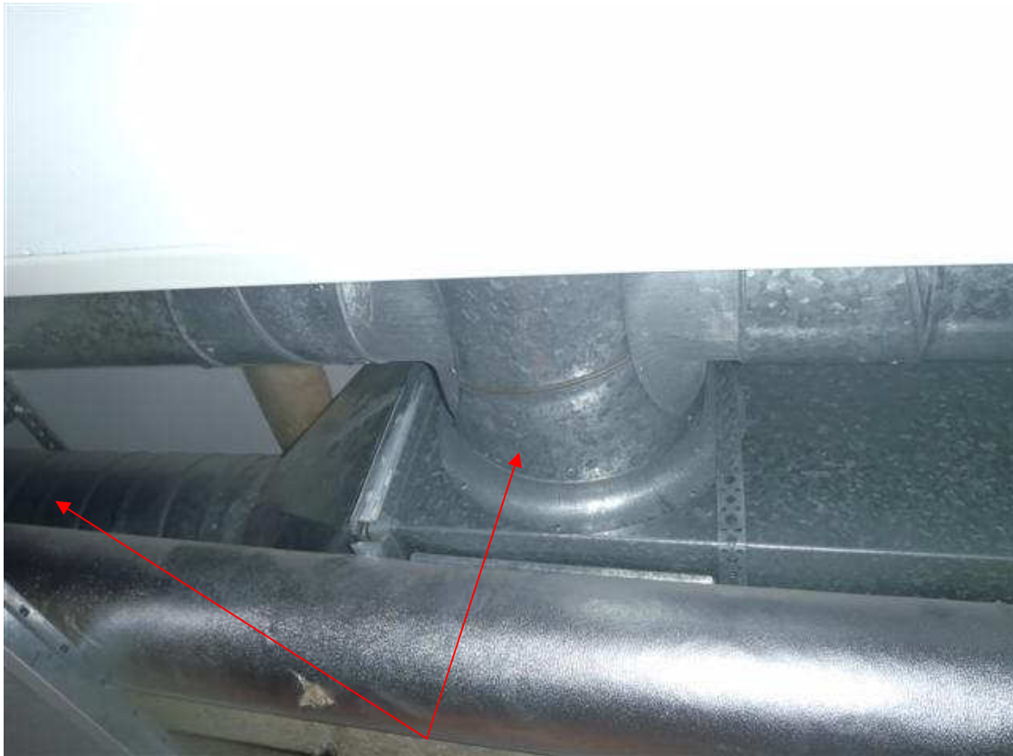
Kuva 5. Liikuntatilan tuloilmakanava pitäisi siirtää lähteväksi pyöreäksi kanavasta.
