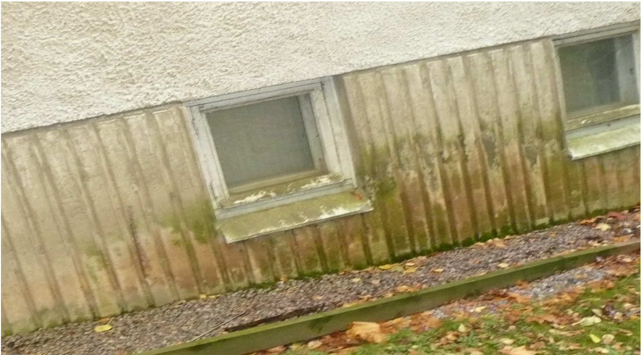
R-kuva 2. Sokkeleiden pinnoissa esiintyy jonkin verran maalipinnan hilseilyä, kulumia ja mikrobikasvuston aiheuttamia vaurioita.
