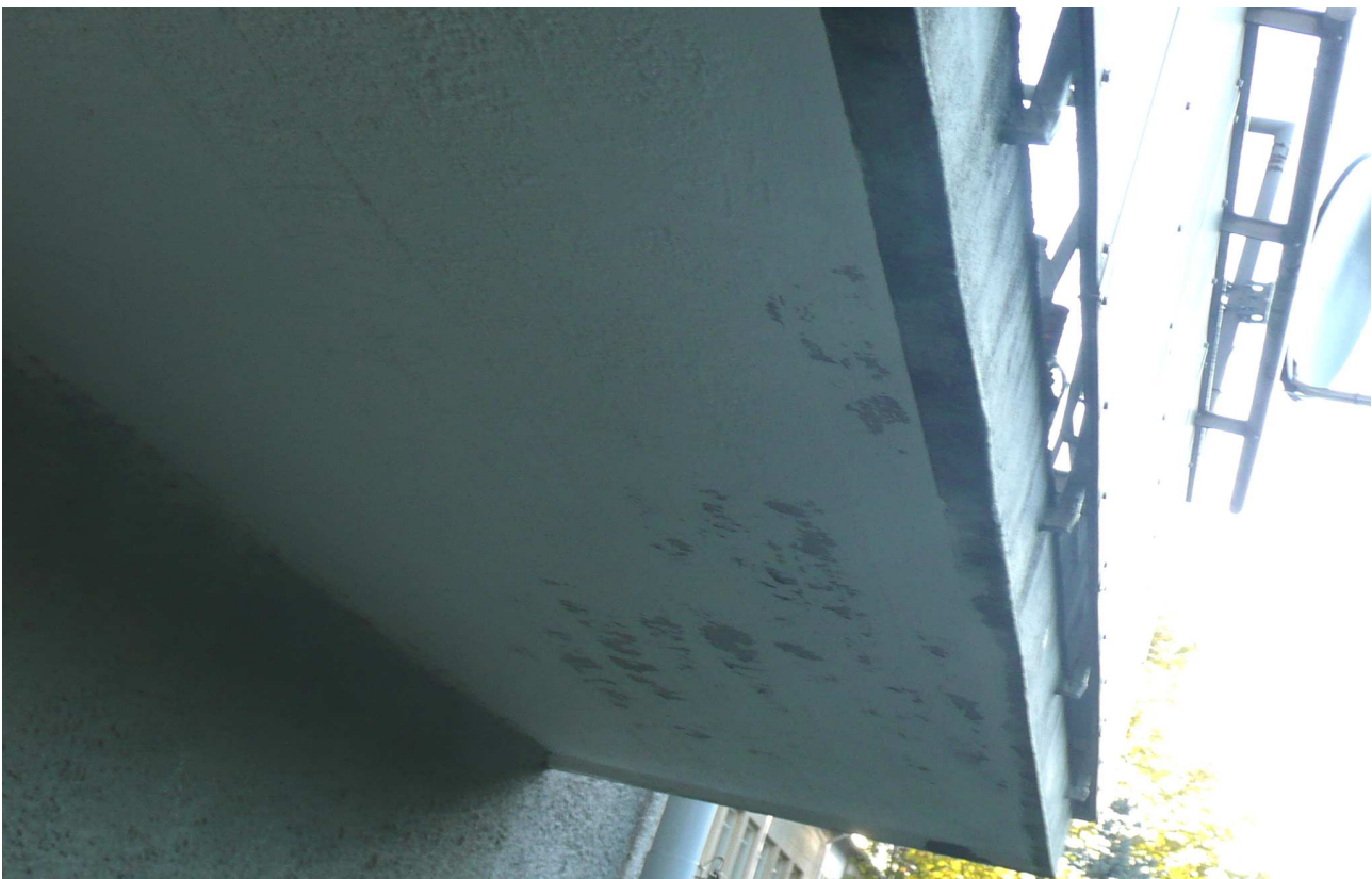
R-kuva 6. Parvekkeen laatan alapinnassa on maalipinnan hilseilyä.
