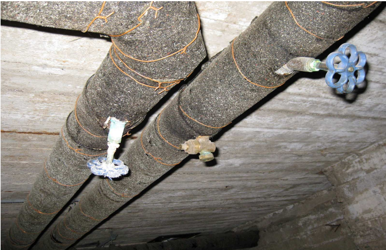
LVI-kuva 2. Yleiskuva lämpöjohtoverkoston venttiileistä.
