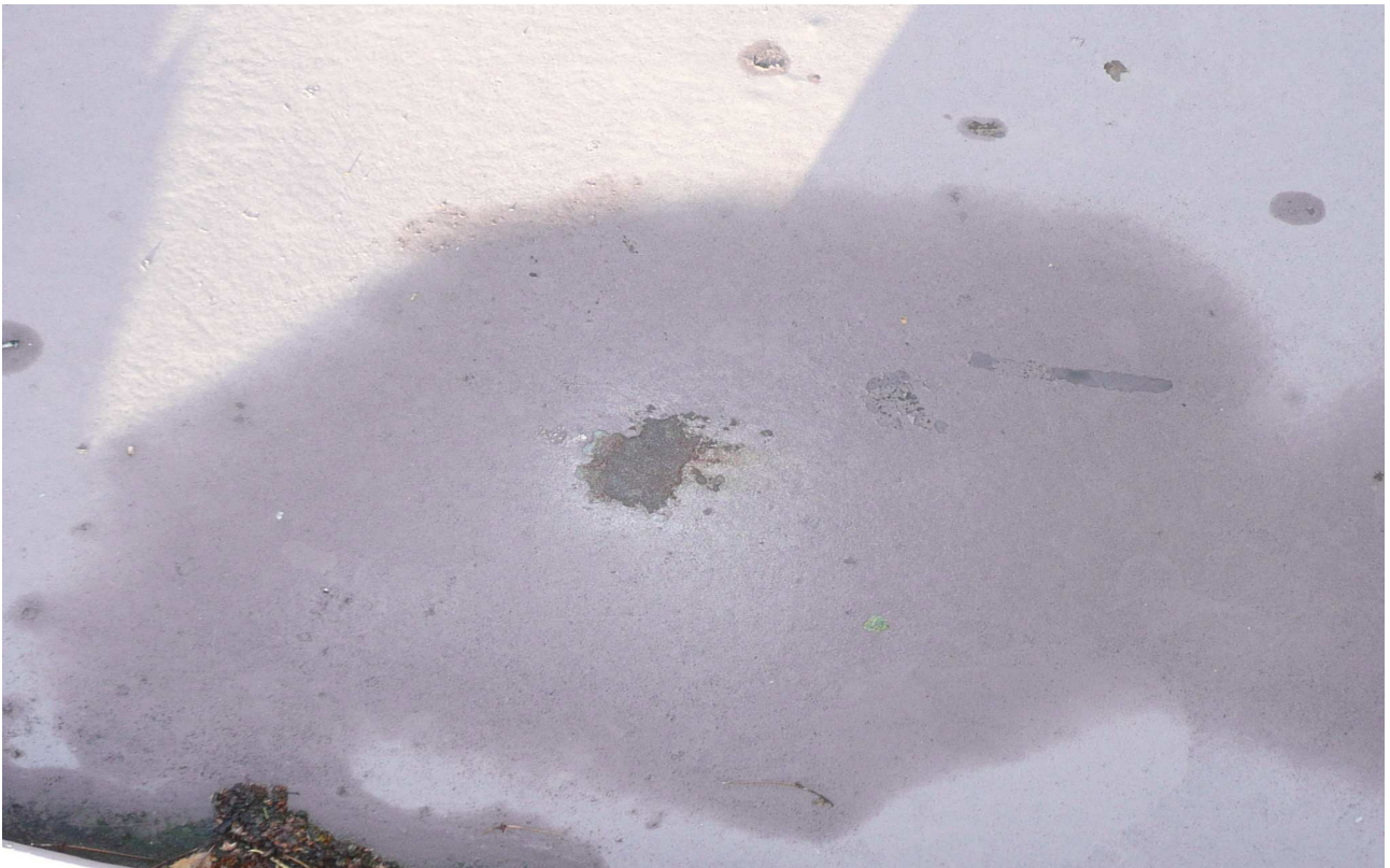
R-kuva 9. Katteessa on myös ruosteen aiheuttamia vaurioita.
