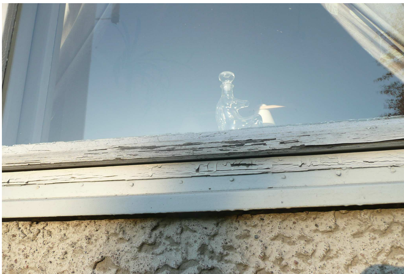
R-kuva 4. Ikkunoiden maalipinnassa esiintyy eriasteisia kulumia ja maalipinnan lohkeiluja.
