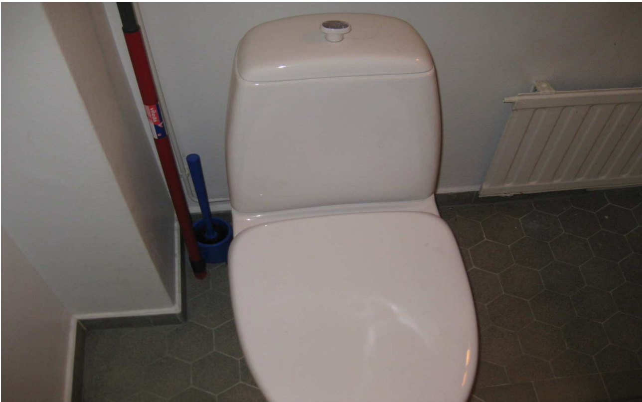
LVI-kuva 6. Yleiskuva vesikalusteista.
