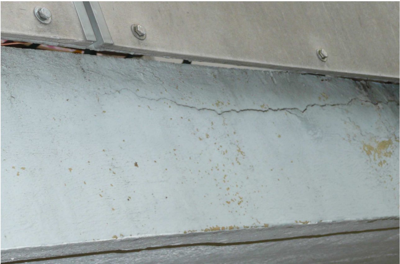
R-kuva 5. Parvekkeen etureunassa todettiin halkeama.
