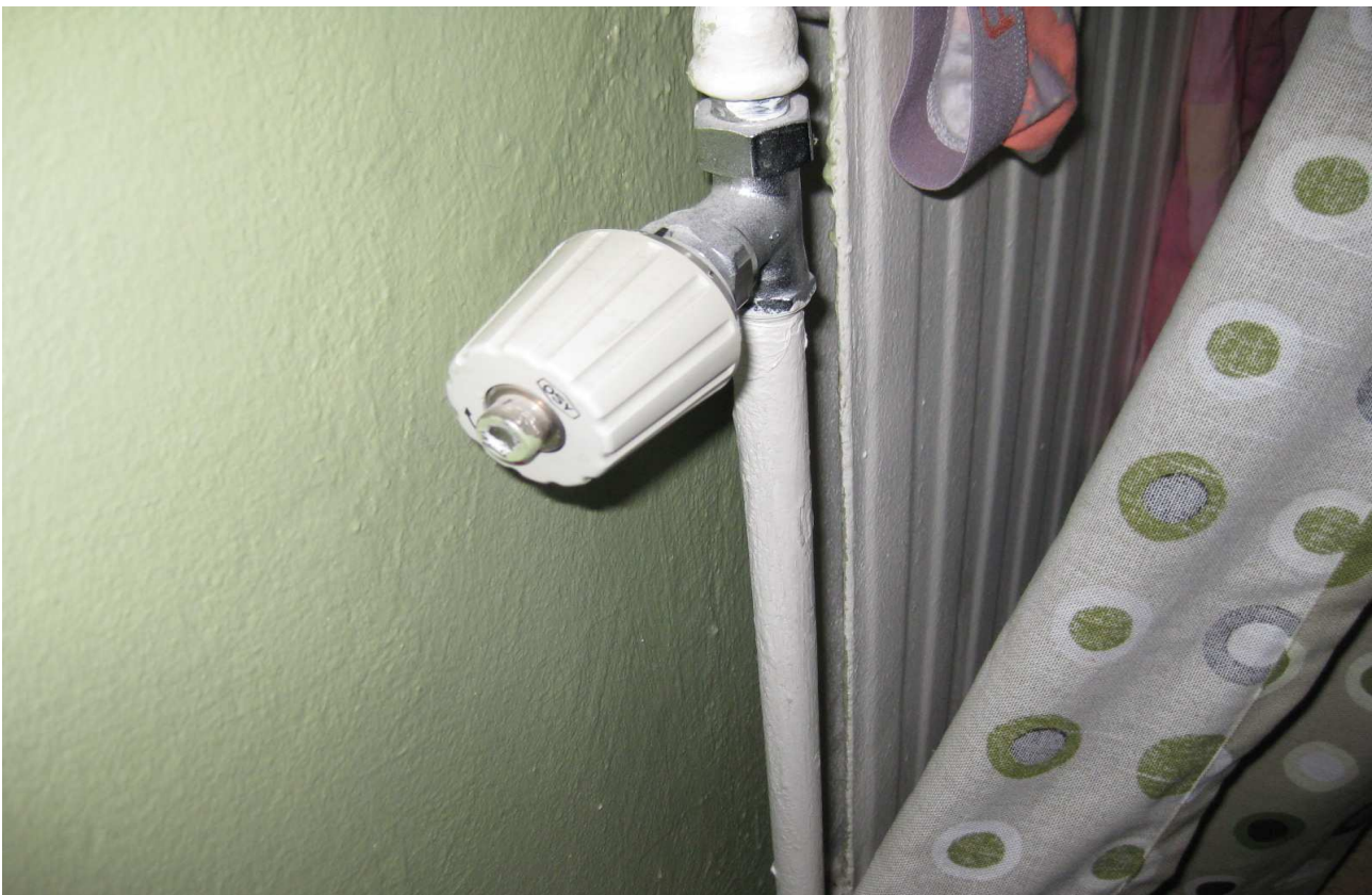
LVI-kuva 3. Yleiskuva patteriventtiilistä.
