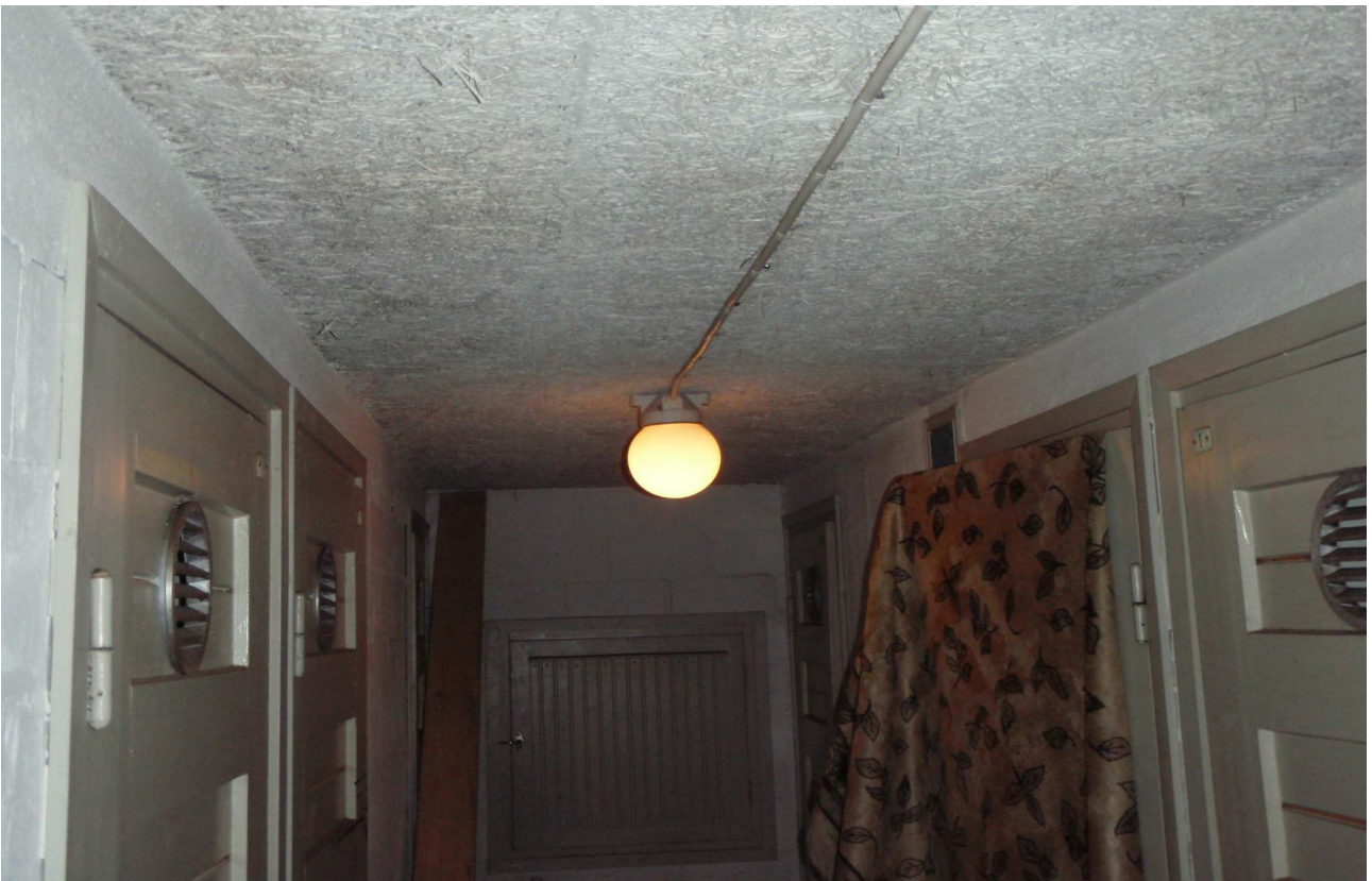
S-kuva 6. Kellarin valaistus.
