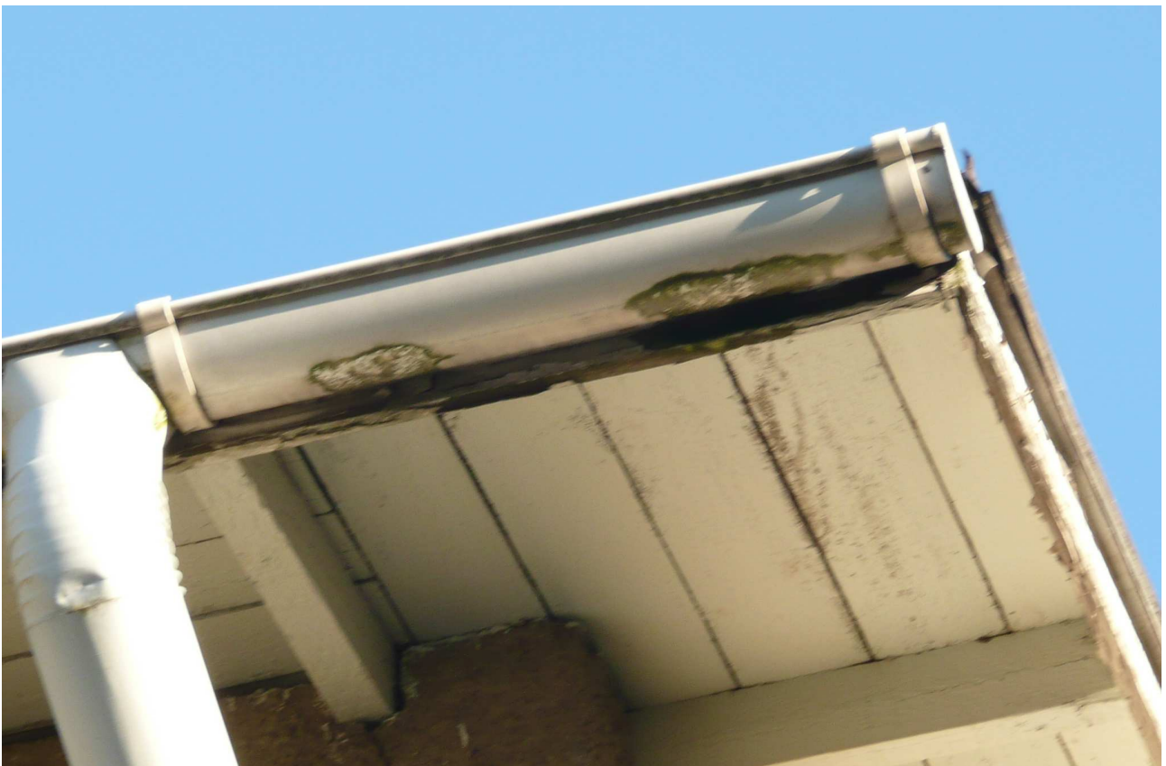
R-kuva 10. Räystäälauta on kärsinyt kosteudesta.
