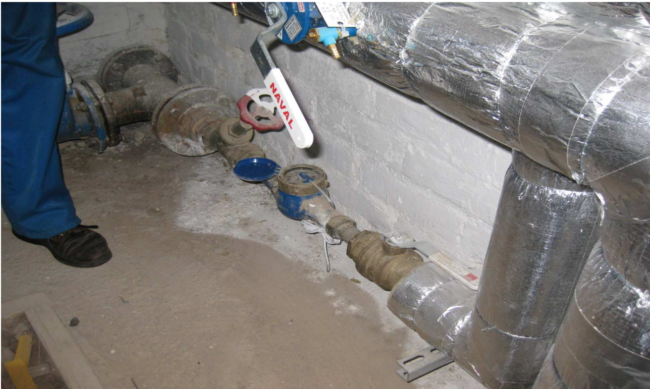
LVI-kuva 4. Yleiskuva vesimittarista ja pääsuluista, jotka sijaitsevat koulurakennuksen kellarikerroksessa.
