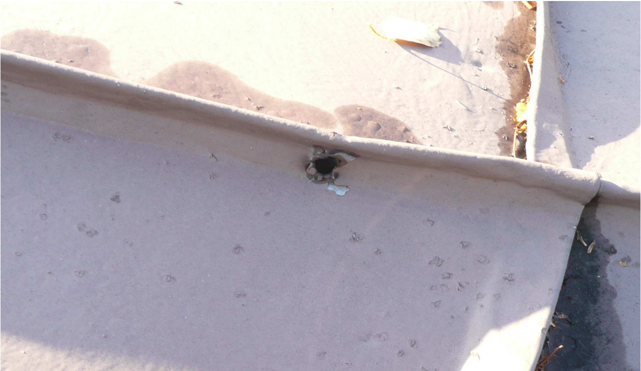
R-kuva 7. Peltikatossa todettiin muutama reikä.
