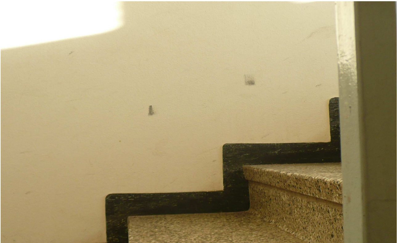
R-kuva 13. Seinissä on käytöstä aiheutuneita kulumia.
