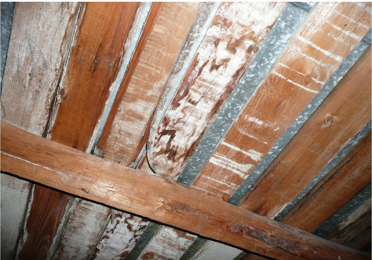
R-kuva 8. Sadevedet ovat päässeet reikien kautta yläpohjarakenteisiin ja aiheuttaneet kosteusvaurioita ruodelaudoitukselle.
