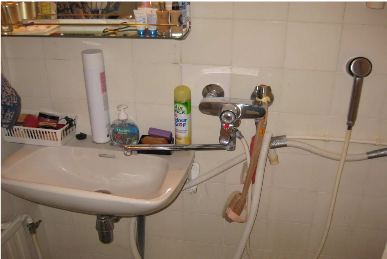
LVI-kuva 5. Yleiskuva vesikalusteista.
