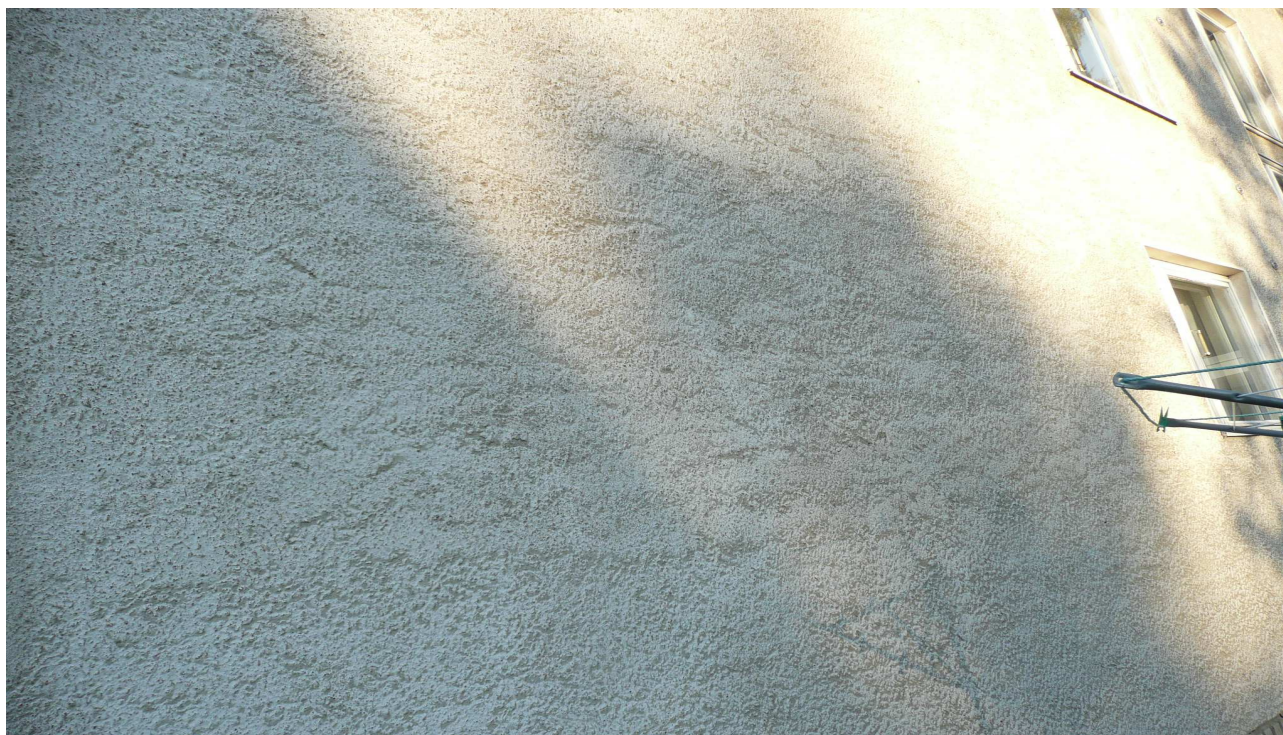
R-kuva 3. Rapatun julkisivun pinnassa esiintyy väri vaihteluja, joka näkyy rappauspinnan tummumisena.
