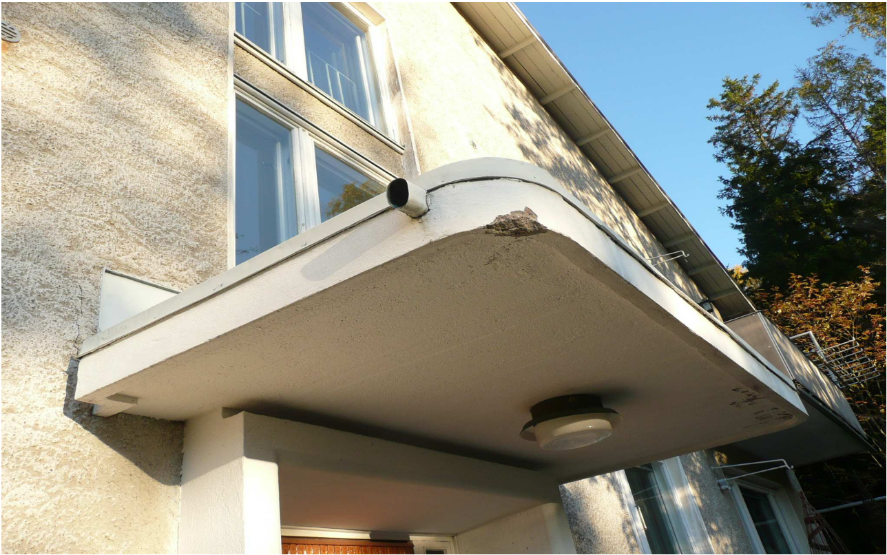
R-kuva 1. Pääsisäänkäynnin katoksen betonipinnoissa on lohkeamia.
