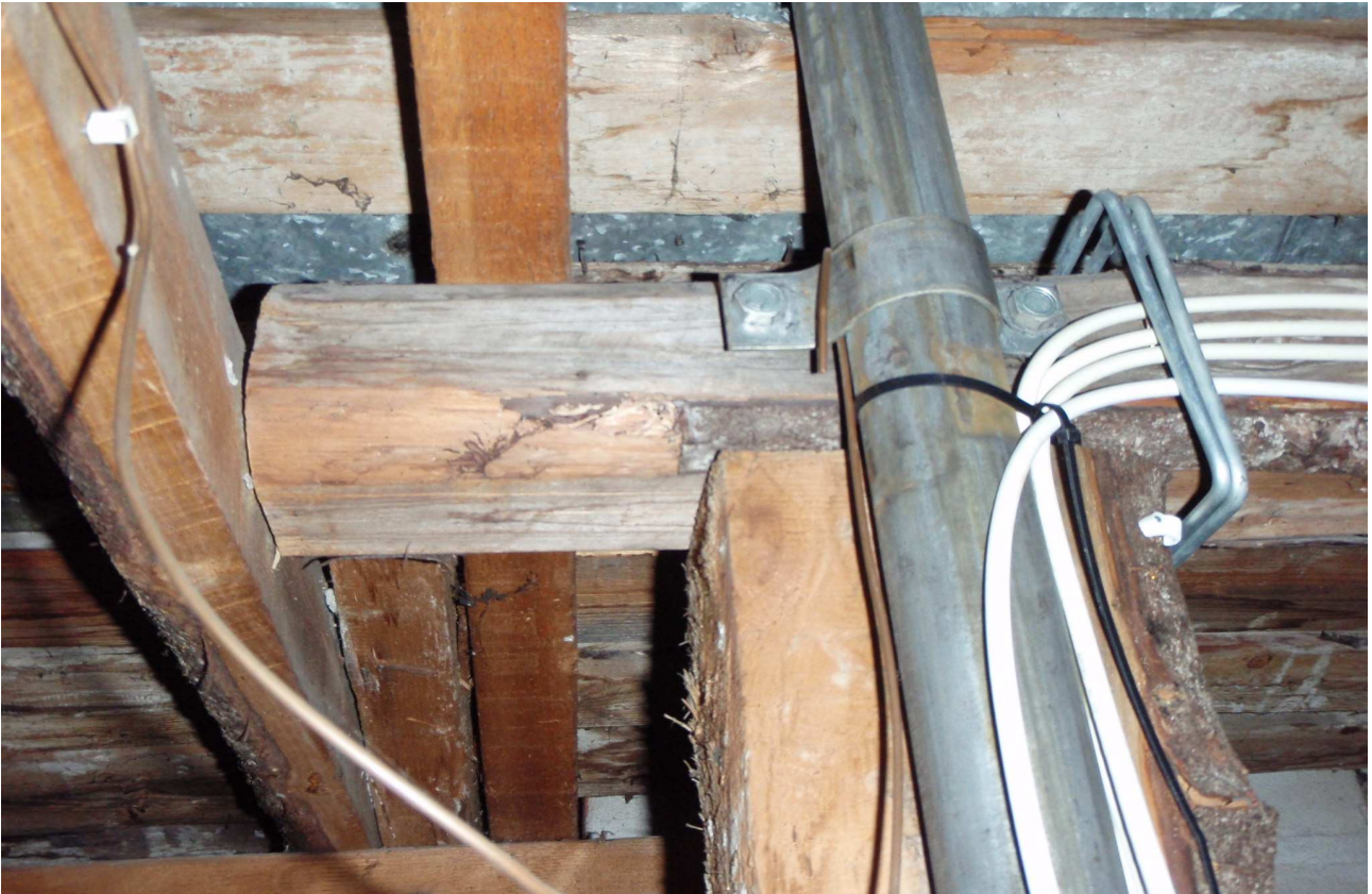
S-kuva 5. Ullakolla antennimaston potentiaalintasausjohdin on irti.
