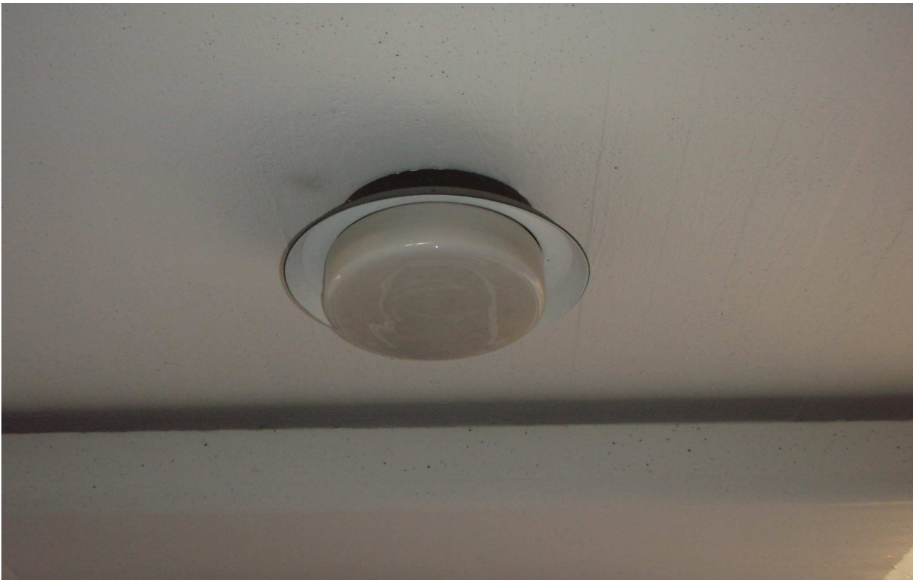
S-kuva 1. Sisäänkäynnin valaistus.
