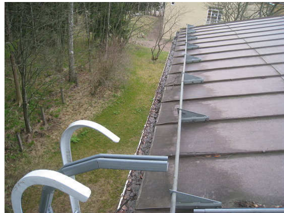
Kuva 2 Räystäskouruissa runsaasti lehtiä yms..
