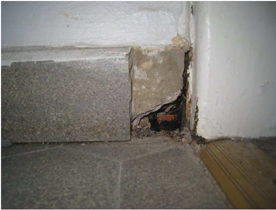
Kuva 23 Avauskohta asunnon 6 kylpyhuoneen avauskohta. Mikrobivaurioon viittaavaa hajua.
