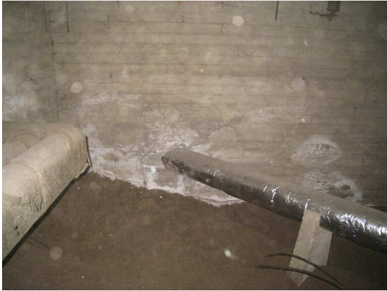
Kuva 15 kosteuden aiheuttamia jälkiä myös Alustatilassa 2.
