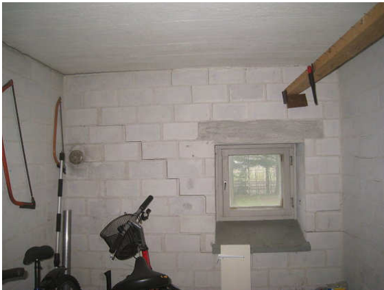
Kuva 5 Länsikulmassa sisäverhousiili-muurauksessa on halkeama.
