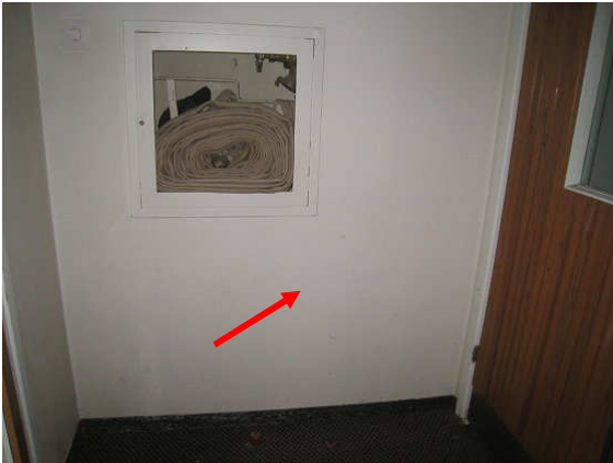
Kuva 29 Palopostin alaosalla seinässä kohonneita kosteuksia ja halkeamia.
