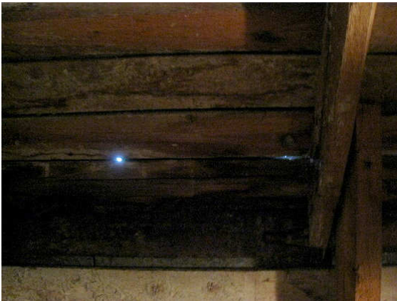
Kuva 19 Vesikatteessa reikiä harjalinjalla.
