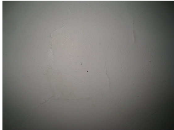
Kuva 30 Lähikuva palopostin alaosan vauriokohdasta.
