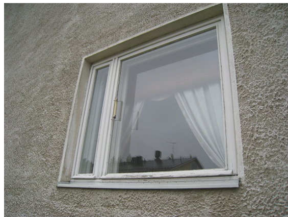
Kuva 26 Ikkunoiden puupintojen maalipinta hilseilee.
