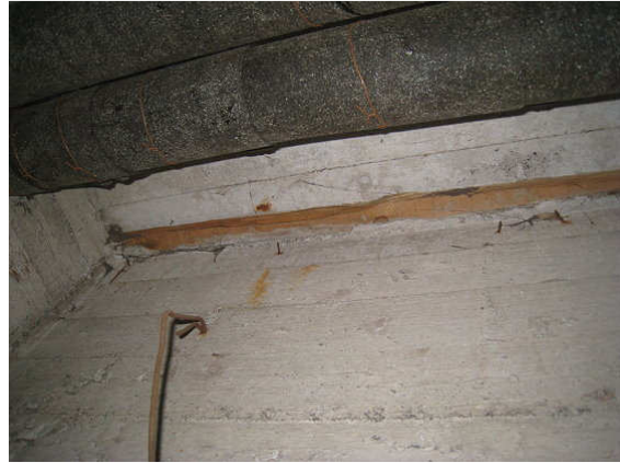
Kuva 16 Perusmuurin ja katon rajassa jäljellä hyväkuntoista muottilaudoitusta.
