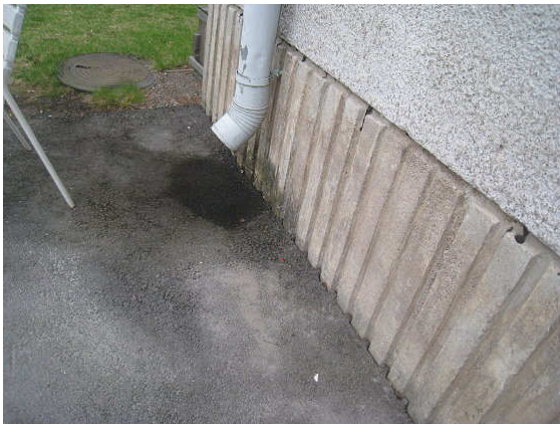
Kuva 1 Asfaltissa on painanne ja sade- ja kattovesi lammikoituu.
