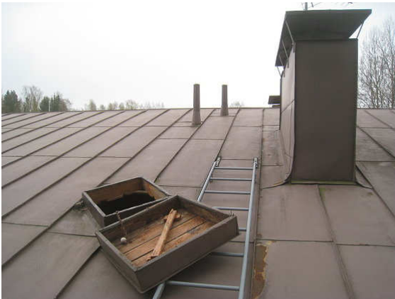
Kuva 17 Pulttikiinnitykset katteen läpi ovat vesivuotoriskipaikkoja.
