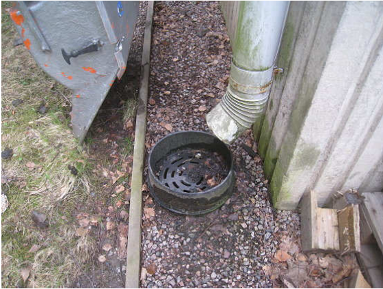
Kuva 3 Heitinosa ja kaivon keskinäisessä sijoittamisessa puutteita.
