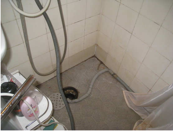
Kuva 21 Alkuperäiskunnossa olevan kylpyhuoneen lattiaa ja seinän alaosa suihkunurkassa.
