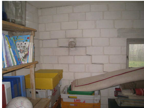
Kuva 6 Halkeama myös keskemällä länsisivua.
