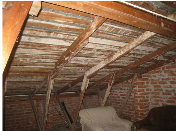
Kuva 20 Ruodelaudoissa ja kattotuolirakenteissa on kondenssiveden aiheuttamia jälkiä.
