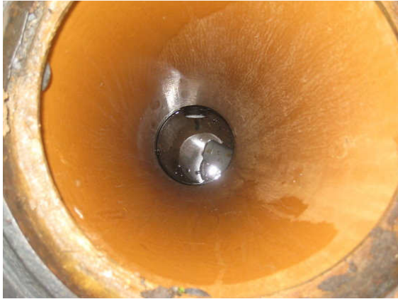
Kuva 9 Pohjoiskulman salaojien tarkastuskaivo.
