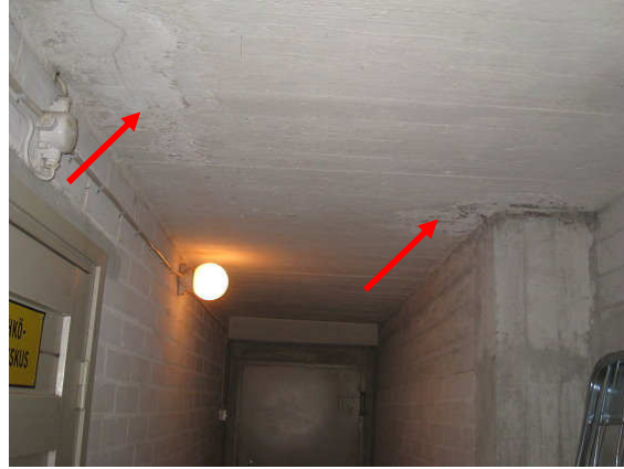
Kuva 22 Kellarin käytävän katossa kosteuden aiheuttamaa maalipinnan hilseilyä. Yläpuolella on asunnon 2 kylpyhuone.
