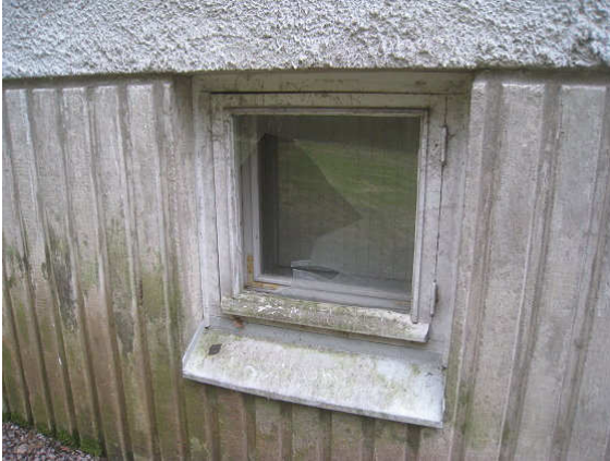
Kuva 27 Kellarikerroksen ikkunalasi rikottu.
