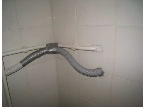
Kuva 28 Asunnon 6 kylpyhuoneen suihkukurkan seinässä kiinnityksiä ja tiivistämätön läpivienti.
