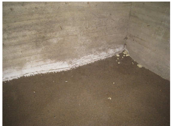
Kuva 14 Kalkkisuoloja näkyvillä perusmuurin alaosalla lähellä täyttökerrosta alustatilassa 1.
