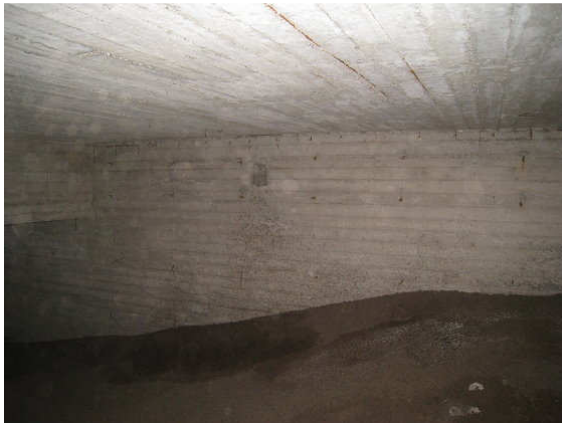
Kuva 11 Perusmuurissa tuuletusaukon alapuolella tummentumia.
