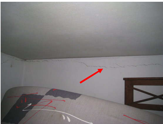
Kuva 25 Ullakkokerroksen varastotilan seinässä (porrashuone) on vaakasuuntainen halkeama.
