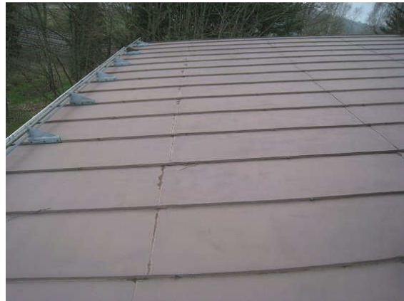
Kuva 18 Vesikatteen pinnalla ruostetta.
