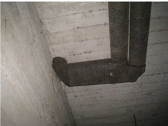
Kuva 13 Lämpöputkinousujen läpivientejä ei päästy tarkistamaan.
