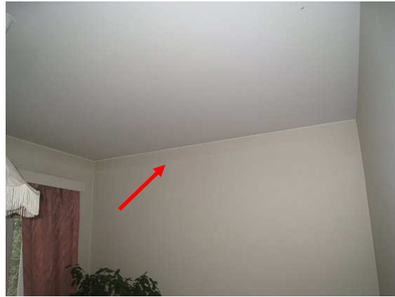
Kuva 24 2.kerroksessa asunnon 6 makuuhuoneen ulkoseinän yläosalla vaakasuuntainen halkeama.
