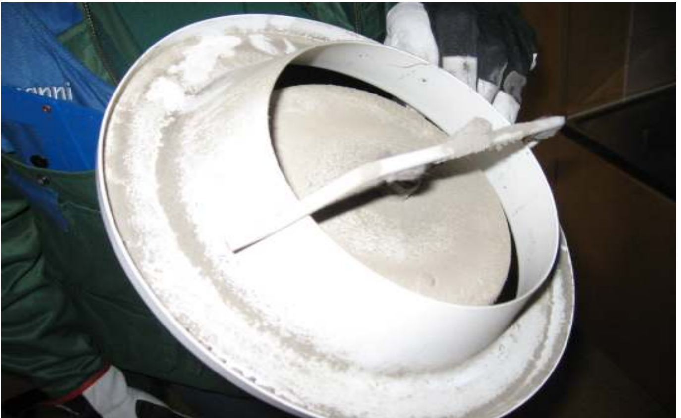
KUVA 12. Poistoilmaventtiilit ovat osin melko pölyisiä.
