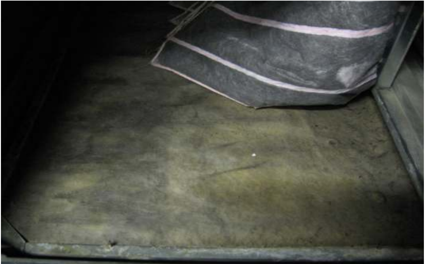
KUVA 5. Koneen kammion seinät on vuorattu mineraalivillalla, joka on alttiina kolhuille.
