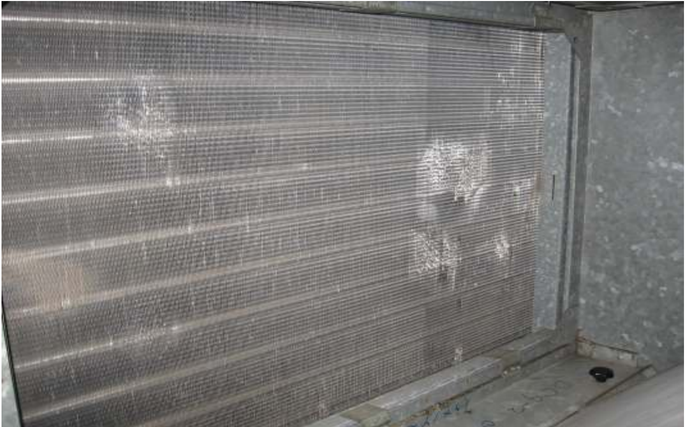
KUVA 3. Lämmityspatterissa on pieniä kolhuja.
