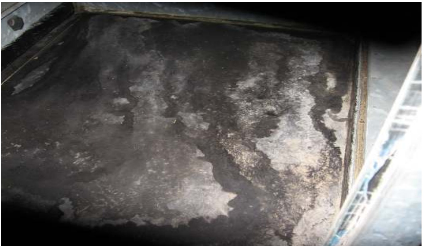
KUVA 2. LTO- kammiossa on kosteuden jättämiä jälkiä.
