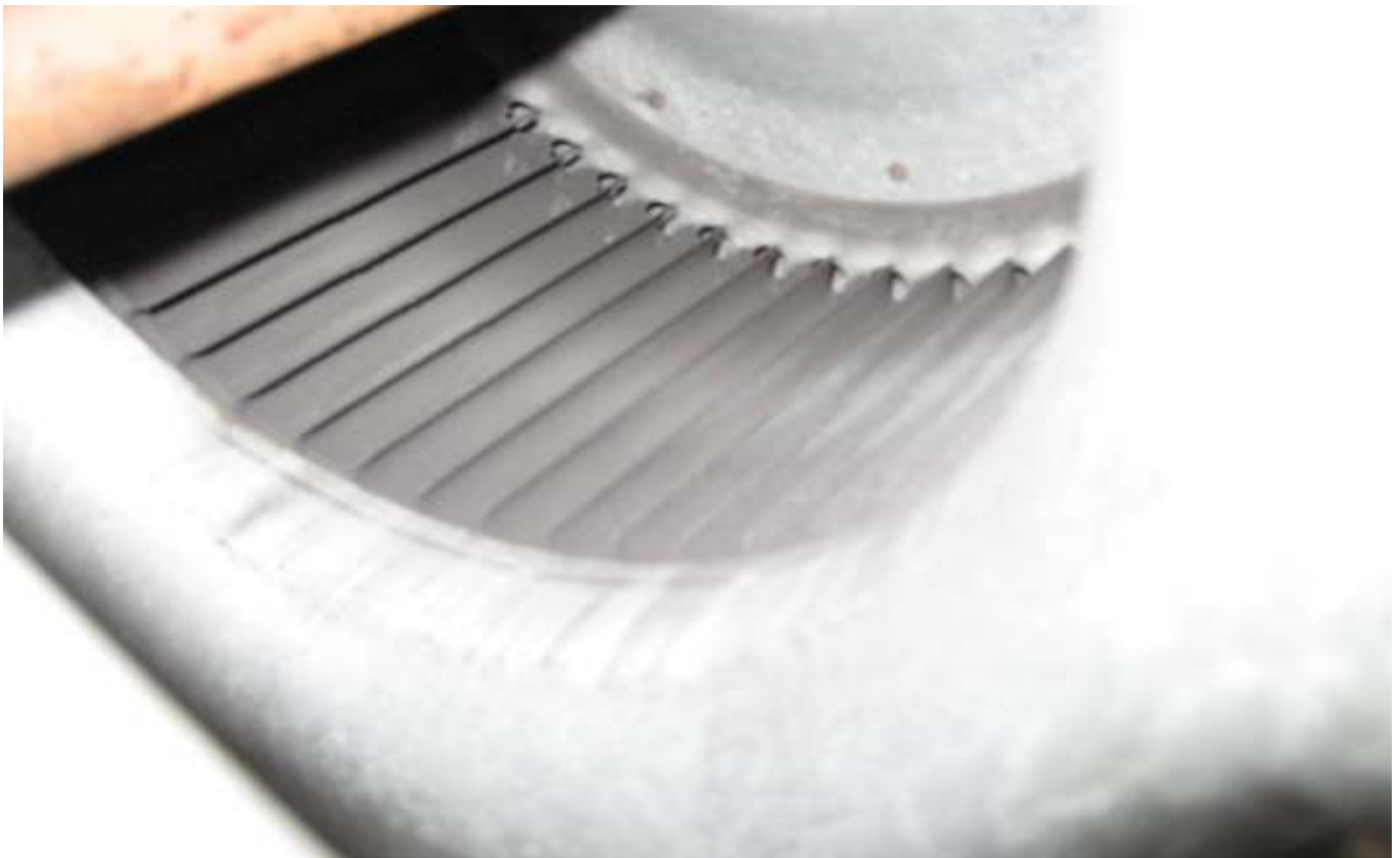
KUVA 4. Tuloilmapuhallin on pölyinen ja nokinen.
