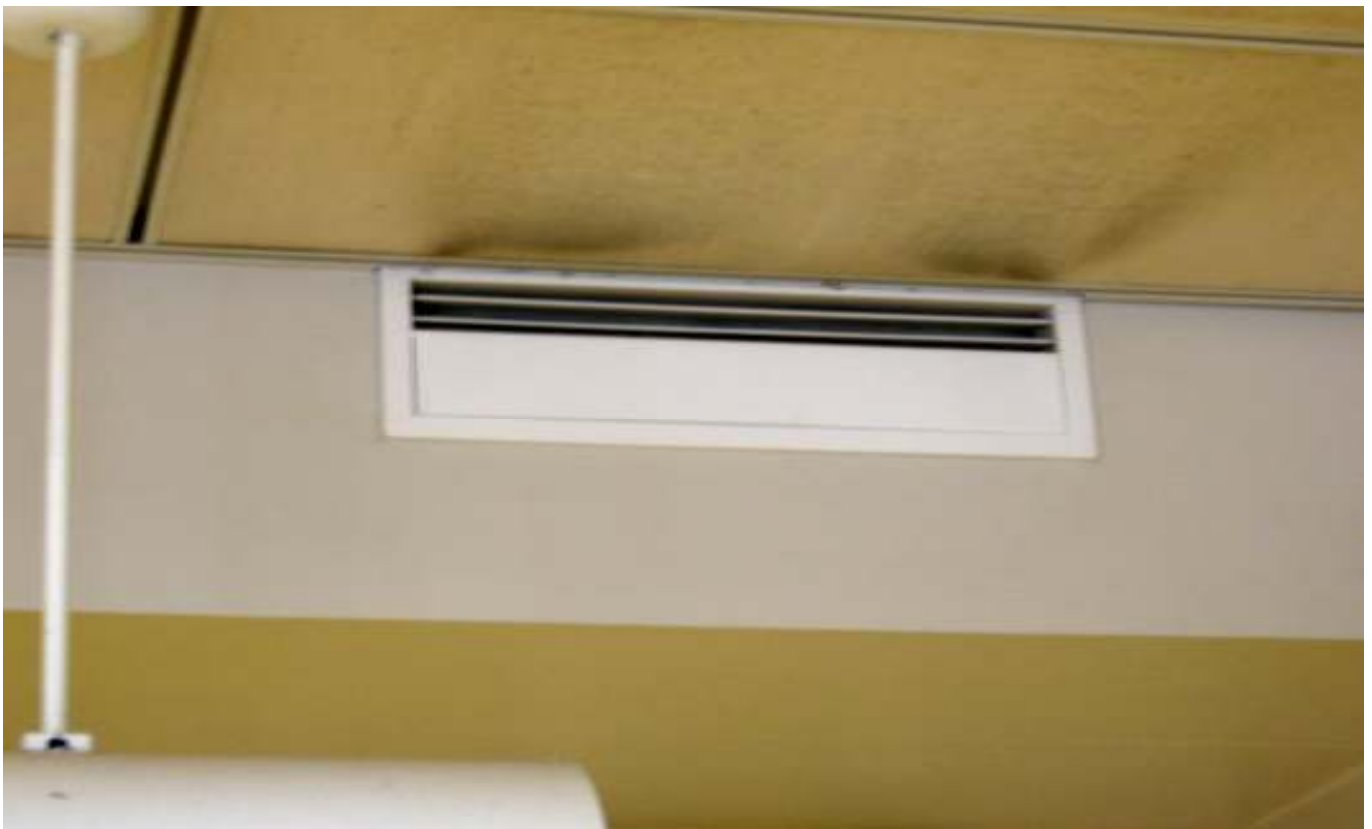
KUVA 10. Luokkatilojen tuloilmasäleiköt ovat ritiläsäleikköjä.
