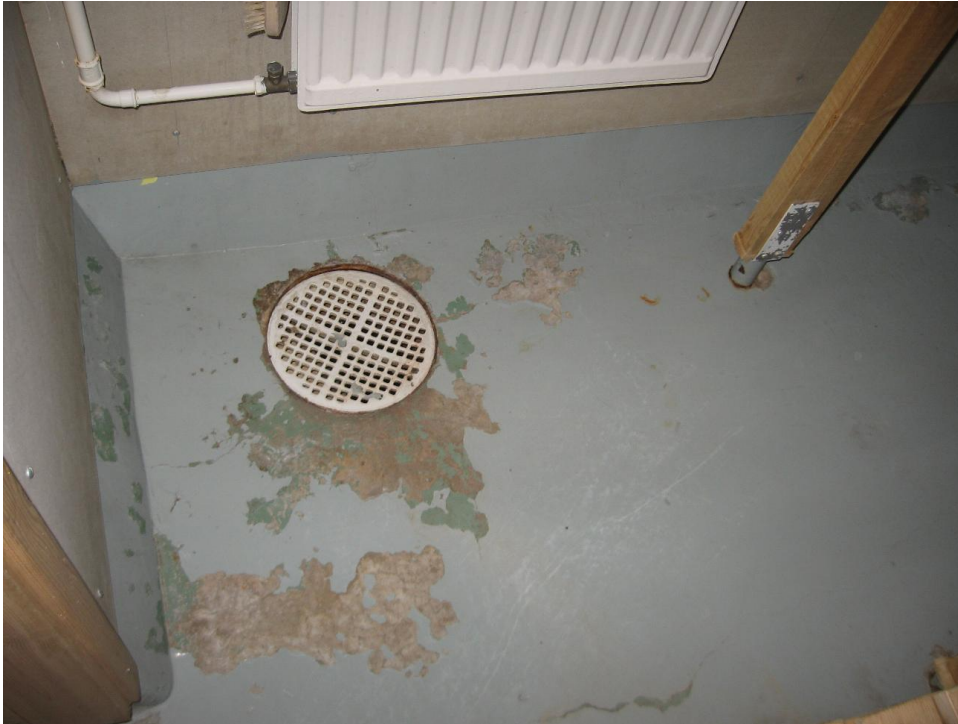
Kuva 5. Yläkellarin saunan lattiakaivon ympäriltä irronneita pinnoitteita.
