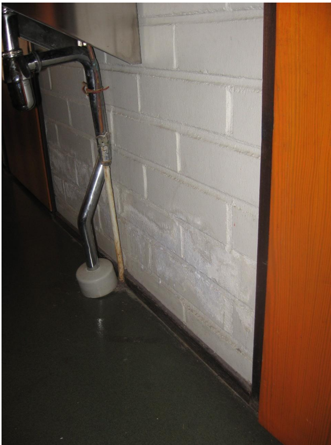
Kuva 16. Liikuntasalin yhteydessä olevan käytävän vesipisteen ympärillä on kosteusjälkiä tiiliväliseinän kummallakin puolella.
