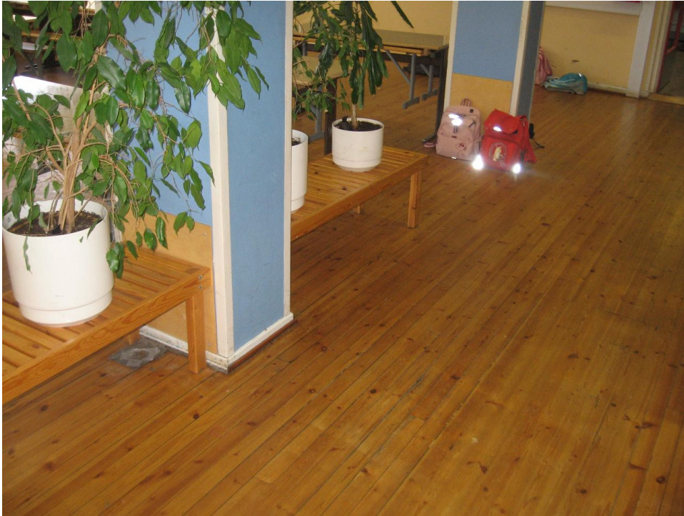
Kuva 17. Ruokasalin yläpuolella oleva WC-tila on henkilökunnalta saadun tiedon mukaan joskus vuotanut ruokasalin lautalattialle ja lattialautojen alapuoliseen eristetilaan. Kuvassa pilarin vieressä näkyvissä lattian kuivatuskohta.
