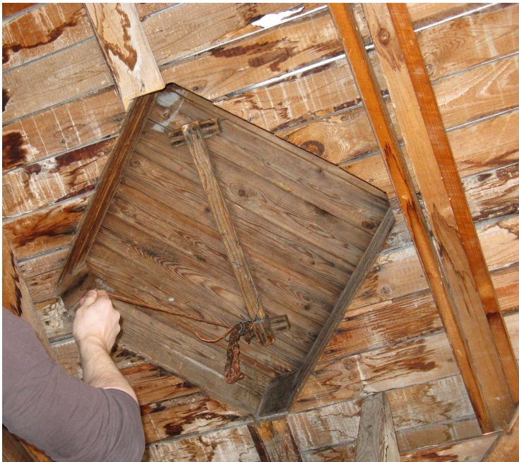
Kuva 30. Kattoluukun kiinnityskettinki on irti ja luukun ympärillä vuorojälkiä.
