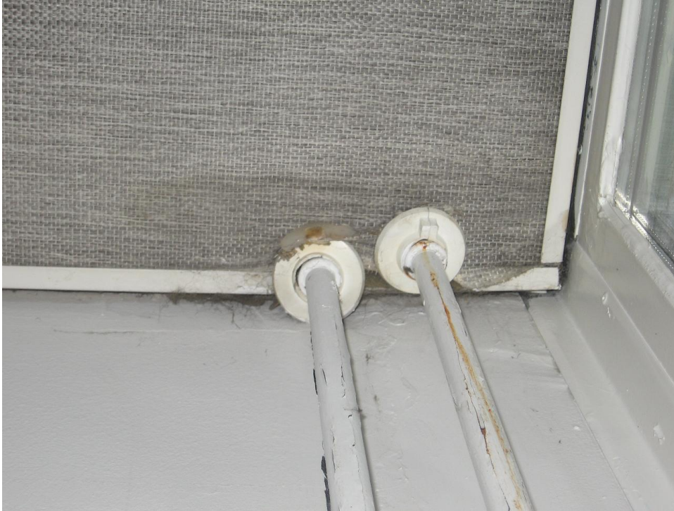
Kuva 15. Alakaton kosteusjälkiä samassa tuulikaapissa.
