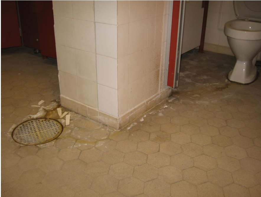
Kuva 11. Tyttöjen vanhan WC:n pitkään juurestaan vuotanut WC-pönttö.
