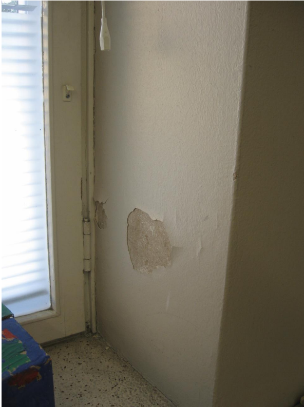
Kuva 19. Jälkiä musiikkiluokan ikkunaliittymässä.
