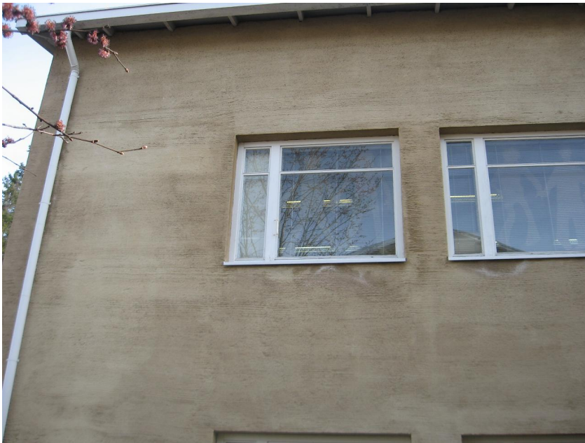
Kuva 27. Kosteusjälkiä ikkunoiden alaosissa.
