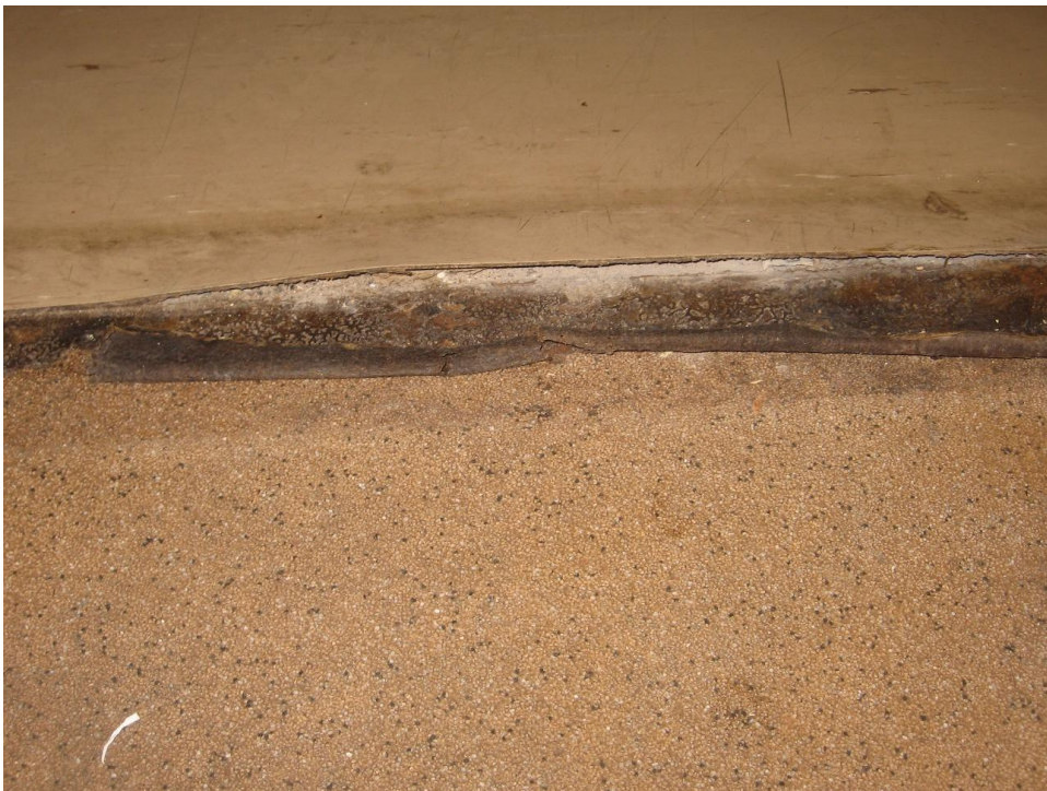
Kuva 18. Keittiön yhteydessä olevan käytävän muovimaton ja perkaushuoneen lattiamassan avonainen liitoskohta oviaukossa, josta vesi pääsee muovimaton alle.
