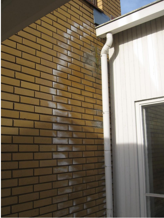
Kuva 20. Kosteusjälkiä tiili- ja puujulkisivun nurkka-alueella.
