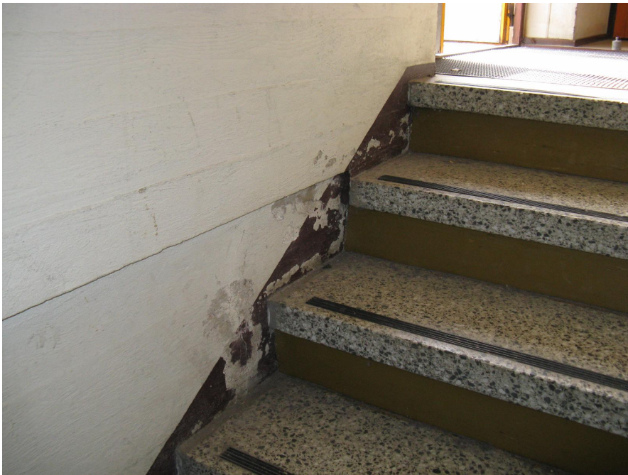
Kuva 12. Vanhoja kosteusjälkiä väestönsuojan edustan portaiden kohdalla olevassa ulkoseinässä.
