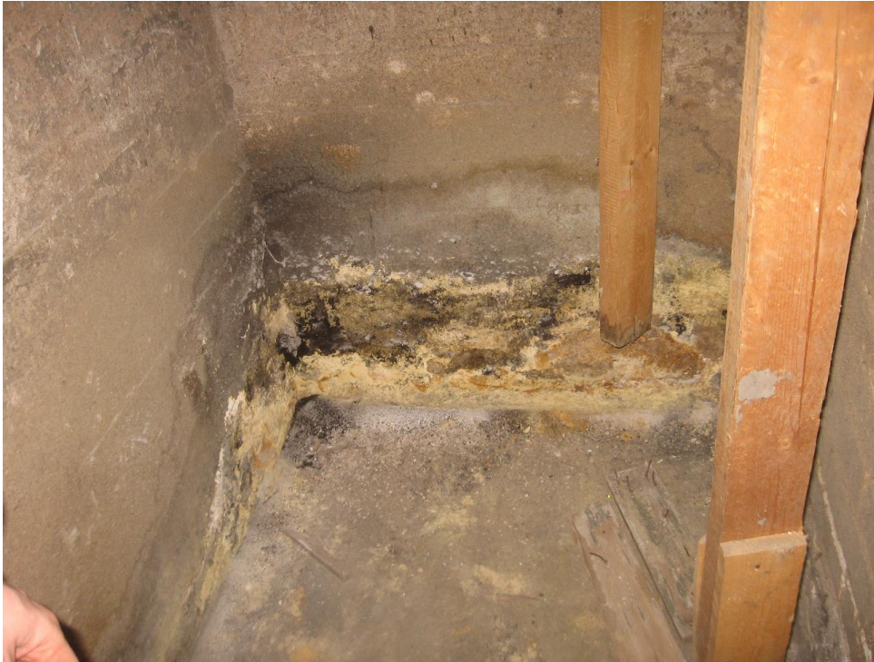
Kuva 3. Kosteusjälkiä alakellarin tuhkasiilon maanvastaisen betoniseinän alaosassa.
