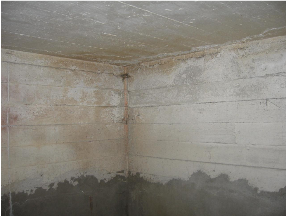
Kuva 1. Kosteusjälkiä alakellarin polttoainevaraston maanvastaisessa betoniseinässä.
