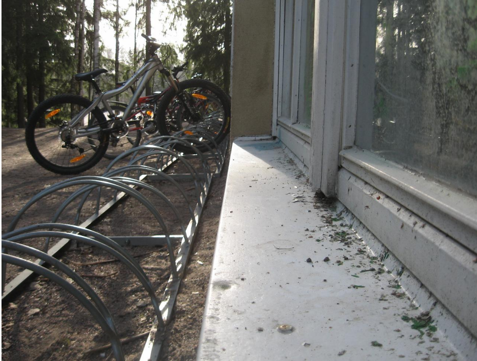
Kuva 26. Vanhan osan ikkunan vesipellin puutteellinen kallistus.
