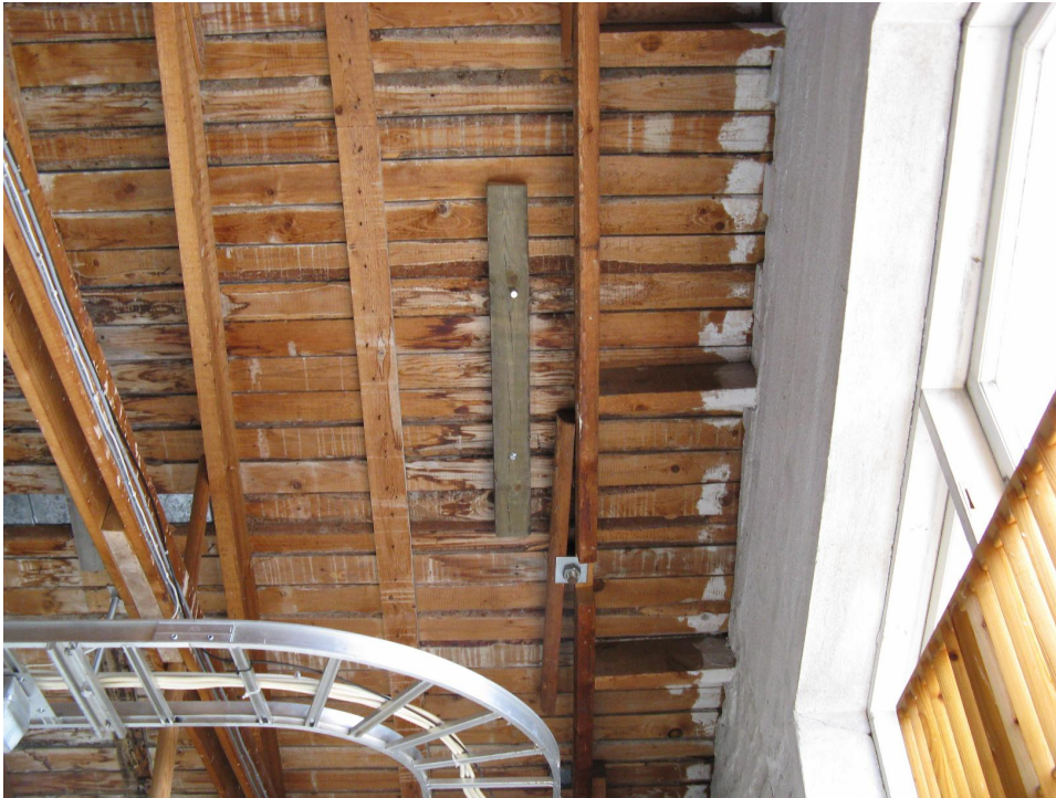
Kuva 29. Kattosiltojen kiinnityskohdissa on vuotojälkiä.
