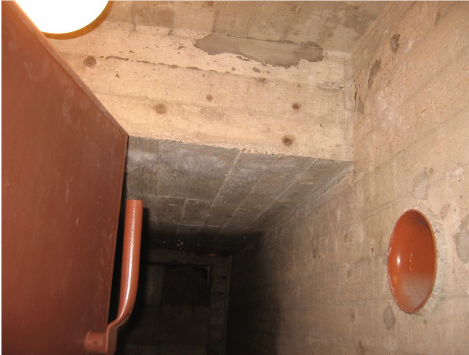
Kuva 9. Yläkellarissa sijaitsevan väestönsuojan poistumiskuilun mikrobikasvustoa.
