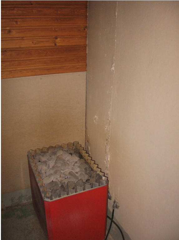
Kuva 7. Saunan seinän pinnoitteet hilseilevät johtojen roilotuksen kohdalta.
