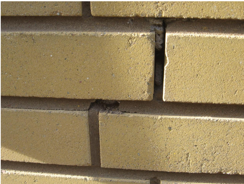
Kuva 25. Kuvassa näkyvissä vanhan tiilisaumauksen päälle saumattua uudem- paa saumausta, joka osassa tiilijulkisivua irtoilee.
