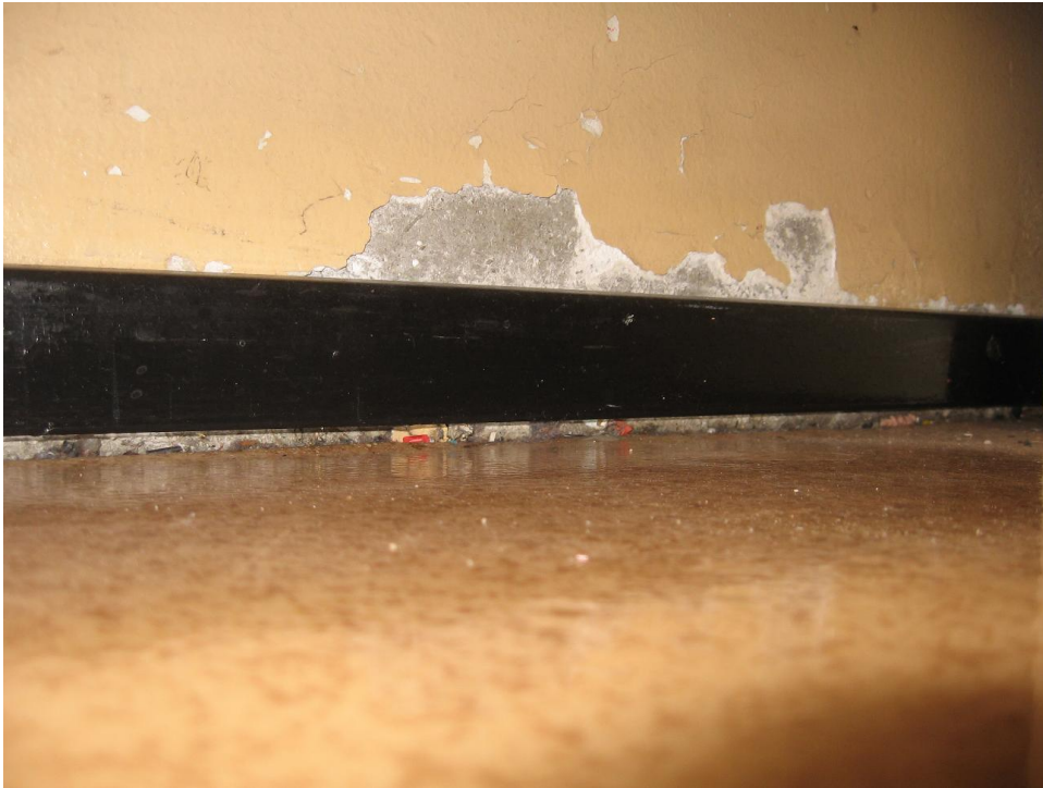
Kuva 13. Lisärakennuksen luokkatilan vanhoja kosteusjälkiä ulkoseinän alaosassa sekä viitteitä lattian painumisesta.
