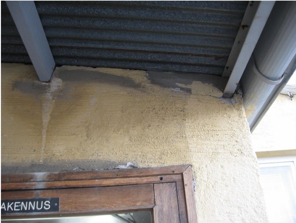
Kuva 24. Katoksen ja julkisivun vuotanut liitoskohta.
