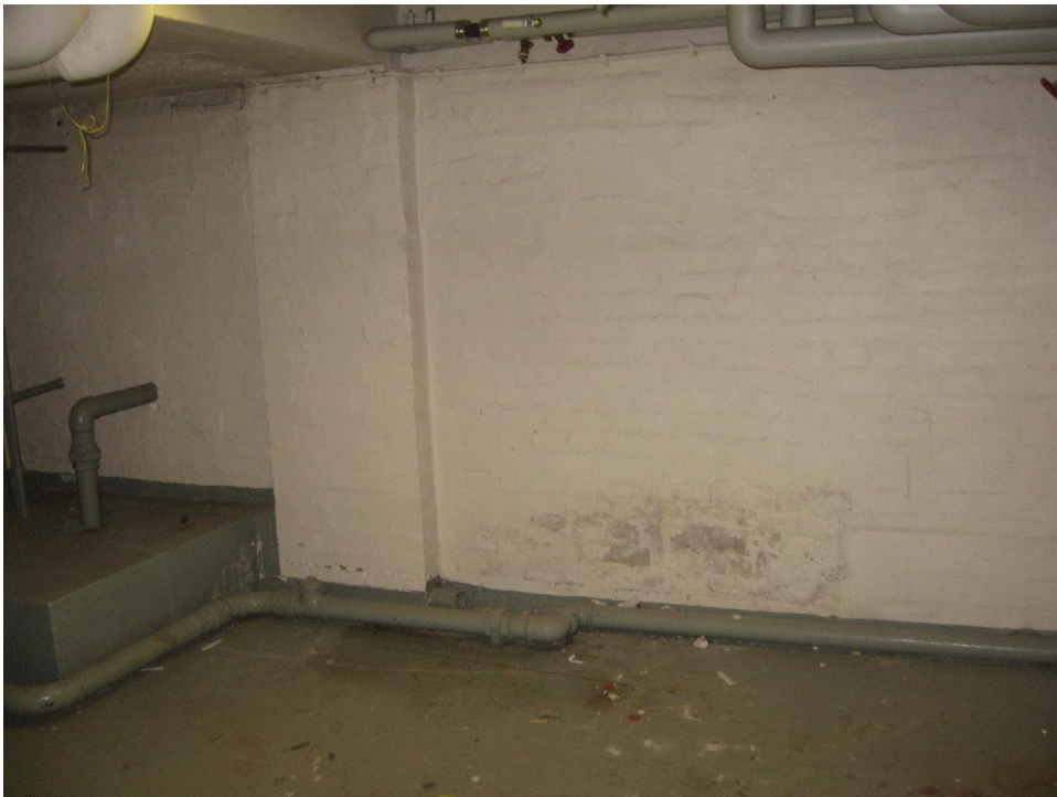
Kuva 4. Viitteitä alapohjan kosteuden kapillaarisesta noususta polttoainevaraston ja painesäiliöhuoneen välissä olevassa tiiliväliseinässä yläkellarissa.
