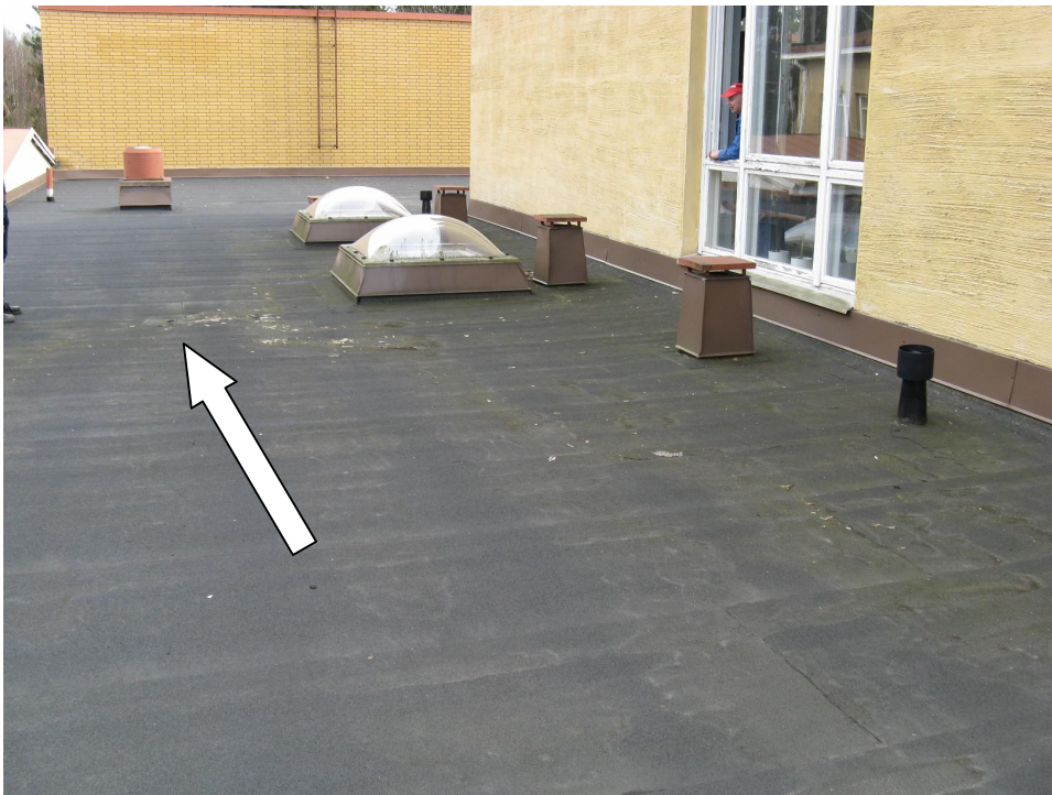
Kuva 32. Kahdesta kattokaivosta puuttuvat sihdit.
