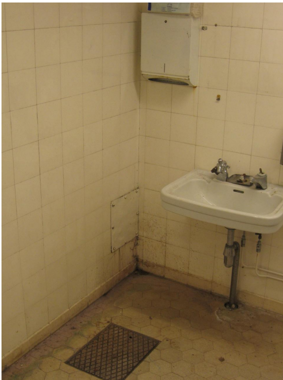
Kuva 10. Tyttöjen vanhan WC:n maanvastaisen seinän nurkan kosteusjälkiä.
