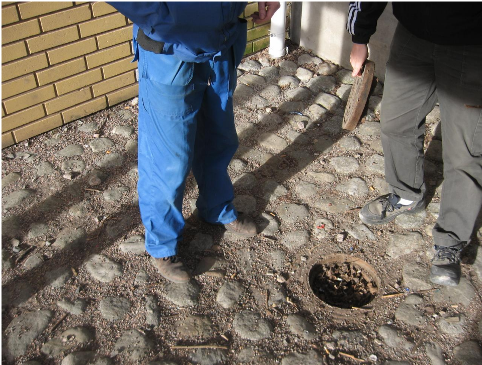
Kuva 22. Tukossa oleva rännikaivo.
