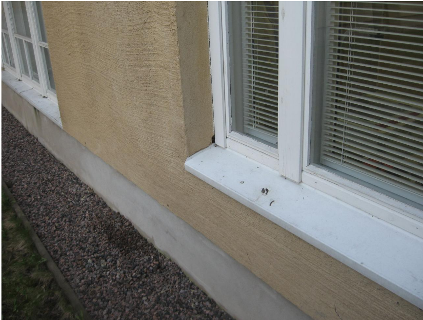
Kuva 28. Ikkunoiden seinäliitoksissa ei ole elastisia saumauksia.
