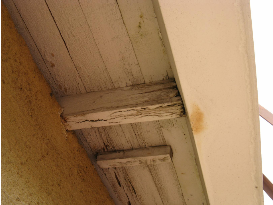
Kuva 35. Osassa räystäistä on vauriojälkiä.
