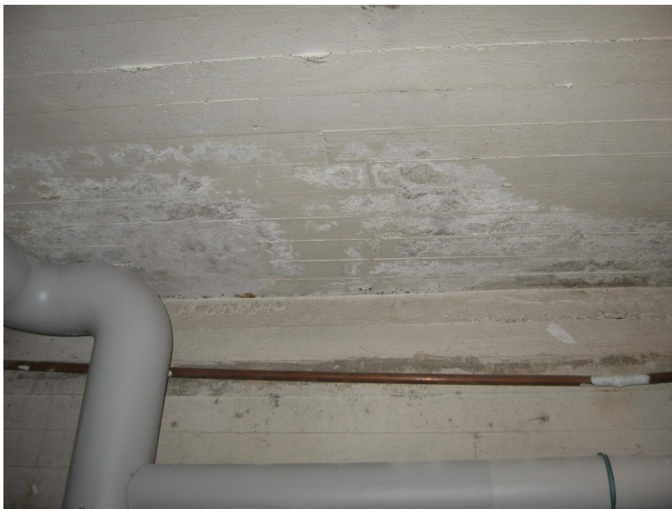
Kuva 2. Kosteusjälkiä alakellarin pumppuhuoneen välipohjassa.
