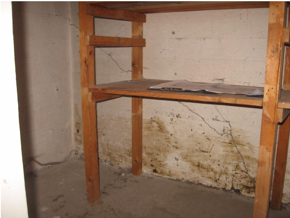
Kuva 8. Yläkellarissa sijaitsevan talouskellarivaraston seinän halkeama.
