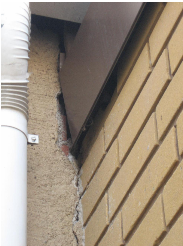
Kuva 23. Julkisivujen sisänurkkaliitoksissa ei ole elastisia liitoksia.
