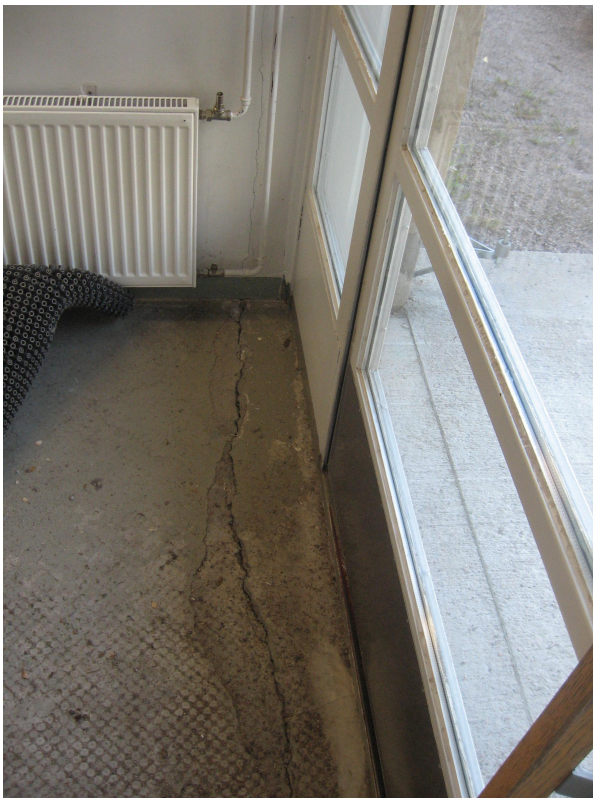
Kuva 14. Halkeama lisärakennuksen tuulikaapin lattiassa ja seinässä.
