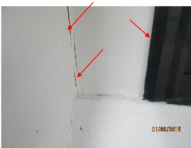
Kuva 4. Vuotoilmareitti seinän halkeamasta (tila 039).
