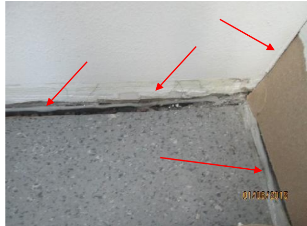
Kuva 3. Vuotoilmareitti lattian ja ulkoseinän rajapinnasta (tila 202).
