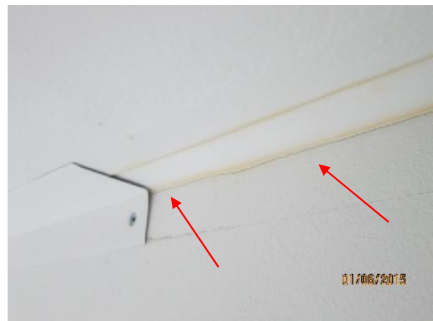
Kuva 5. Vuotoilmareitti ontelolaatan ja seinän liitoksesta (tila 204).
