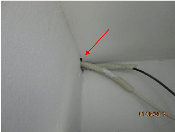
Kuva 2. Vuotoilmareitti seinän läpiviennistä (tila 165).
