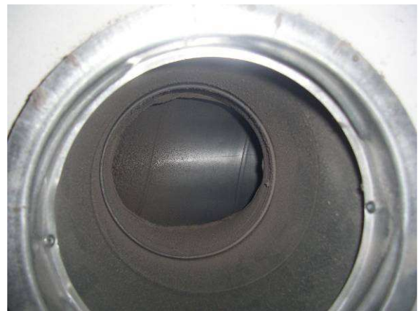
Ilmanvaihtokanavissa oli lievää pölykertymää.
