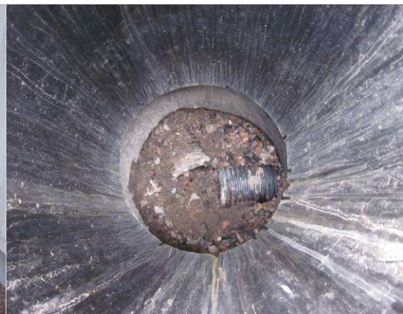
Salaojan tarkastuskaivossa huomattava määrä sepeliä
