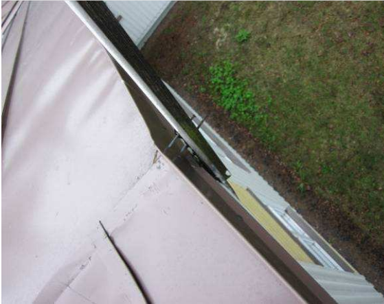
Antennin kiinnikkeet ovat irtoamassa otsalaudasta
