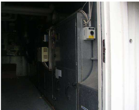
Yhteinen lämmönjako, ilmanvaihtokonehuone.
