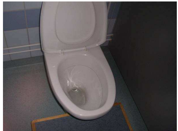
Vuotavia wc-istuimia havaittiin 3 kpl.
