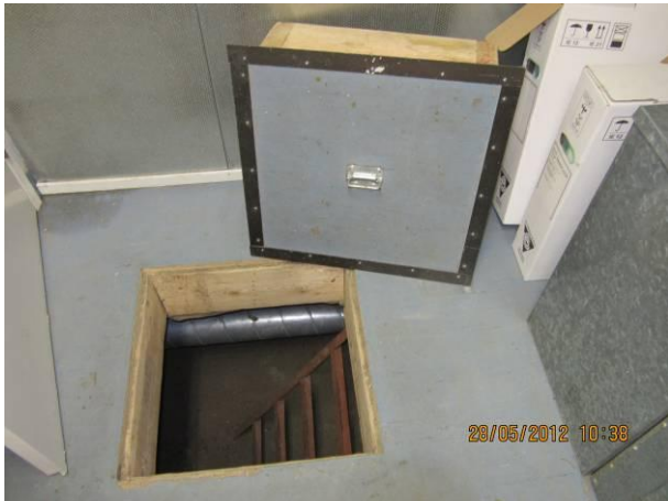
Kuva 11 Luukku teknisessä tilassa 56.
