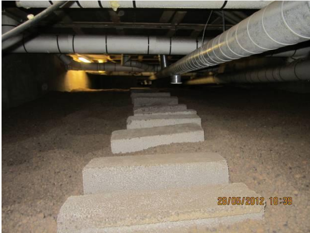
Kuva 7 Poistoilmakanava keskialueella ruok./ neuv. 28 alla.
