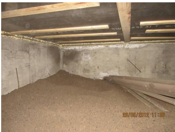
Kuva 15 Kosteutta betonisoskelissa reunalohkon kulmalla teknisen tilan 56 alla.
