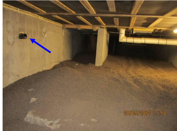
Kuva 8 Tuloilmaputken pää, kalliota ryhmähuo- ne 10 alla.
