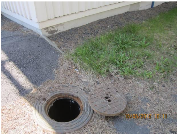
Kuva 1 Teknisen tilan 56 so-kaivo
