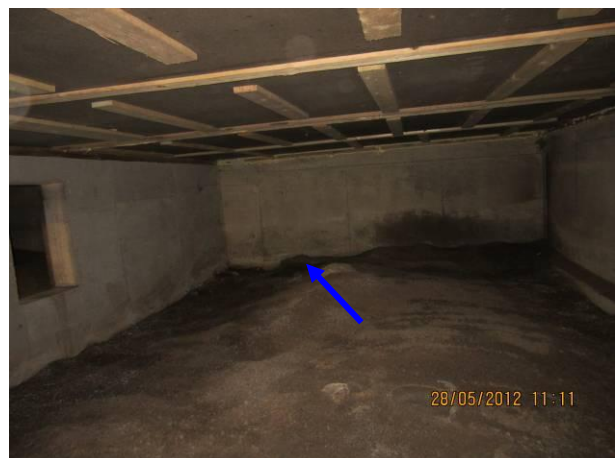
Kuva 16 Kostea soramaata, ohut kevytsorakerros, mikrobikasvua leikkihuone 50 alla, kostea perusmuuri, salaojan korkeus?
