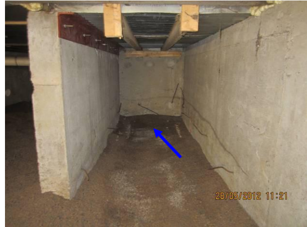
Kuva 18 Kosteusjälkiä TK 34 sisäänkäyntitason alla, sidosteräksiä on jäljellä.
