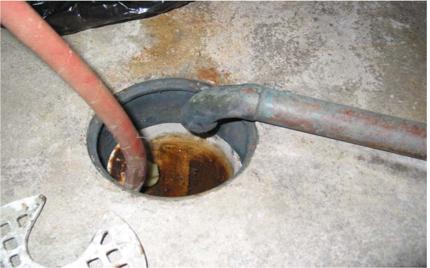
KUVA 5. Tuloilmakoneeseen pääsee viemärihajua kostutusosan viemäroinnin kautta.
