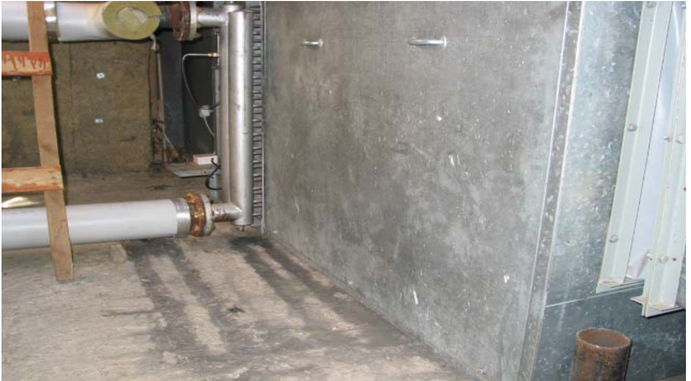
KUVA 1. Tuloilmakoneen luukkujen kiinnitykset ovat heikkokuntoisia.
