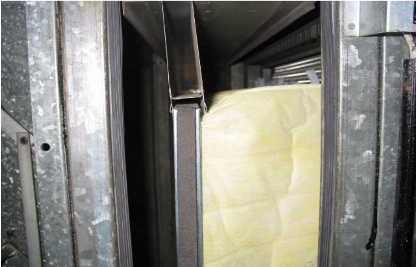
KUVA 3. Tuloilmakoneen suodattimissa tapahtuu ohivirtausta.
