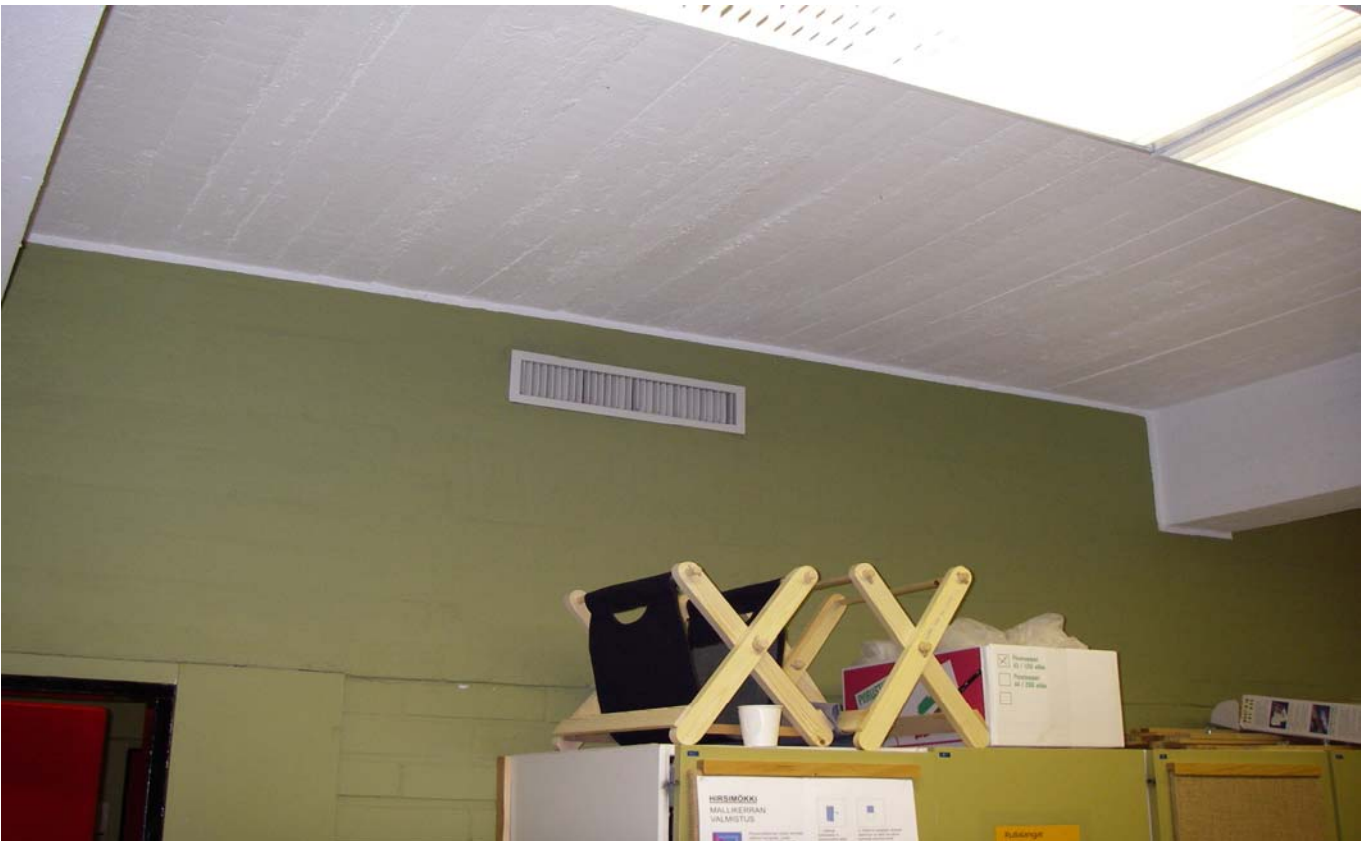
KUVA 6. Luokkatilojen tuloilmasäleiköt ovat ritiläsäleikköjä.
