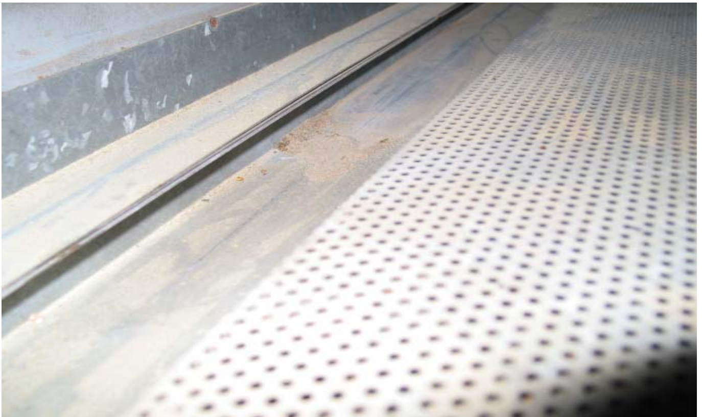
KUVA 4. Tuloilmakoneen kammiossa on hiekkaa ja roskaa.
