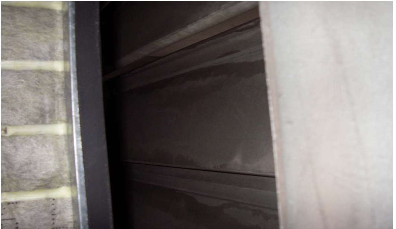
KUVA 2. Tuloilmakoneen sulkupelti ei sulkeudu täysin.
