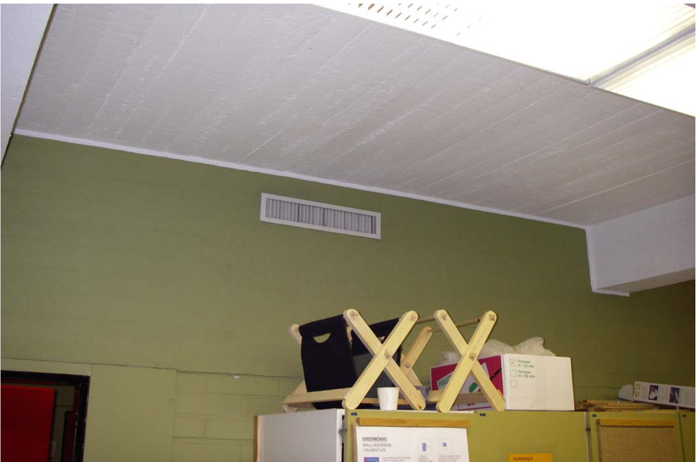
KUVA 4. Luokkatilojen tuloilmasäleiköt ovat ritiläsäleikköjä.
