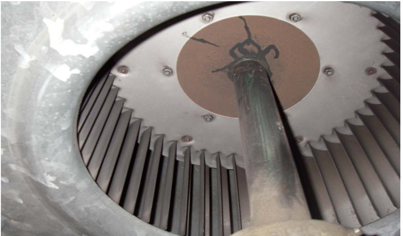
KUVA 2. Puhallin on pölyinen.
