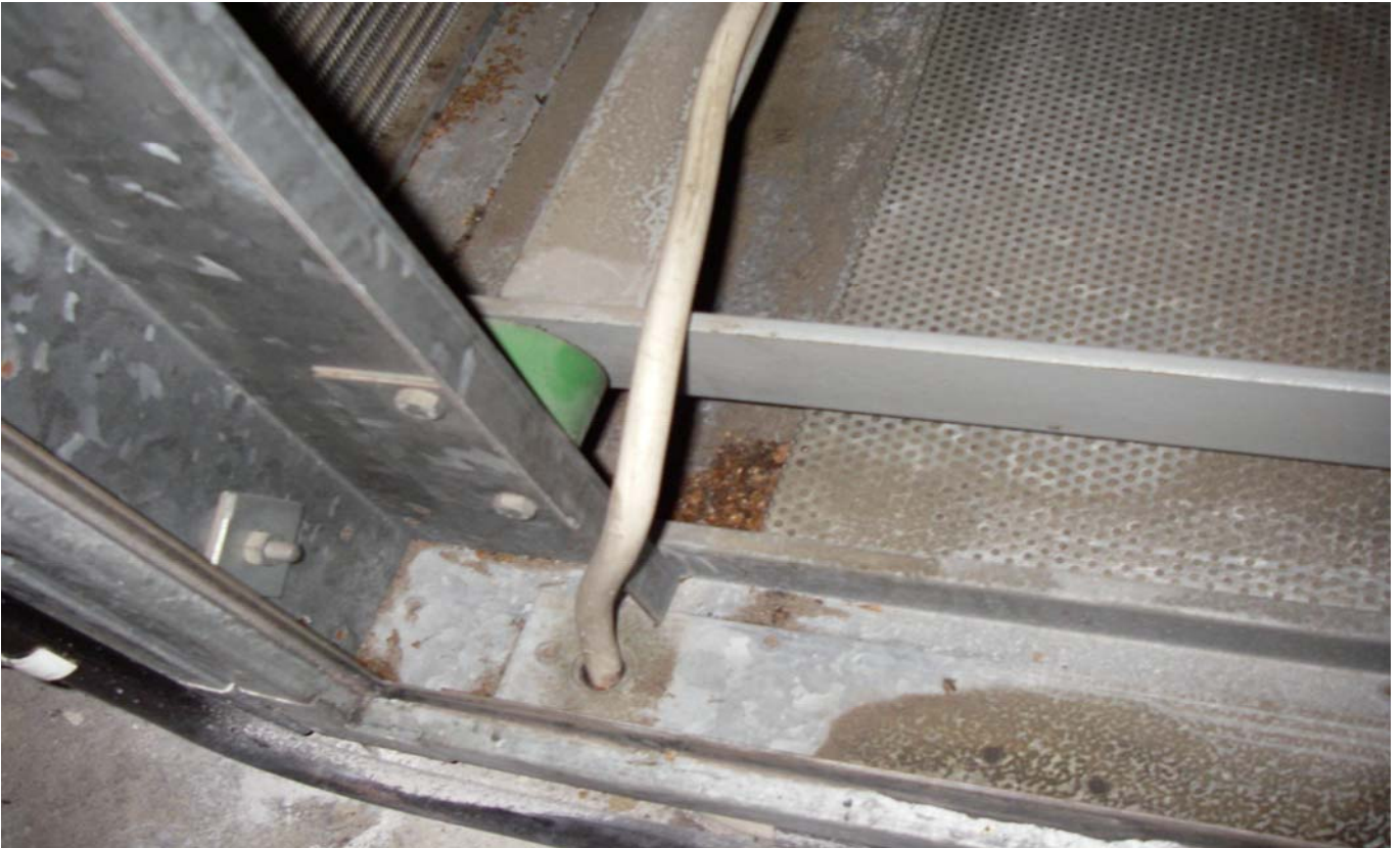
KUVA 3. Tuloilmakoneen kammiossa on roskaa.
