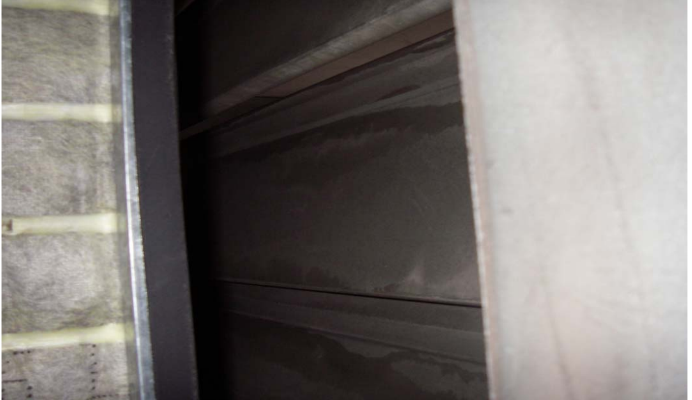
KUVA 1. Tuloilmakoneen sulkupelti ei sulkeudu täysin.
