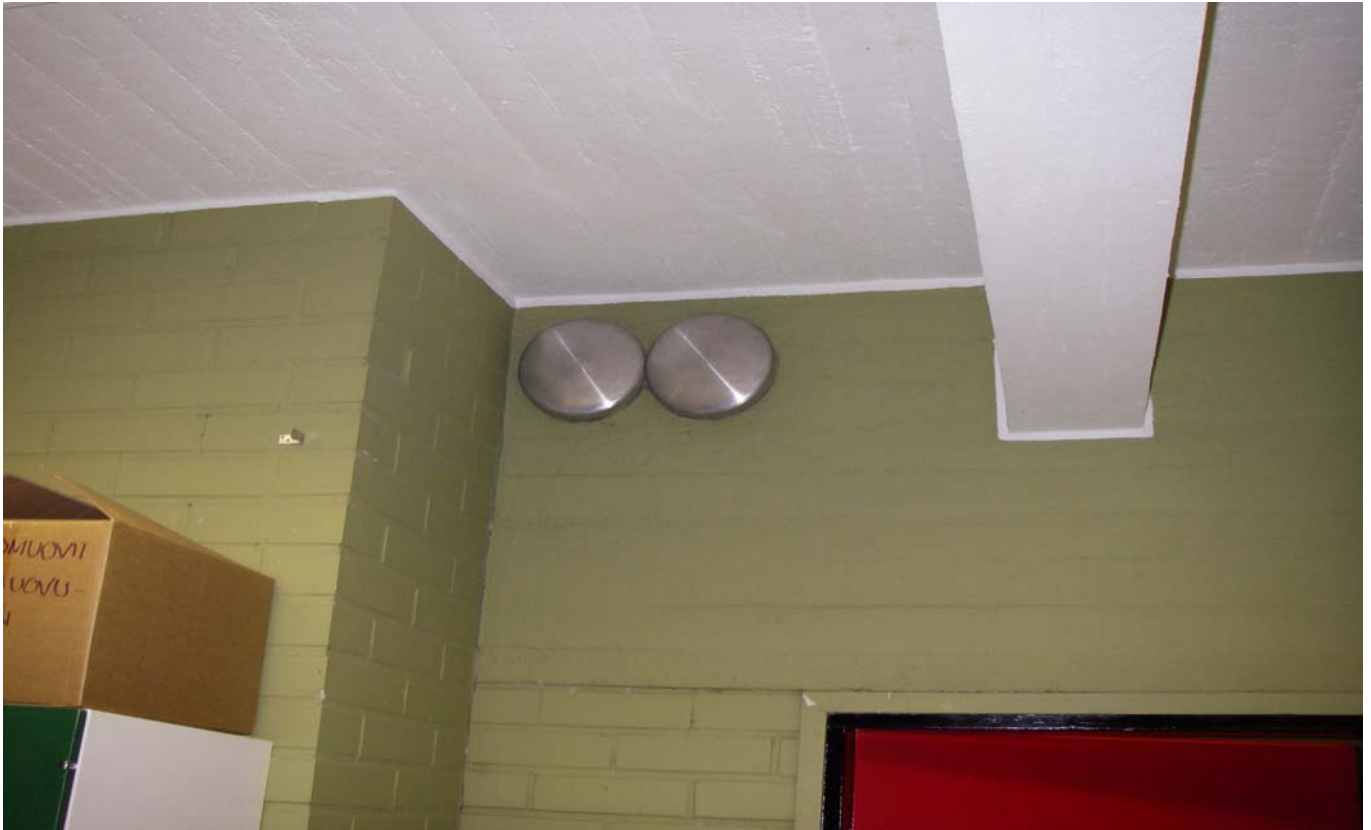
KUVA 5. Poistoilmaventtiilit ovat pääosin alkuperäisiä lautasventtiileitä
