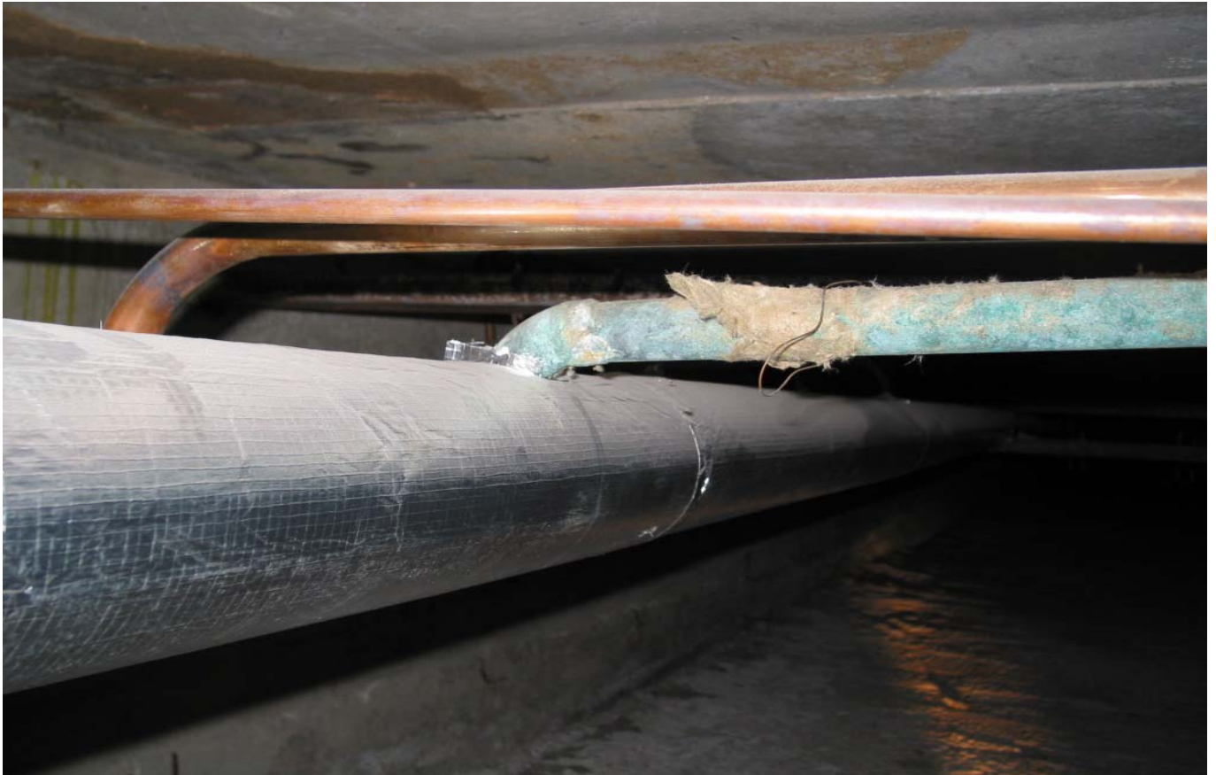
Kuva 9. Eristämättömät putket lämmittävät putkikanaalia.
