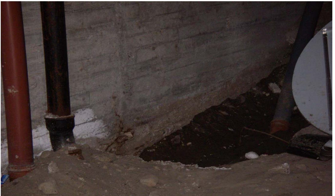
KUVA 8. Putkikanaalissa on kosteaa maata.
