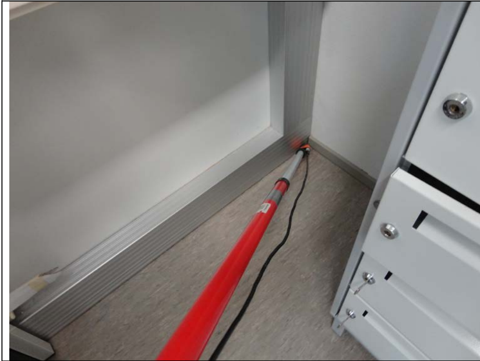
Kuva 9: Vuotokohta alapohjasta tekstiilityöluokassa 137.
