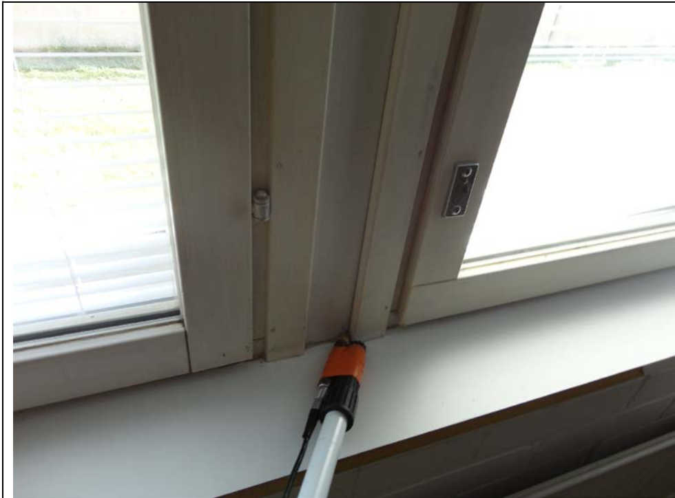
Kuva 5: Pistemäinen vuotokohta ikkunaliittymässä luokassa 124.
