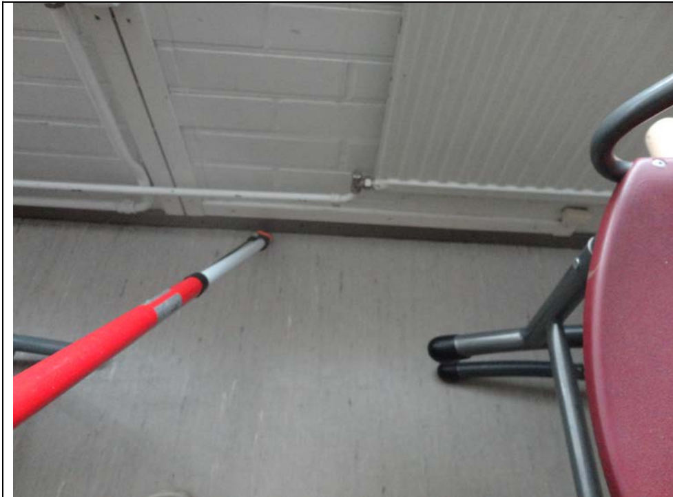
Kuva 1: Luokassa 125 merkkiainetta syötettiin alapohjaan koulun uudella osalla. Luokassa havaittiin laajoja nauhamaisia vuotokohtia alapohjan ja ulkoseinän liitoskohdissa.
