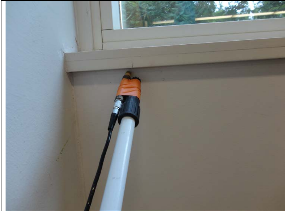
Kuva 11: Vuotokohta ikkunaliittymässä luokassa 141.
