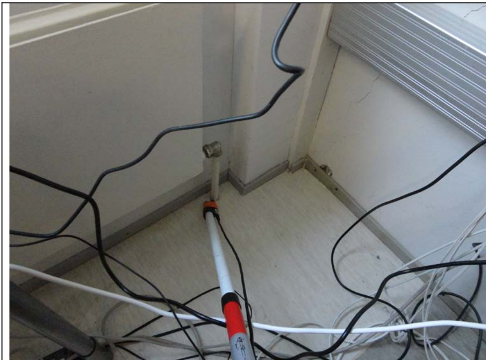
Kuva 12: Vuotokohta patteriläpiviennistä luokassa 141.
