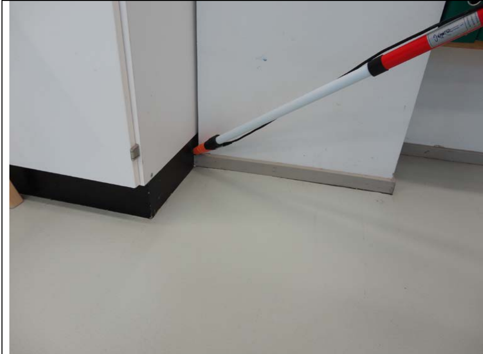
Kuva 8: Vuotokohta koulun vanhalla osalla syötettäessä merkkiainetta alapohjaan (tekstiilityö 137).
