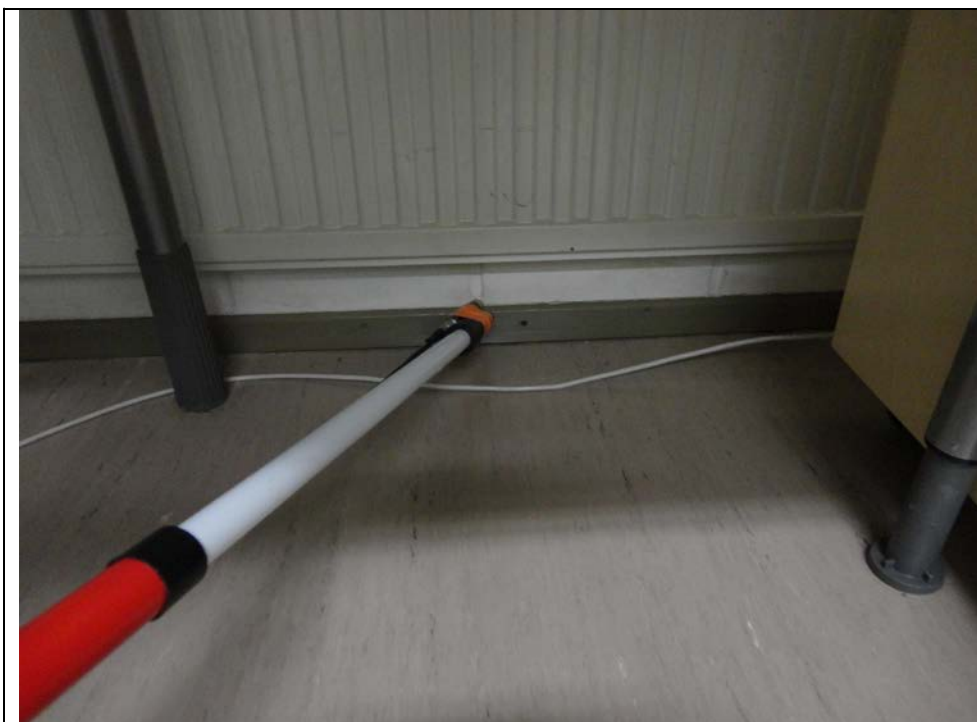
Kuva 2: Merkkiainetta laskettiin ulkoseinärakenteen eristetilaan. tilan 106 (kuraattori) kohdalla. Merkittävä nauhamainen vuoto seinä- ja alapohjarakenteen liitoskohdassa.
