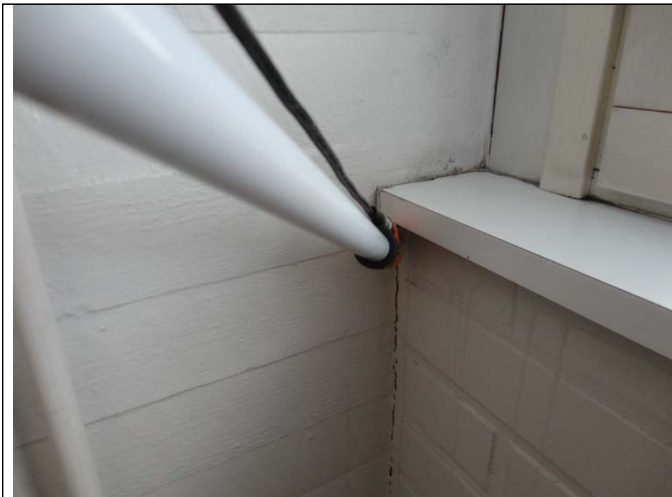
Kuva 6: Vuotokohta ulko- ja väliseinän liitoskohdassa luokassa 124.
