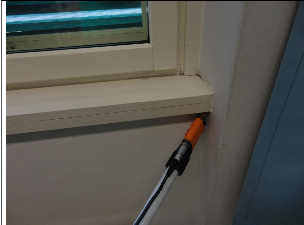
Kuva 13: Vuotokohta ikkunaliittymässä luokassa 143 tilan ollessa alipaineistettuna.
