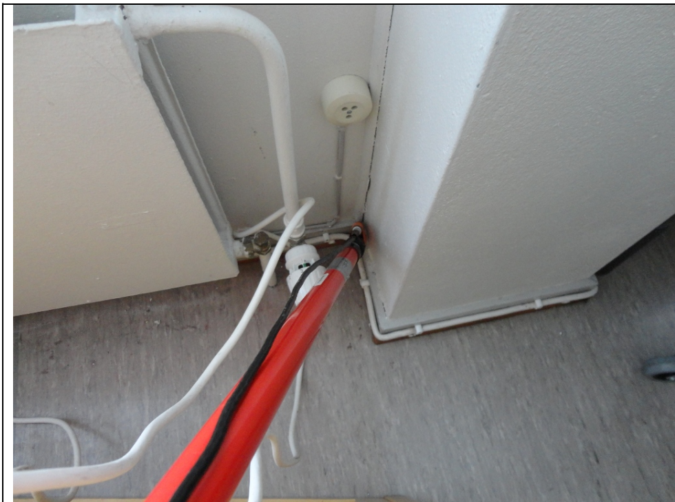
Kuva 14: Vuotokohta pilarin juuressa tilassa 157.
