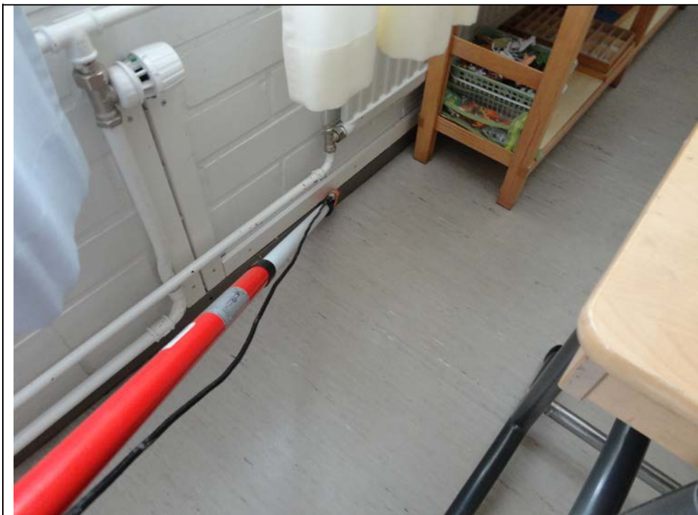
Kuva 4: Merkittävä nauhamainen vuotokohta ulkoseinärakenteesta luokassa 124.
