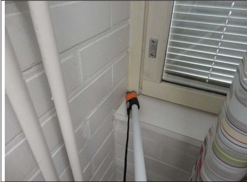
Kuva 3: Pistemäinen vuotokohta ikkunaliitoksesta tilassa 106 (kuraattori).
