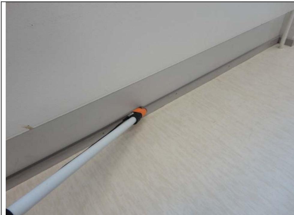
Kuva 10: Vuotokohta ulkoseinärakenteesta luokassa 141.
