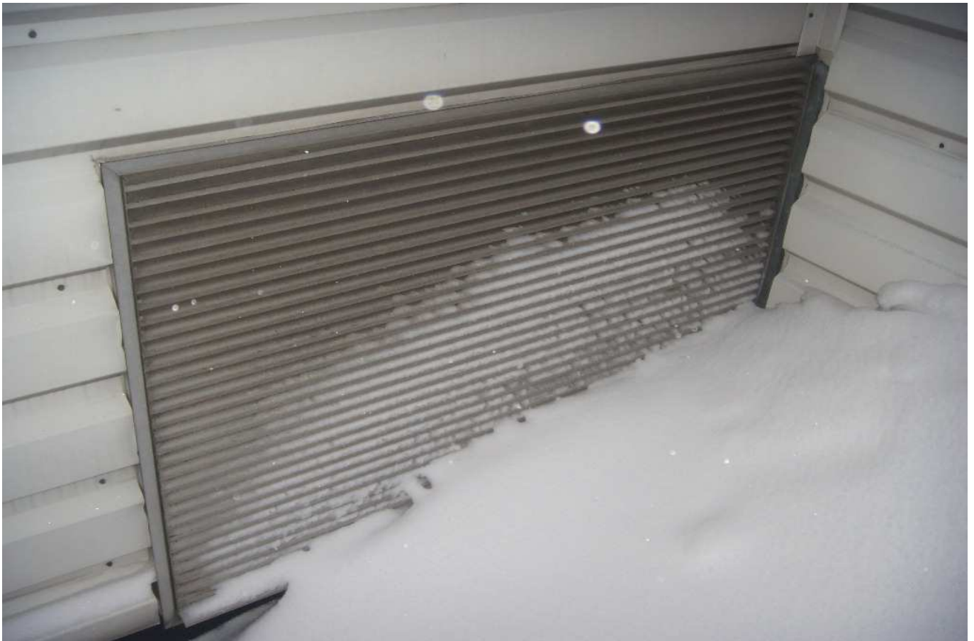
KUVA 16. Yleiskuva tuloilmakoneen raitisilmasäleiköstä.
