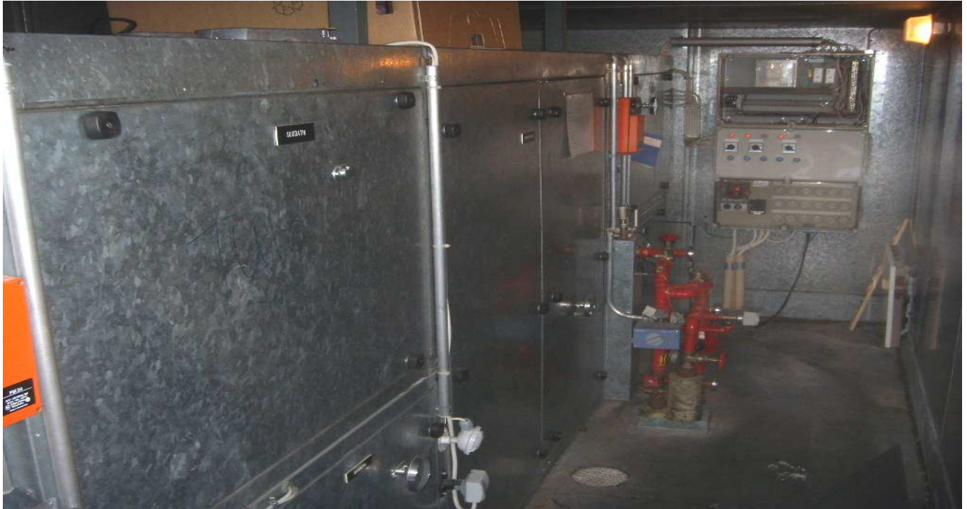
KUVA 1. Yleiskuva IV- konehuoneesta.
