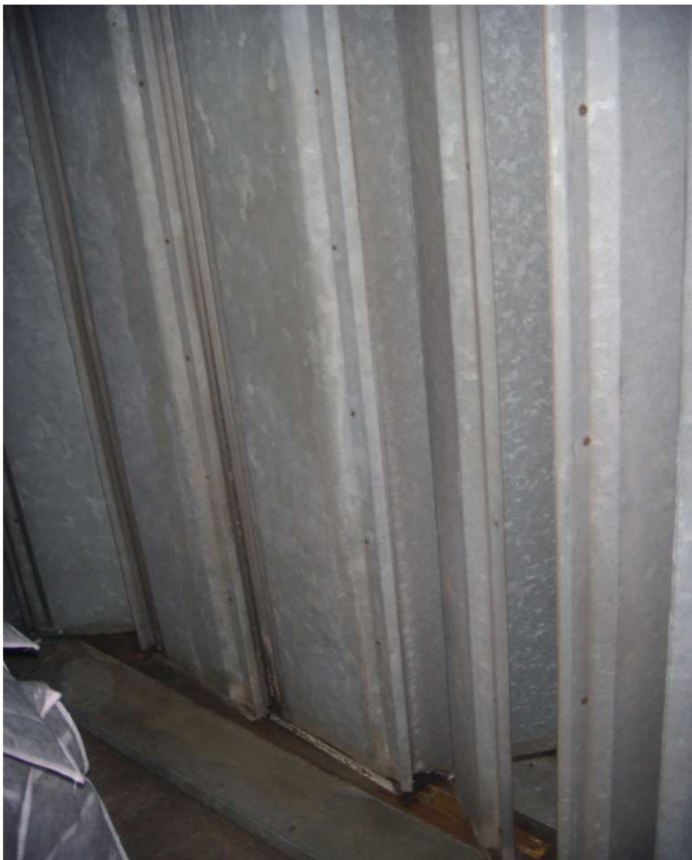
KUVA 7. Tuloilmakoneen sulkupellit eivät sulkeudu kokonaan TIK 2.2.
