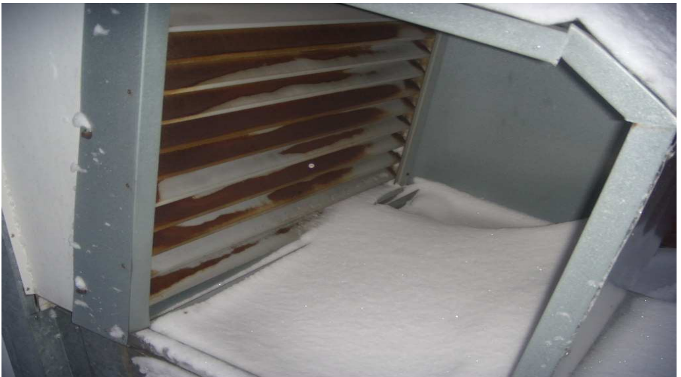
KUVA 17. Yleiskuva tuloilmakoneen raitisilmasäleiköstä.
