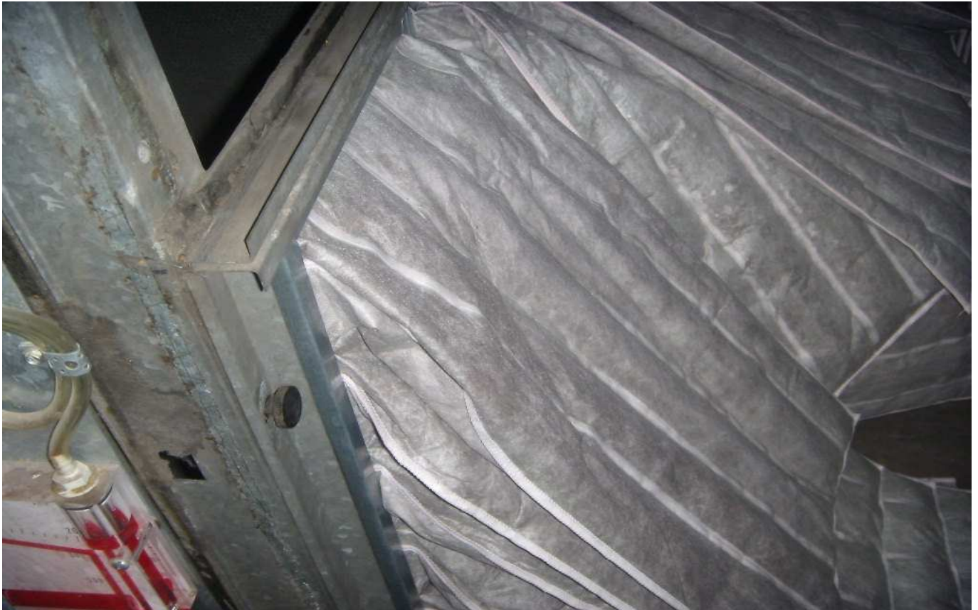
KUVA 5. Yleiskuva tuloilmasuodattimista (TIK 2.2).
