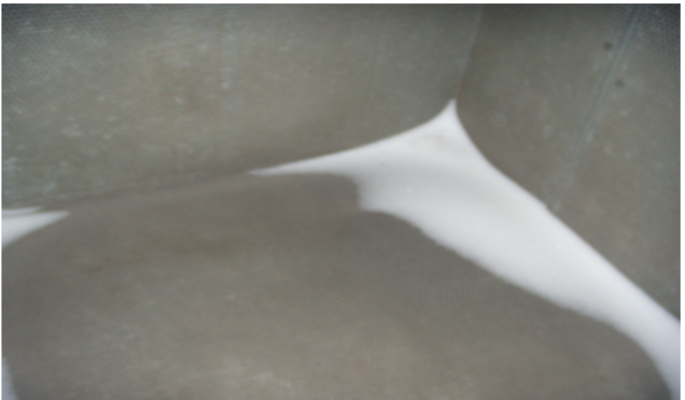
KUVA 6. Yleiskuva tuloilmakoneen raitisilmakammiosta (TIK 2.2).
