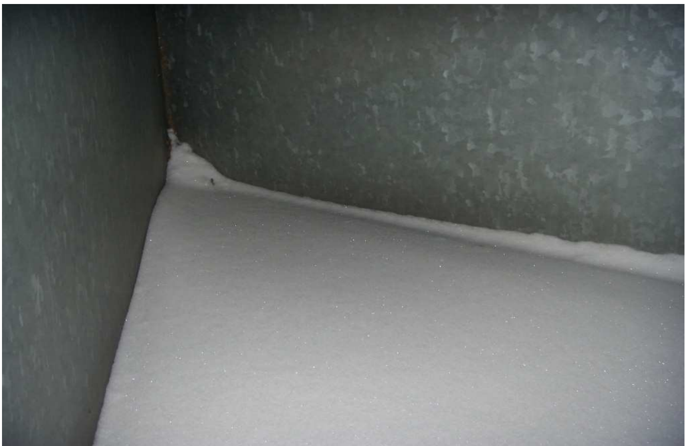
KUVA 2. Yleiskuva tuloilmakoneen raitisilmakammioista.
