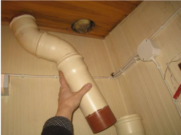
Kuva 19 Wc-rakennuksen tuuletusviemäri päättyi yläpohjan eristetillaa.
