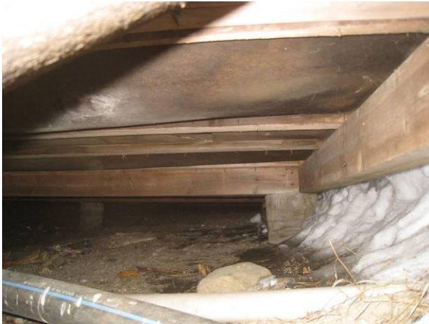
Kuva 13 Wc-rakennuksen alla AV3 bituliitti-levyt ovat mikrobivaur. ja notkolla.
