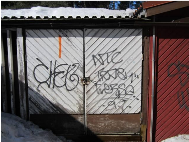
Kuva 33 Huonokuntoinen pystyritilä ja pariovi terassille.
