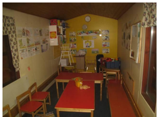
Kuva 12 Näkymä lämmittelytilaan. Peräseinän yläosassa on IV-venttiili, jonka kanava oli tukittu vaatteella.
