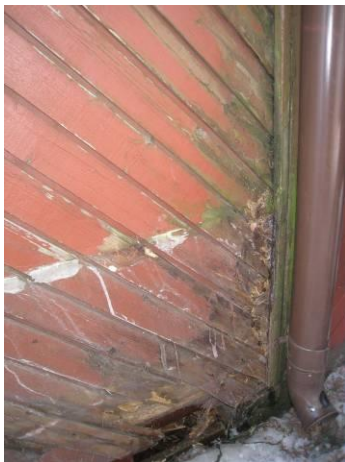
Kuva 17 Poistetun suojavannerin alla (AV2) terassin laho suoja-aita on kiinni wc-rakennuksen seinässä.
