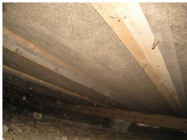
Kuva 24 Varastorakennuksen alapohja, bituliitti-levyissä on hieman mikrobikasvustoa.
