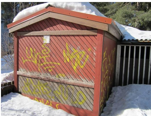
Kuva 23 Varastorakennuksen itäpään puurakenteet ovat lähellä maanpintaa.
