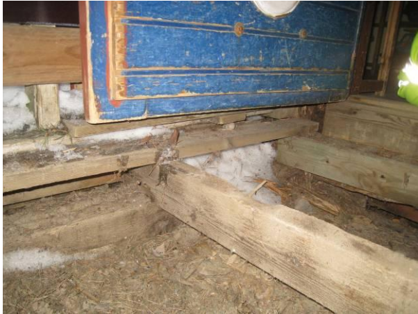
Kuva 37 Avauskohdalla AV8 maata vasten olevat runkorakenteet ovat jo lahoja.
