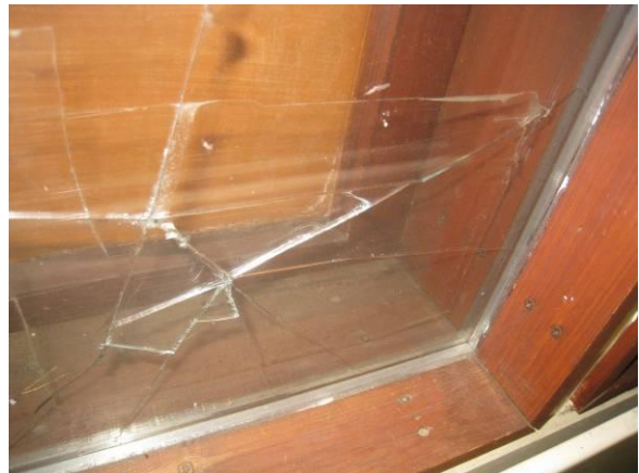
Kuva 6 Lämmittelytilan umpiolasi-ikkunan lasi oli rikki.
