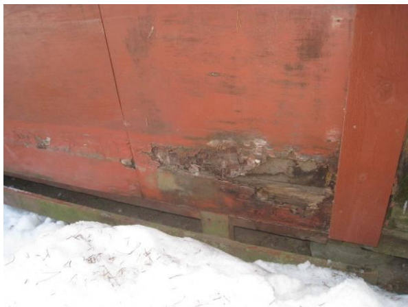
Kuva 3 Päädyistä poistettiin suojavaneri (AV1), jonka alla todettiin vaurioita.
