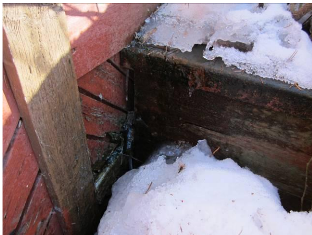
Kuva 29 Eteläsivulla oleva istutuslaatikko on aiheuttanut seinän lahoamisen.
