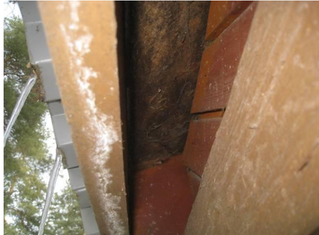
Kuva 10 Räystään pituus on vain 15 cm. Yläpohjan bituliittelyssä on mikrobikasvua.
