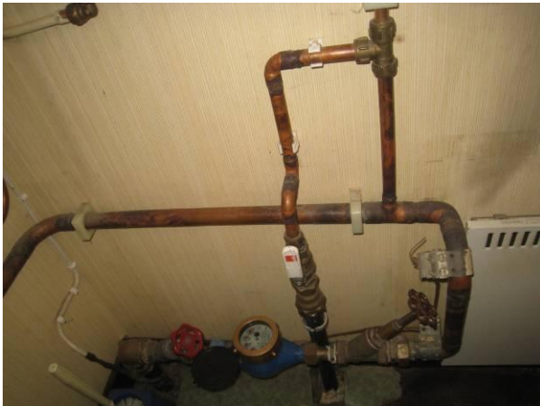
Kuva 43 Wc-tilassa on kaksi putkinousua ja vesimittari.
