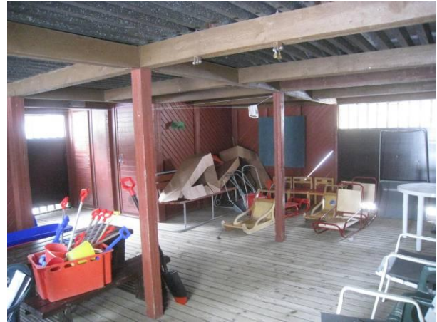
Kuva 38 Yleiskuva terassille. Palkkien ja lattian väli on alle 195 cm.
