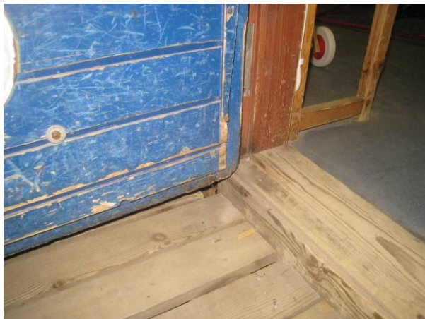
Kuva 27 Kulunut ovi ja kynnyks.
