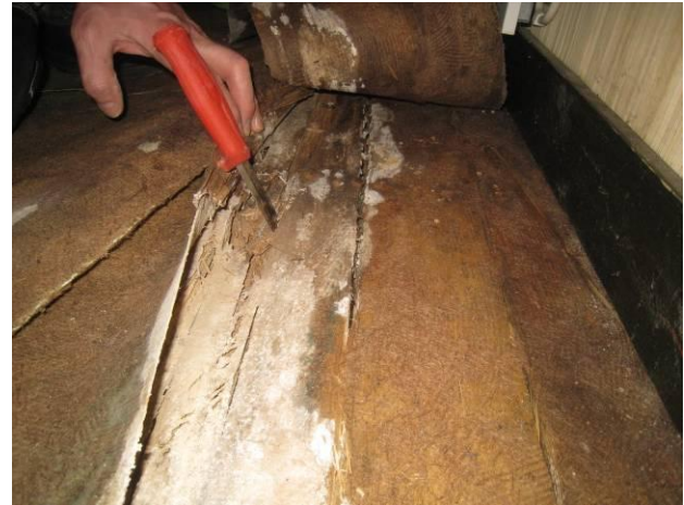
Kuva 16 Wc-tilan mikrobi- ja lahovaurioista lattia-laudoitusta rakenneavauskohta AV4.
