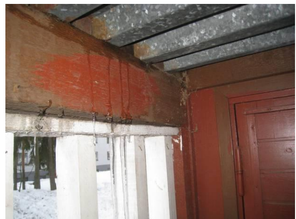
Kuva 42 Terssin vesikaton reunalta uittaa vettä tukirakenteiden päälle ja on jo lahoa.
