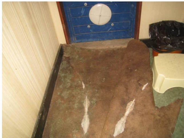
Kuva 22 Wc-tilan mikrobivaurioituneet juuttihuopapohjaiset muovimatot, joita oli 2 kpl päällekkäin
