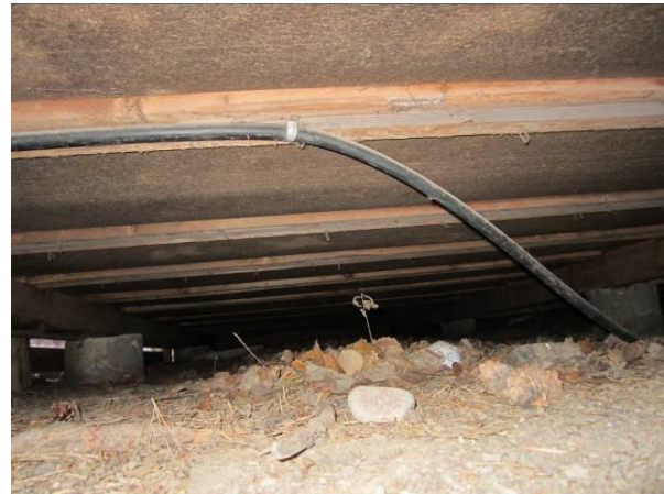
Kuva 2 Lämmittely-ohjaaja -rakennuksen alapohja, levyissä on mikrobikasvua. Alla on myös sähkön syöttökaapeli.
