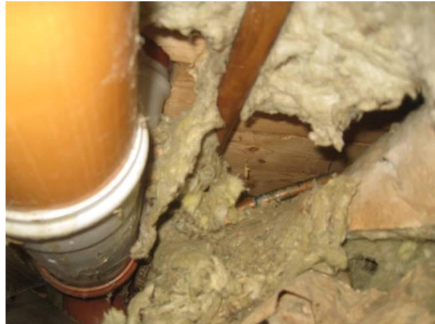
Kuva 14 Alapohjan eristelevyt (AV3) olivat osin irronneet ja putket eristämättä.
