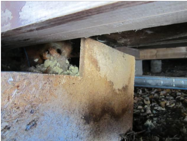
Kuva 15 Wc-tilojen vesijohto ja viemäri nousevat itäpäädyistä maan alta kotelossa
