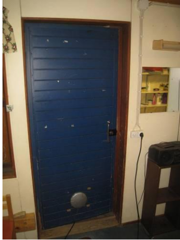
Kuva 7 Ulko-ovi sisäpuolelta on kulunut, alareunassa on venttiili.
