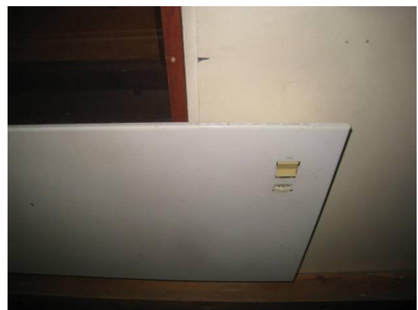
Kuva 48 Alkuperäinen Siemens sähköpatteri, tehoa on 1000 W. Näitä on 14 m 2 lämmittelytilassa 2 kpl.
