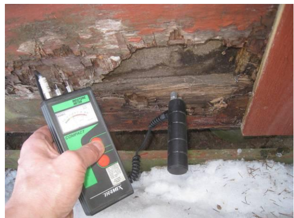
Kuva 4 AV1 -kohdalla puu on lahonnut ja oli selvästi kostea n. 18 paino -%.
