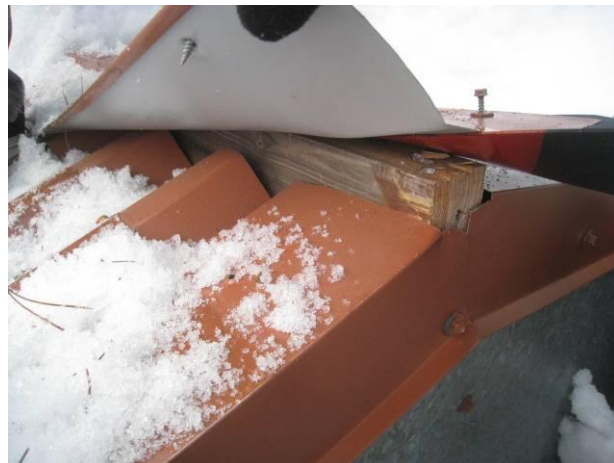
Kuva 18 Wc-rakennuksen harjalla ei ollut tuuletusviemärin läpivienttiä, ks. kuva 19.
