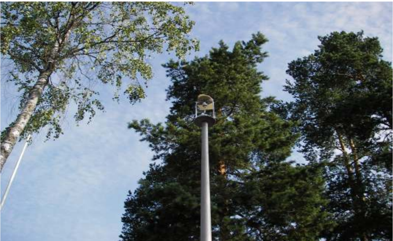
S-KUVA 2. Rikkinäinen pylväsvalaisin.
