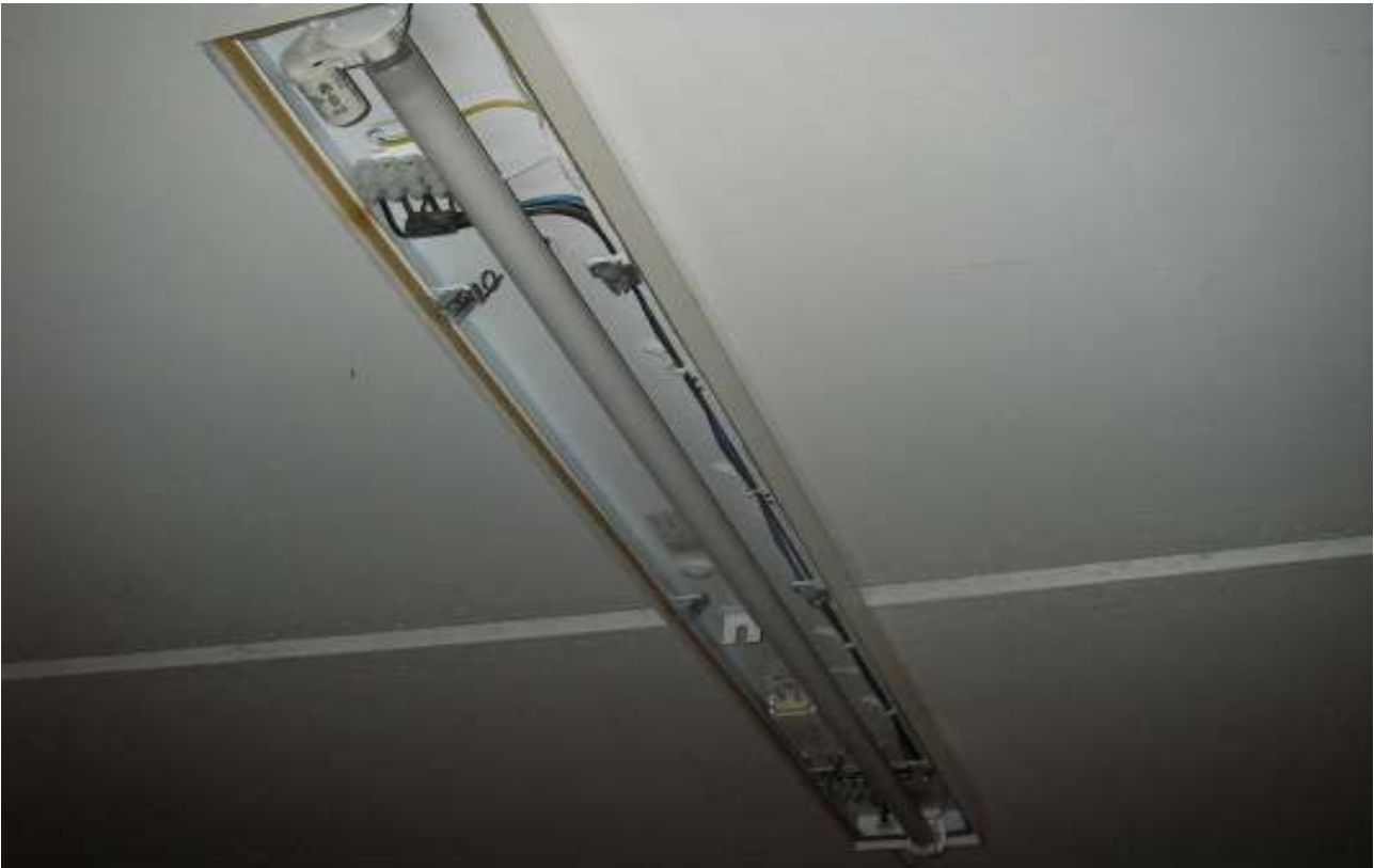
S-KUVA 3. Rikkinäinen kellarin valaisin.
