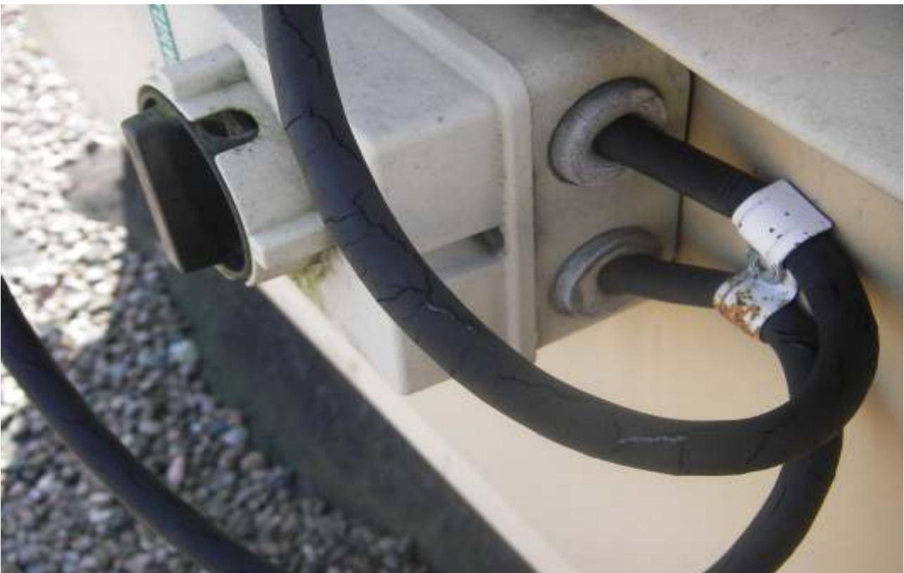
S-KUVA 4. Huonokuntoinen huippuimurin liitosjohto.
