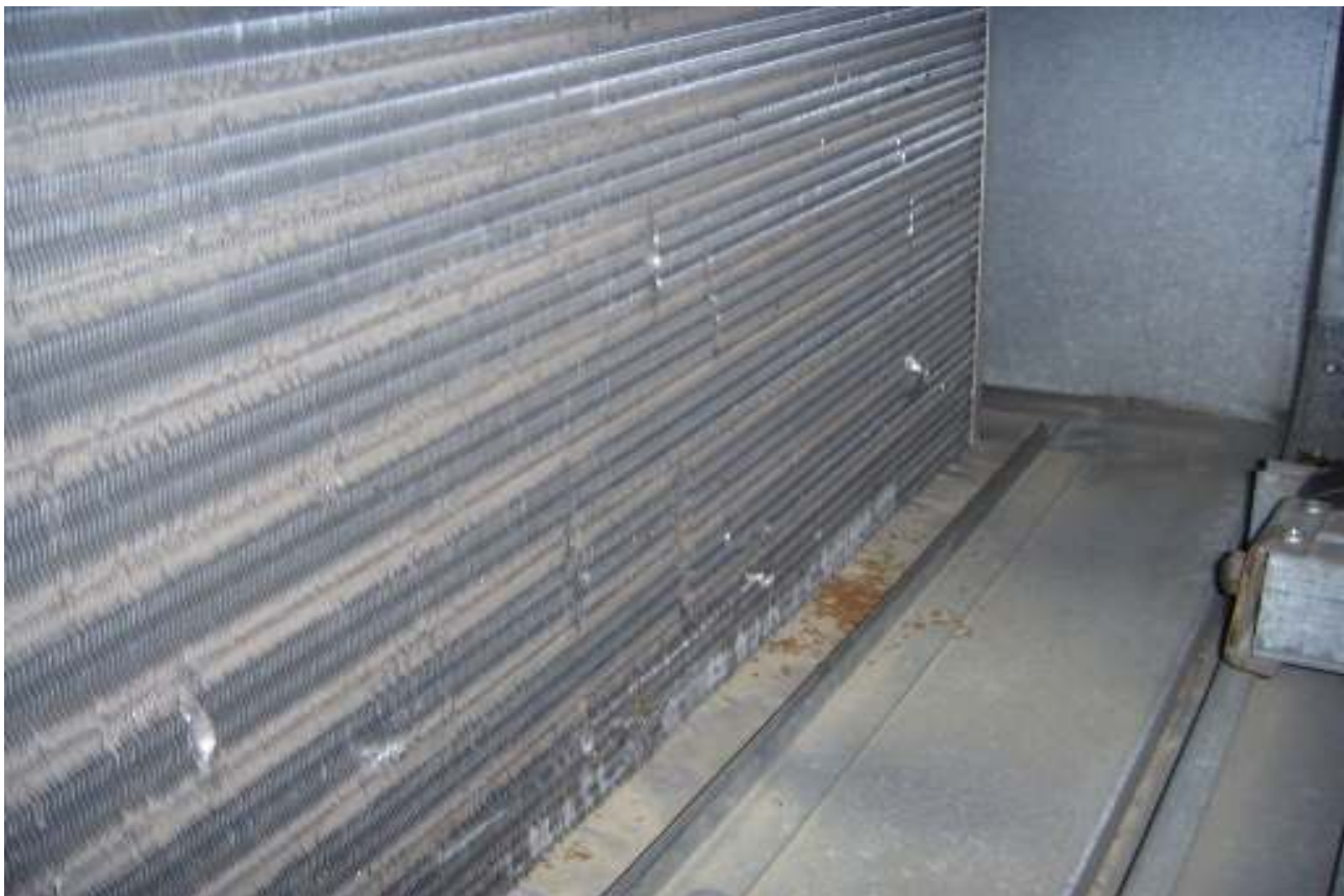
LVI-KUVA 8. Tuloilmakoneiden lämmityspatterit ovat pölyisiä.
