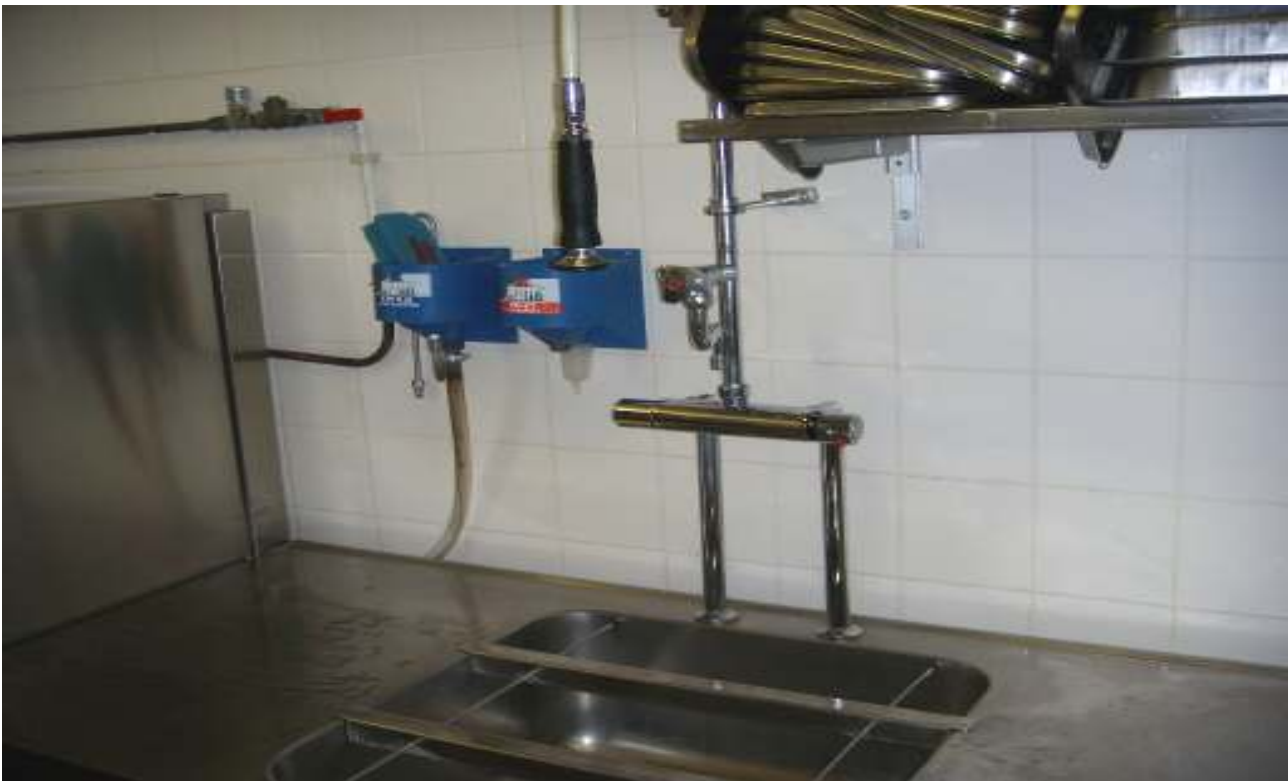
LVI-KUVA 4. Yleiskuva keittiön vesikalusteista.
