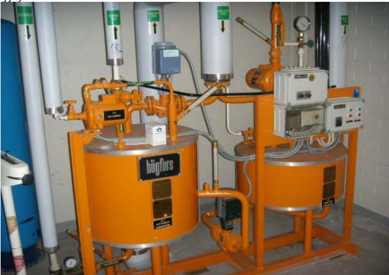
LVI-KUVA 1. Kaukolämmön alajakokeskus on alkuperäinen.
