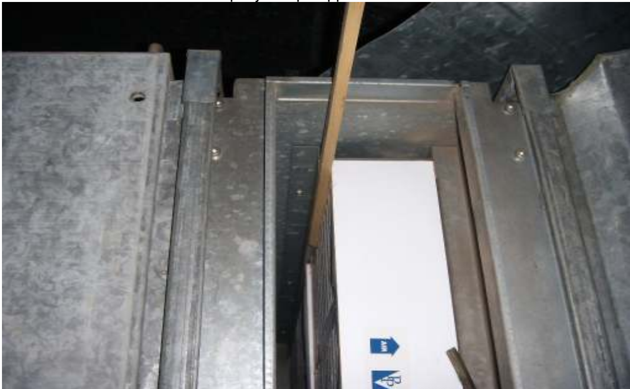
LVI-KUVA 7. Tuloilmakoneiden suodattimet tiivistetään puulistalla, joka irtoaa koneen käytössä.
