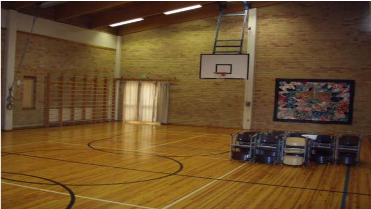
R-KUVA 9: Liikuntasali on muiden kiinteistön tilojen mukaisesti pintarakenteiden osalta tyydyttävässä kunnossa.
