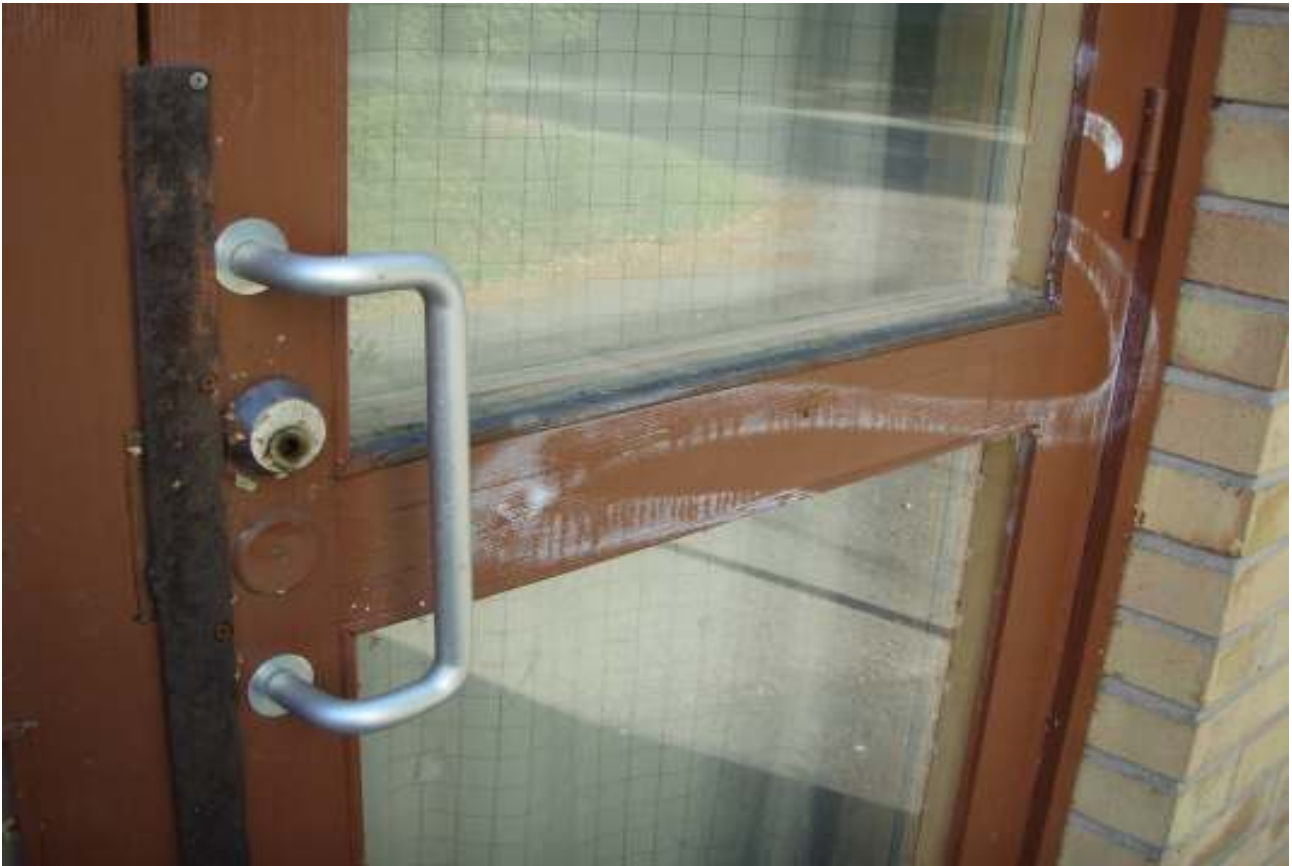
R-KUVA 3. Liikuntasaliin johtavien puuvien kunnostus esim. ikkunarakenteiden kunnostustöiden yhteydessä.
