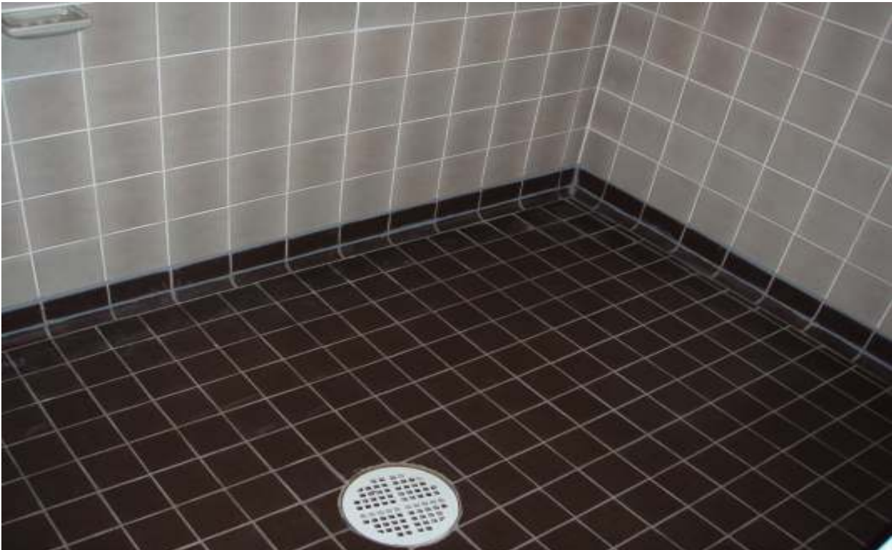
R-KUVA 7: Kiinteistön sosiaali- ja märkätilat ovat yleisilmeeltään siistejä mutta niiden tekninen käyttöikä alkaa olla lopussa ja siten niihin arvioitiin kohdistuvan kunnostustoimenpiteitä seuraavan 10-vuoden tarkastelujakson aikana.
