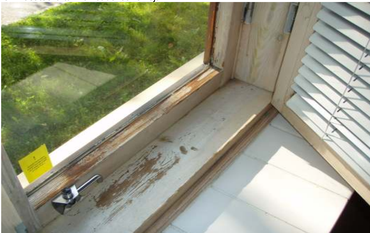
R-KUVA 2. Ikkunarakenteet arvioitiin edellyttävän huoltokäsittelyä (myös väli- ja sisäpuitteet / -karmit).
