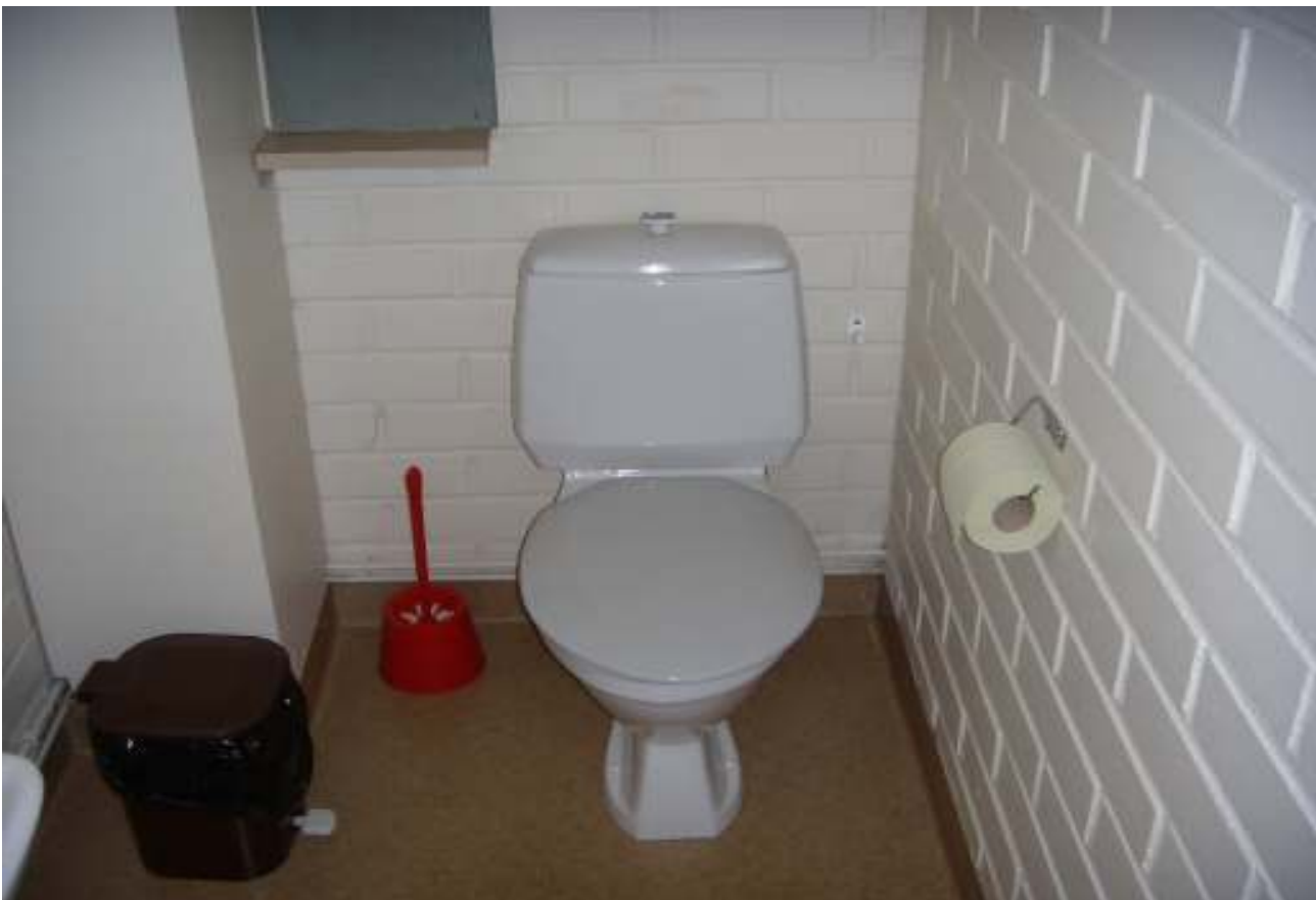
LVI-KUVA 5. Yleiskuva vanhoista WC- istuimista.
