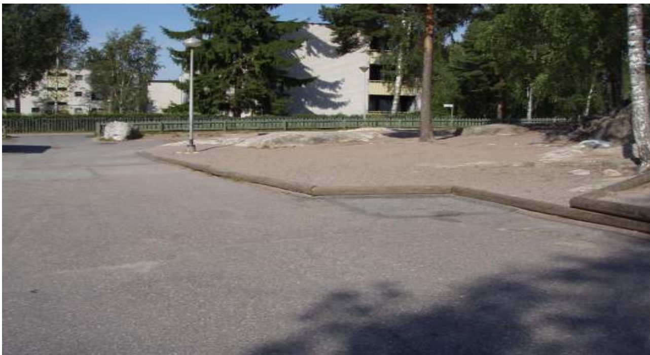
R-KUVA 1. Asfaltoidulle piha-alueelle valuu hiekkapintaiselta ulkoilualueelta hiekkaa mm. rankkasateella tukkien sadevesikaivoja.
