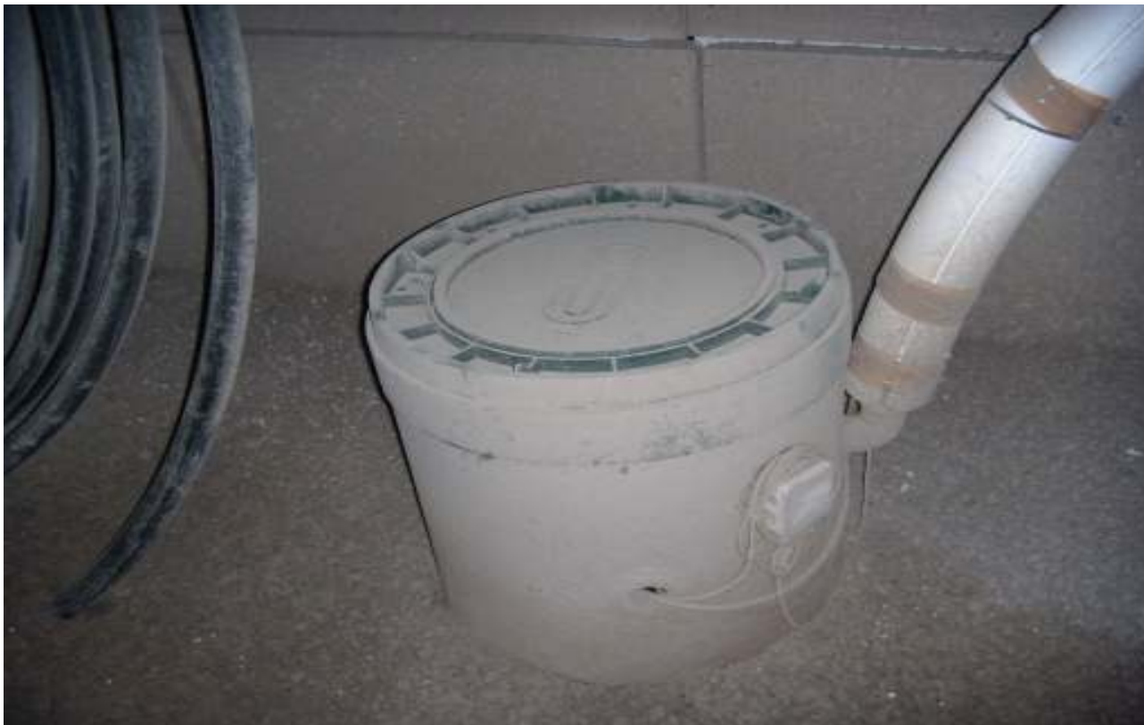
LVI-KUVA 6. Yleiskuva alustilan pohjavesipumppaamosta.
