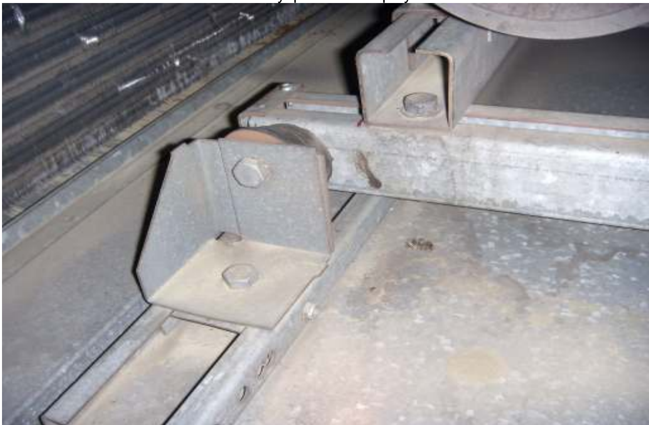
LVI-KUVA 9. Puhaltimien kumityynyt ovat osin huonossa kunnossa.
