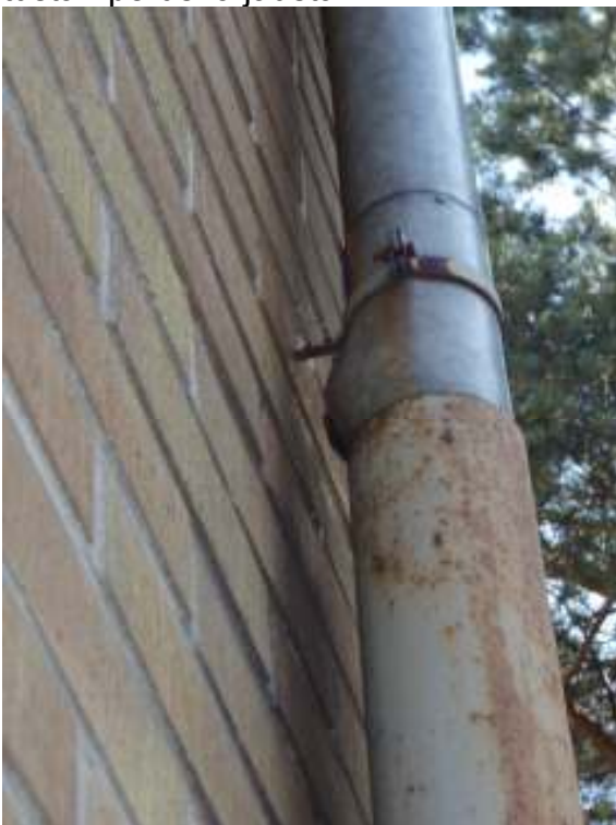
R-KUVA 6: Syöksytorvet tulee kunnostaa, asentaa saattolämmityskaapelointi sekä jatkaa niitä alapäästä suoraan sadevesijärjestelmään.
