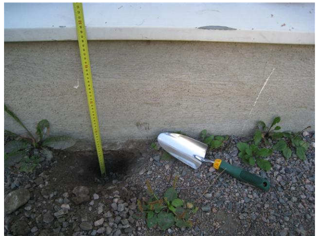
Kuva 16 Koekaivukohdassa koillispäädystä on slammauksesta alaspäin kevytsoraharkkomuurausta, ei ole kosteussuojaa.
