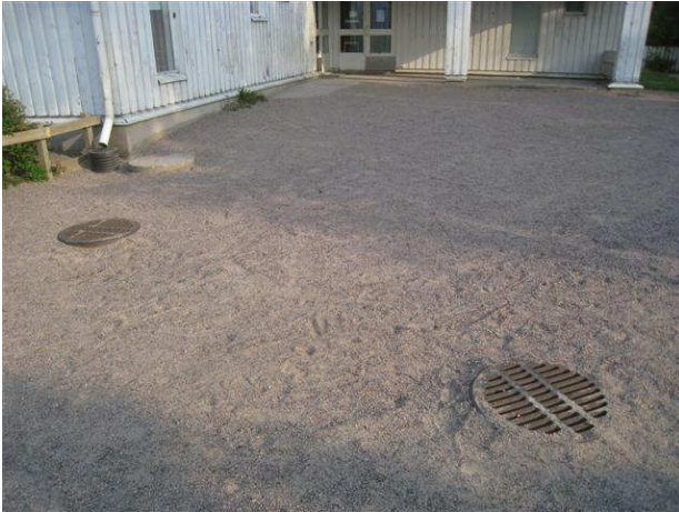
Kuva 7 Leikkipihan sadevesikaivoja, joihin pääsee hiekkaa.
