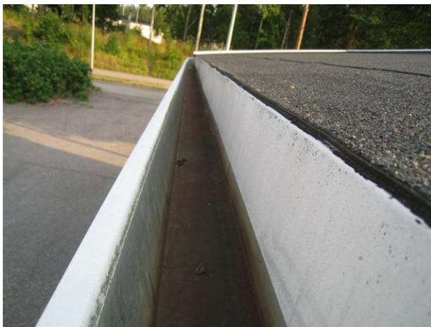
Kuva 29 Räystäskourujen pohja on ruosteessa, räystäältä on am. ohjauspelti ränniin.
