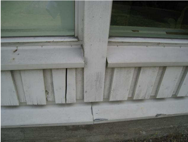
Kuva 19 Kulunutta maalipintaa, lauta halki – vettä voi päästä sisään.
