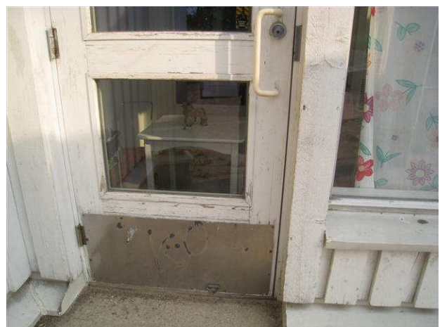
Kuva 24 Ulko-ovien maalipinnat ovat kuluneet.
