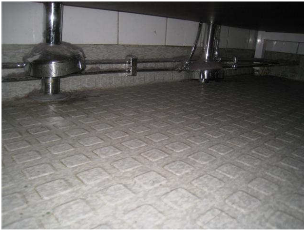
Kuva 49 Lavuaarien kaappien alla on pölyä mm. putkien kohdalla.
