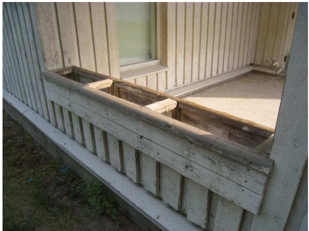
Kuva 22 Sisäänkäyntikatoksen kulunut istutuslaatikko.
