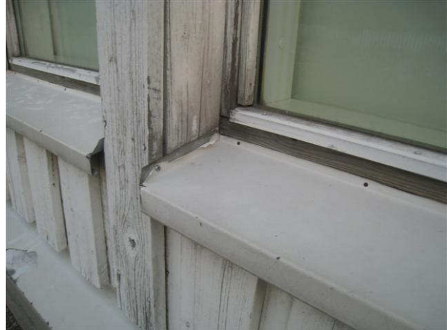
Kuva 20 Ikkunoiden ulkopinnat ja niiden pieli-laudat ovat pinnoiltaan kuluneet.
