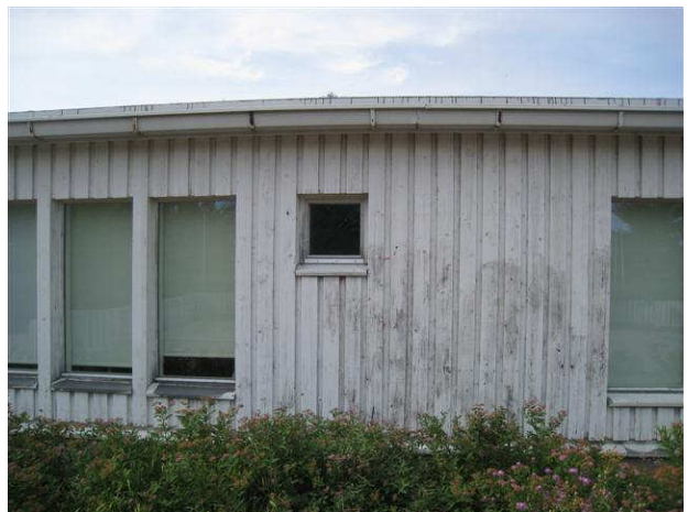
Kuva 18 Epäsiisti seinä graffitipoiston jäljiltä.
