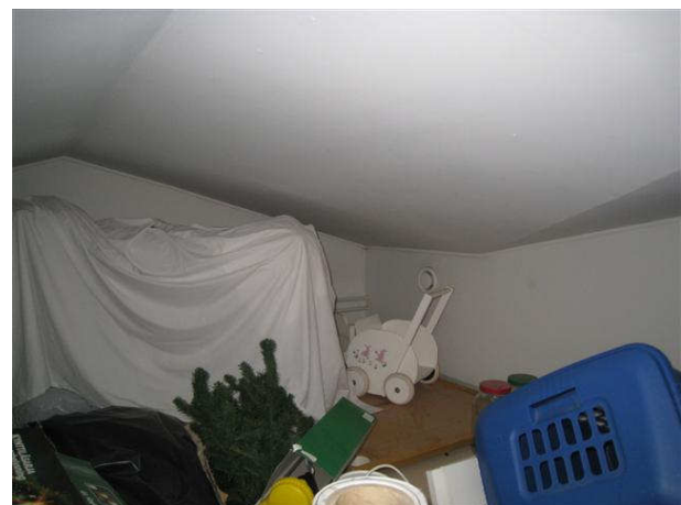
Kuva 54 Toimiston yläpuolisella parvella on ilmanpoistoventtiili, lisäksi on kalusteita yms. roinaa.
