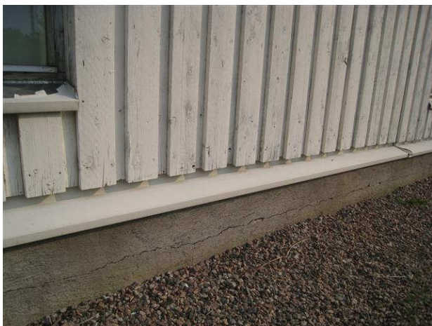
Kuva 17 Sokkelin vaakahalkeama saumassa sokkelihalkaisun kohdalla.
