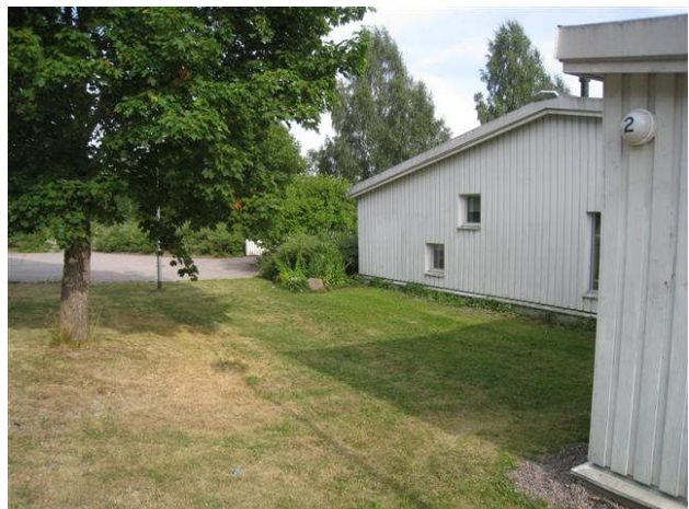
Kuva 12 Luoteissivun kulunut nurmi, sadevesikaivoa ei ole.
