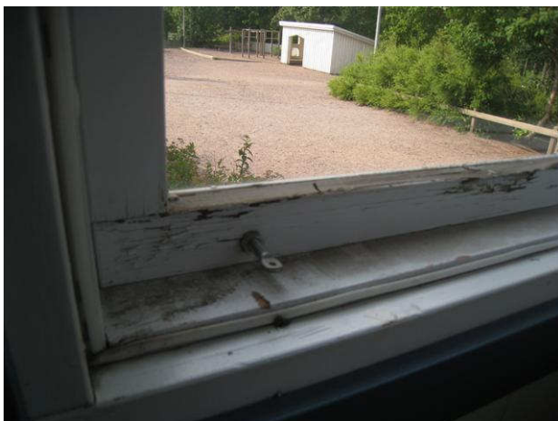
Kuva 23 Ikkunat ovat paikoin kuluneet myös sisäpintojen osalta.
