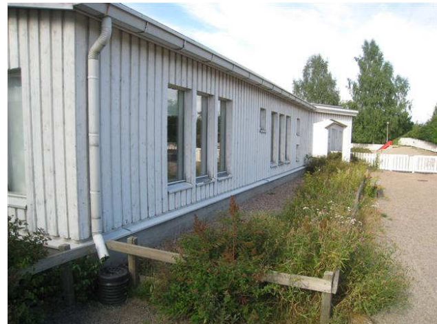
Kuva 4 Kaakkoissivun istutukset seinän vieressä ovat huonokuntoiset.
