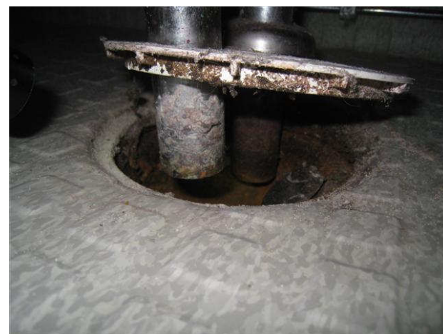
Kuva 42 Pesutila 36 lattiakaivo on hyvin likainen, hajut voivat johtua tästä.
