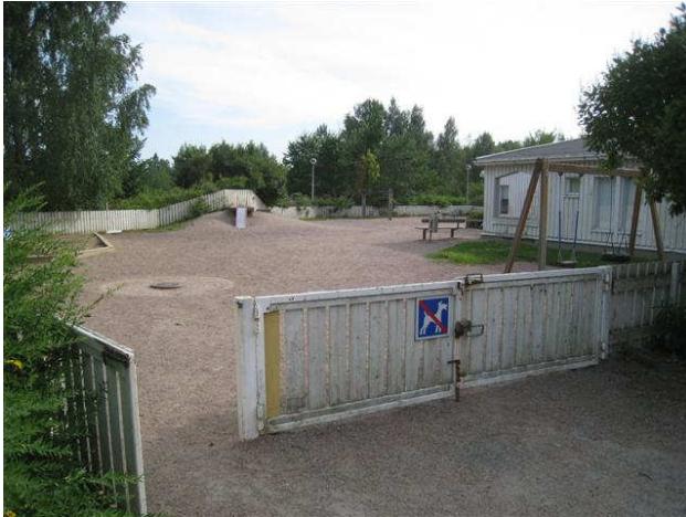
Kuva 1 Leikkipihan aidat ja portit ovat matalia, maalipinnat ovat kuluneet.
