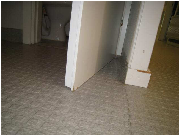
Kuva 51 Tämä väliovi panttaa käytävän lattiaan.
