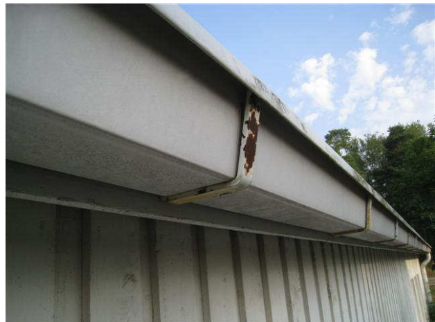
Kuva 30 Rännien kannatinterästen pinta on ruosteessa.
