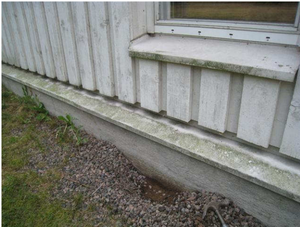
Kuva 15 Koekaivukohdassa luoteissivulla sokkelinvierustan sepelin alla on kostea hiekkaa, ei havaittu perusmuurin kosteussuojaa.
