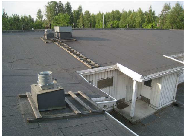
Kuva 26 Kulkusillat ovat puuta ja kuluneet.
