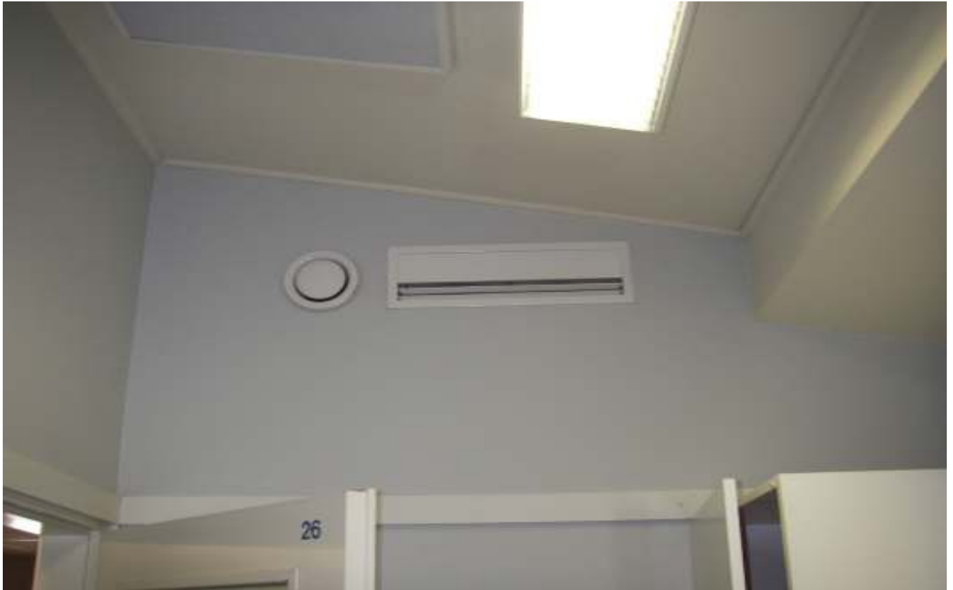
KUVA 19. Tulo- ja poistoilmaelimet ovat osin melko lähekkäin.
