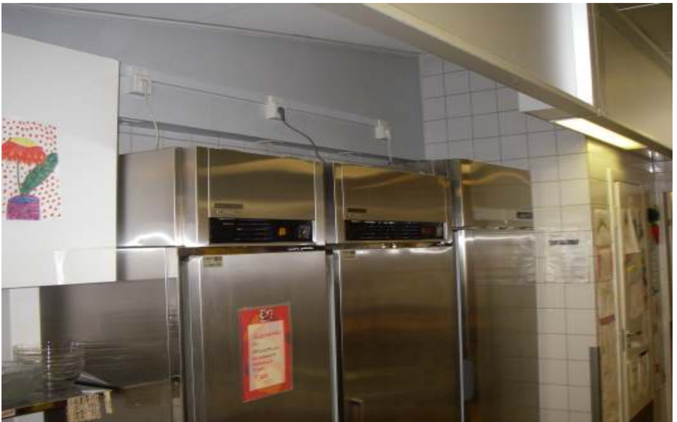
KUVA 22. Yleiskuva keittiön kylmiöistä.
