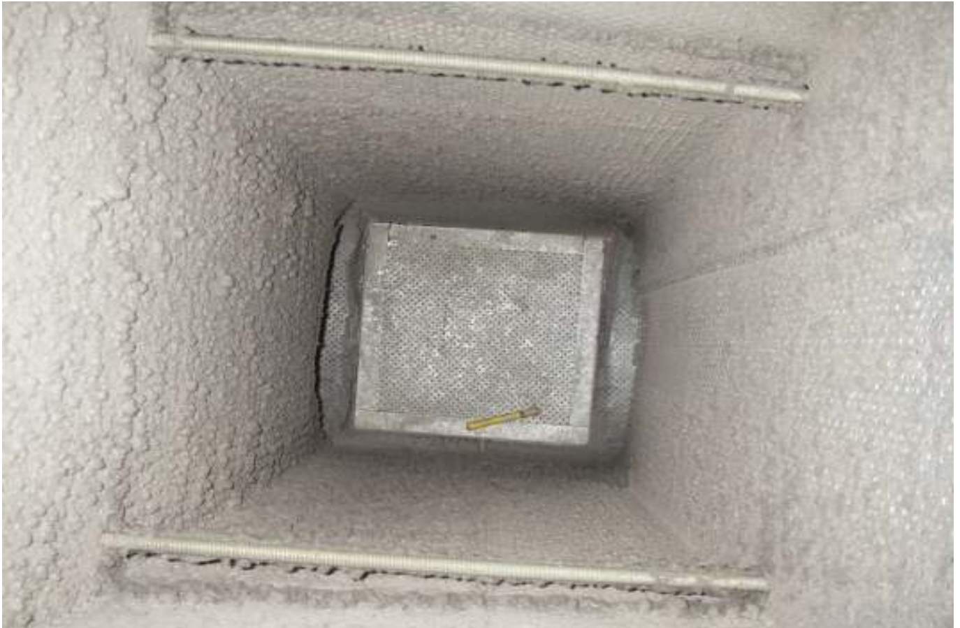
KUVA 15. Yleiskuva keittiön poistokanavasta.
