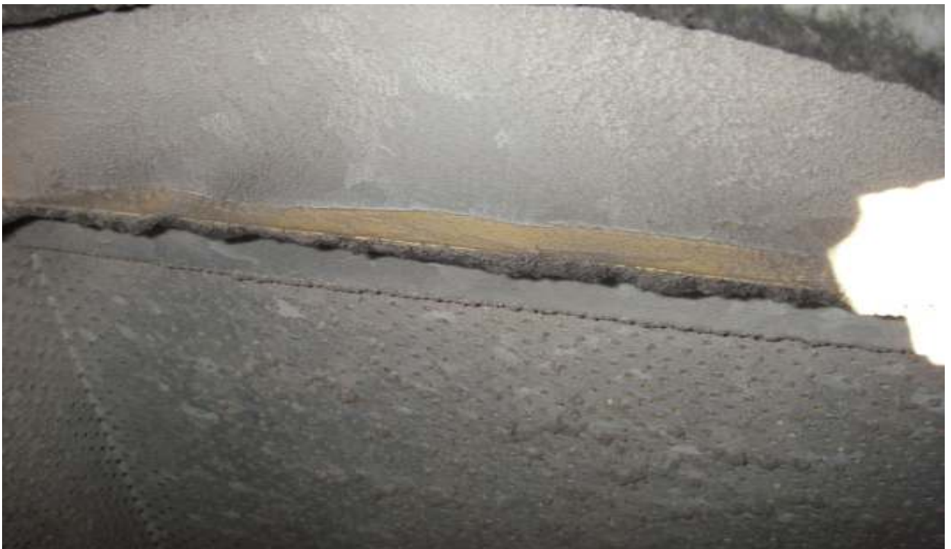
KUVA 16. Yleiskuva keittiön poistokanavasta.
