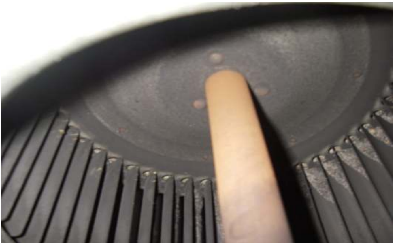
KUVA 4. Tuloilmapuhallin on pölyinen ja nokinen.
