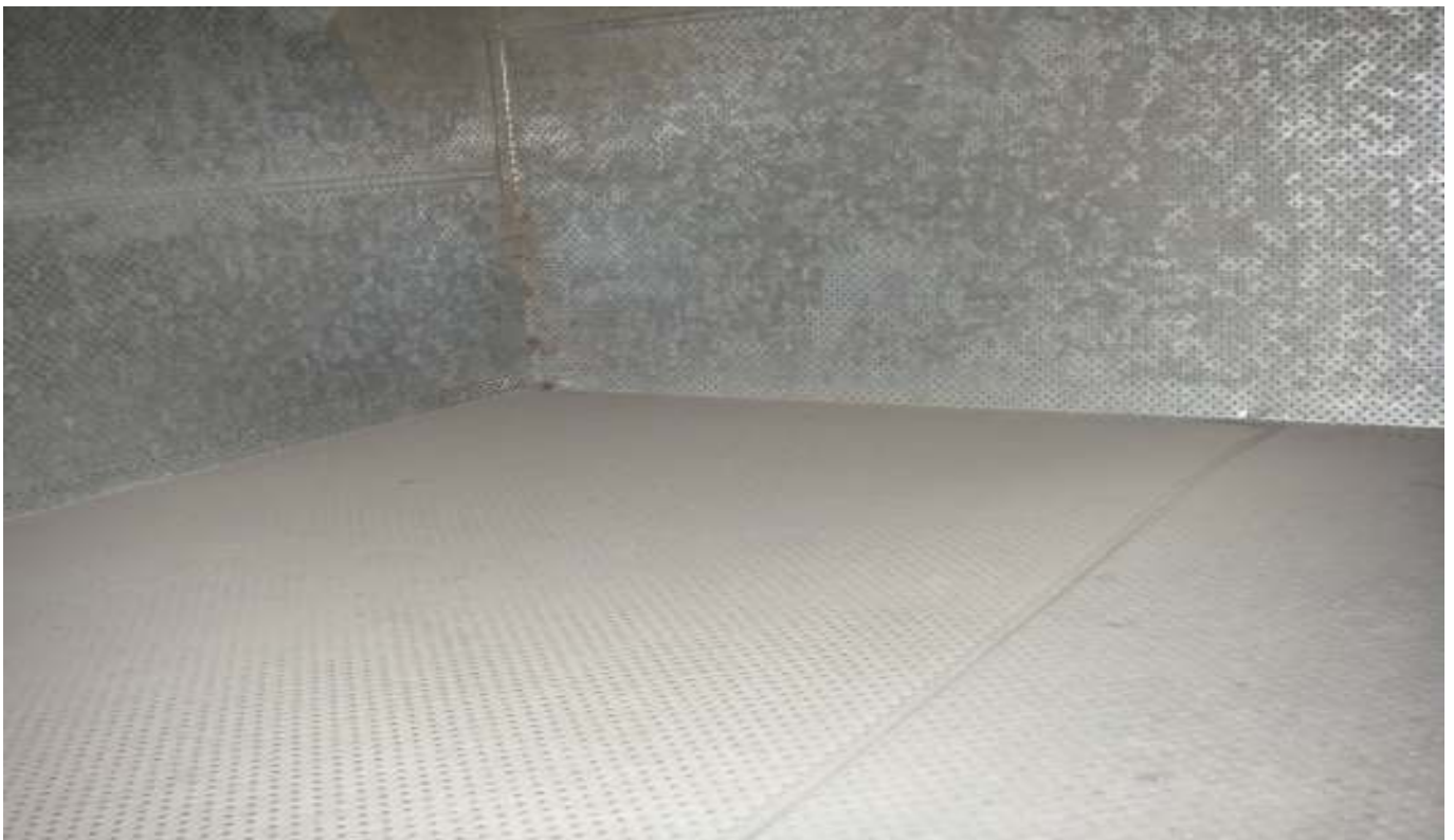
KUVA 8. Tuloilmakoneen kammiot on eristetty mineraalivillalla, joka on päällystetty reikäpellillä.
