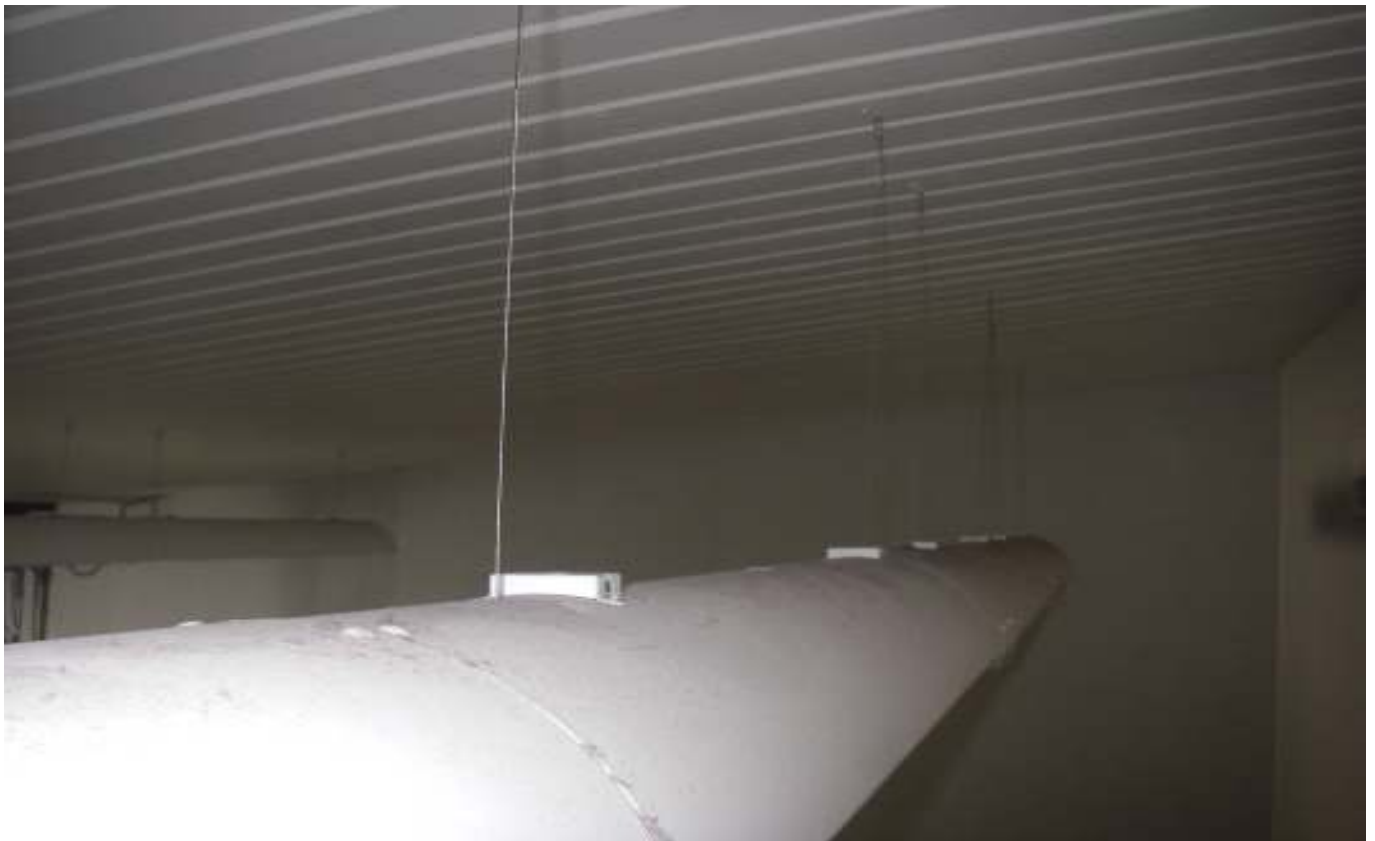
KUVA 20. Lamppujen päällä on pölykertymää.
