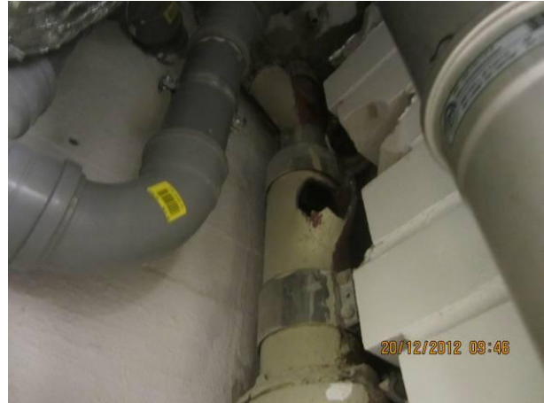
Kuva 40 Kellarin IV-konehuoneen nurkassa oleva rikkiäinen vanha valurautaviemäri.
