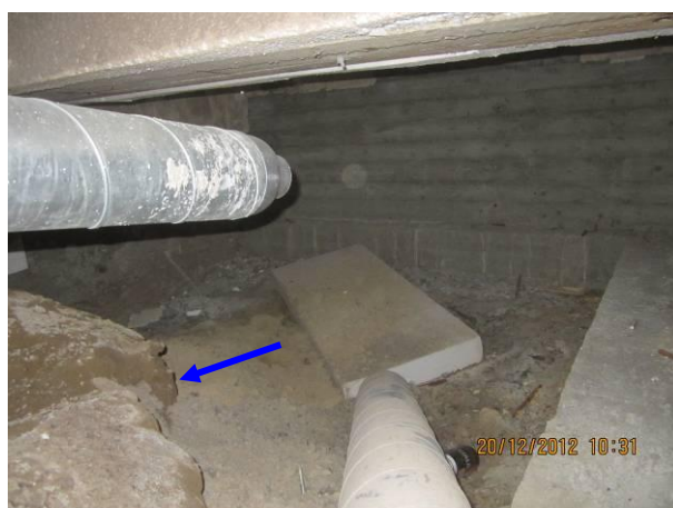
Kuva 7 Puhallus kotikeittiön alla ulkoseinän vierellä olevaan korkeaan alustaonteloon. Kostealta vaikuttavaa hiekkaa penkereessä, on selvää mikrobihajua. Perusmuurin vierellä ei ole sepeliä.
