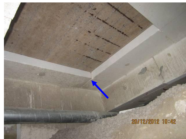
Kuva 26 Ap-eristelevy on irronnut, ruosteisia rakenneteräksiä valupinnassa v. 2008 C-laajennusosan rajalla.
