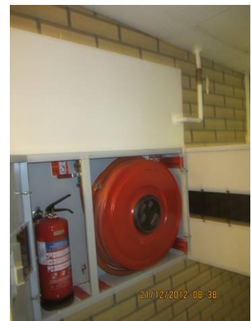
Kuva 34 Pikapalopostin kohdalta havaittiin paha hajua, joka todennäköisesti tulee ulkoseinän kautta.
