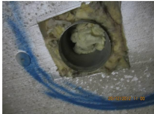
Kuva 24 Käytöstä poistetun IV-poiston pää on tiivistämättä.
