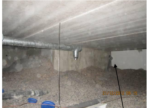
Kuva 30 V. 2000 käytävän luiskan alle ei ole pääsyä, nurkassa on viemärläpivienti, joka nousee terveydenhoito huoneeseen.
