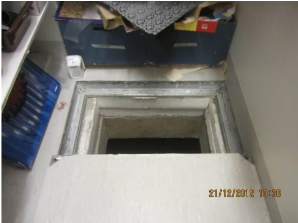
Kuva 35 A-osan painava kulkuluukku on tiivis.
