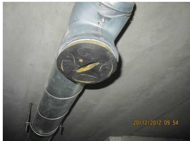
Kuva 12 Laajennuksen 2008 B-laajennuksen tulokanavan venttiili on solumuovinen säätöosa, josta virtasi ilmaa.
