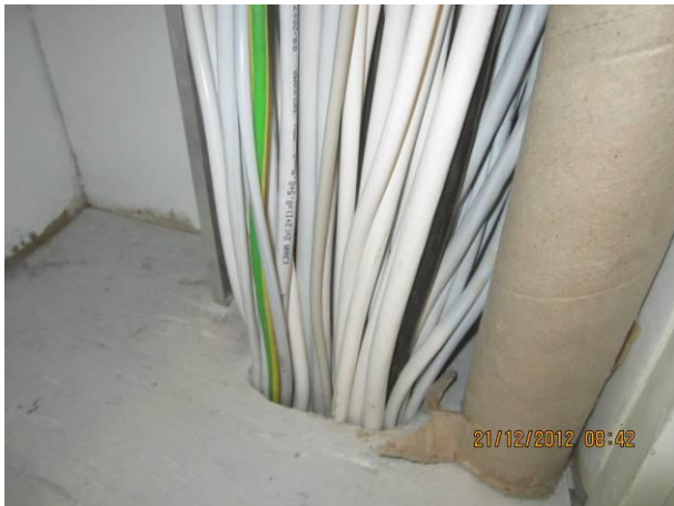
Kuva 27 Tiivistämätön sähköläpivienti keittiön ja inva-wc:n viereisen komeron lattias- assa.
