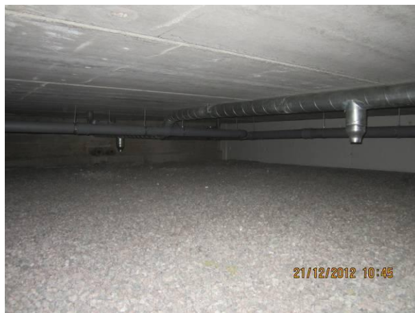
Kuva 17 Laajennuksen 2008 A-osan tuloilmakanavia, pohjasepeli on kuiva ja tasainen.
