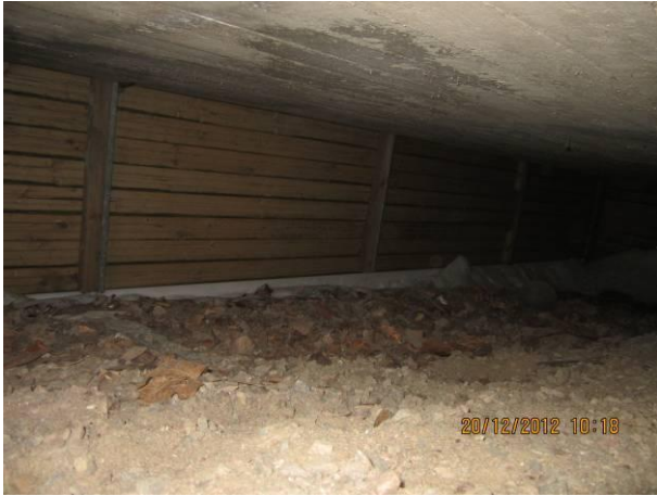
Kuva 21 Länsisivun sisäänkäyntitason alustatila, jossa on maatuvaa lehtijätettä.
