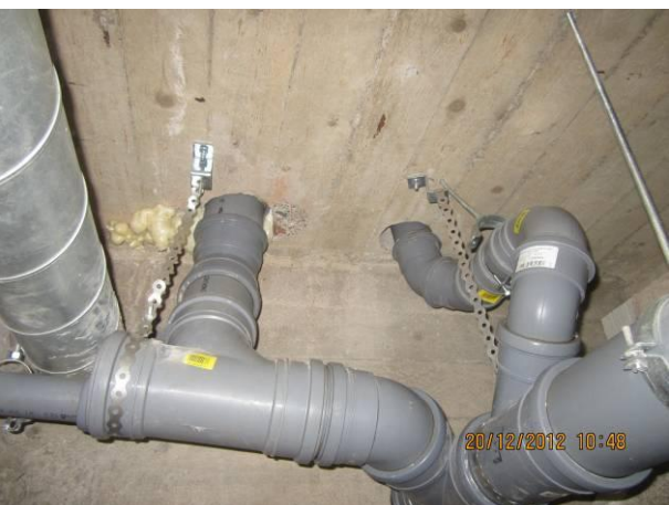
Kuva 25 Tiivistämättömiä uudehkoja viemäri- pivientejä, ap-eriste puuttuu.
