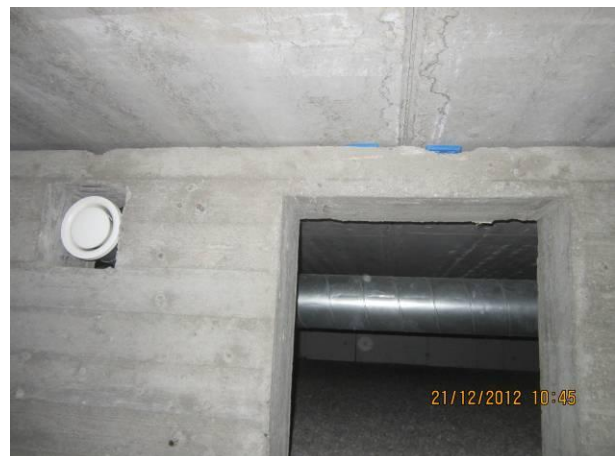
Kuva 18 Laajennuksen 2008 A-osan poistokanava ja poistoveniilli, lohkojen välinen kulkuaukko.
