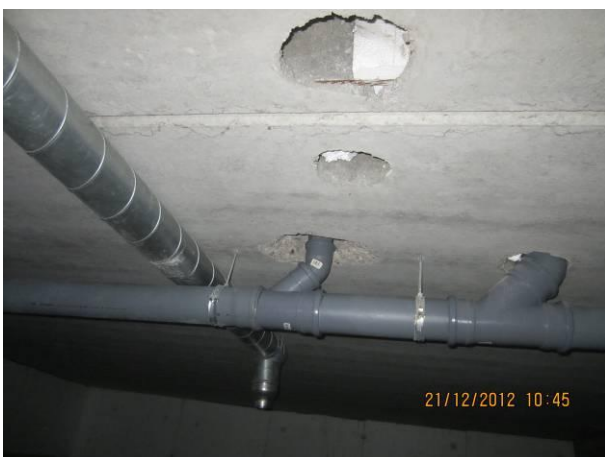
Kuva 37 A-osan käyttämättömiä läpivientejä ei ole tiivistetty.
