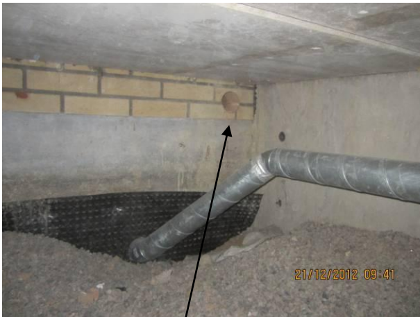
Kuva 31 Alkuperäisen osan ulkoseinän alaosa, jossa nurkassa on käyttämätön IV-läpivienti. Alap. ja ulkos. välissä rako.
