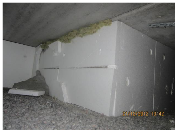
Kuva 38 Sisäänkäyntikohdan kohdalla olevia valupurseita, sauman villatilkkkeitä, muuten vaikutti olevan ok.
