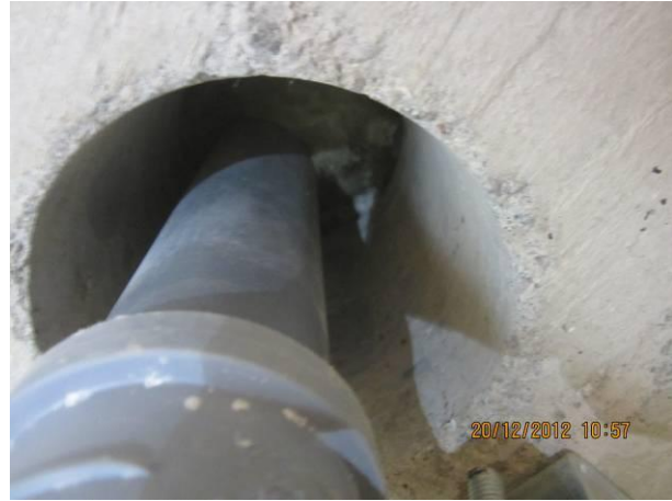
Kuva 22 Tyypillinen tiivistämätön läpivienti, yläosalla vuorivillaa valutukkeena.
