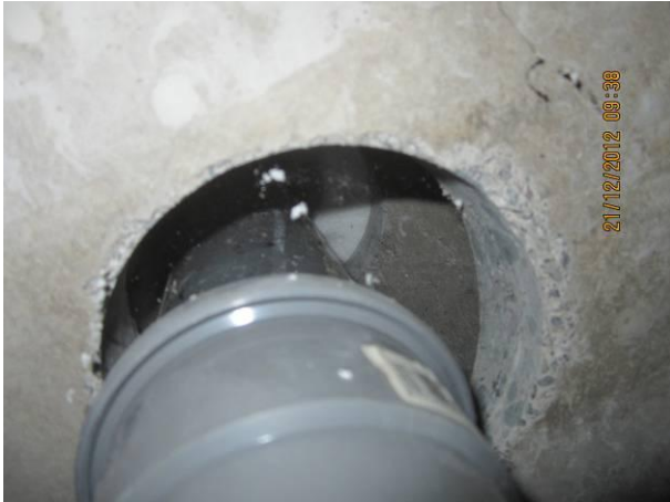
Kuva 29 Tyypillinen tiivistämätön läpivienti.
