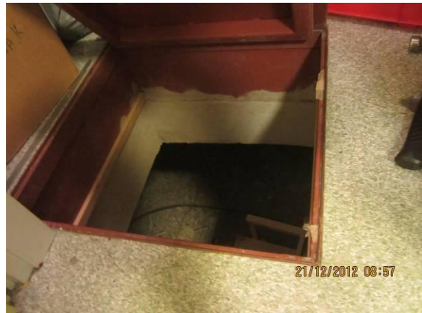
Kuva 28 Tiivistämätön kulkuluukku v. 2000 alus- tatalaan.
