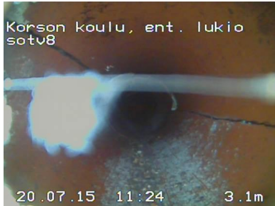
Kuva 30. Salaojaputki haljennut linjassa sotv8.
