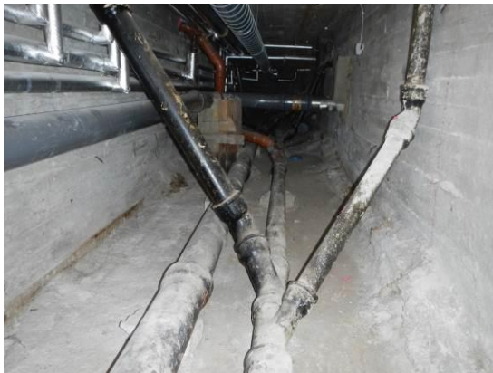
Kuva 15. Jäte- ja sadevesipohjarunkoviemärit putkitunnelissa.
