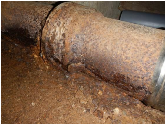
Kuva 17. Ulkopuolista syöpymistä pohjarunkoviemärissä ja kosteutta sen lähetyvillä.
