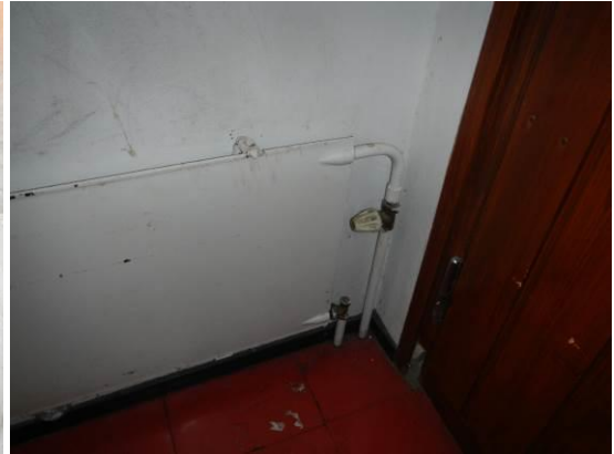
Kuva 2. Lämpöjohdot nousevat lattialäpivientien kautta lämpöpattereille.
