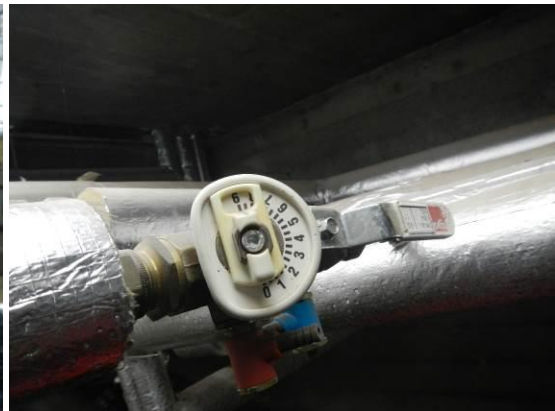
Kuva 12. Linjasäätöventtiili on täysin auki.
