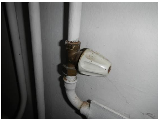
Kuva 5. Todennäköisesti alkuperäinen patteriventtiili.
