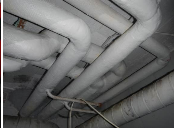
Kuva 8. Todennäköisesti alkuperäisiä putkieristeitä, saattavat sisältää asbestia.
