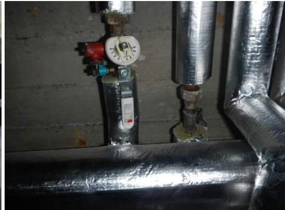
Kuva 4. Linjasulku- ja säätöventtiilipari, näyttötaulun mukaan säädetty.
