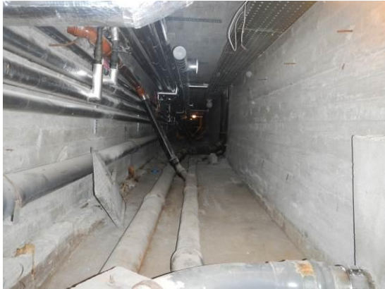
Kuva 1. Lämpö- ja käyttövesirunkojohtoja ryömintätilassa.
