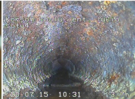
Kuva 31. Salaojaverkoston valurautainen purkuputki on sisäpinnaltaan ruosteinen, sotv4.
