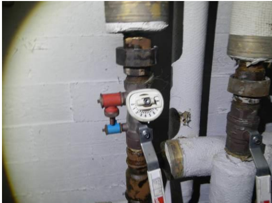
Kuva 3. Linjasulku- ja säätöventtiilipari, säätö täysin auki.
