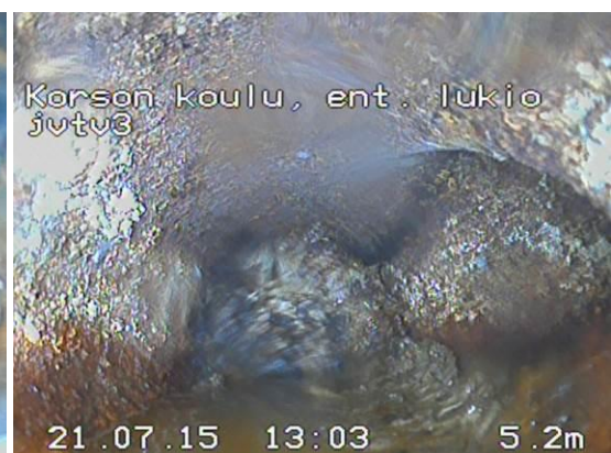
Kuva 24. Tukkeuma pohjaviemärissä, jvtv3, pesty auki.
