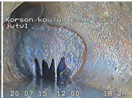
Kuva 22. Jätekerääntymää pohjaviemärissä, jvtv1.
