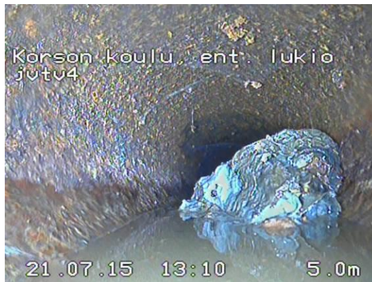
Kuva 21. Jätekerääntymä pohjaviemärissä, jvtv4.
