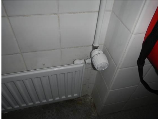
Kuva 7. Uusittu patteriventtiili, merkki Danfoss, vuoden 2003 termostaattimalli.
