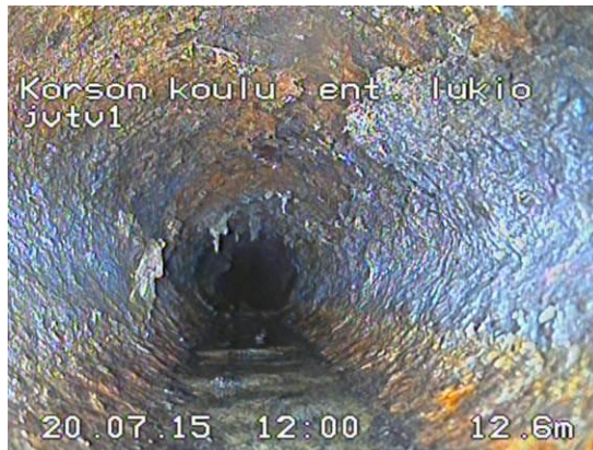
Kuva 19. Lastumaista ruostetta viemärin sisäpinnalla, jvtv1.
