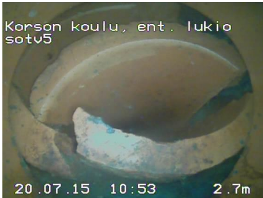
Kuva 27. Putkirikko linjassa sotv5.
