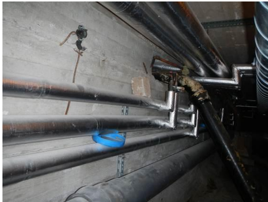
Kuva 9. Käyttöveden runkojohtoja ryömintätilassa.
