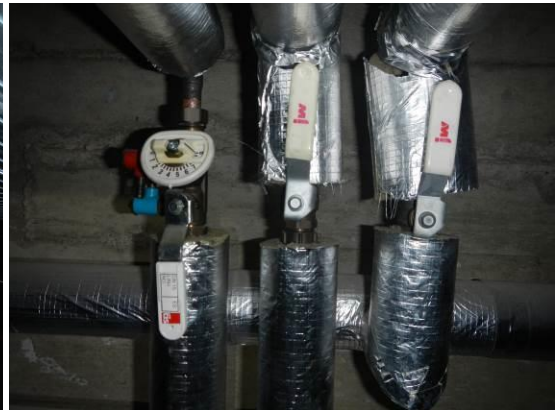
Kuva 10. Linjasäätö- ja sulkuventtiileitä ryömintätilassa.
