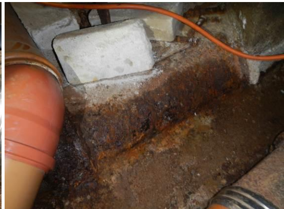
Kuva 18. Ulkopuolista syöpymistä pohjarunkoviemärissä ja kosteutta sen lähetyvillä.
