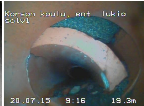
Kuva 26. Putkirikko linjassa sotv1.
