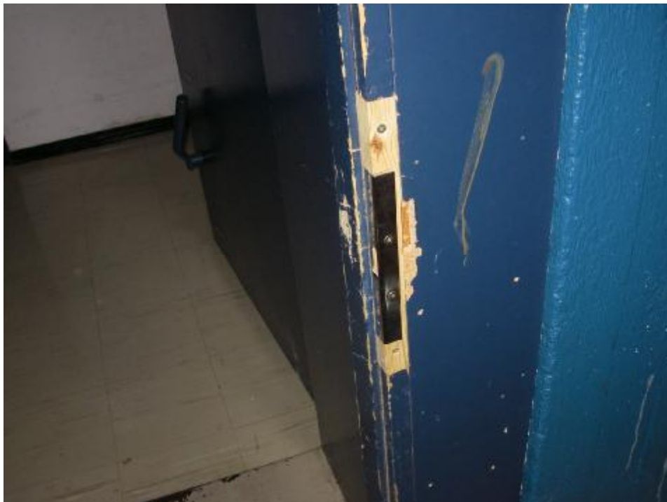
Väliovia ja niiden karmeja on jouduttu korjaamaan eri puolella rakennusta. Suositellaan huonokuntoisten väliovien uusimista.
