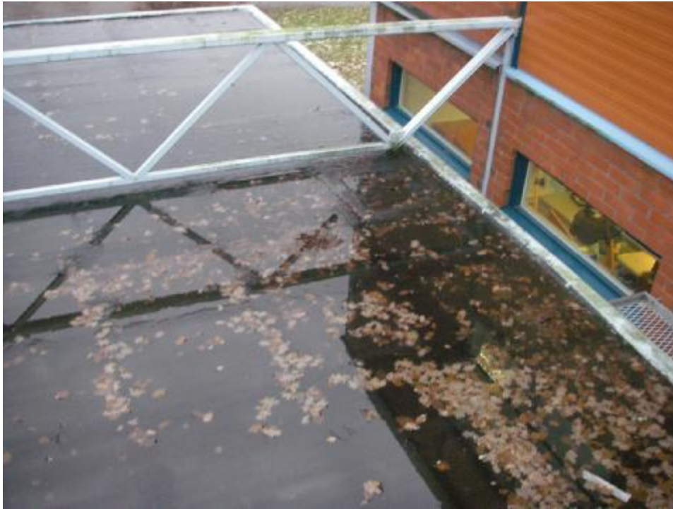
Katosten kallistukset ovat puutteellisia ja vesi seisoo katoilla monin paikoin.
