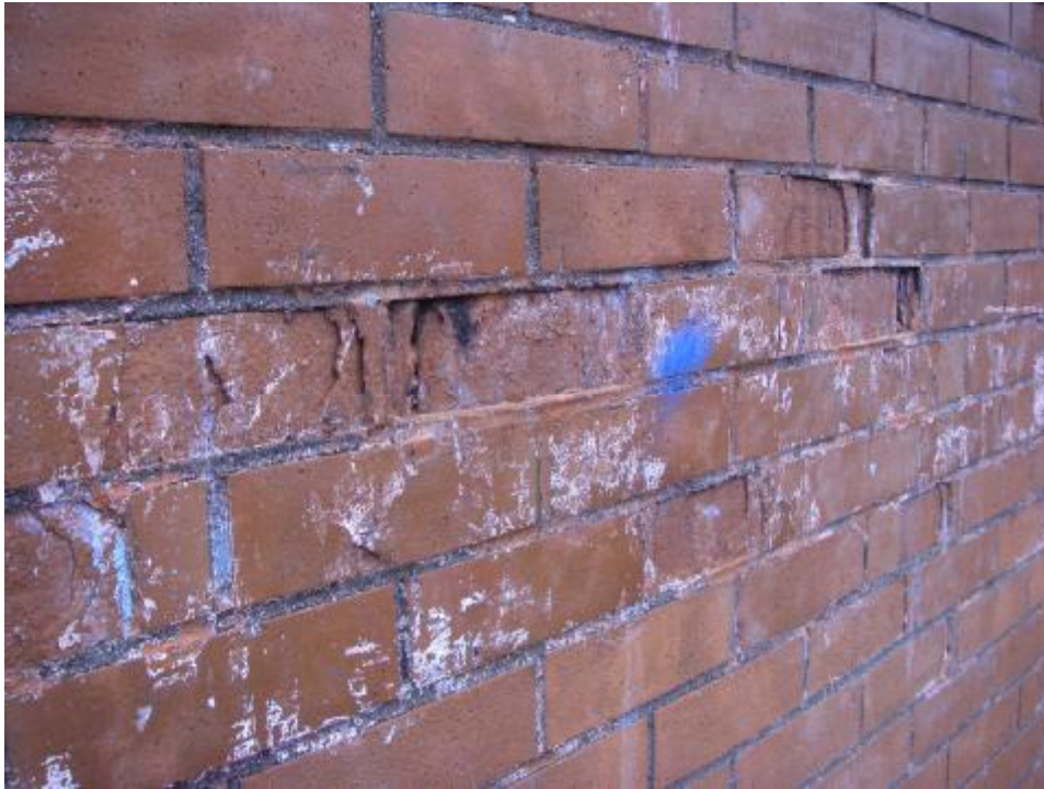
Tiiliseinien pinnassa esiintyy rapautumaa muutamissa kohdissa. Huonokuntoisten tiilien uusimiseen tulee varautua.
