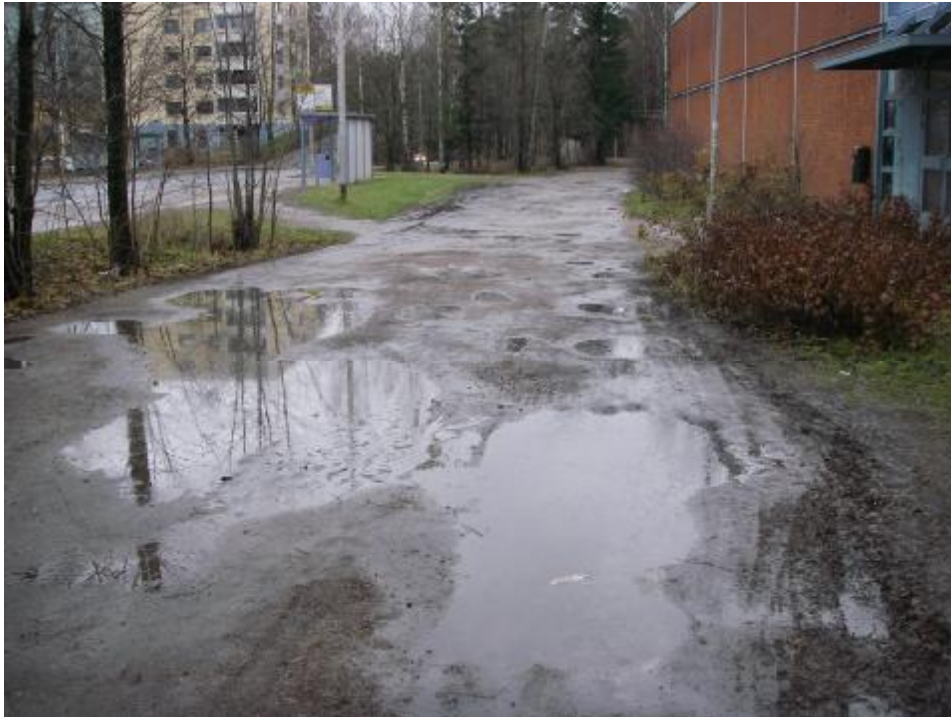
Sorapäällysteessä on painumia, joihin vesi lammikoituu.
