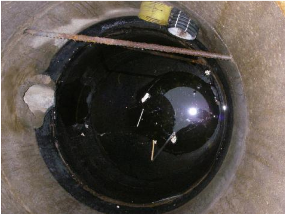
Salaojan tarkastuskaivo liikuntasalin nurkalla. Viitteitä salaojien puutteellisesta toiminnasta ei havaittu.
