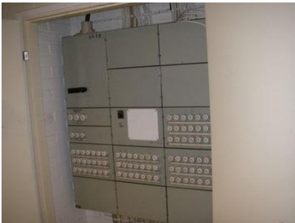
Ryhmäkeskus käytävällä on perinteinen tulppasulakekeskus.
