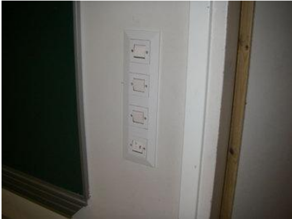
Valaistuksen kytkimet ovat pääosin alkuperäiset.
