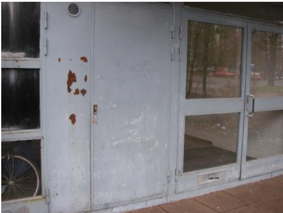
Useissa ulko-ovissa esiintyy maalipintojen vaurioita ja epätiivyyttä.
