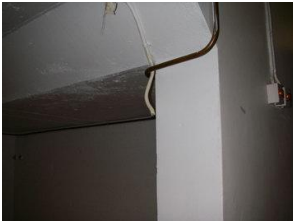
Päättämätön kaapeli väestönsuojan edessä.
