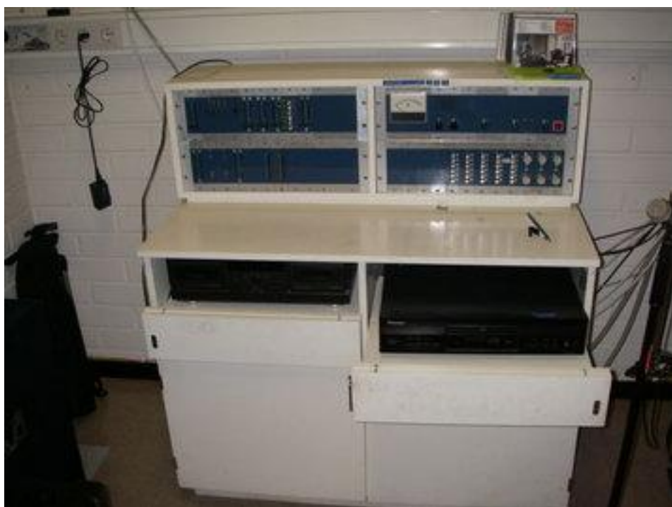
Alkuperäinen äänentoistolaitteisto on elinkaarensa päässä.
