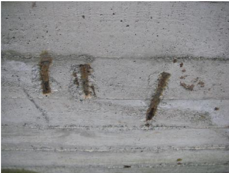
Sokkelipinnoissa olevat ruostuneet teräkset vaativat korjaustoimenpiteitä.
