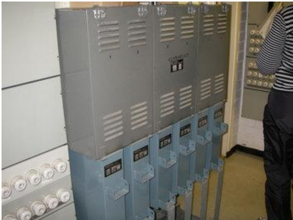
Kompensointilaitteen yksiköt on uusittu mutta on muuten alkuperäinen.
