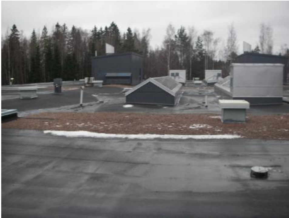
Yleiskuvaa vesikatolta. Bitumikermikate alkaa ikänsä puolesta olla uusimistarpeessa PTS-jakson aikana.
