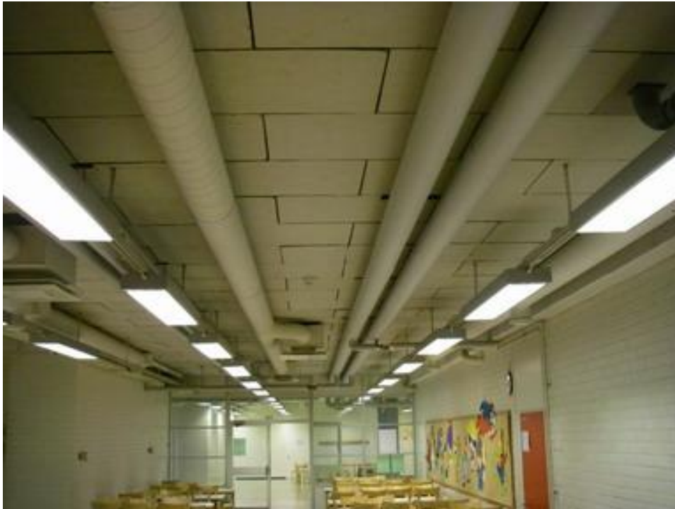
Pääosa kanavista ja pääte-elimistä on uusittu vuonna 2000.
