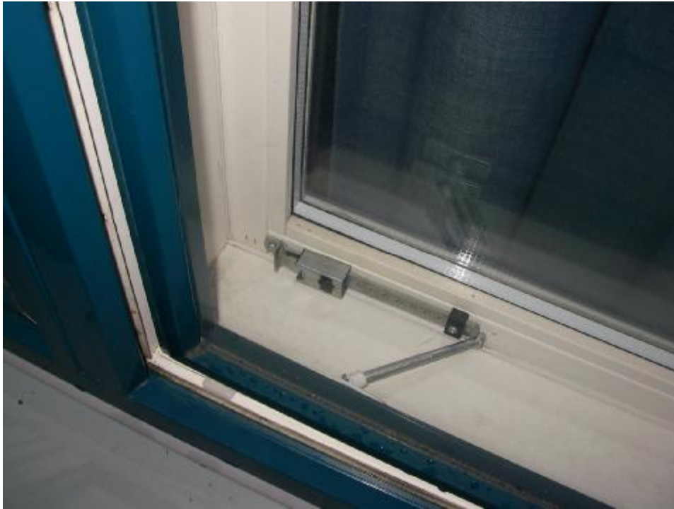
Ikkunoiden sulkijamekanismit ovat monissa kohdissa irti tai epäkunnossa.
