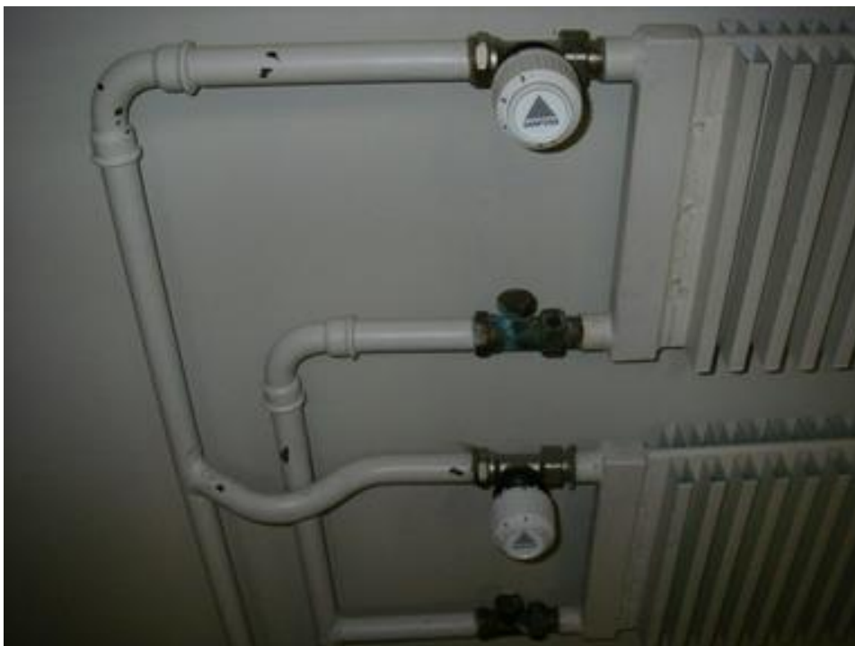
Termostaattiset patterivernttiilit on pääosin uusittu lämmönsiirrin paketin yhteydessä.
