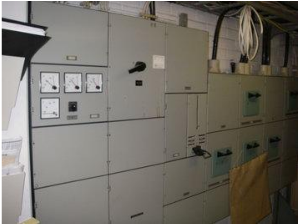
Kiinteistön sähköpääkeskus on alkuperäinen.
