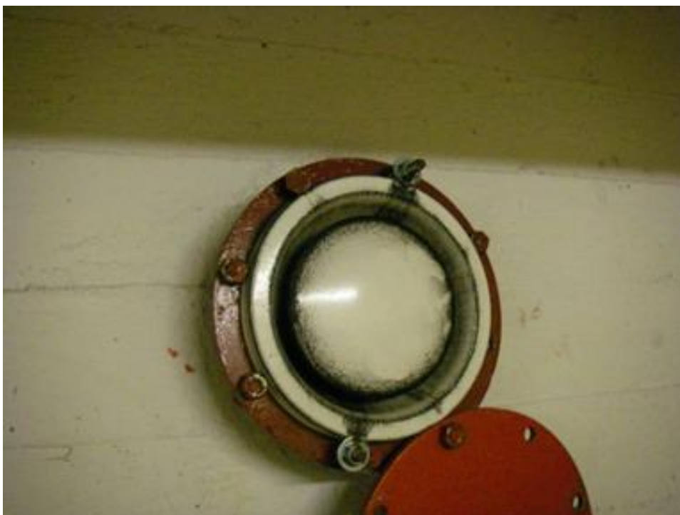
Ilmanvaihdon pääte-elimet tulee puhdistaa kanavien nuohouksen yhteydessä.
