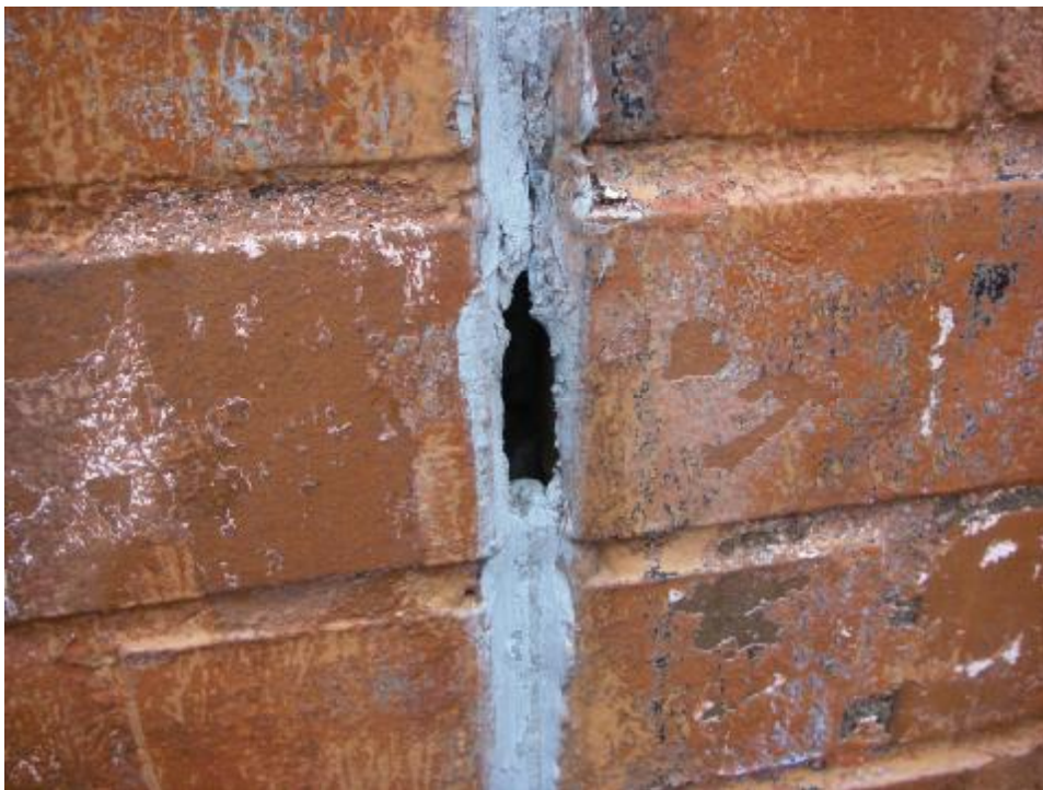
Tiiliseinien elastiset saumat ovat huonossa kunnossa ja niissä on muutamia reikiä. Vanhat saumat saattavat sisältää PCB:tä tai lyijyä.
