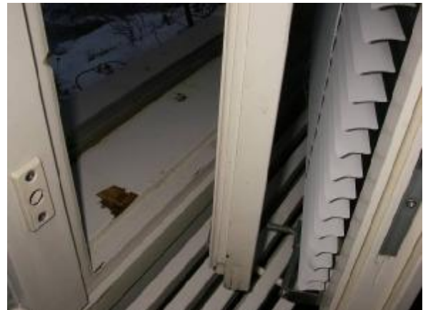
Ikkunoiden käynnissä ja tiivistyksissä esiintyy puutteita.
