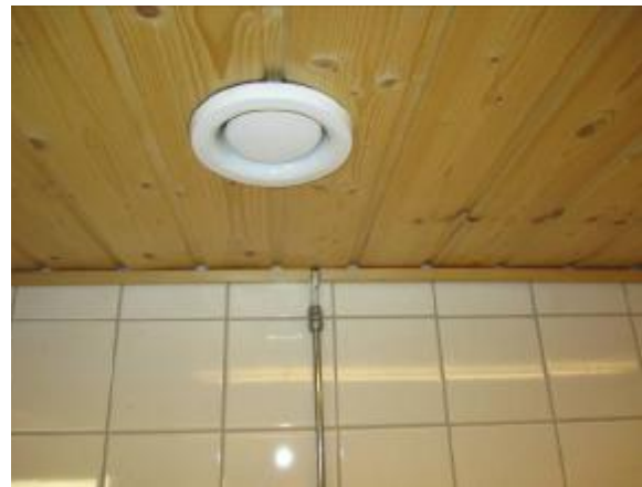
Poistoilmaventtiilit ovat paikoin kohtalaisen likaiset.
