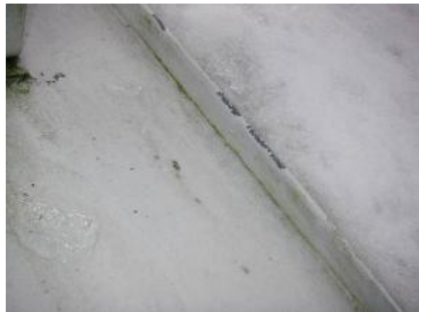
Vesikaton maalipinnassa on vähäisiä vaurioita.
