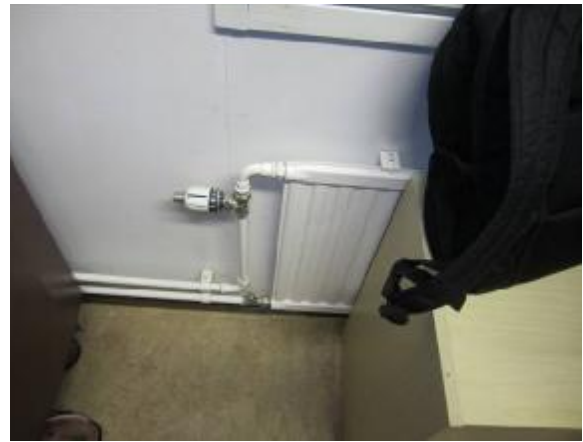
Lämmitysjärjestelmä on pääosin vuodelta 1988.
