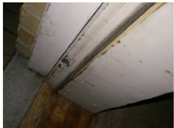
Ulko-oven karmissa esiintyy kulumaa ja tiivistevikoja.
