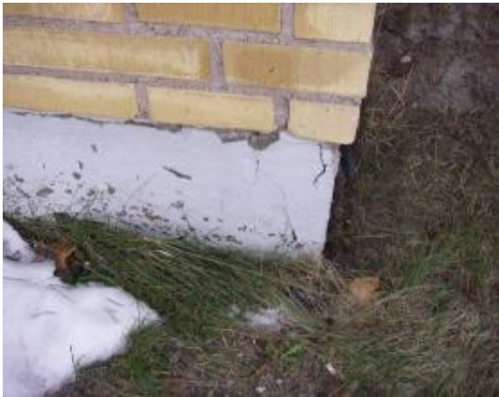
Sokkeleissa on muutamia halkeamia.
