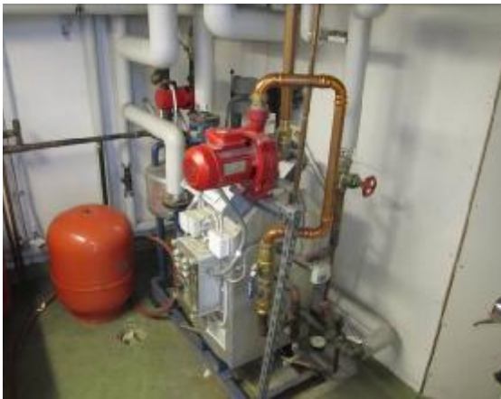
Lämmönsiirtimet ovat vuodelta 1982.
