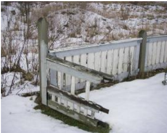
Puuaita on huonossa kunnossa.
