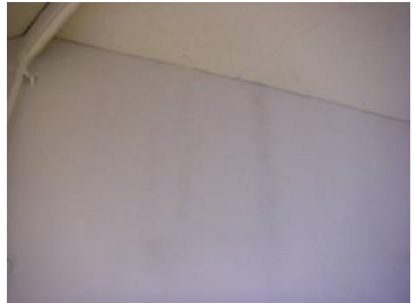
Takkahuoneen seinässä lämpövuotoihin viittaavia jälkiä.
