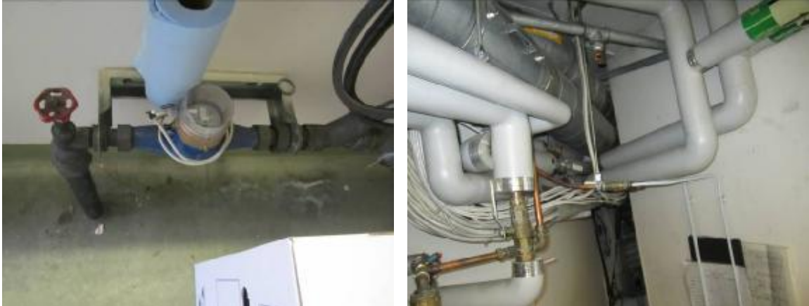
Kiinteistön vesimittari on lämmönjakuhuoneessa. Linjaventtiilit ovat myös vuodelta 1988.
