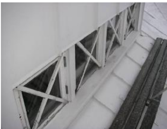
Kattolyhtyjen ikkunoiden ulkopuitteissa on havaittavissa maalipintojen vaurioita.
