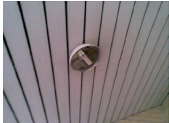
Katoksen valaisimesta puuttuu suojakuppu.
