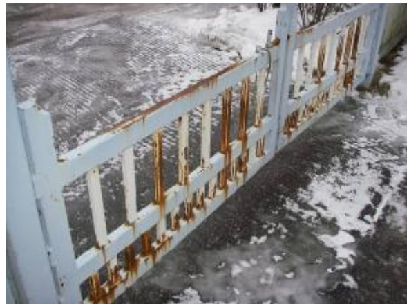
Teräsrakenteinen portti on ruostunut.
