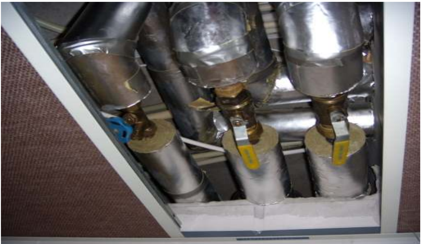
KUVA 2. Käyttövesiverkoston venttiilit ovat pallo- ja vinoistukkaventtiileitä.
