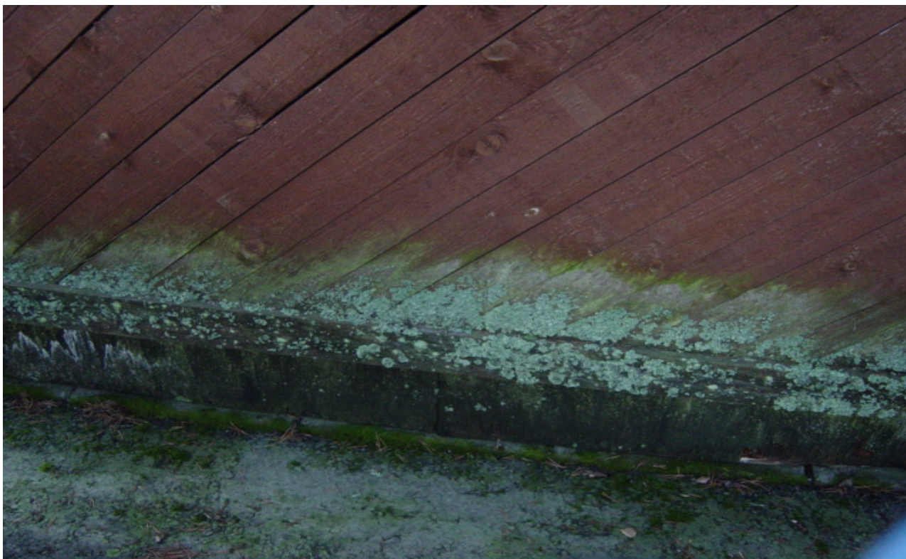
Kuva 1. Jätekeskuksen ulkopuolen vaurio
