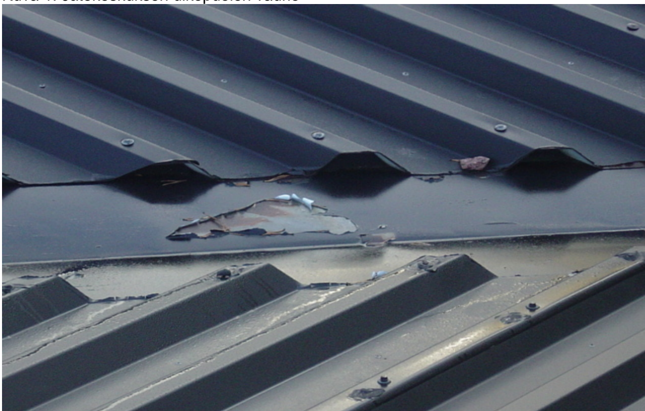
Kuva 2. Vesikaton pinnoitteen irtoilua.
