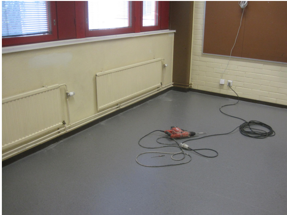
Kuva 4. Luokkahuoneen 205 ulkoseinä, jonka lattia-seinäliitoksesta havaittiin ilmavuotoa.
