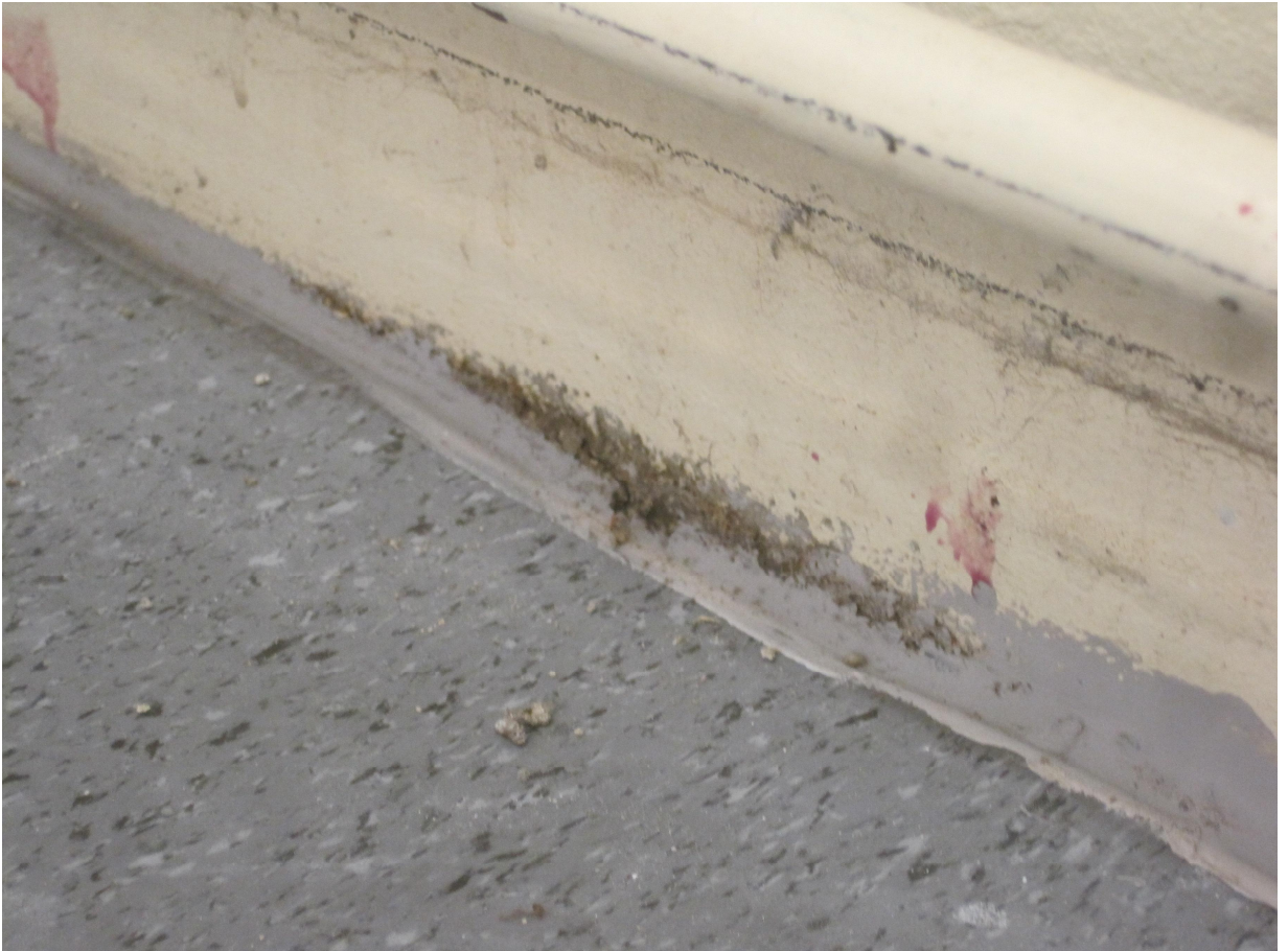
Kuva 2. Seinä-lattialiitosta ei ole puhdistettu kunnolla ennen tiivistystyön aloittamista.
