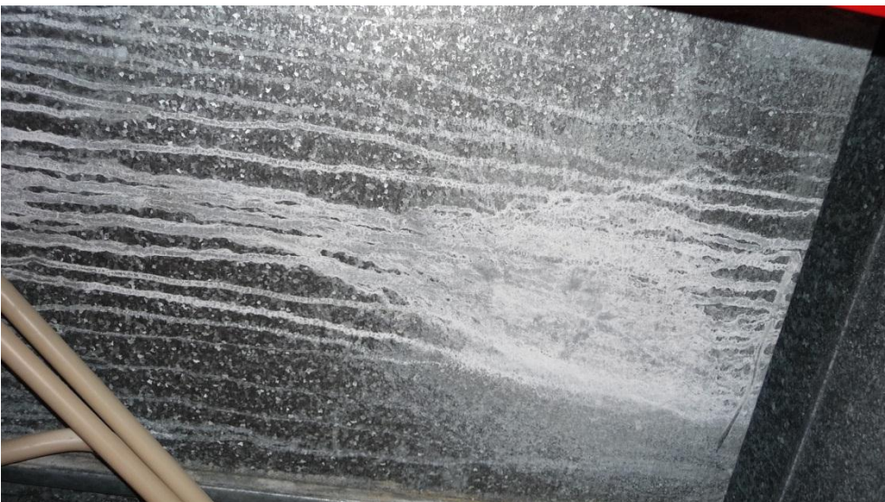
Vesivalumia välikaton kanavassa
