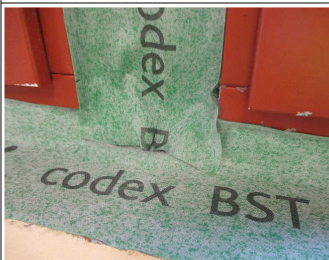
Epätiivis tiivistysnauhojen asennus.
