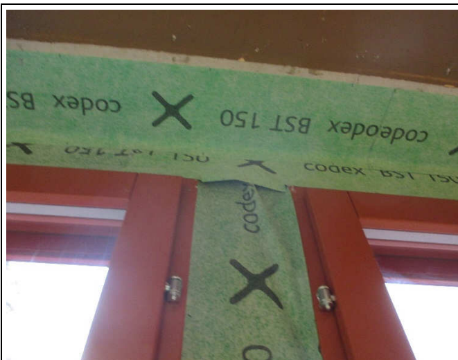
Epätiivis tiivistysnauhan jatkos.
