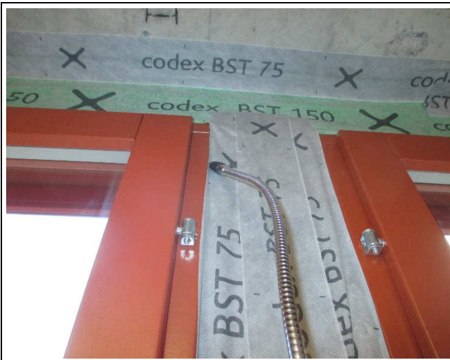
Epätiivis tiivistysnauhan liitos.
