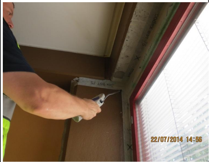
Kuva 12: vuotokohta, palkin ja pilarin liitos
