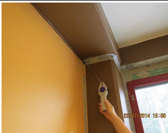
Kuva 15: vuotokohta, seinän, pilarin ja palkin liitos
