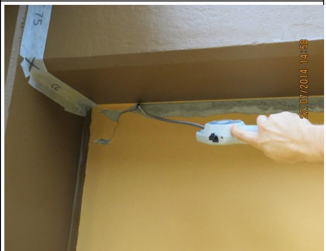
Kuva 16: vuotokohta, halkeama pilarin vieressä
