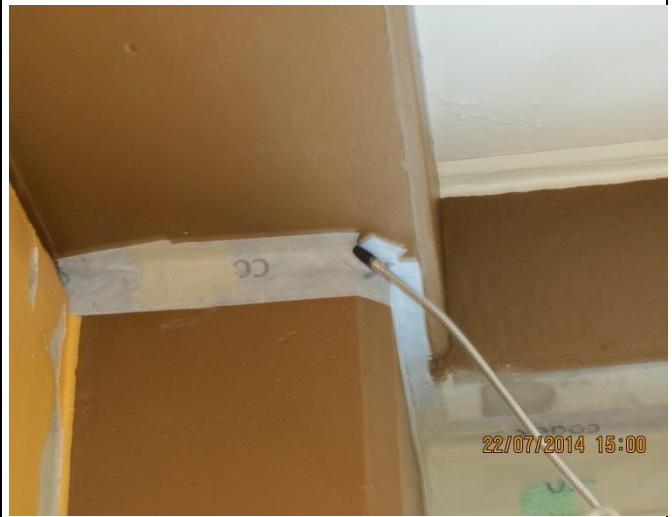
Kuva 14: vuotokohta, palkin ja pilarin liitos
