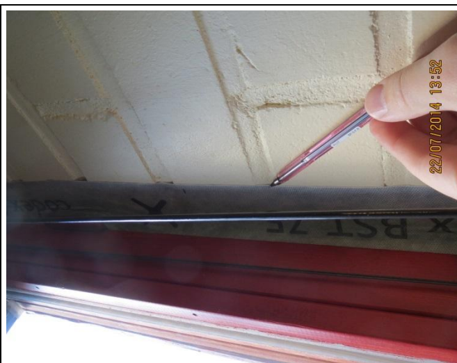
Kuva 2: vuotokohta, väliseinän muuraussaumat
