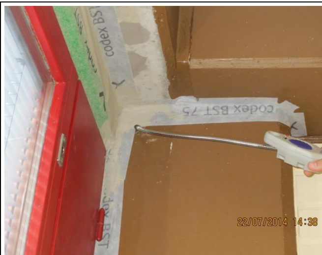
Kuva 9: vuotokohta, palkin ja pilarin liitos
