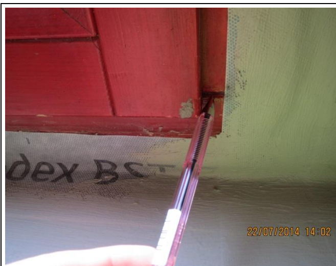
Kuva 1: vuotokohta, ikkunan karmiliitos
