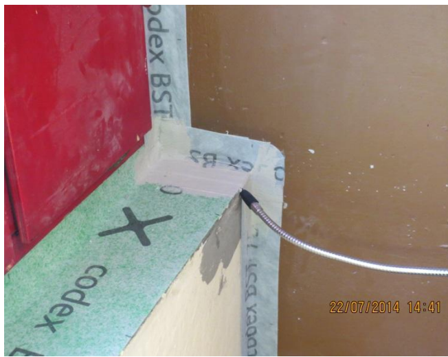
Kuva 11: vuotokohta, pilarin ja sisäkuoren liitos
