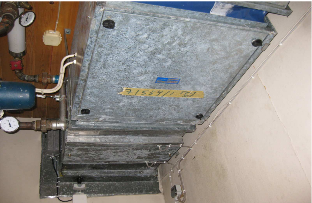
LVI-kuva 9. Yleiskuva lisärakennuksen tuloilmakoneesta.
