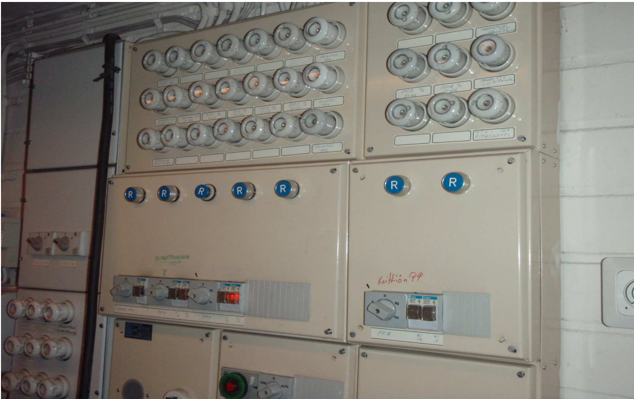
S-kuva 5. Päiväkodin IV- konehuoneen keskus.
