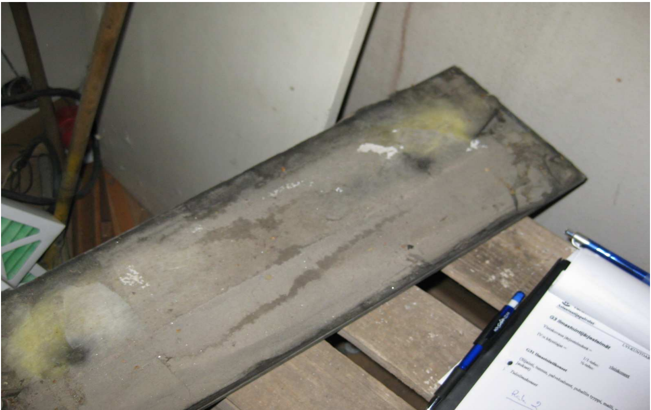
LVI-kuva 16. Tuloilmakoneen kammiot ovat eristetty mineraalivillalla, joka on paikoin rikki.
