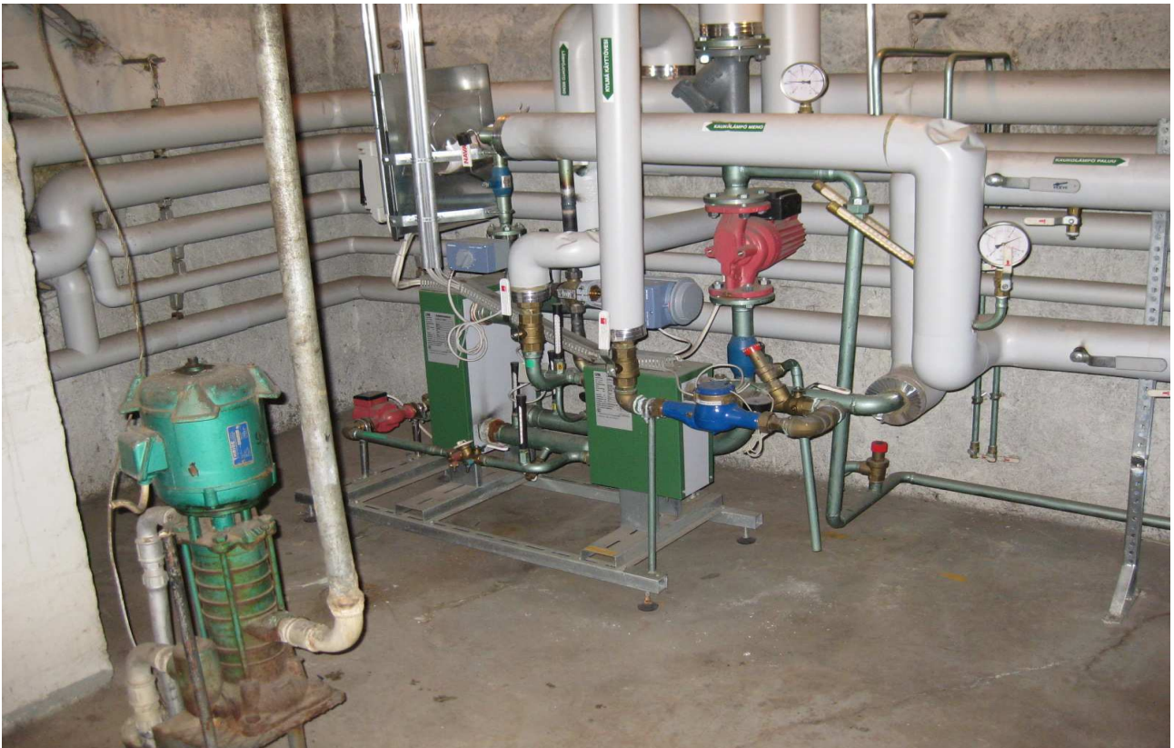
LVI-kuva 1. Yleiskuva lämmönjakohuoneesta.
