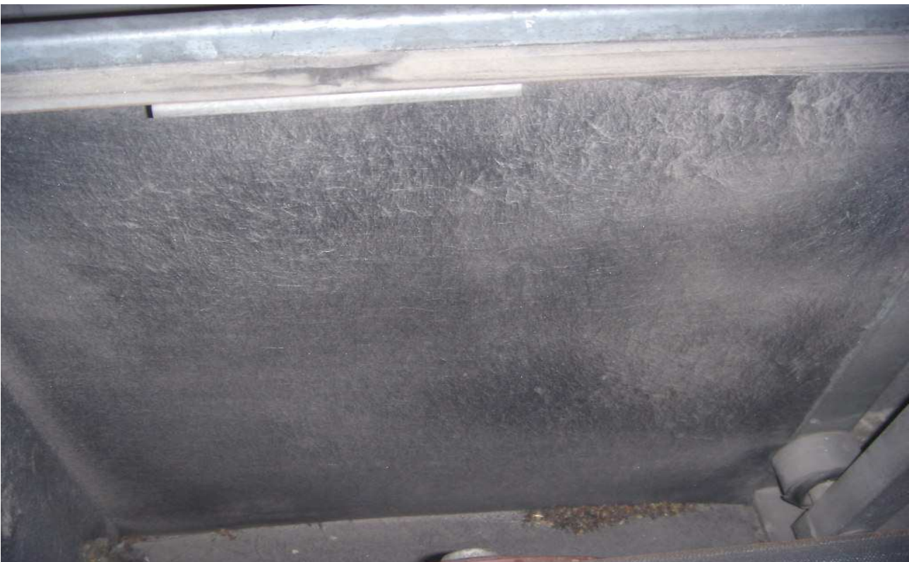
LVI-kuva 13. Päiväkodin tuloilmakoneen kammiot ovat eristetty mineraalivillalla.
