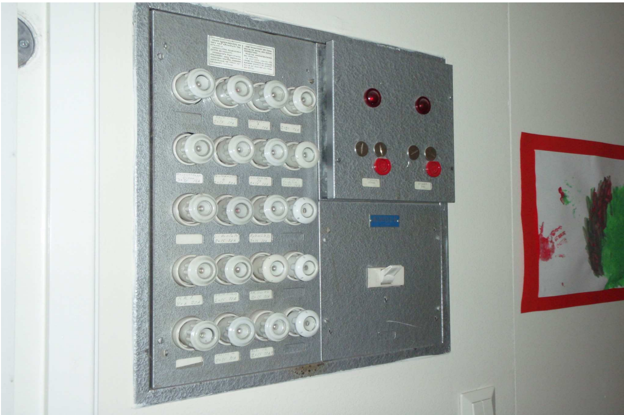
S-kuva 6. Lisärakennuksen sähkökeskus.
