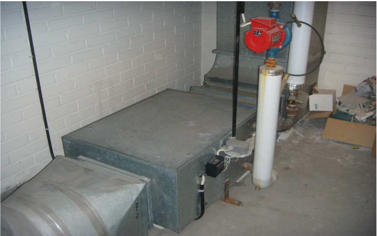
LVI-kuva 8. Yleiskuva päiväkodin tuloilmakoneesta.
