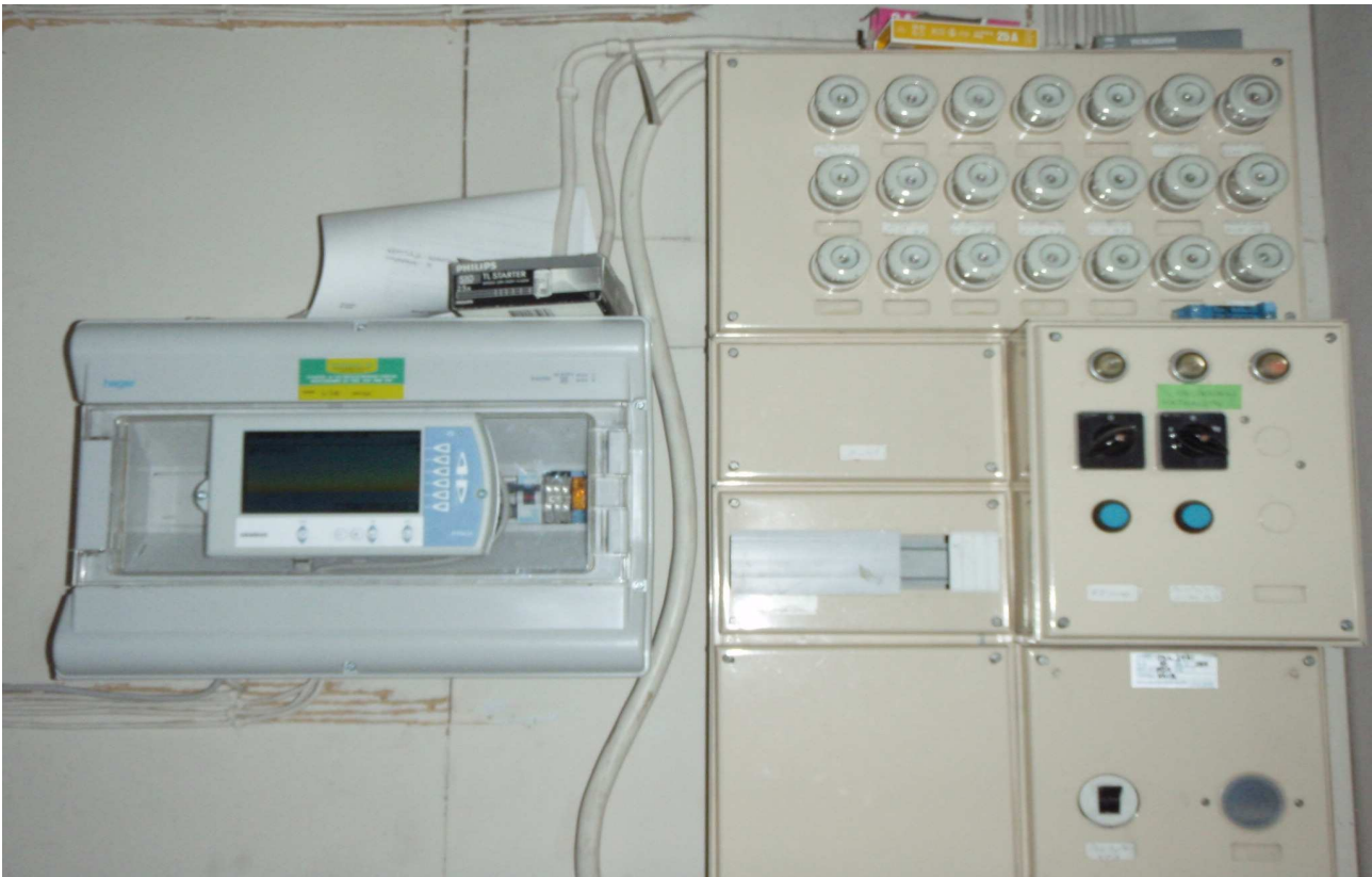
S-kuva 7. Lisärakennuksen IV- keskus ja yksikkösäädin.
