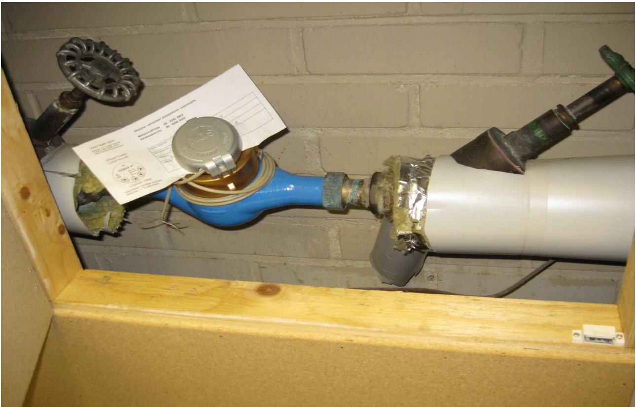
LVI-kuva 4. Yleiskuva vesimittarista ja pääsuluista.
