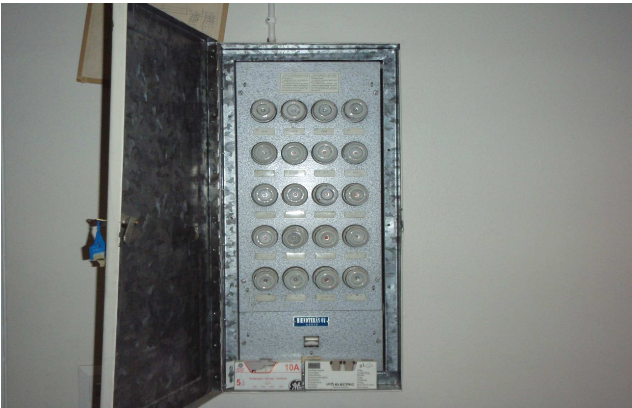
S-kuva 4. Päiväkodin toimistohuoneen keskus.
