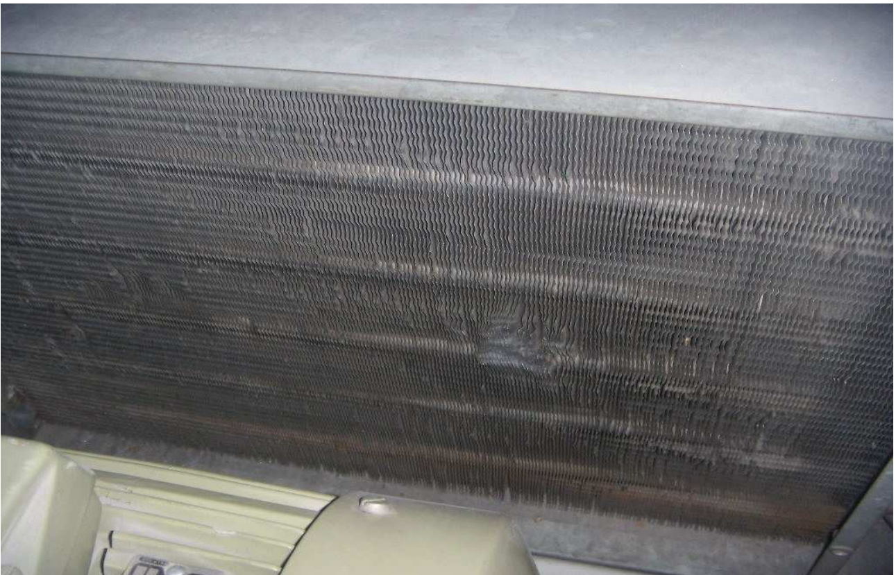
LVI-kuva 11. Päiväkodin tuloilmakoneen lämmityspatteri on pölyinen
