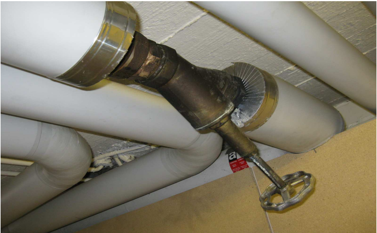
LVI-kuva 5. Yleiskuva käyttöveden sulkuventtiilistä.
