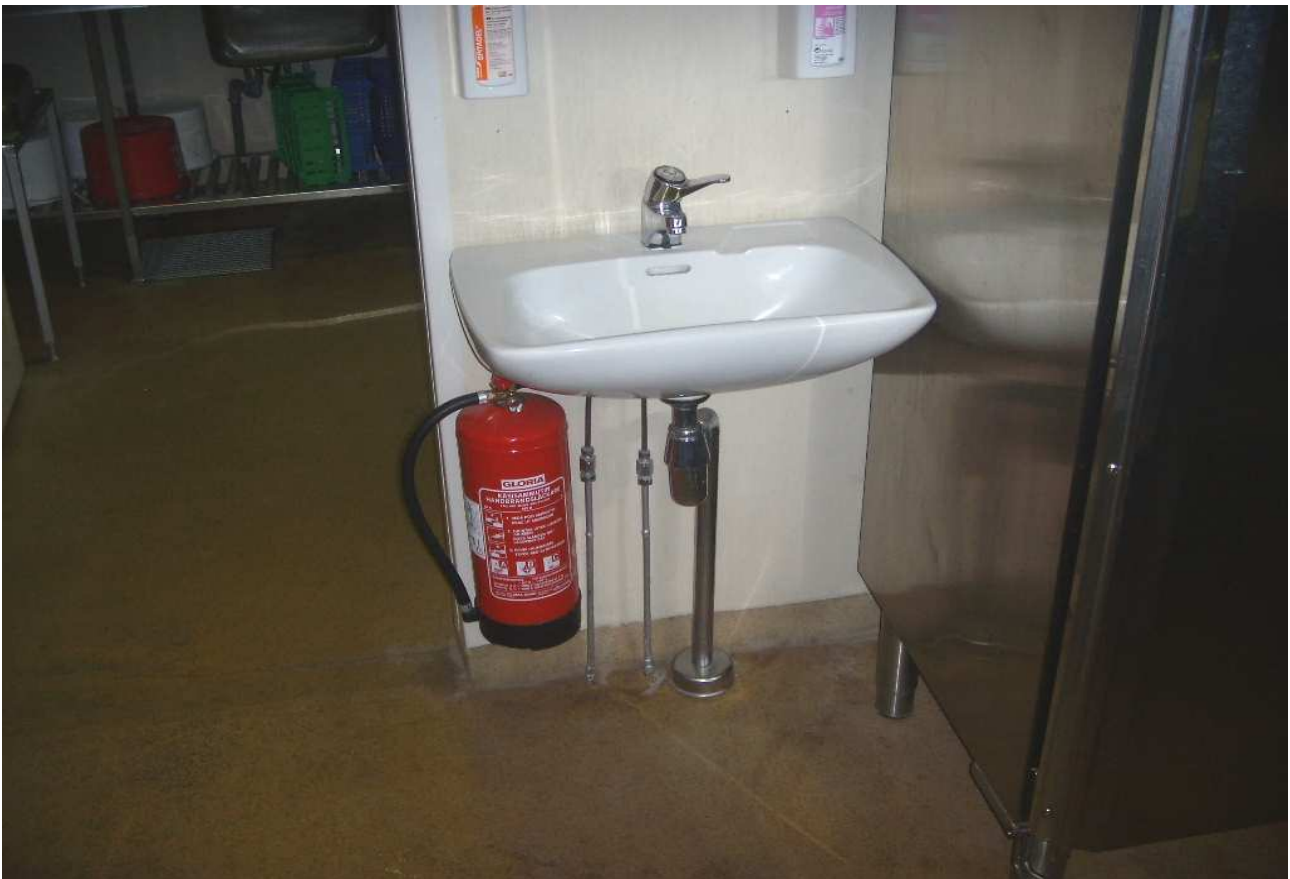
LVI-kuva 6. Yleiskuva vesikalusteista.
