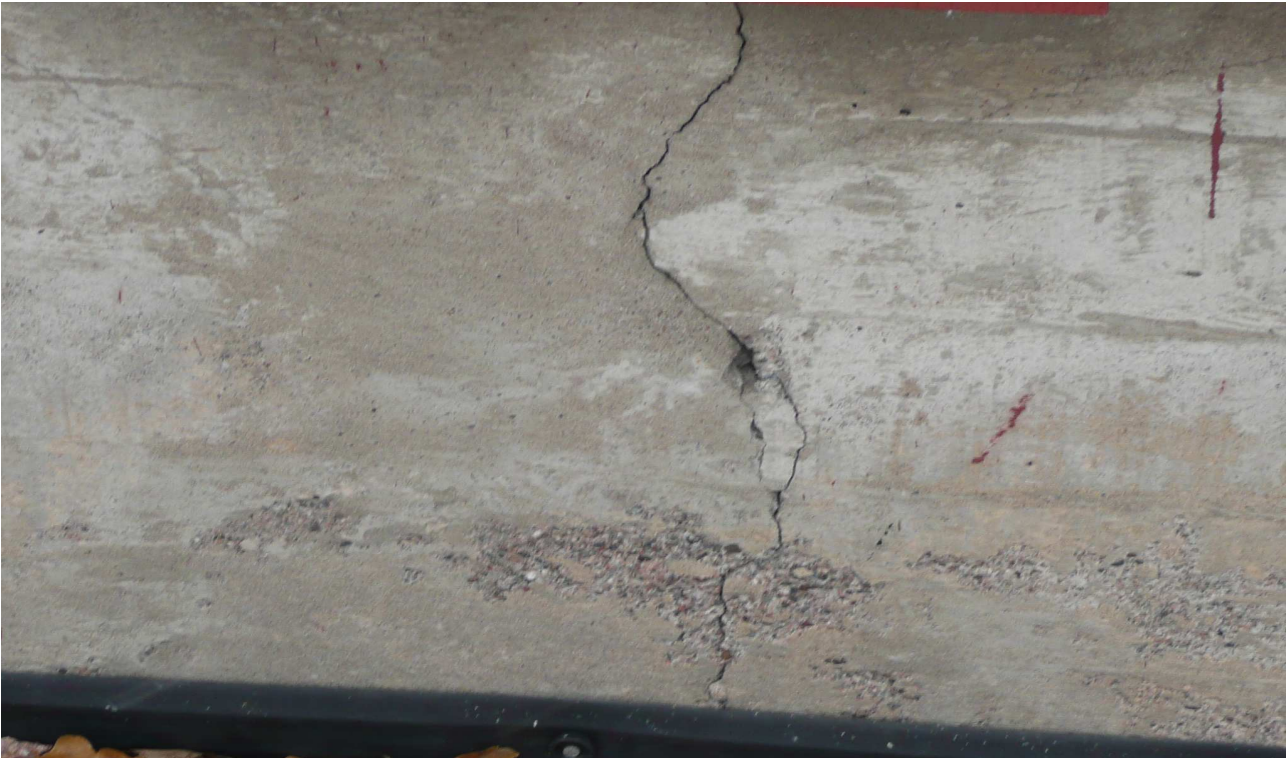
RAK-kuva 5. Lisärakennuksen sokkelissa on halkeama.
