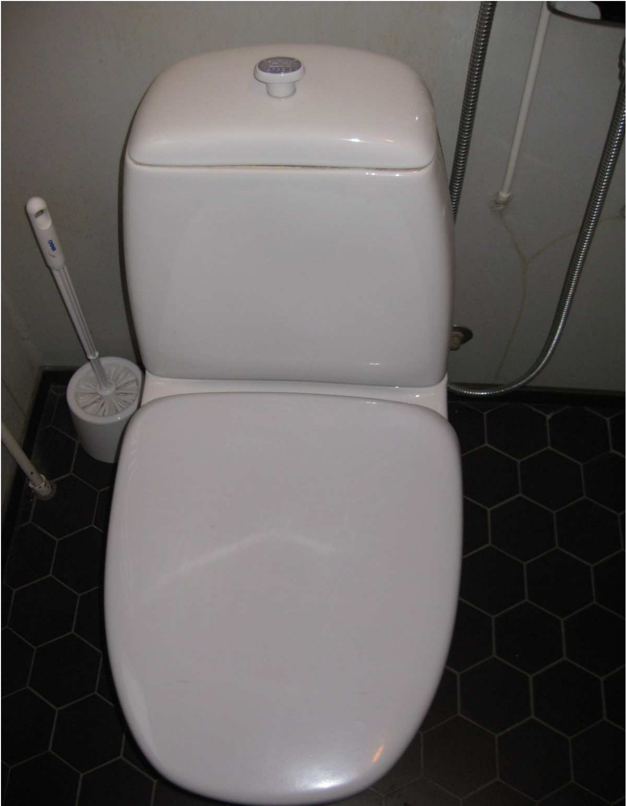
LVI-kuva 7. Yleiskuva vesikalusteista.
