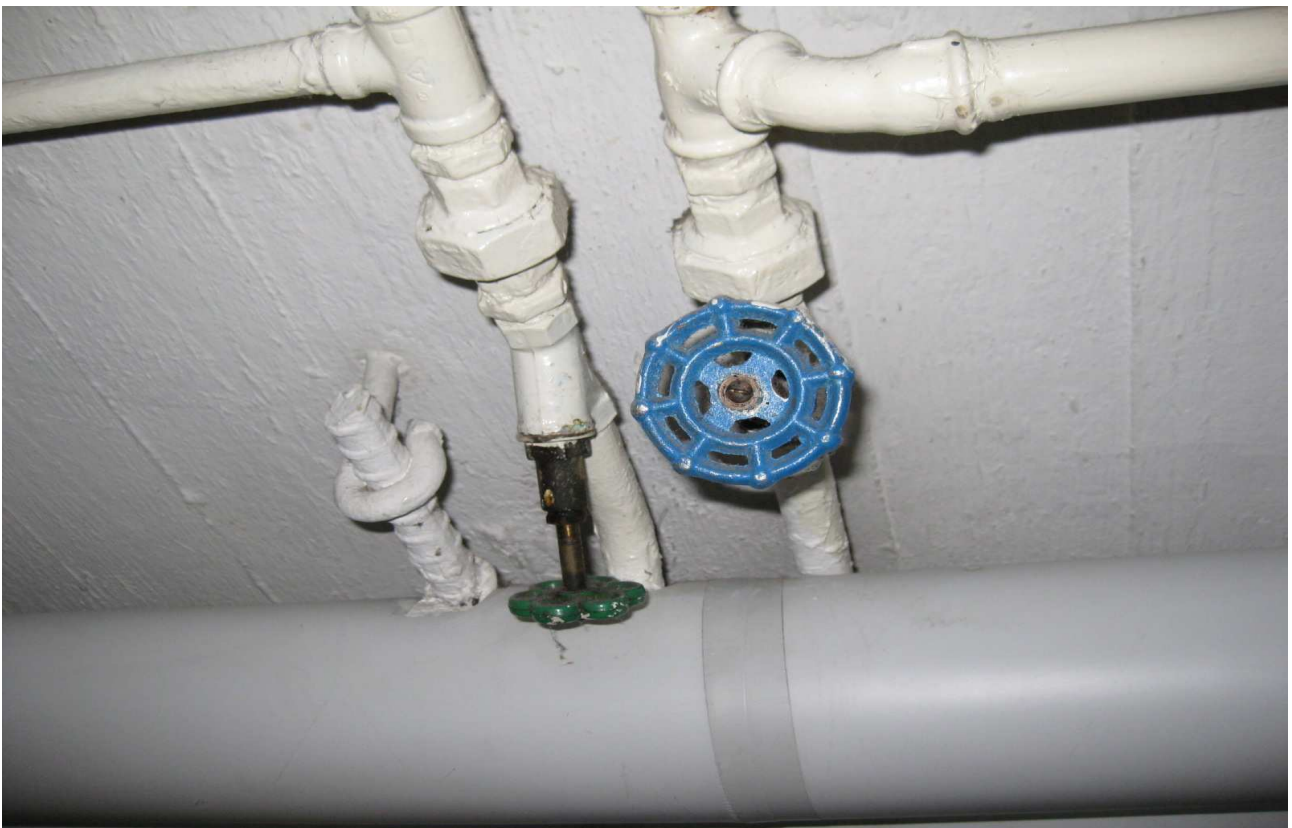
LVI-kuva 2. Yleiskuva lämpöjohtoverkoston venttiileistä.
