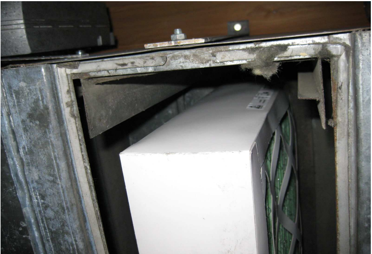
LVI-kuva 14. Lisärakennuksen tuloilmakoneen suodatin on liian pieni.
