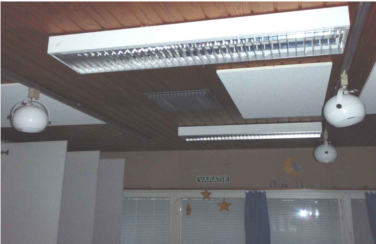
S-kuva 8. Päiväkodin huoneiden valaistus.
