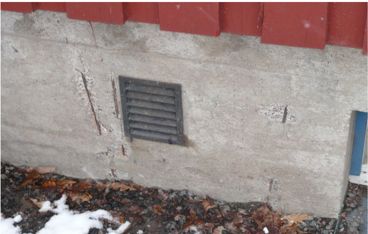
RAK-kuva 4. Yleiskuva sokkelista, jossa on näkyvissä ruosteisia betoniteräksiä.
