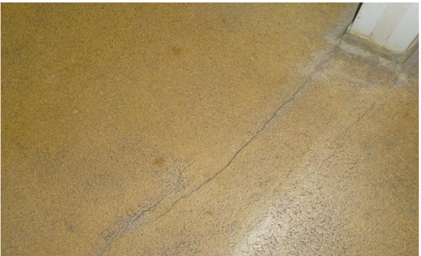
RAK-kuva 10. Keittiön lattiassa on halkeamia.
