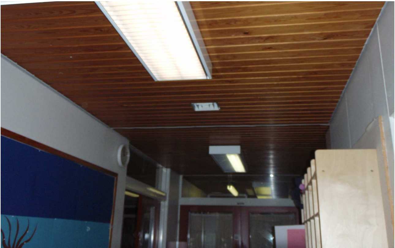
S-kuva 9. Lisärakennuksen käytävän valaistus.
