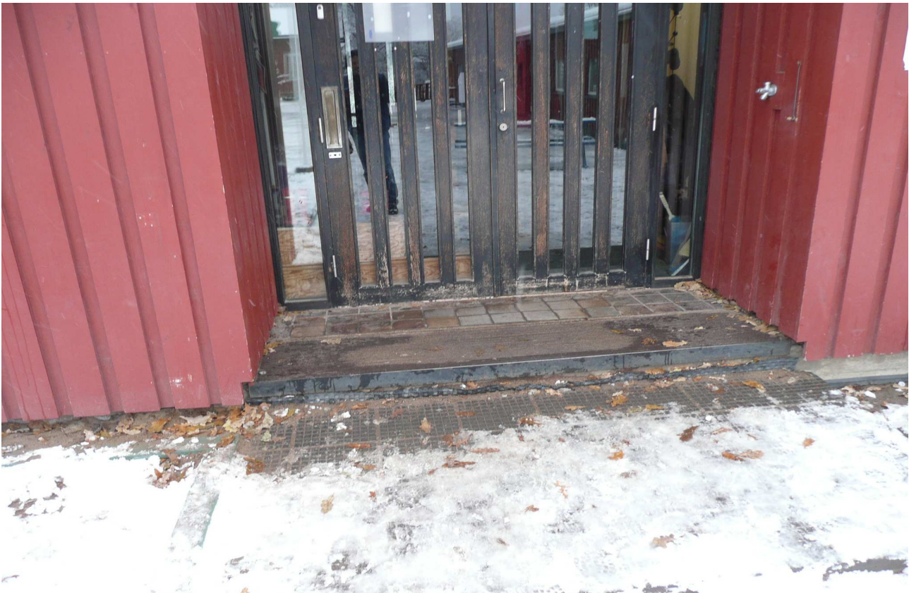
RAK-kuva 9. Puuovissa esiintyy melko voimakasta pinnan kulumista.
