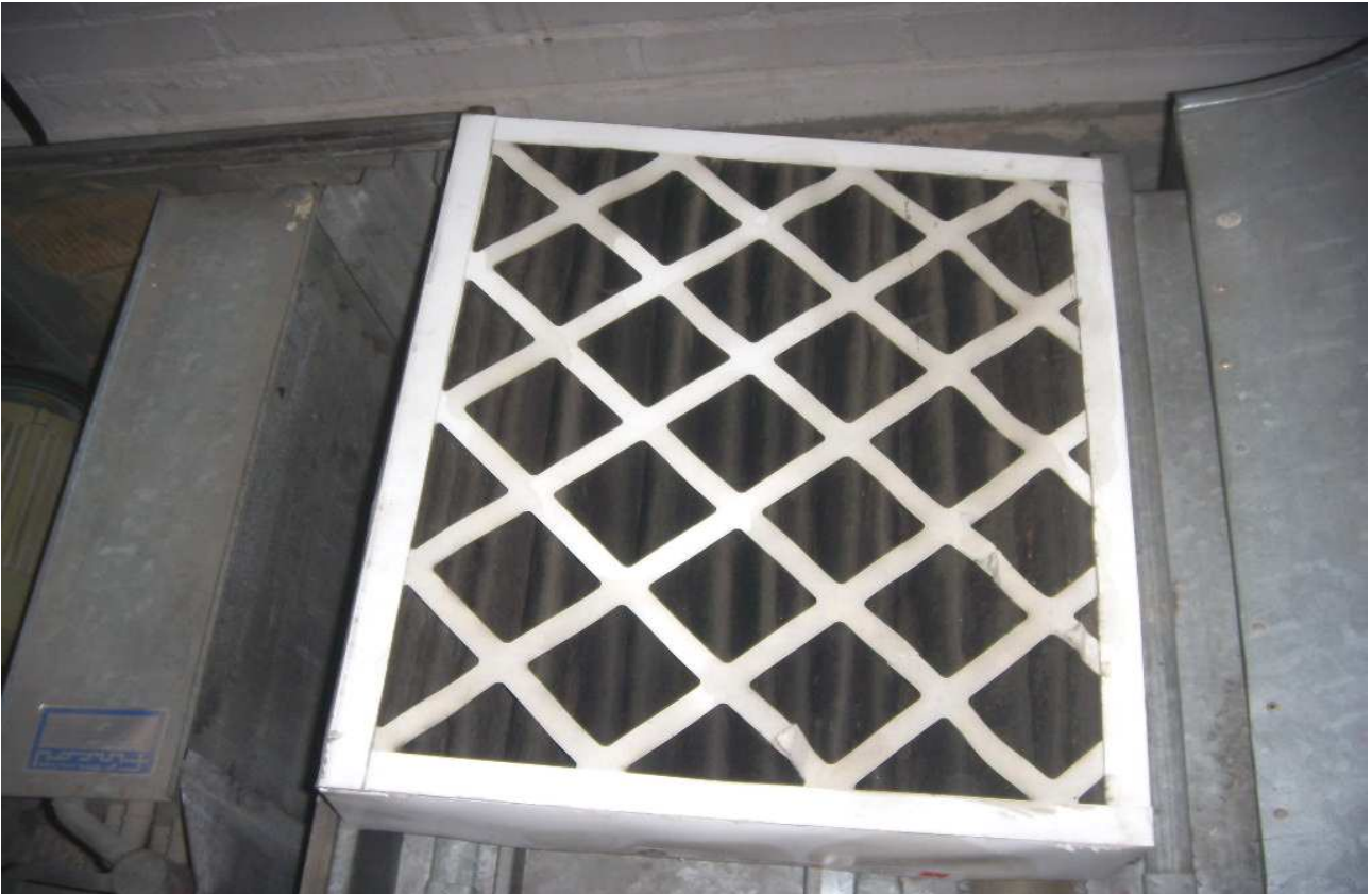
LVI-kuva 10. Yleiskuva päiväkodin tuloilmasuodattimesta.
