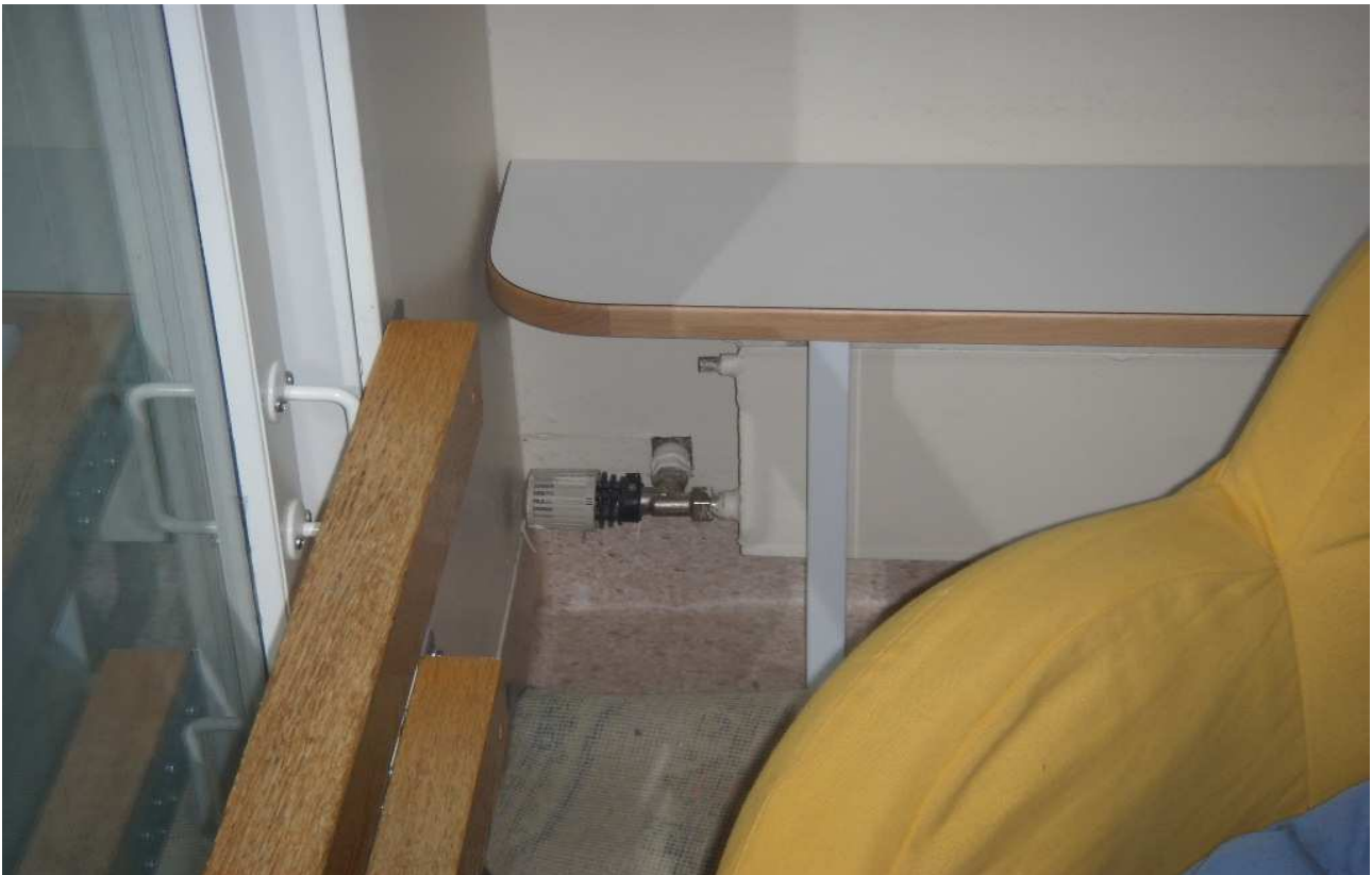
LVI-kuva 3. Yleiskuva patteriventtiilistä.
