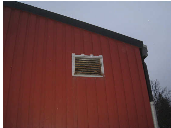
Kuva 26 Ilmanottosäleikköä ei ole suojattu.
