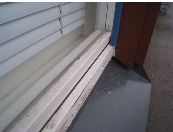
Kuva 13 Ikkunan alalista kaareutuu irti karmista, jolloin sadevettä voi päästä ulkoseinärakenteeseen.
