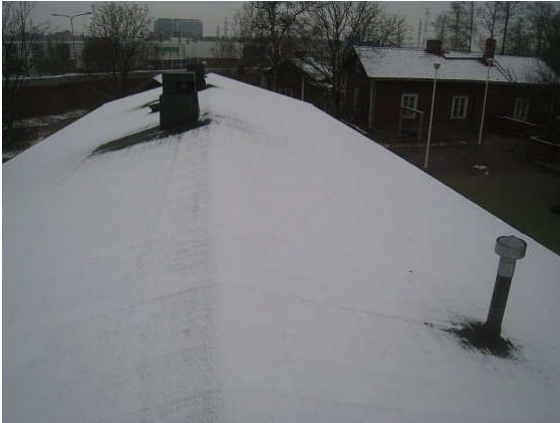
Kuva 15 Puhaltimien kautta tuleva lämmin ilma on sulattanut lunta.
