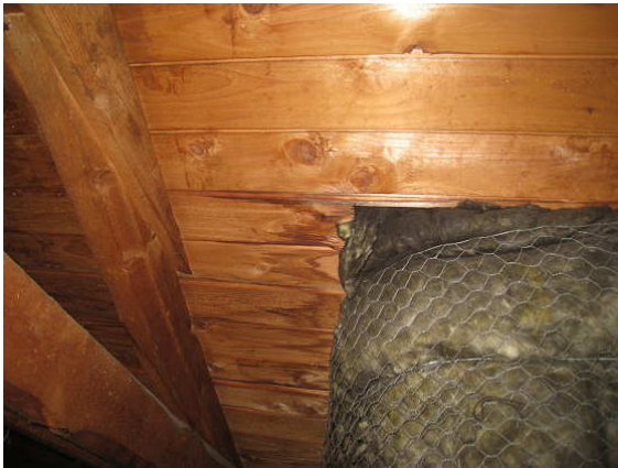
Kuva 17 Läpiviennin kohdalla aluslaudoituksessa vesijälkiä
