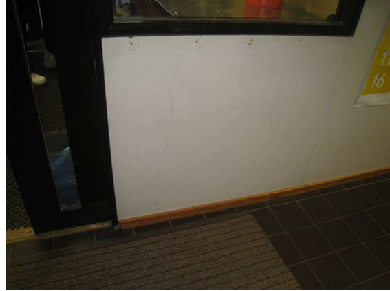
Kuva 10 Lastulevyssä kosteuden aiheuttamia kupruja.
