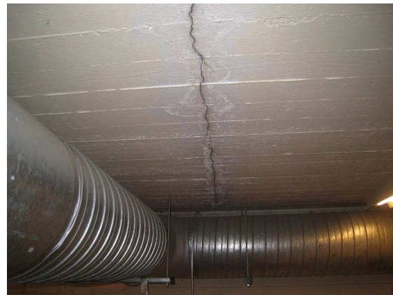
Kuva 8 Varaston 009 katossa poikittaissuuntainen halkeama.
