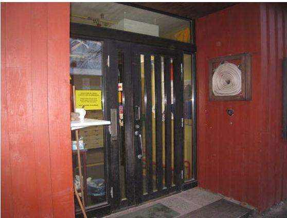
Kuva 11 Ulko-oven maalipinnat ovat kuluneet.
