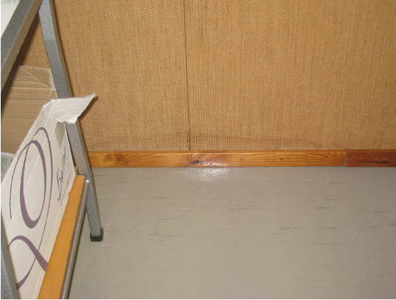
Kuva 9 Sisäverhousseinälevyn alaosalla todennäköisesti siivousveden aiheuttamia jälkiä.
