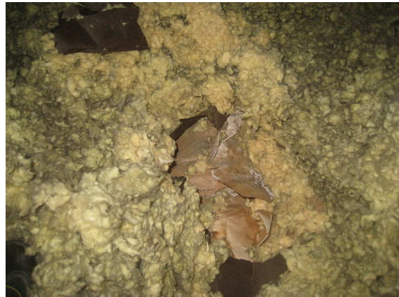
Kuva 18 Puhallusvillan ja mineraalivillan välissä eristyspaperia, jossa kosteuden aiheuttamia jälkiä.
