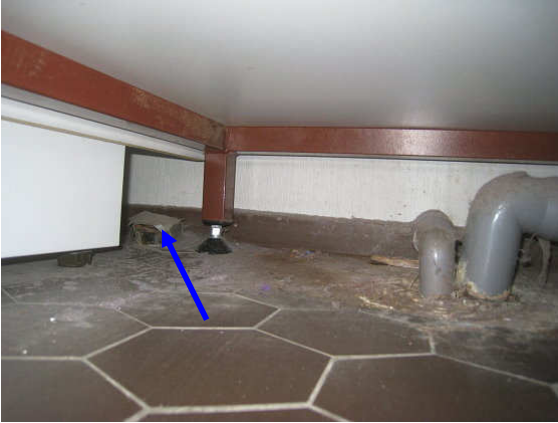
Kuva 27 Teipillä tulpattu viemärin pää. Pölyä kalusteiden alla pyykink. tilassa 2.
