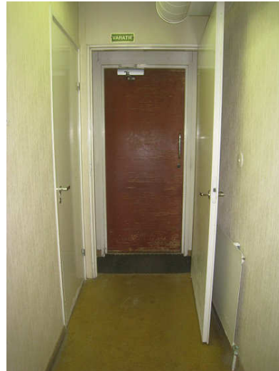
Kuva 12 Keittiön ulko-oven sisäpinnat maali hilseilee voimakkaasti.
