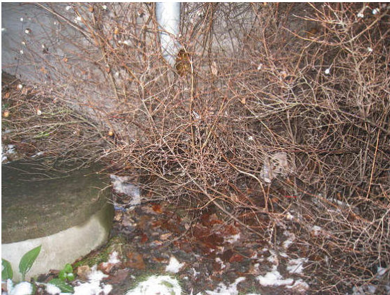
Kuva 3 Alapihalla rännivettä roiskuu loiskekivien ohi. Kouru on lyhyt.
