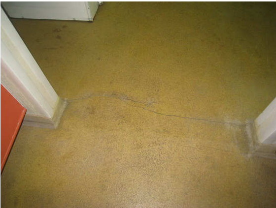
Kuva 23 Keittiön massalattiassa halkeama.
