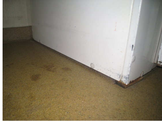
Kuva 22 Perkaustilan 13 kylmäkaapin alla kosteusvaurioituneet korokepalat.
