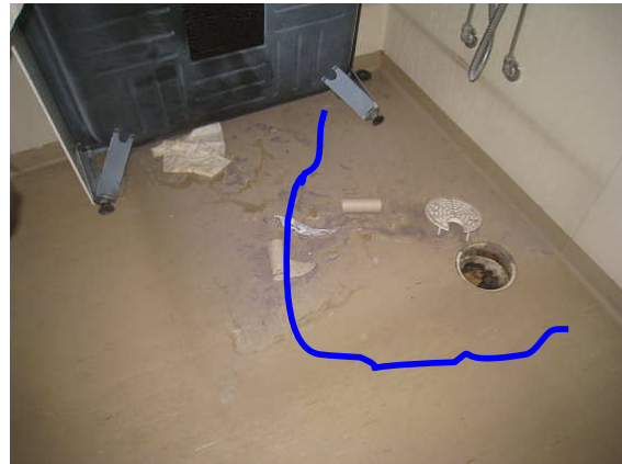
Kuva 24 Suihkunurkan kohdalla lattiassa koholla olevia pintakosteuksia.
