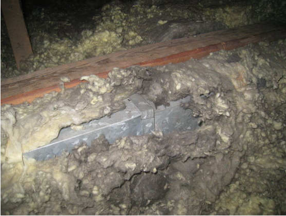
Kuva 21 Runkokanavan eristys osin puutteellinen.
