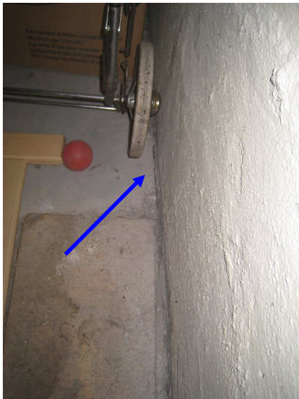
Kuva 7 Varastossa 009 lattian ja seinän välissä rako.
