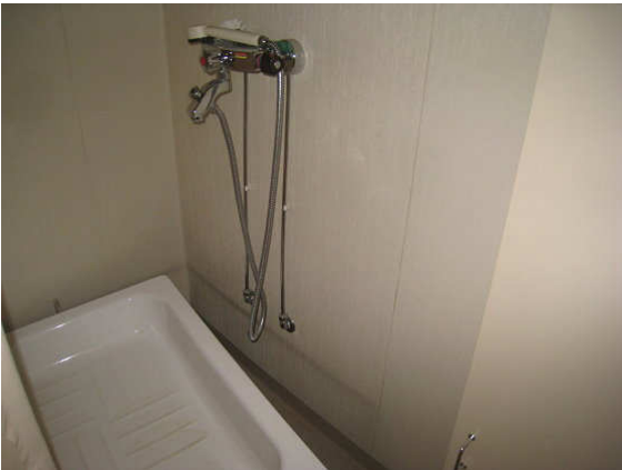
Kuva 25 Suihkusekoittajan alapuolella seinässä kohonneita pintakosteuksia.
