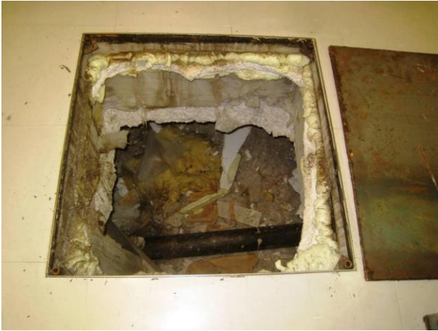
Kuva 3 Tiivistämätön luukku alustatilaan.
