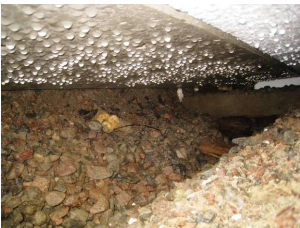
Kuva 10 Sokkelielementin alapinnassa kondenssia.
