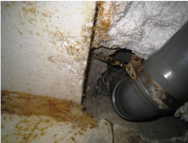
Kuva 22 Viemäriputkien läpivientejä ei ole tiivistetty.
