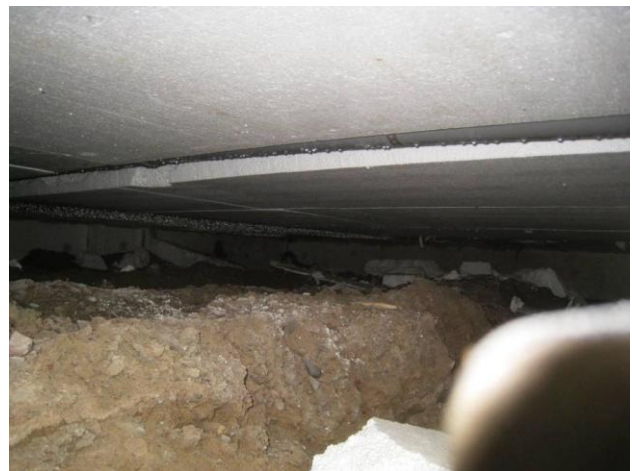
Kuva 13 F-osalla savea ja alustatilan korkeus on alle 400 mm. Polystyreenilevyä irtoamisillaan ontelolaatan alapinnasta.
