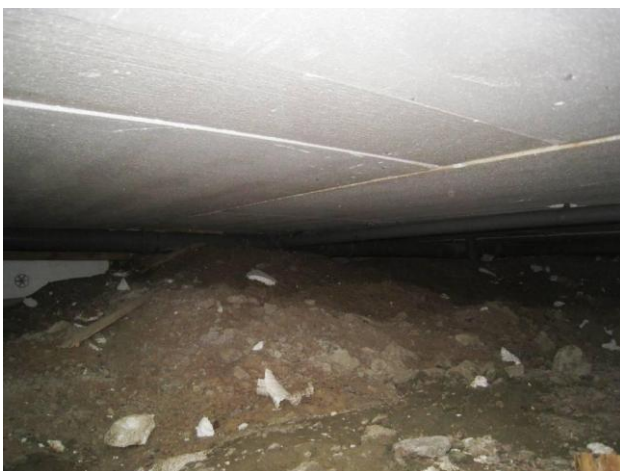
Kuva 14 D-osan keskilinjalla olevan perustuspalkin eteläpuolella täyttöä ei ole tasoitettu.
