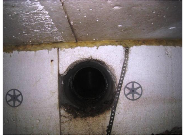
Kuva 7 Korvausilmaputki. Ontelotaatan alapinnassa kondenssia.
