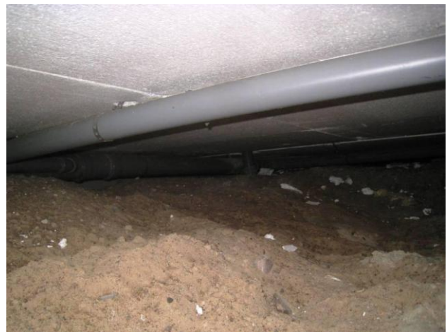
Kuva 19 Viemärit lepävät D-osalla osittain myös täyttökerroksen päällä.
