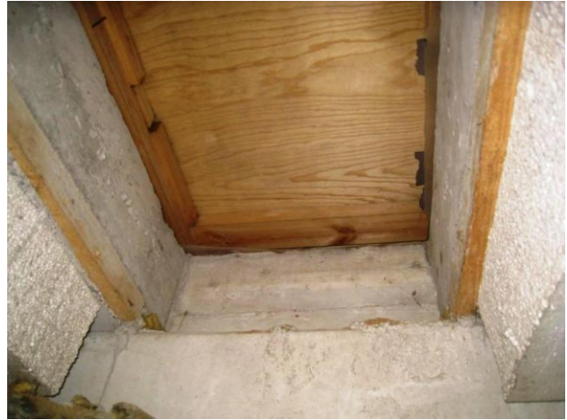
Kuva 4 Liikuntasalin kohdalla ontelolaatassa kulkuaukko. Päällä on vanerilevyä.
