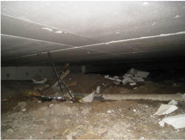
Kuva 16 Salaojaputkea osittain näkyvillä.
