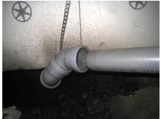
Kuva 23 Selvityshetkellä huomattu avoin liitos, joka korjattiin ASB-Consult Oy:n toimesta.
