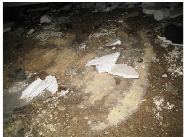
Kuva 15 F-osalla selvää mikrobikasvustoa. Vastaavaa ei havaittu muualla.
