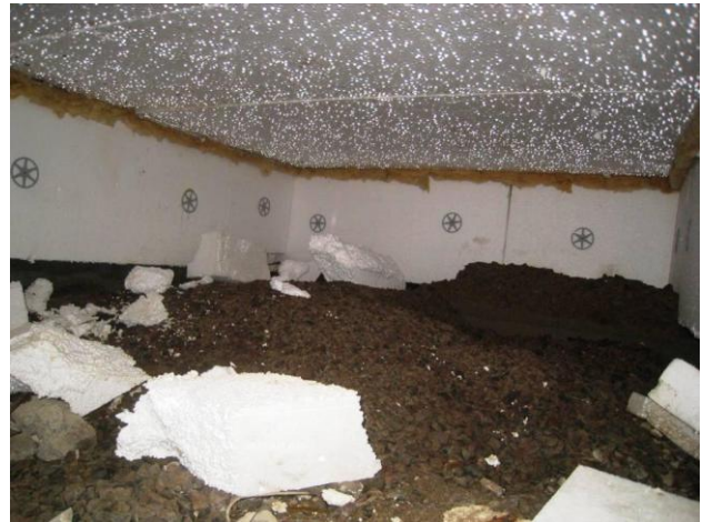
Kuva 9 Ontelotaatan alapinnassa kondenssia. Täyttö kostea.
