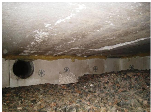
Kuva 11 B-osan päädyssä sokkelielementin alapinnassa ei havaittu kondenssia.
