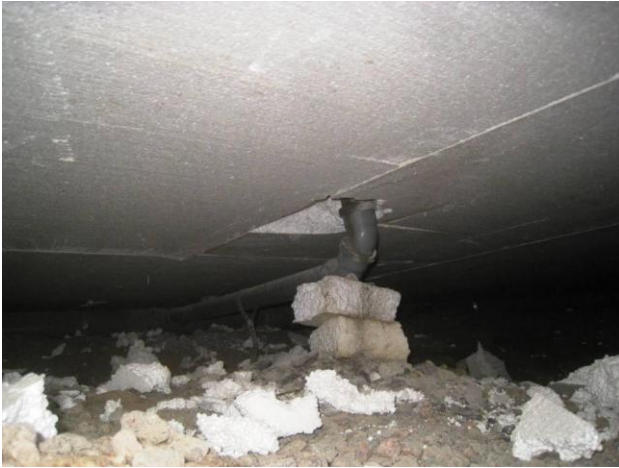
Kuva 20 Viemäriin kannakointi pettänyt. Tuettu polystyreenilevyn kappaleilla,
