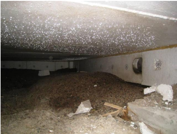
Kuva 8 Ontelotaatan alapinnassa kondenssia. Täyttö kostea.
