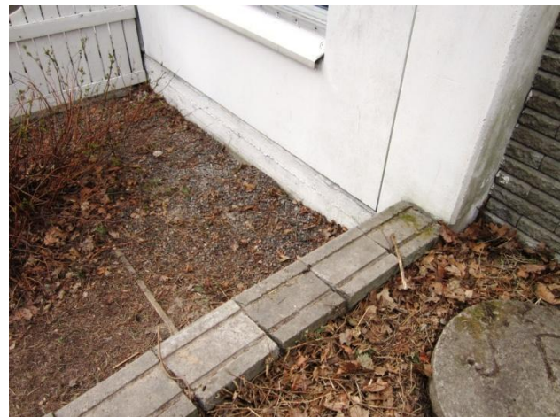
Kuva 4 Maanpinta viettää rakennukseen päin.
