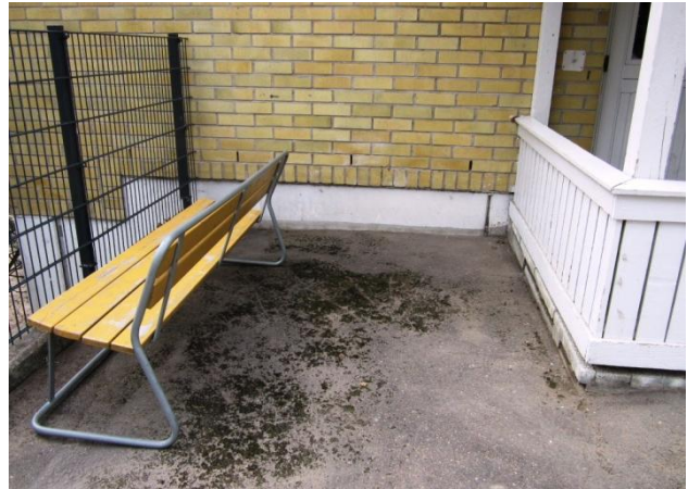
Kuva 6 Maanpinta viettää rakennukseen päin.
