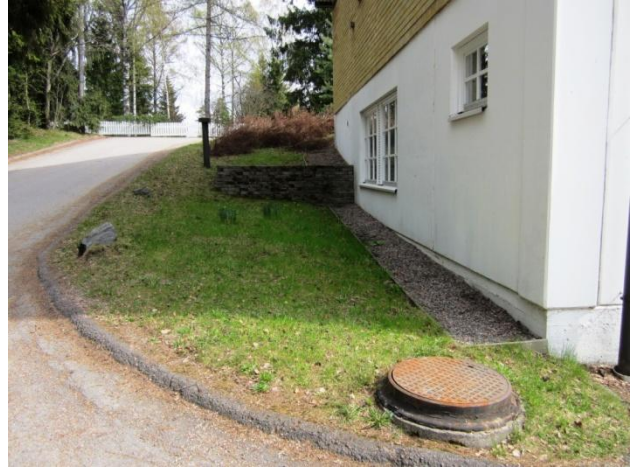
Kuva 12 Rakennusvierellä sepeliä. Nurmialue kaataa rakennusta päin.
