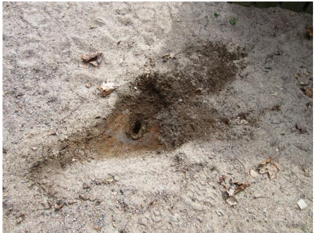
Kuva 8 Sadevesikaivo tukittu hiekalla.
