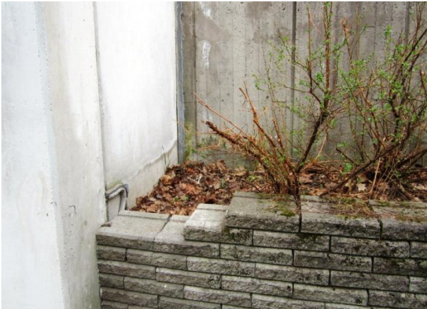
Kuva 5 Maanpinta viettää rakennukseen päin.
