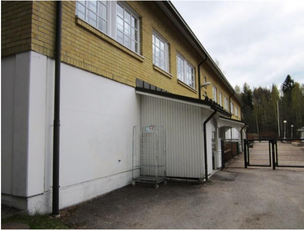
Kuva 1 Pinta viettää rakennukseen päin asfaltoidulla kohdalla. Reunamakkaraa ei ole.
