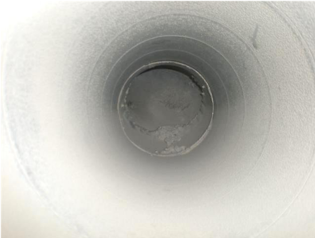
Kuva 2. Erittäin likainen poistokanava.
