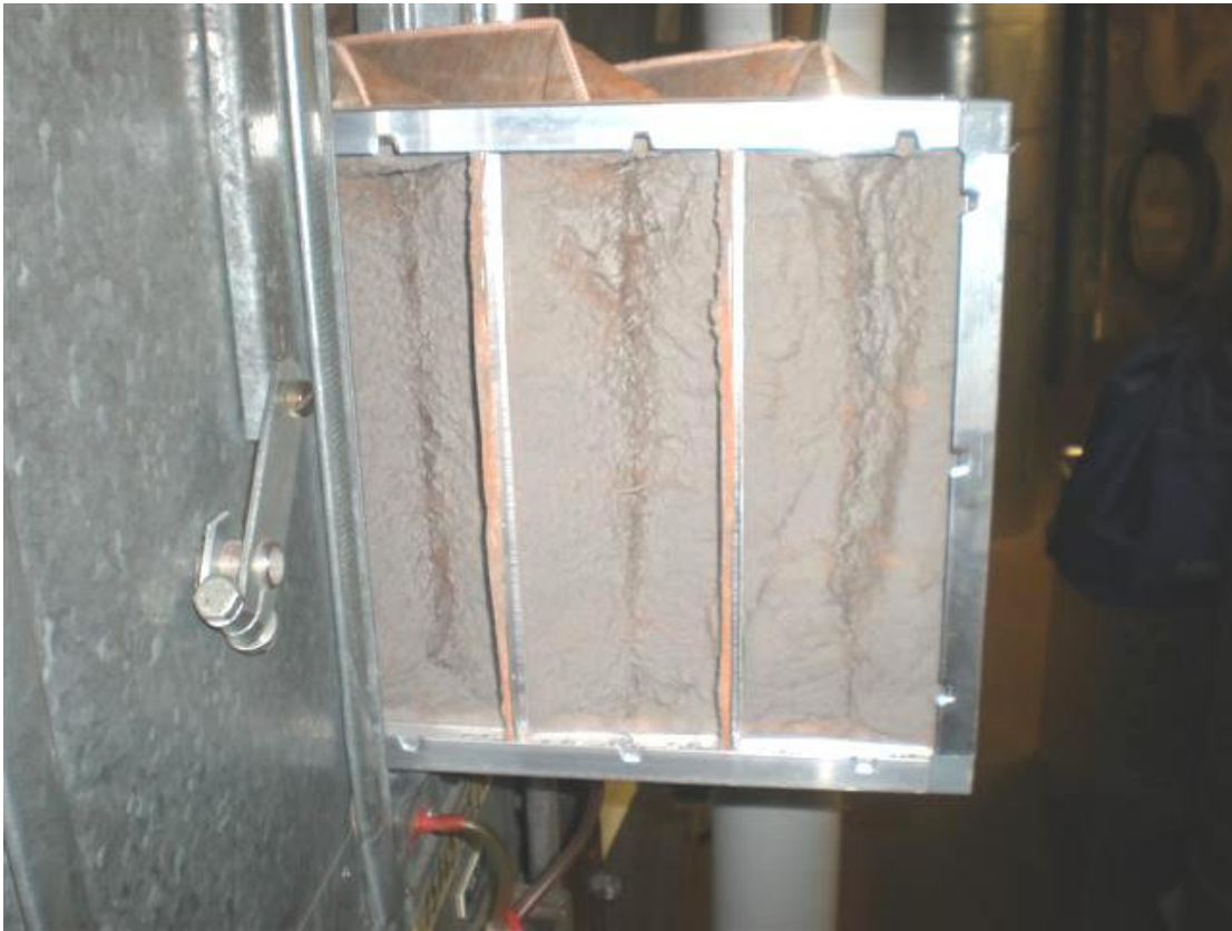
Kuva 1. Poistoilmakoneen PP1.1 suodatin.
