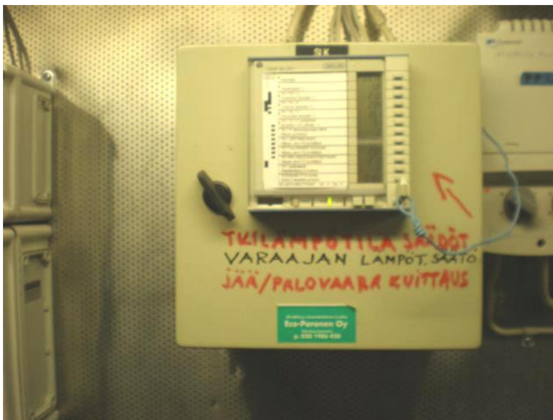
Kuva 6. Säätokekeskus ohjaa ilmanvaihtokoneen TK1 / PP1.1 toimintaa.
