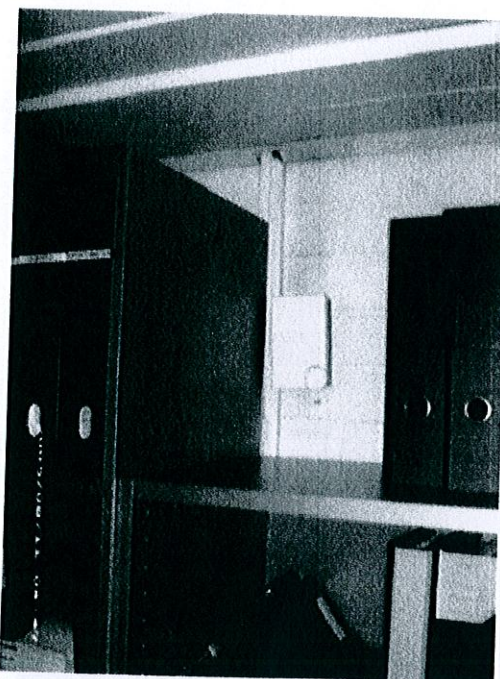
Huoneessa 405b anturi on hyllyn takana, mikä häiritsee automaattista lämmönsäätöä.
