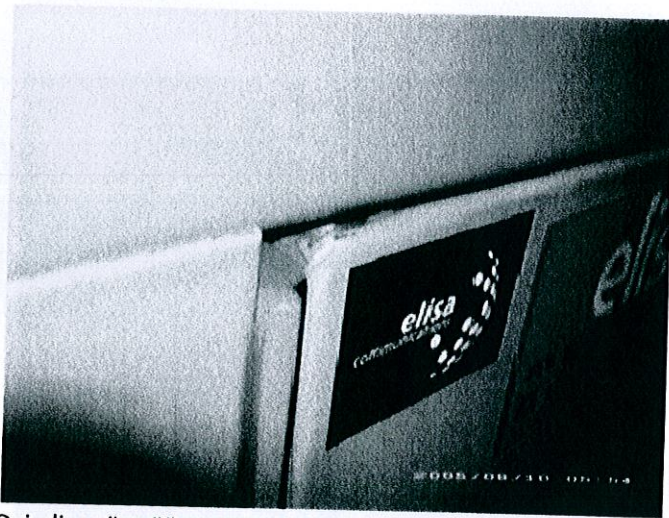
Ovi oli myös vääntynyt siten, että ovea ei voinut sulkea kokonaan. Epäsuotuisista painesuhteista johtuen konehuoneesta voi kulkeutua epäpuhtauksia työtiloihin.
