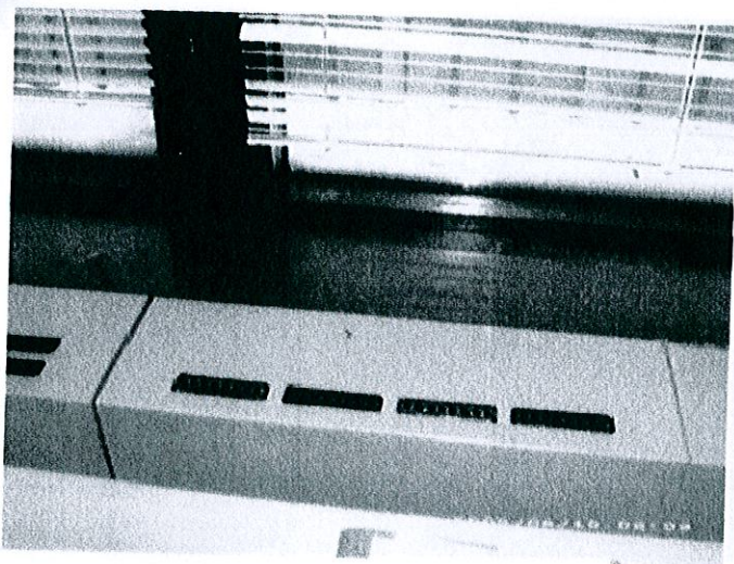
Työhuoneisiin ohjataan tuloilma huoneiden päädyssä olevien penkkien kautta. Käytössä on edelleen kaksi rinnakkaista tuloilmakanavaa, sillä aiemmin lämmin ja viileä ilma sekoitettiin huonekohtaisesti vasta penkissä.
