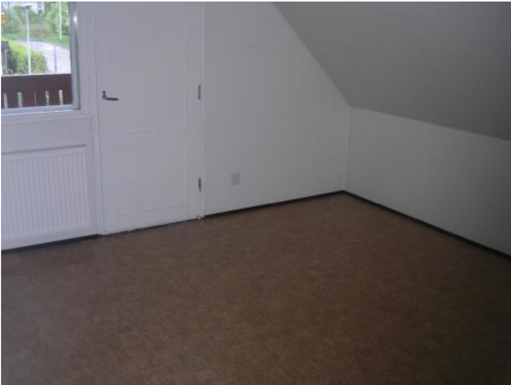
Yläkerran huonetta. Yläkerrassa on vinoja kattoja, joiden tuuletus on puutteellinen lämmöneristeen ja aluskatteen välistä
