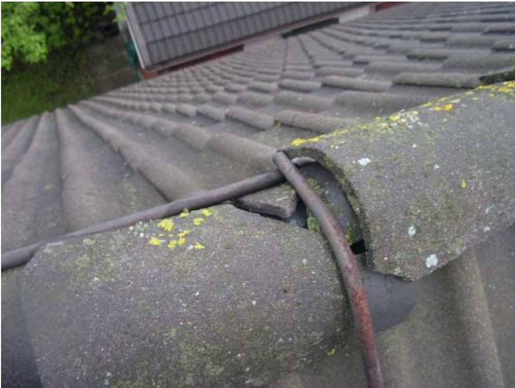
Lapetikkaiden päät ovat tiilien päällä ja ne ovat rikkoneet harjatiiliä. Lapetikkaiden kiinnitys tulee uusia samoin rikkoutuneet tiilet
