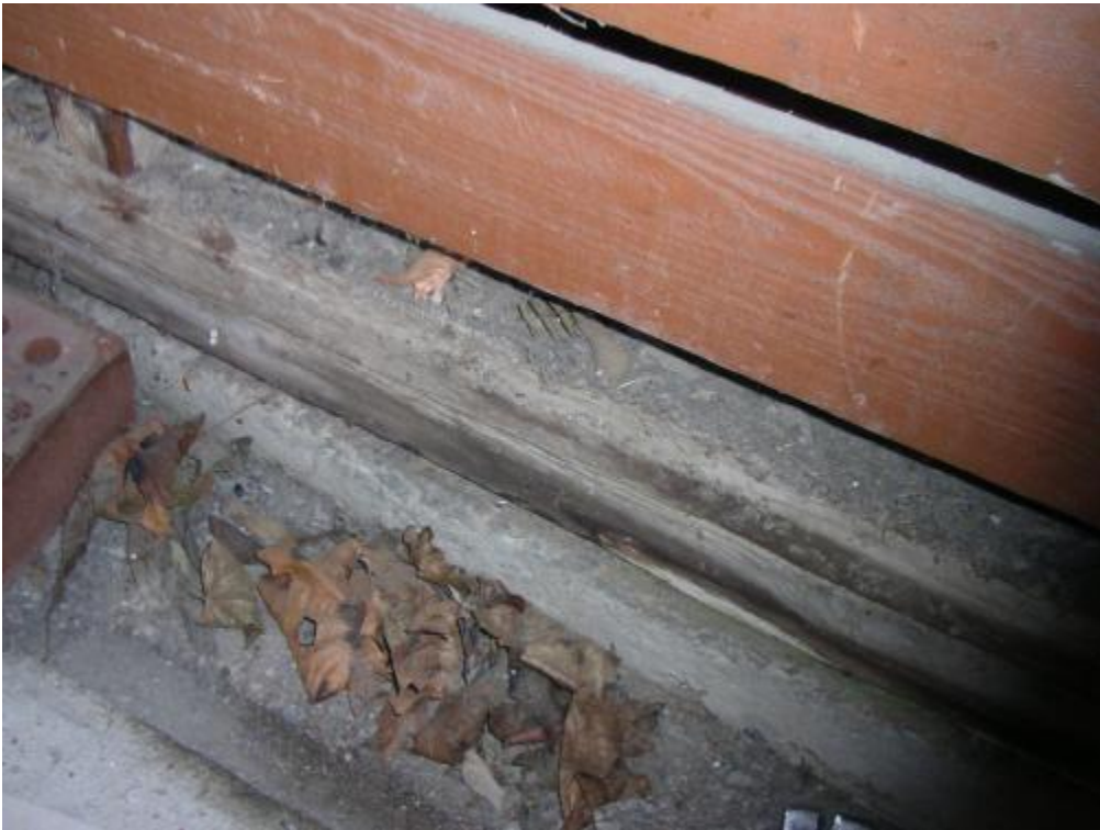
Autokatoksen puolelta seinän alajuoksu on kosteuden vaurioittama
