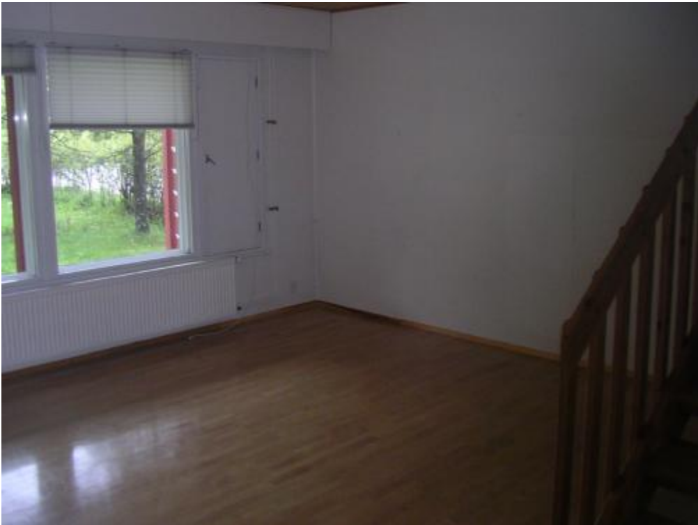
Asuinrakennus oli tarkastushetkellä tyhjillään
