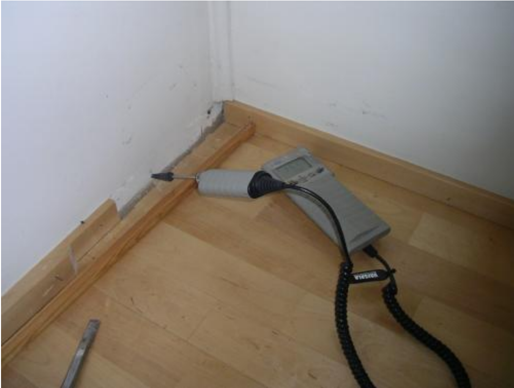
Takanurkan makuuhuoneen lattiasta mitattiin suhteellinen kosteus lattian rajasta
