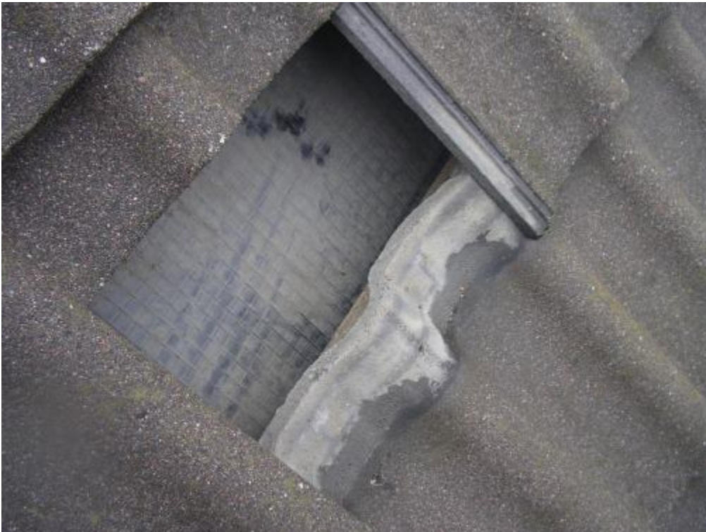
Tiilikatteen alla on aluskate. Korotusrimoja ei ole rakennusajalle tyypillisesti
