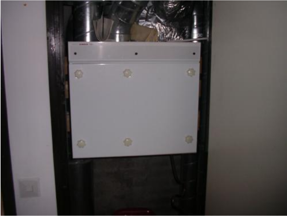
Rakennukseen on asennettu ilmanvaihtokone jälkeinpäin, kone on yläkerrassa
