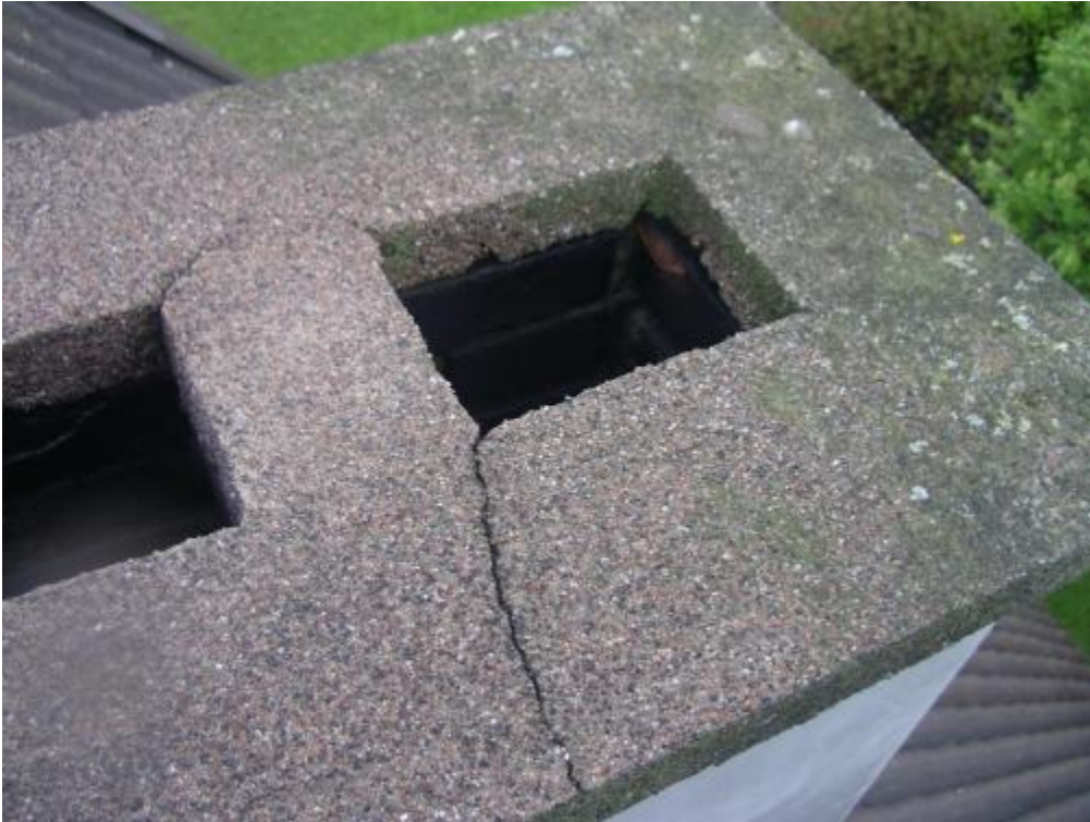
Hormin lakivalu on halkeillut eikä hormissa ole sadehattua. Lakivalu tulee tarvittaessa uusita ja hormiin suositellaan lakivalun asentamista
