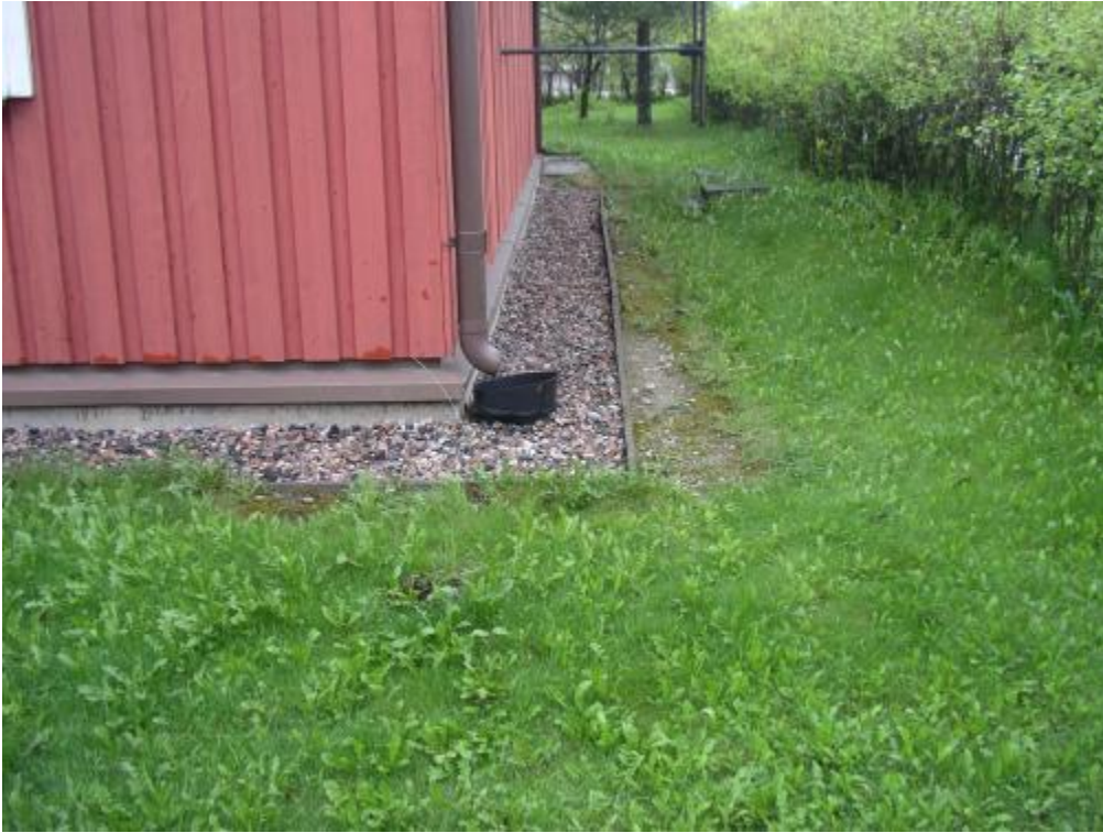
Asuinrakennuksen ympärille on asennettu sepeliä ja maanpinnat on muotoiltu rakennuksesta pois päin viettäviksi tai ovat tasaiset
