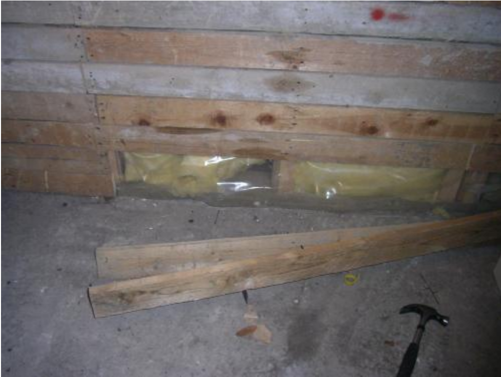
Varaston takseinä on osin kosteuden vaurioittama
