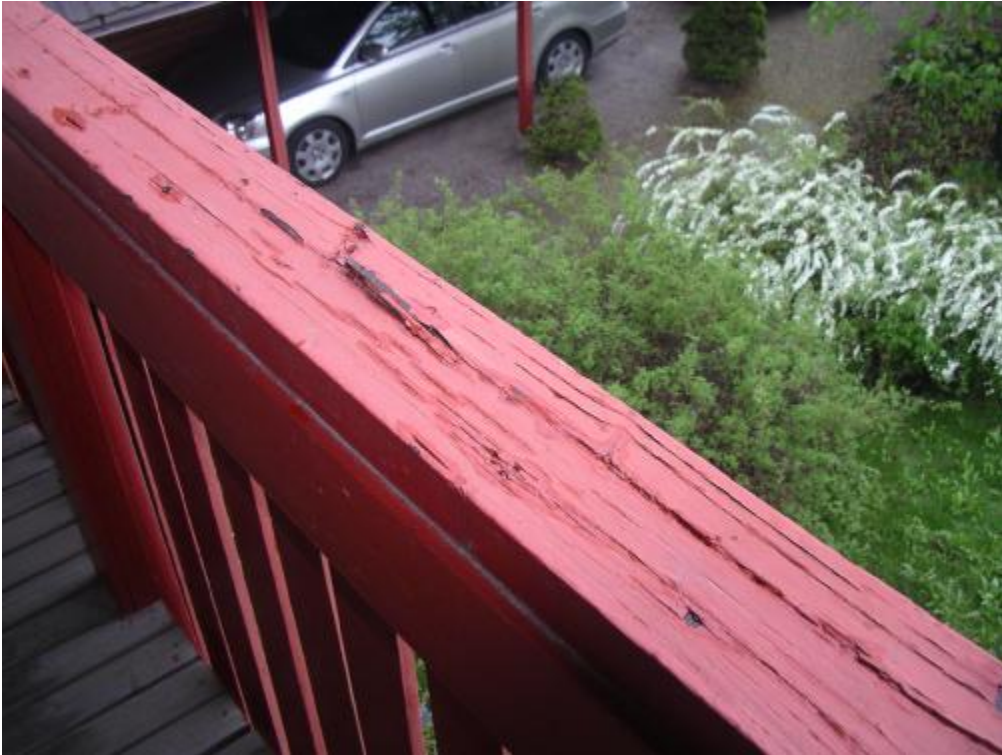
Parvekkeen kaiteen yläpuu alkaa iän kulutuksesta vaurioitua
