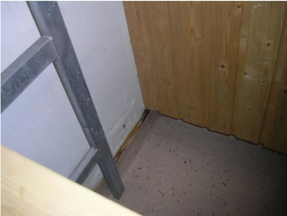
Saunan lattian muovimaton reunan tiiveys on puutteellinen ja se mahdollistaa veden pääsyn rakenteisiin
