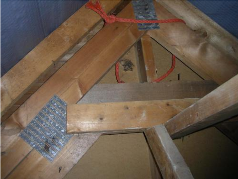
Ullakon päätyjen ilmaraoit ovat puutteelliset. Päätyihin suositellaan suurempien ilmarakojen tekoa
