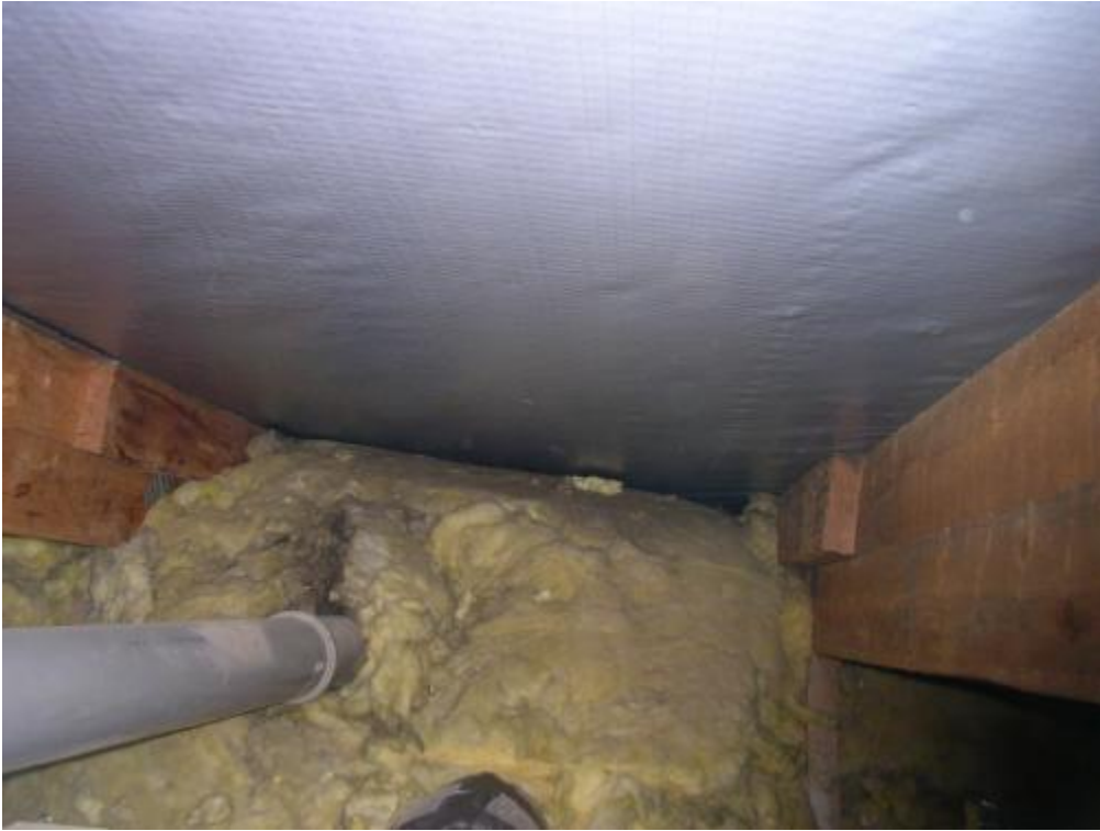
Yläpohjan vinojen osien ilmarako on lähes ummessa, jonka vuoksi vinojen osien tuuletus on puutteellinen
