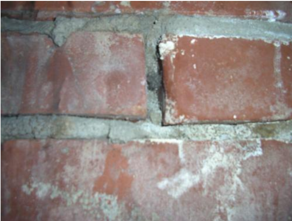
Hormin yläosassa ei ole slammausta vesikattoon asti ja saumoissa on koloja. Ullakolla hormi tulee slammata määräyksien mukaisesti ja ennen pinnoitusta tulee hormin saumat korjata
