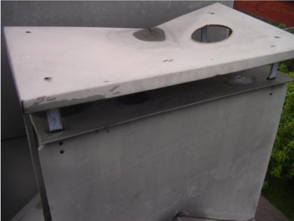
Ilmanvaihto kanavien sadehattu on vaurioitunut, se suositellaan uusittavan
