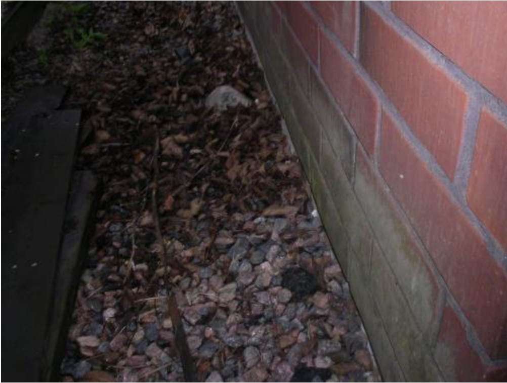
Varistorakennuksen takaseinä on alaosastaan kosteuden vaurioittama
