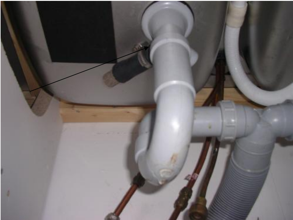
Keittiön vasemman puoleisen altaan poistoputki viemäriin vuotaa liitoskohdasta
