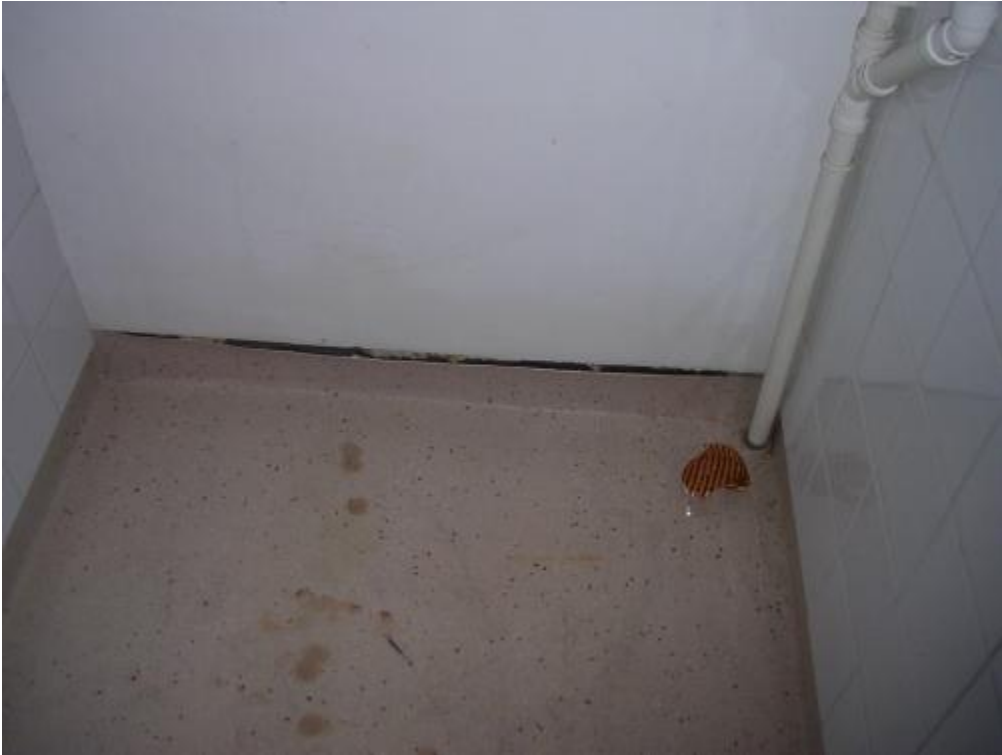
Pesuhuoneen lattiamaton reunojen kiinnitys on puutteellinen, jonka vuoksi tila tulee remontoida ennen suihkukäyttöä
