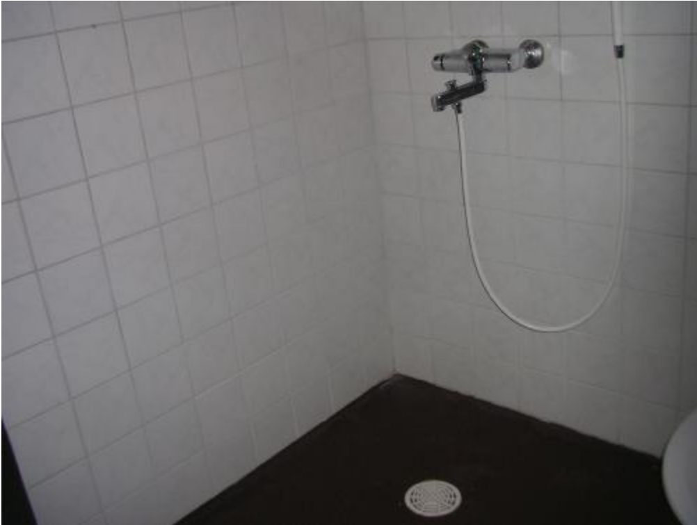
Suihkunurkan kohdalla lattiamatto on tiivistetty laatoitukseen laastilla, joka ei ole vesitiivis liitos. Ennen tilan käyttöä suihkutilan tulee tila remontoida
