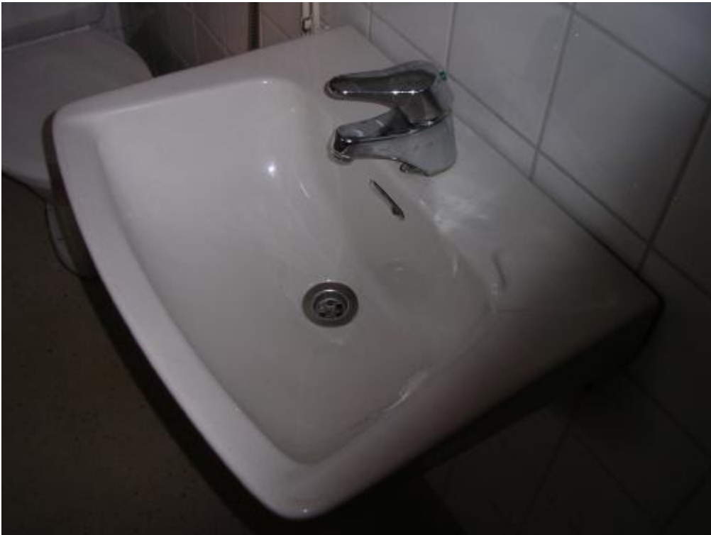
Pesuhuoneen altaassa on halkeamia
