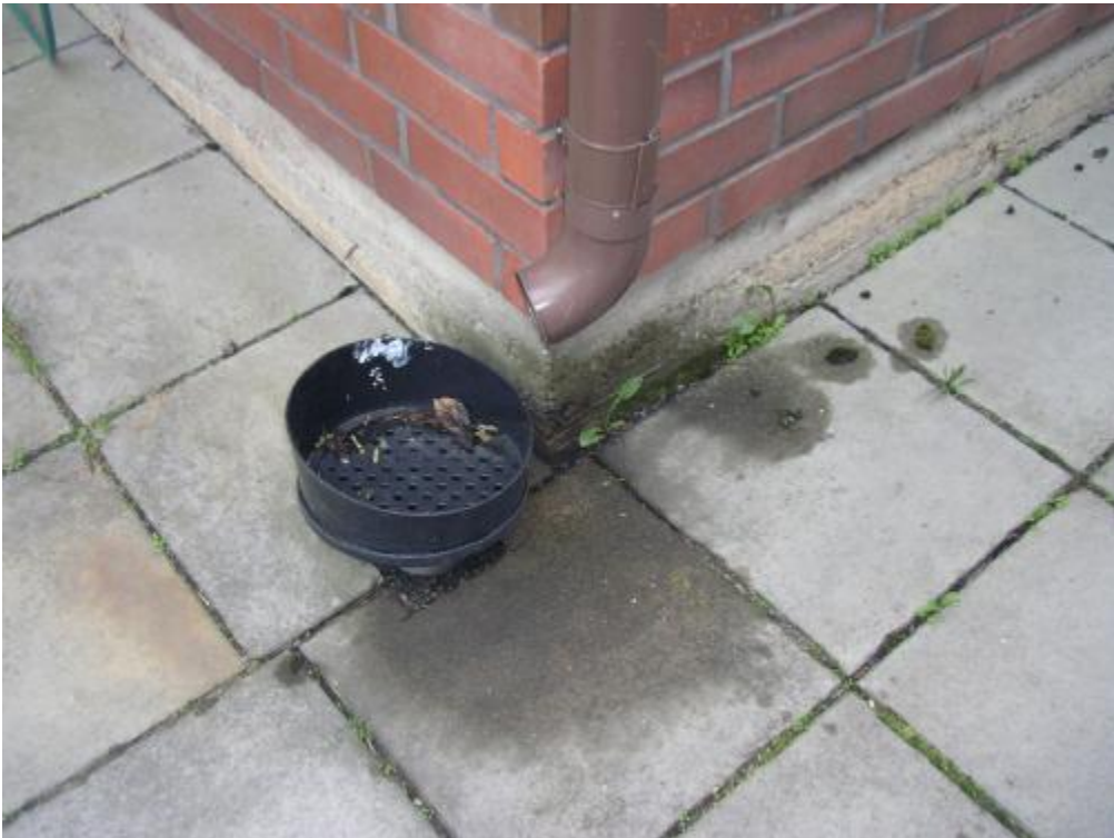
Sadevedelle asennettu loiskekaivo ei ole syöksytorven alla kunnolla ja vedet kastelevat seinää
