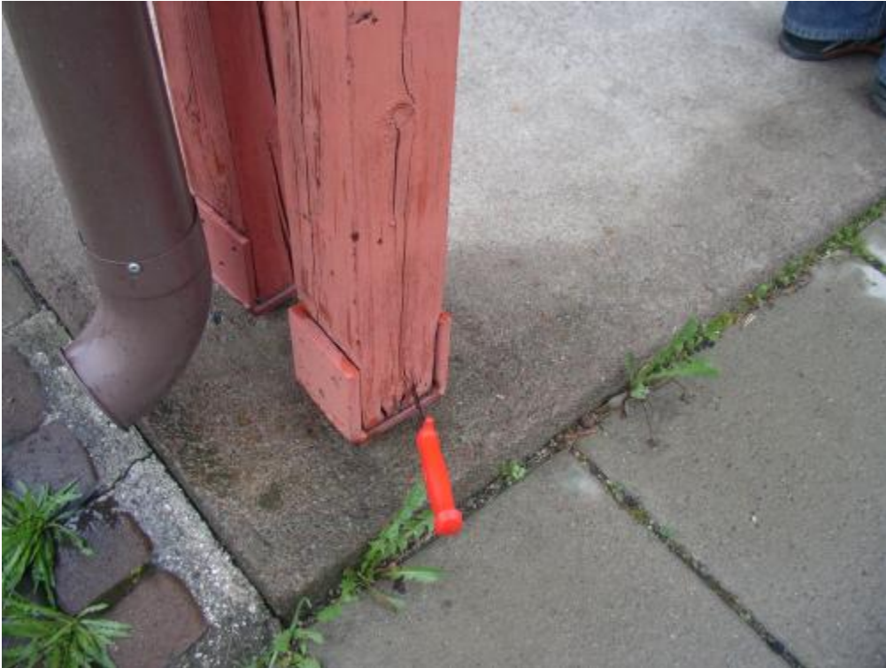
Asuinrakennuksen parvekkeen pilareiden alapäävät eivät ole kiinnitetty ruuveilla / pulteilla. Puupilareiden alapäässä on tapahtunut puunlahoamista, joka tulee jatkossa huomioida.
