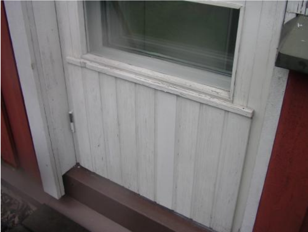
Puuvien ulkopinnat ovat sääolojen kuluttamat ja vaativat huoltomaalausta
