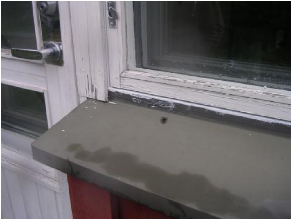
Ikkunoiden puitteet ovat sääolojen kuluttamat ja vaativat huoltomaalausta
