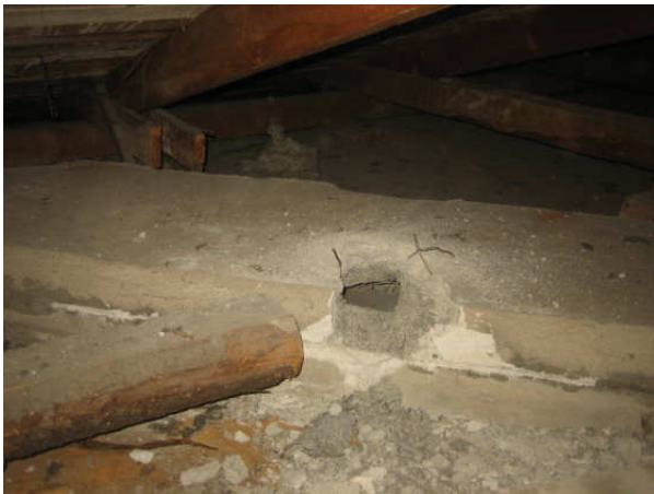
Kuva 7 Avattu vanha rakennusaineinen poistokanava, jossa käy vahva ilmavirta.
