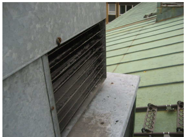
Kuva 16 Väärään suuntaan kallistetut lamellit, joiden kautta voi päästä vettä.
