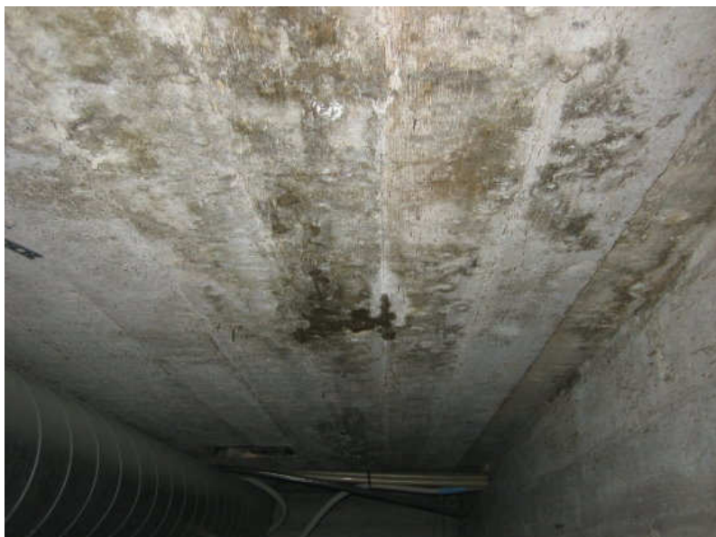
Kuva 4 Irrotettujen peltilamellin kohdalta nähtiin huuvan vuotokohtaan, jossa yläpohjan ylälaattapalkiston läpi tippui vettä..
