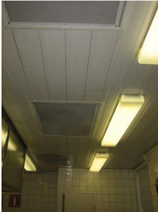
Kuva 1 Kuvan keskellä olevan IV-säleikön reunoilta tippui 8.10.2007 vettä..
