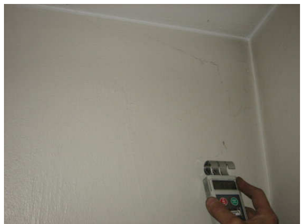
Kuva 10 Porrashuoneen yläosassa ulkoseinä ja väliseinä ovat piipun vieressä selvästi kosteat. Vaurioita ei vielä näy. Rappauksessa voi silti olla mikrobikasvua.
