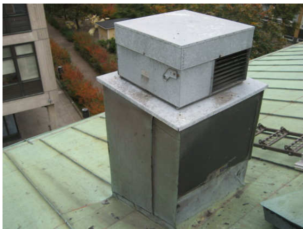
Kuva 15 Keittiön poistopuhallin ja IV-piippu.
