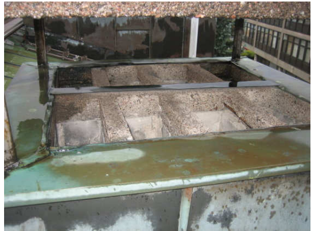
Kuva 14 Tuuletushormeihin pääsee sadevettä.
