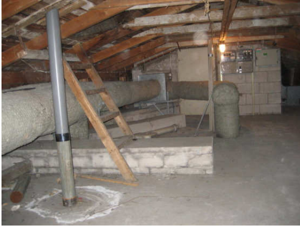
Kuva 5 Yleiskuva ullakolta porrashuoneen suunnasta IV-konehuoneen suuntaan. Vasemmalla on viemärin tuuletusputki eristämättä.
