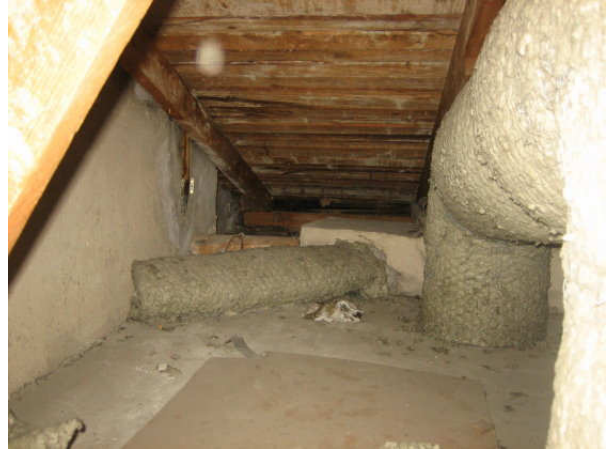
Kuva 6 Porrashuoneen ja ullakon/ keittiön välinen seinä ja piipun vuotoaurkaus..
