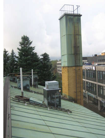
Kuva 12 Yleiskuva vesikatolta, jossa keskellä on keittiön poistokanavan piippu. Vanhan savupiipun tikkaat ovat huonot, samoin piipun katos.
