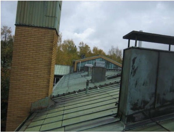
Kuva 11 Yleiskuva vesikatolta itään. Piipun oikea sivu, eteläsivu, on rapautunut saumoistaan.
