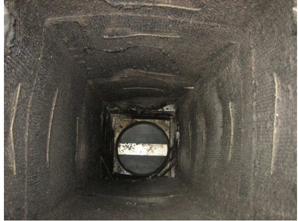
Kuva 18 IV-piipun rakennusaineinen kanava, joka on vuorattu villalla. Villan pinta on rasvan peitossa. Pohjalla on huuva.
