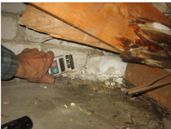
Kuva 9 Piipun lähellä porrashuoneen ja ullakon välinen seinä ja lattia on selvästi kostea. Räystäään lähellä aluslauditus on laho ja kostean tuntuinen.
