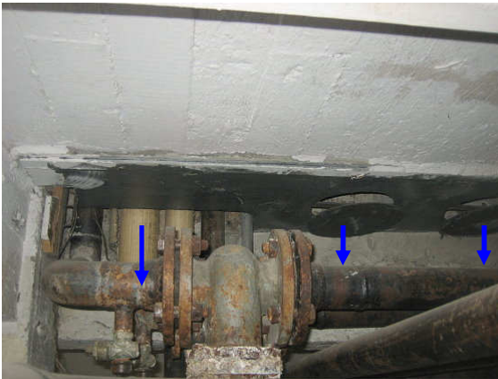
Kuva 3 Putkihormin ja IV-venttiileiden kautta virtaa ilmaa VSS-tilaan.
