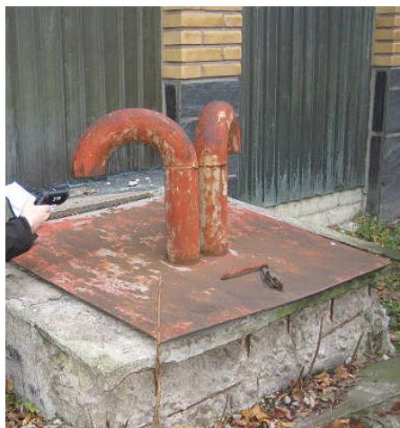
Kuva 5 VSS-tilan varauloskäynti sisäpihalla. Heikko ilmavirtaus ulospäin
