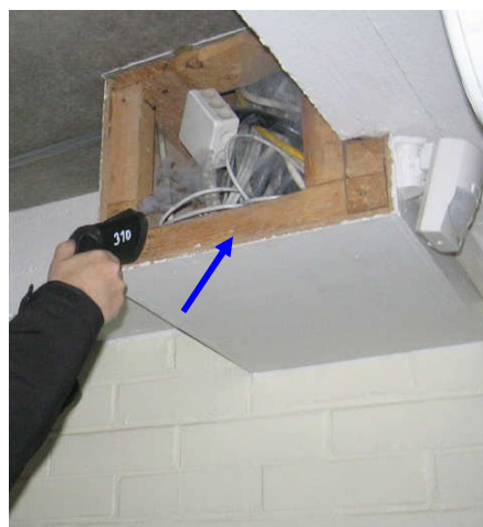
Kuva 6 Tila 041. Voimakas ilmavirtaus koteloon/ hormiin.
