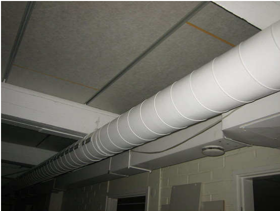
Kuva 9 Pyöreää tuloilmakanavaa ja suorakaiteen muotoista poistoilmakanavaa.
