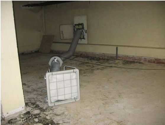
Kuva 1 VSS-tilan alipaineistuslaite. Poistoilma johdetaan putkella varauloskäytävään.
