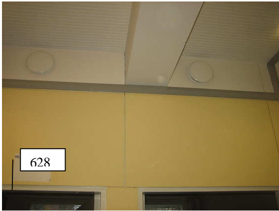
Kuva 13 Toimistohuoneiden 628 ja 629 ovien yläpuolella venttiilit. Kuva eteistilasta.
