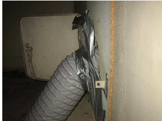
Kuva 2 Poistoilmaputken liitos kulkuaukkoon asennettuun lastulevyyn puutteellinen. Ilmaa palautuu huonetilaan.
