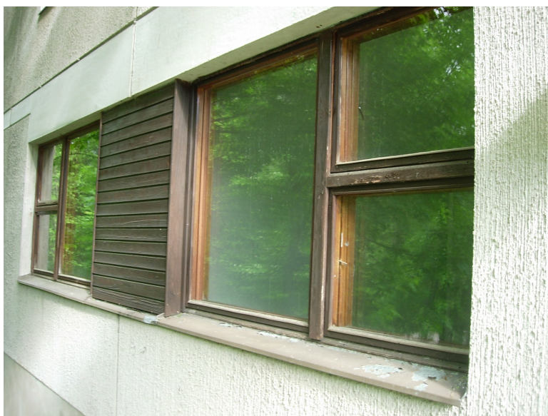
3. Kerrostalojen puupintaiset ikkunat kaipaavat huoltomaalausta kunnossapitajakson alkupuolella.
