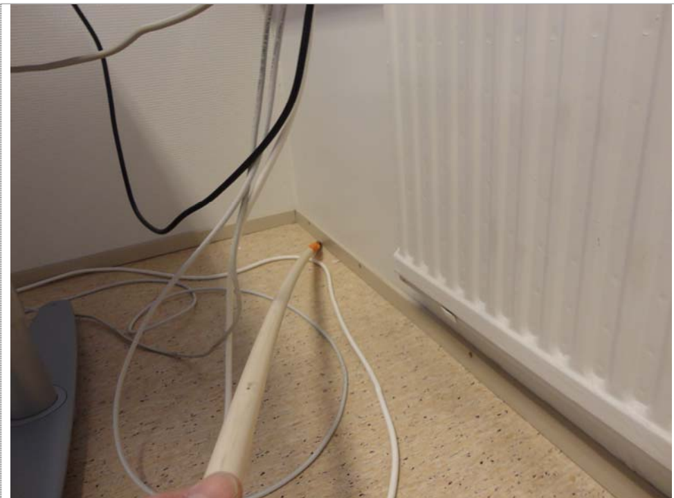
Kuva 8: Vuotokohta lattian alareunassa. (Fysik. hoito 109-2)
