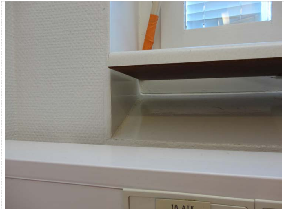
Kuva 1: Vuotokohta ikkunan pielestä. (Kanslia 172).
