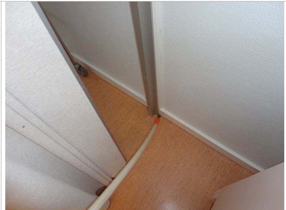
Kuva 3: Vuotokohta lattian alareunassa. (Ryhmä/Ruokailu)
