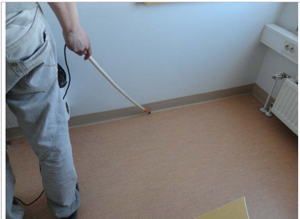
Kuva 2: Vuotokohta väliseinän alareunassa. (Kanslia 172)
