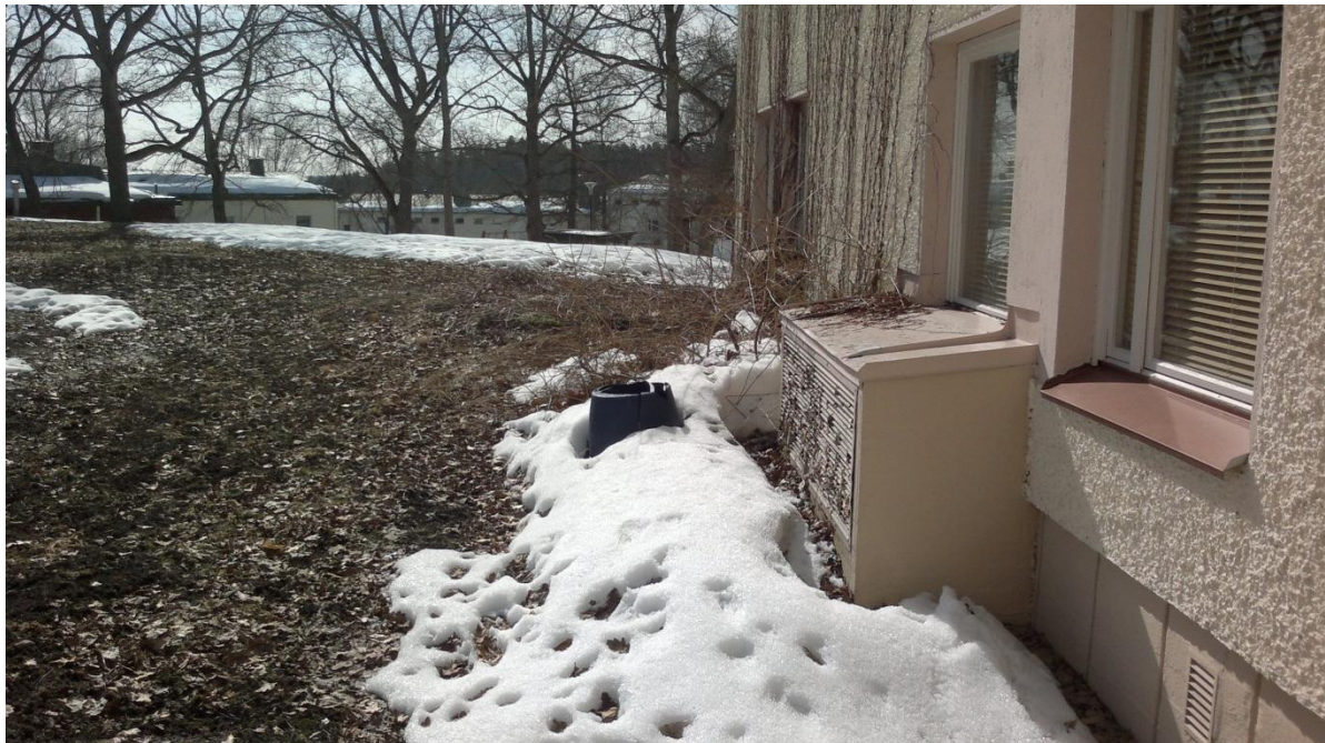
Kuva 3. Päiväsairaalan itäseinusta tuloilmakoneen raitisilmäsäleikkö on alttiina lehduille, pölylle muille maanrajan irtaimille partikkeleille
