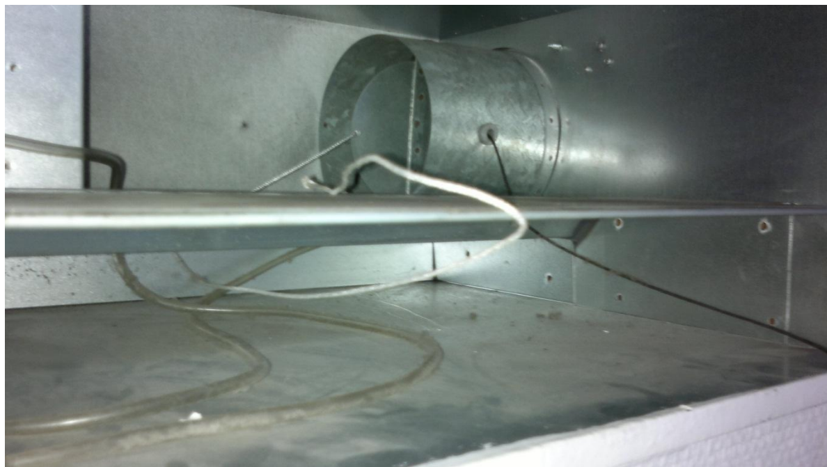
Kuva 4. Päiväsairaalan yhdistetyn tulo- ja poistoilmapäätelaitteen tuloilman säätöpelti
