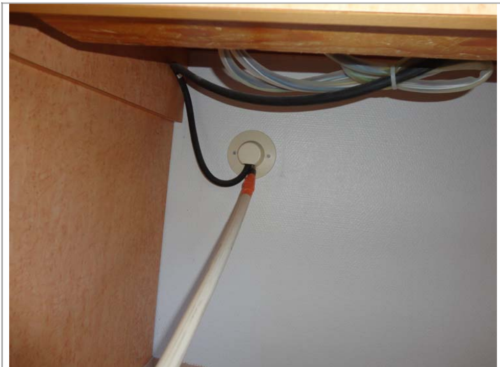
Kuva 4: Vuotokohta uunin sähköjohdon läpiviennistä. (Ryhmä/ruokailu)
