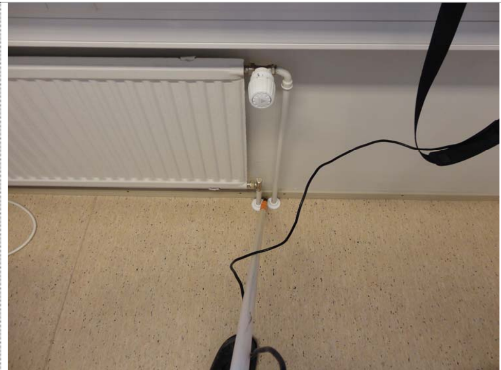
Kuva 7: Vuotokohta putkiläpiviennistä. (Fysik. hoito 109-2)
