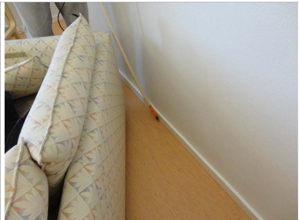
Kuva 6: Vuotokohta väliseinän sähkökourussa. (Ryhmä/ruokailu)
