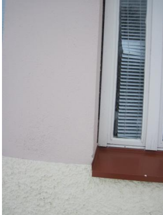
Kuva 2. Julkisivu huoneen 171 kohdalla. Ikkunan pystylistä puuttuu
