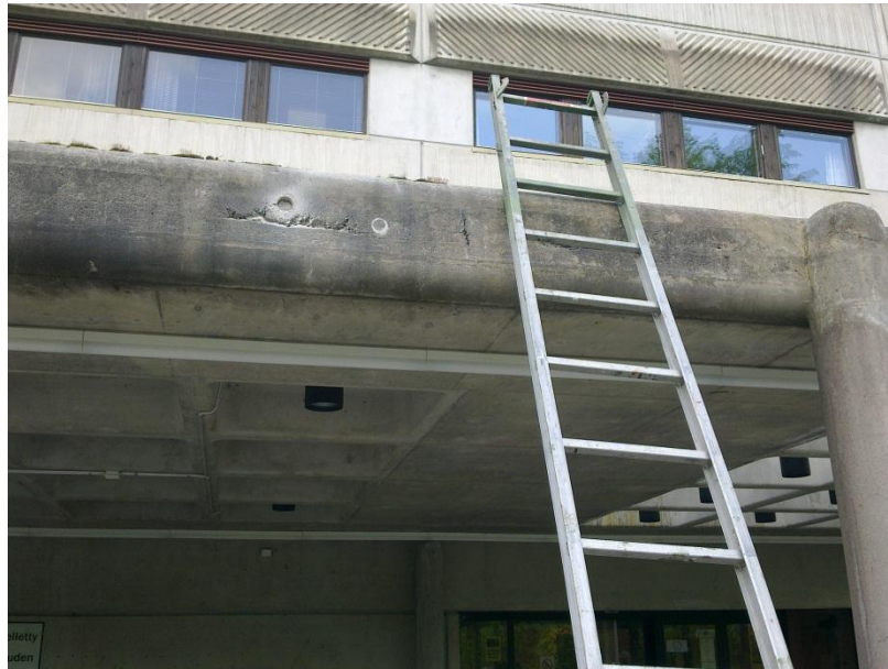
Etulipan epäonnistunut näyte korroosioaurion yläpuolelta
