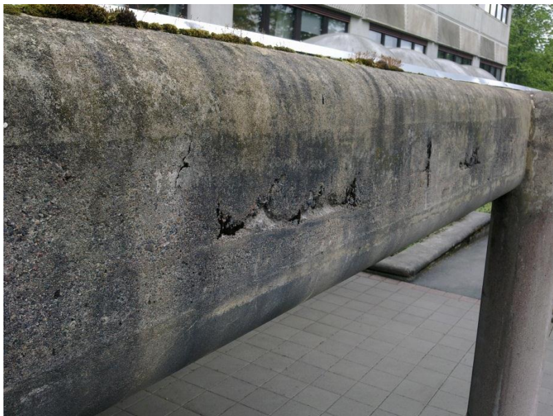
Raudat näkyvissä, huokoista ja pakkasrapautumia
