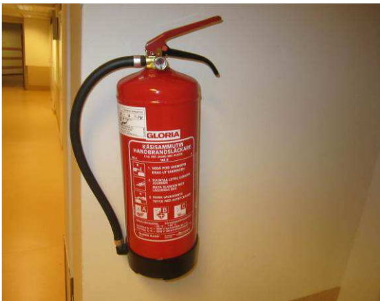
Käsisammuttimet on tarkastettu ja huollettu.
