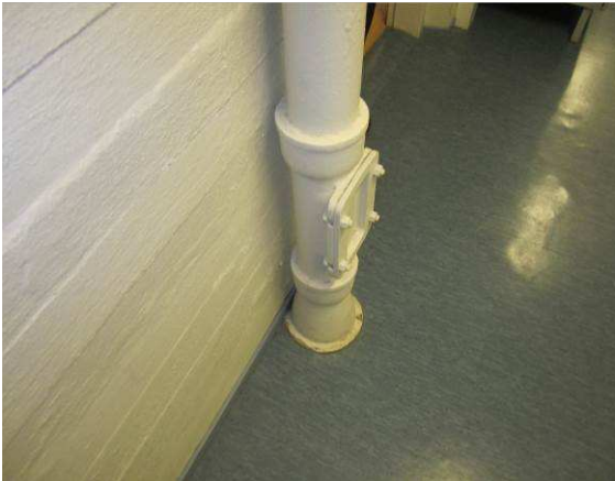
Viemärit ovat pääosin heikossa kunnossa
