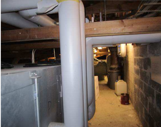
Kiinteistön uusimmat ilmanvaihtokoneet vuodelta 1991.
