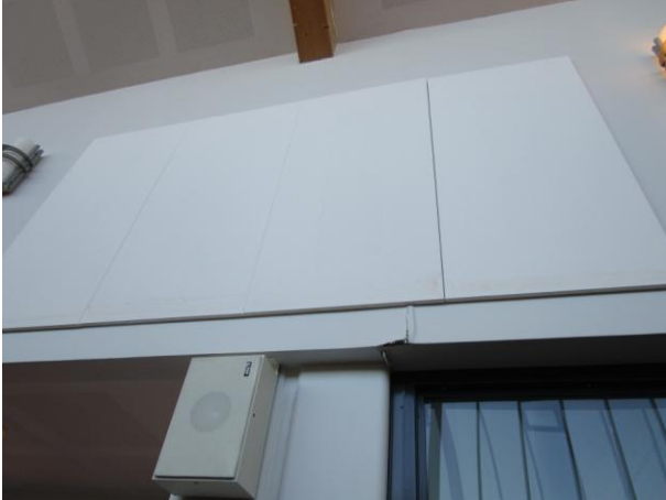
Pääaulaan on vuotanut vettä ilmeisesti liikuntasauaman kautta
