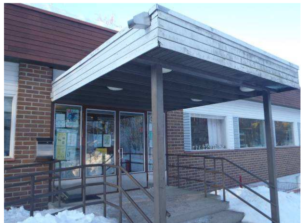
Ovien edustoilla on teräs- ja metallirakenteiset katokset, jotka vaativat jo kunnostamista.
