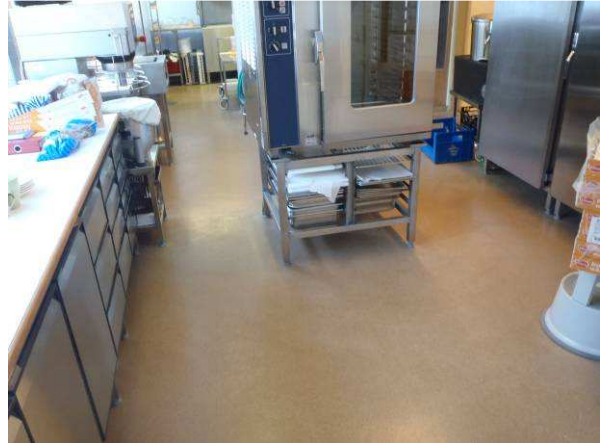
Kuvaa keittiöstä. Lattiassa havaittiin yksi halkeama, muuten pinnat ovat kunnossa.
