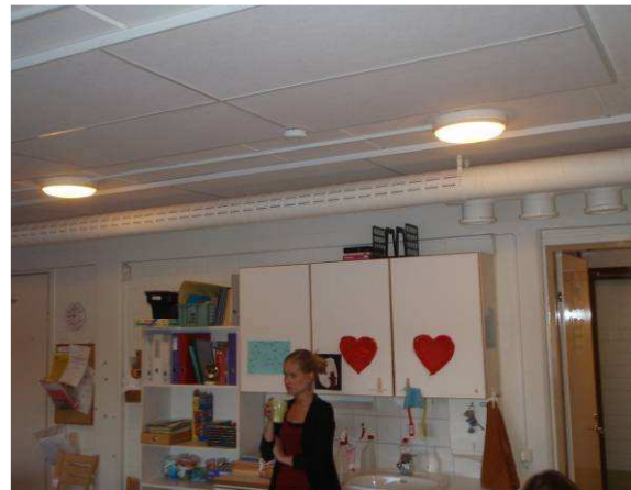
Tuloilmakanava katon rajassa
