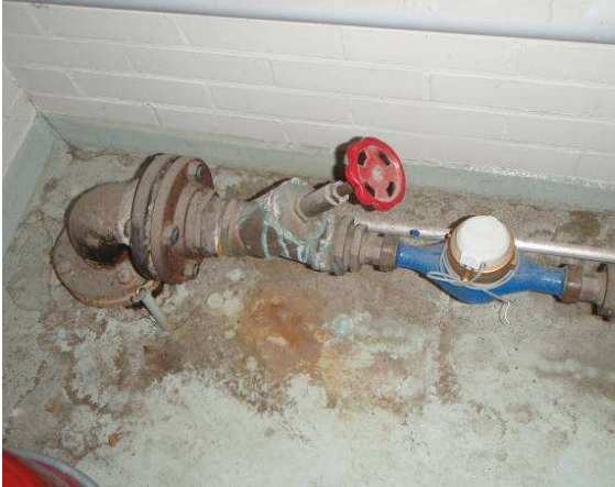
Päävesimittari ja alkuperäiset istukkaventtiilit
