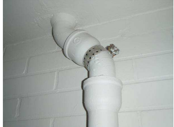
Viemäriputket ovat valurautaa että osin muovia
