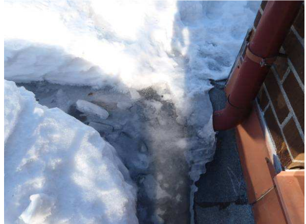
Kuvaa vesikatolle muodostuneesta jäädä rännin kohdalle.
