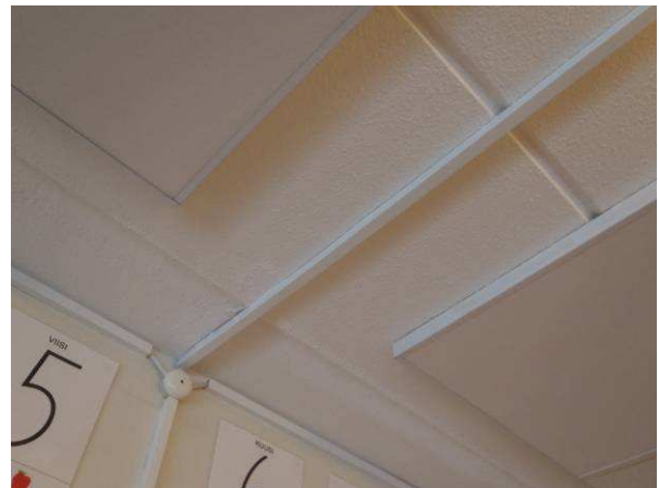
Rungon vaakarakenteissa on havaittu halkeamia, joita on korjattu.
