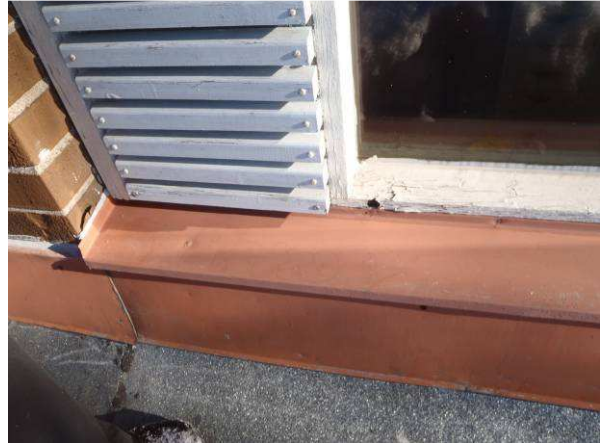
Kuvaa ikkunasta ulkopuolelta, maalipinta irtoilee. Vesipelti on asennettu suoraan ikkunakarmin pintaan.
