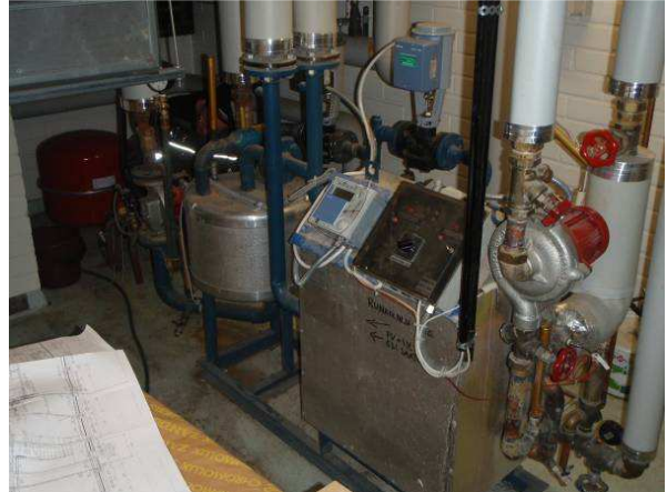
Lämmönsiirrinpaketti on alkuperäinen vuodelta 1980.
