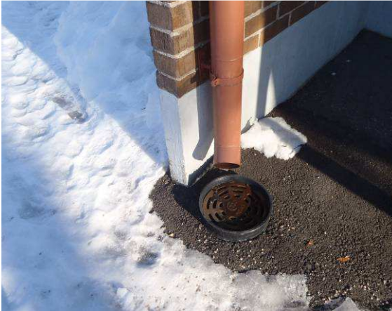
Sadevedet johdetaan katolta rännejä pitkin sadevesijärjestelmiin.
