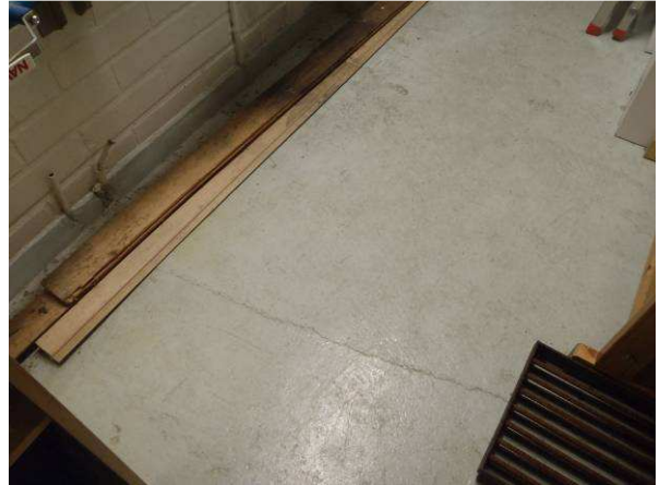
Maavaraeisessa alapohjalaatassa havaittiin muutamia ns. kutistumahalkeamia.
