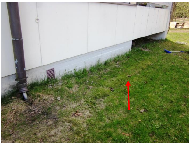
Kuva 10 Sadeveden betoninen ohjaukouru on kasvanut umpeen.
