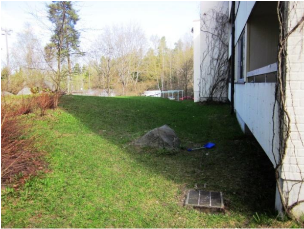
Kuva 8 Maanpinta viettää rakennukseen päin. Sadevesikaivon kansi on maanpintaa ylempänä.
