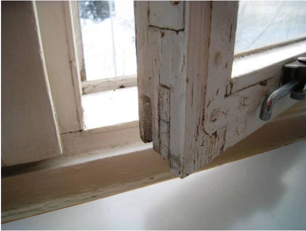
Kuva 8 Ikkunapuitteet ovat kuluneet.
