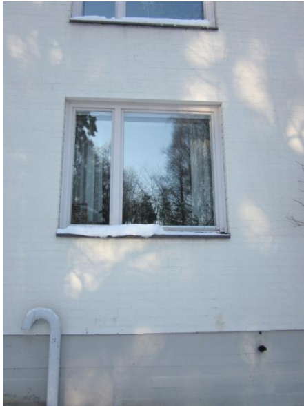
Kuva 6 Tiilimuurauksessa on halkeama.
