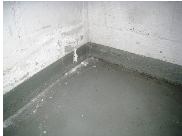
Kuva 15 Kosteuden aiheuttamaa maalipinnan hilseilyä talopesulan viereisessä urh.välinevarastossa.
