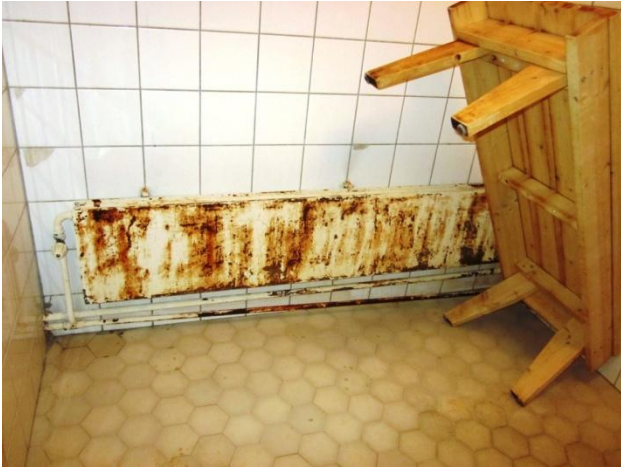
Kuva 16 Pesuhuoneessa ruostunut patteri ja lämminvesiputkia.
