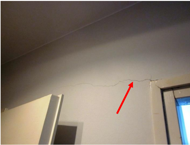
Kuva 12 Halkeama huoneiston A3 betoniväliseinässä.
