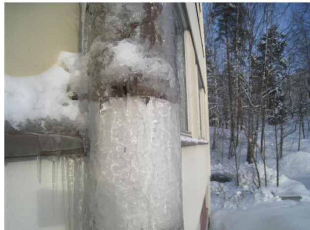
Kuva 2 Syöksytorvet ovat jäässä.
