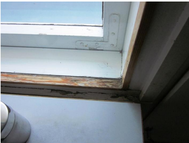
Kuva 10 Ikkunan alapuolella olevassa lastulevyssä kosteusjälkiä.
