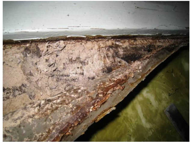
Kuva 13 Kosteus- ja mikrobivaurio saunaosaston pukuhuoneen muovimaton alla.
