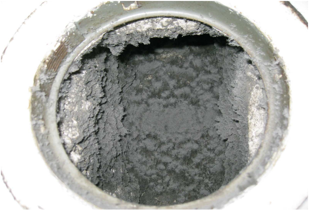
LVI-kuva 8. Yleiskuva poistoilmakanavasta.
