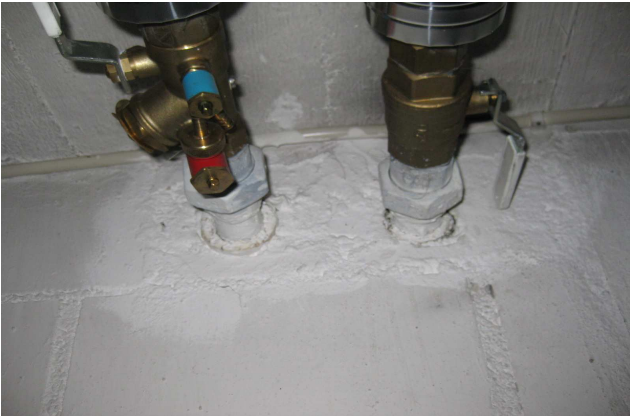
LVI-kuva 2. Yleiskuva lämpöjohtoverkoston venttiileistä.
