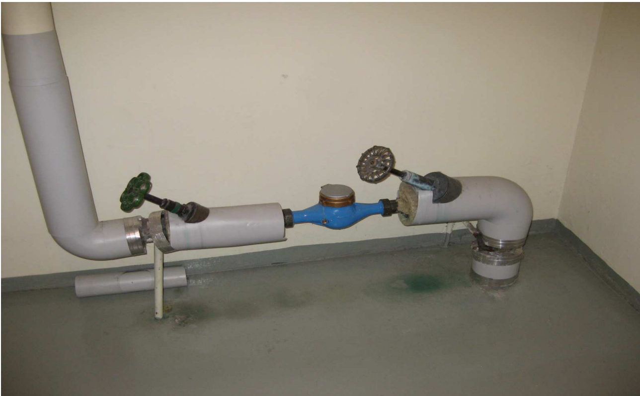
LVI-kuva 4. Yleiskuva vesimittarista ja pääsuluista, jotka sijaitsevat kuivaushuoneessa.
