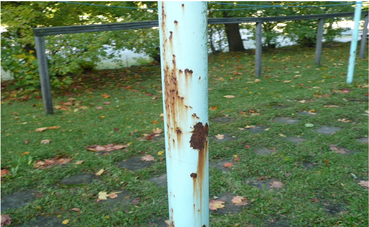
R-kuva 3. Telineissä on eriasteisia ruosteen aiheuttamia vaurioita.
