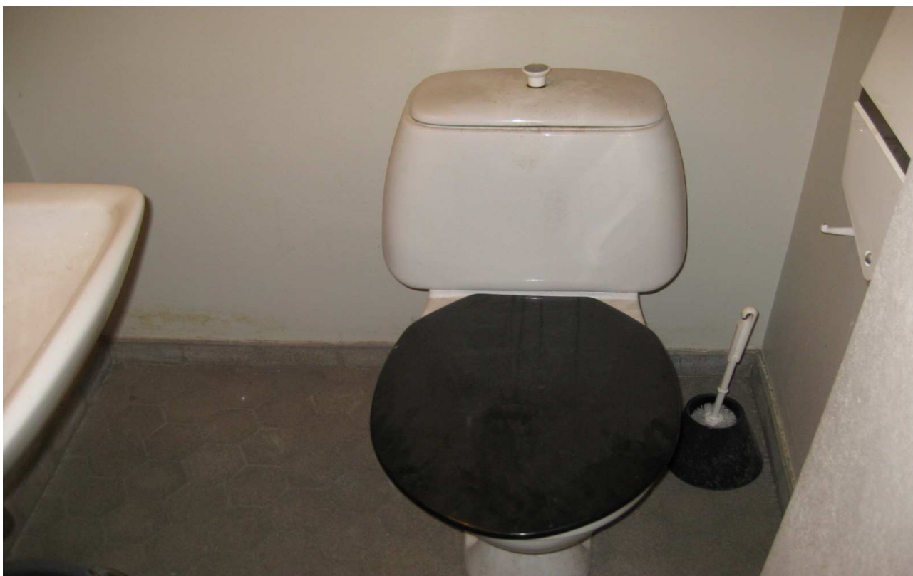
LVI-kuva 6. Yleiskuva vesikalusteista.
