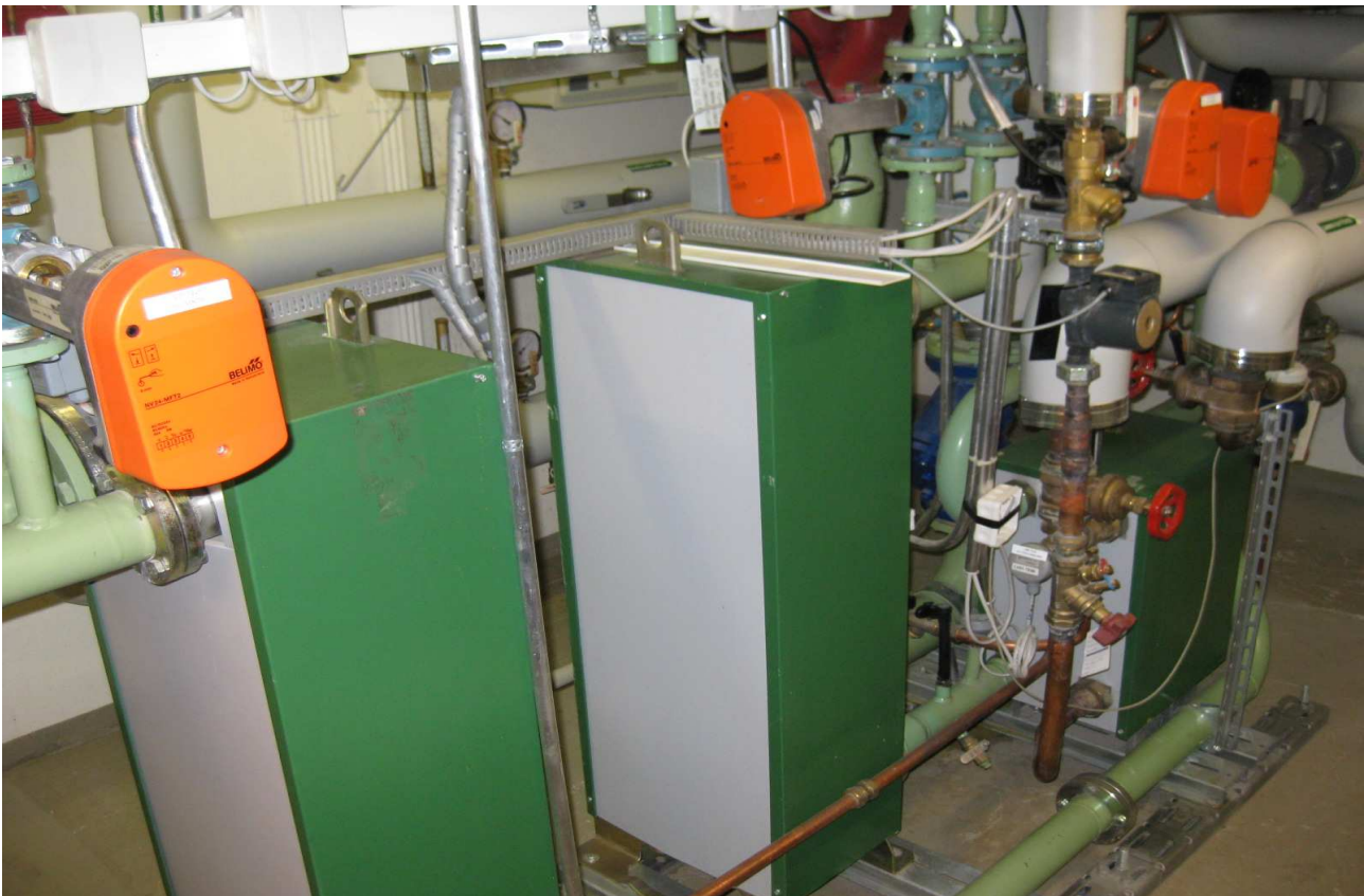
LVI-kuva 1. Yleiskuva koulun pannuhuoneesta, josta myös asuntolan lämpö tulee.
