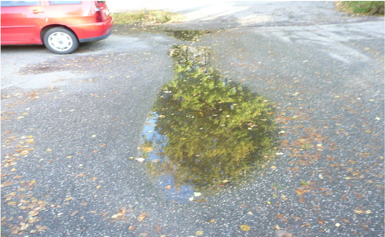
R-kuva 1. Asfaltissa esiintyy runsaasti painaumuja ja halkeamia.
