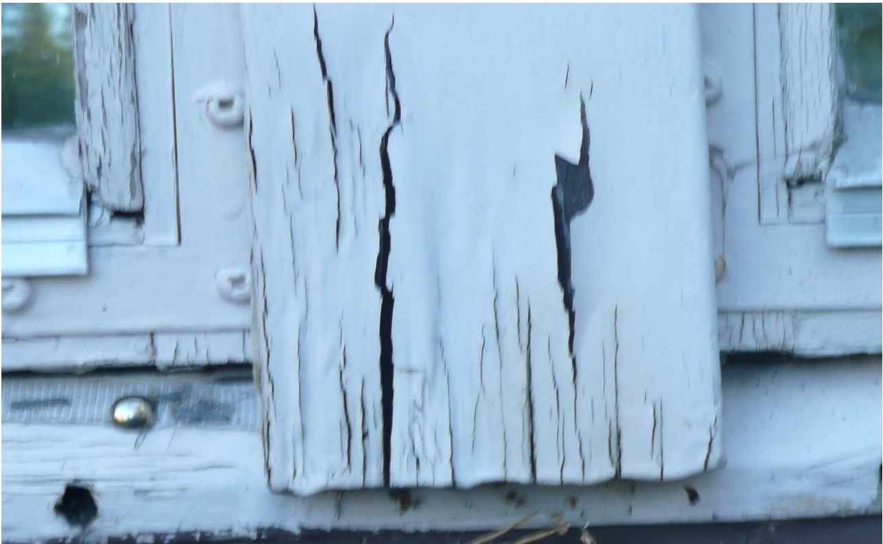
R-kuva 7. Ikkunoissa todettiin olevan maalipinnan lohkeilua ja hilseilyä sekä lahovaurioita.
