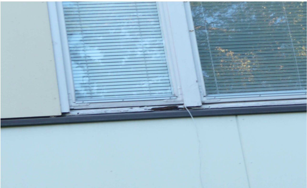
R-kuva 6. Ikkunoissa todettiin olevan maalipinnan lohkeilua ja hilseilyä sekä lahovaurioita.
