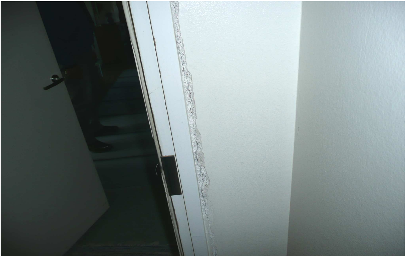
R-kuva 9. Asunto B11:n porrashuoneen seinässä on halkeama.
