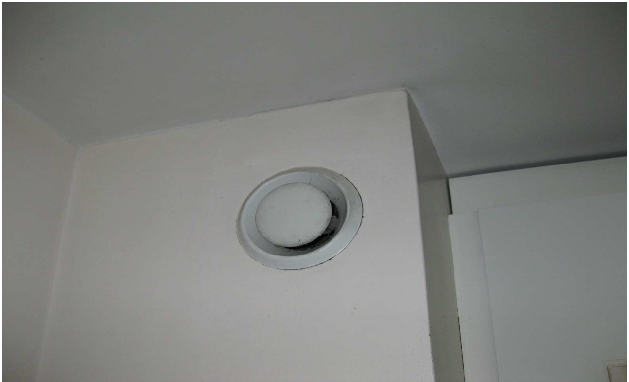
LVI-kuva 9. Yleiskuva poistoilmaventtiilistä.
