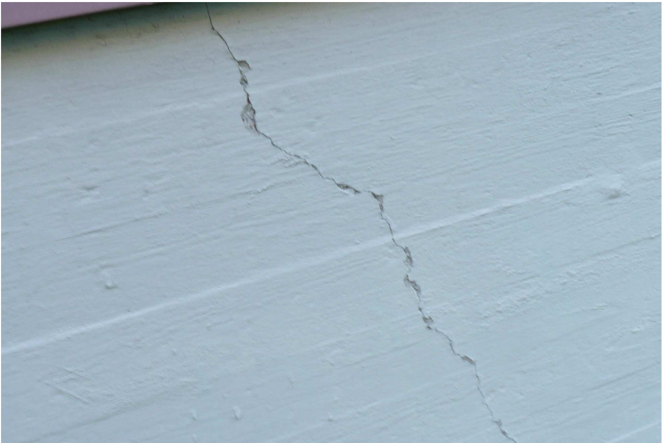
R-kuva 5. Sokkeleissa esiintyy halkeamia.
