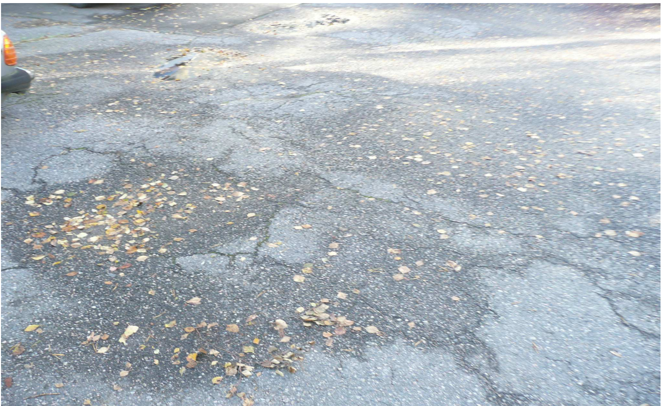
R-kuva 2. Asfaltissa esiintyy runsaasti painaumuja ja halkeamia.
