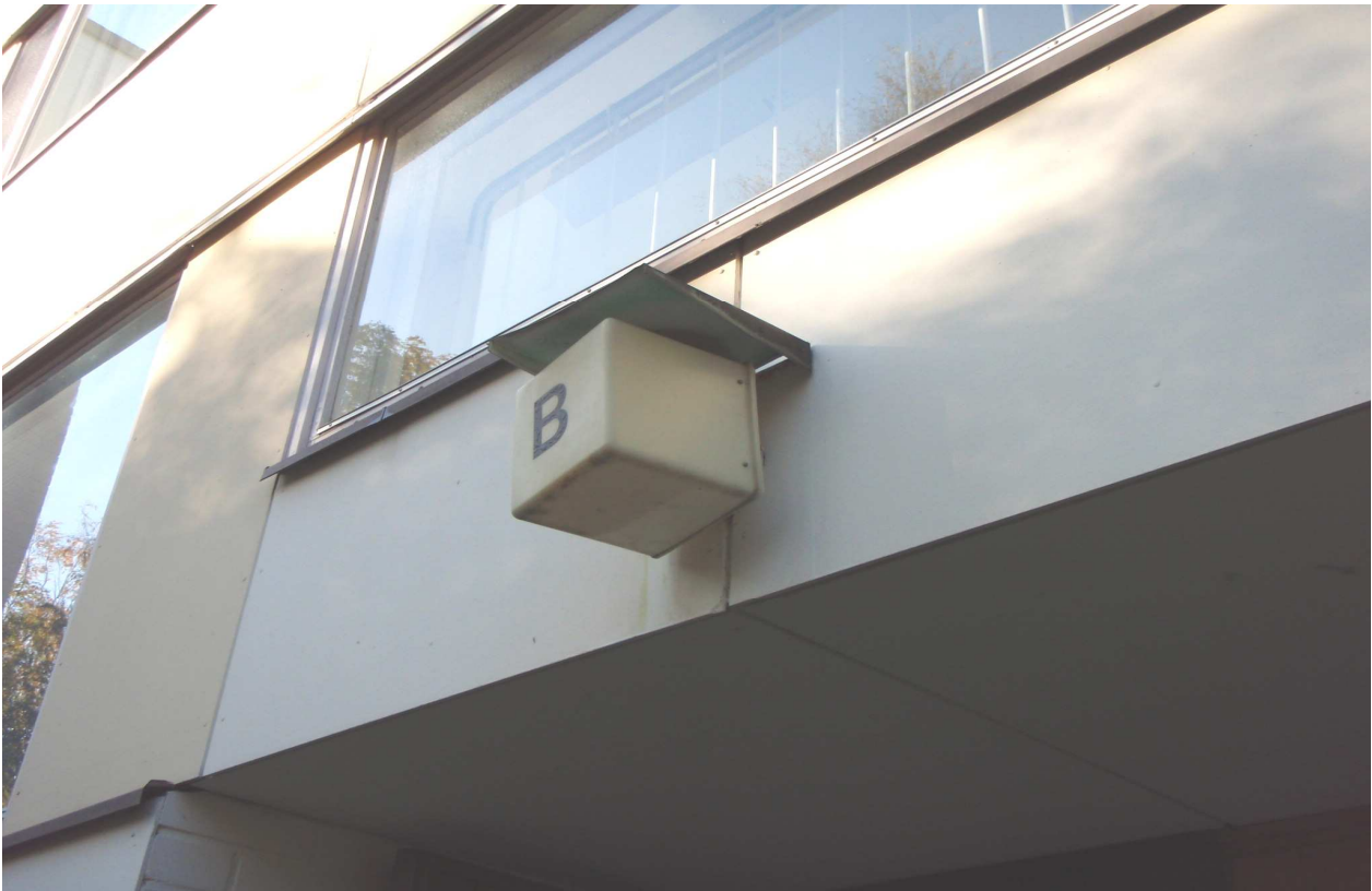
S-kuva 1. Sisäänkäynnin valaistus, valaisimen kupu on huonosti kiinni.
