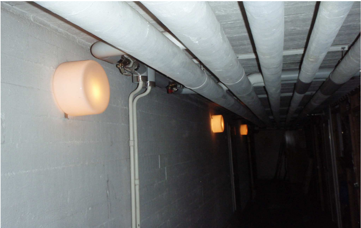
S-kuva 7. Kellarin valaistus.
