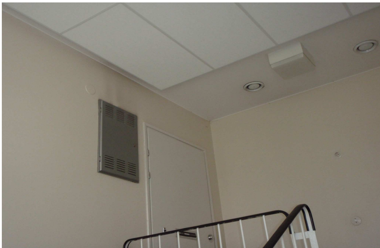
S-kuva 9. Porrashuoneen valaistus.
