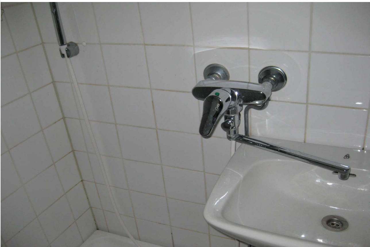
LVI-kuva 5. Yleiskuva vesikalusteista.
