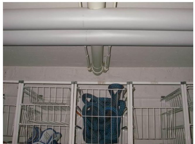
Kuva 4 Tiivistämätön läpivienti välinevaraston puolelta
