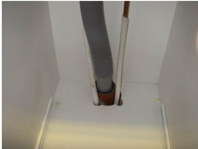
Kuva 1 Tiivistämätön läpivienti välinevarastoon
