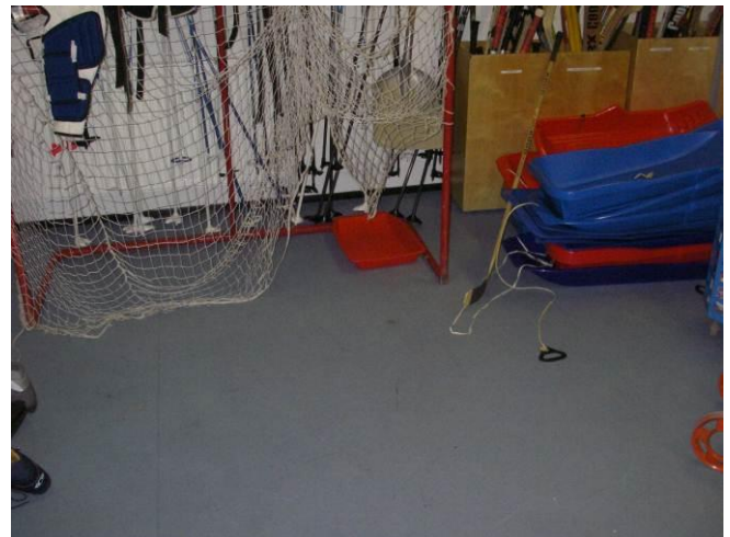
Kuva 3. Välinevarasto, jonka maton alta kosteus
