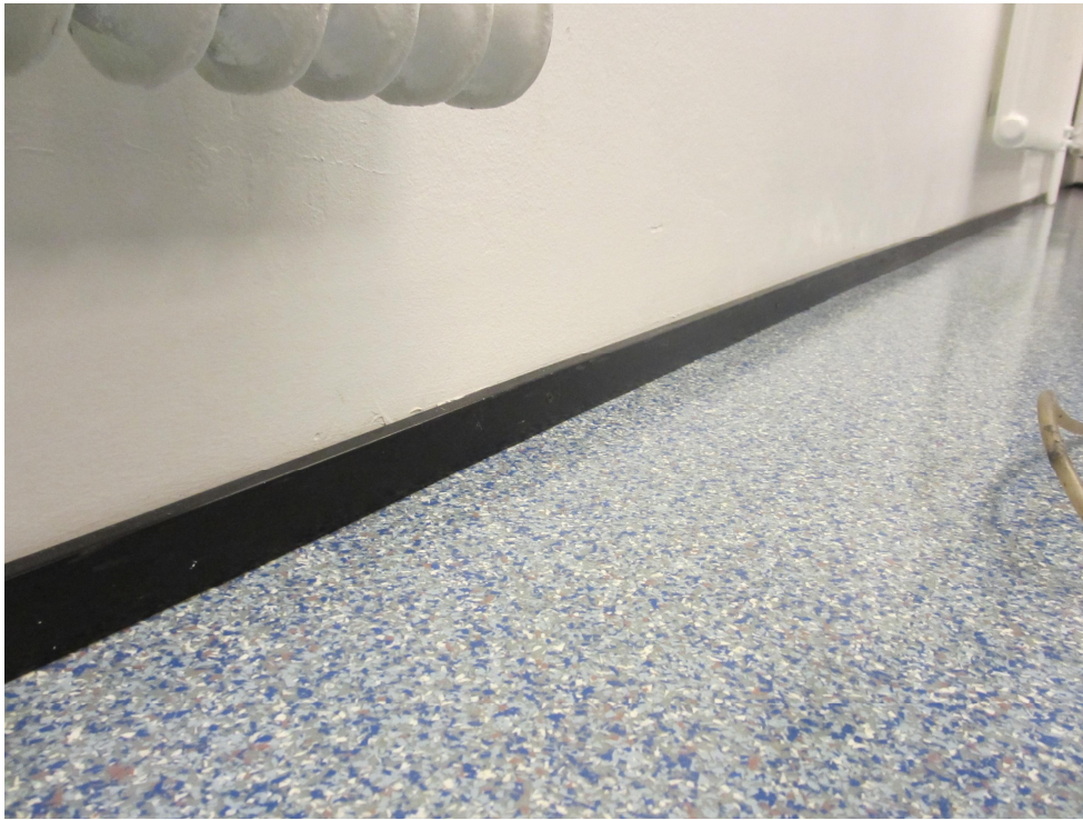
Kuva 2. Ilmavuotoa havaittiin lattia/seinäliittymästä jalkalistan alta.
