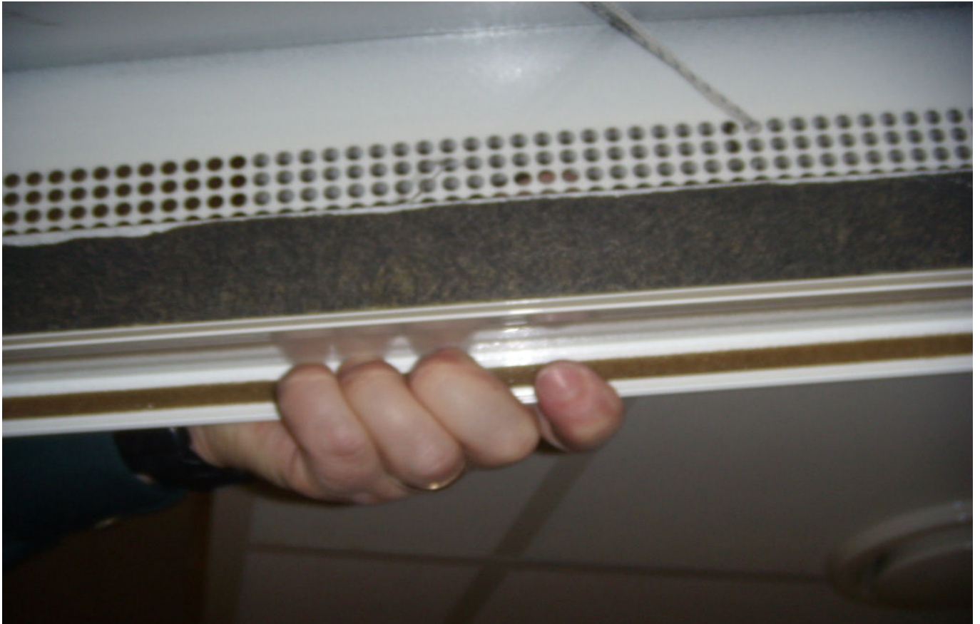
KUVA 11. Yleiskuva tuloilman pääte-elimistä, jossa on villapintaeristettä.
