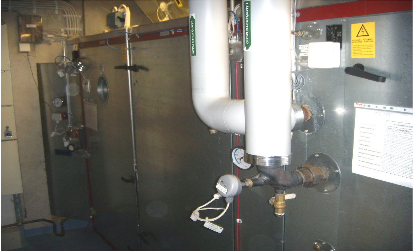
KUVA 1. Yleiskuva IV- konehuoneesta.
