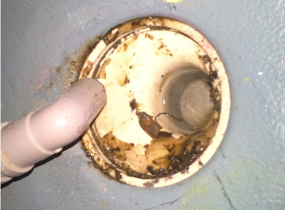
Kuva 1. Epätiivis lattiakaivo vesileikkitalassa 11
