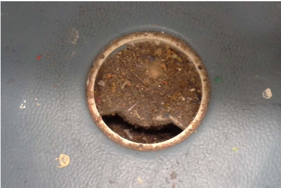
Kuva 2. Täysin kuivunut lattiakaivo vesileikkitalassa 40
