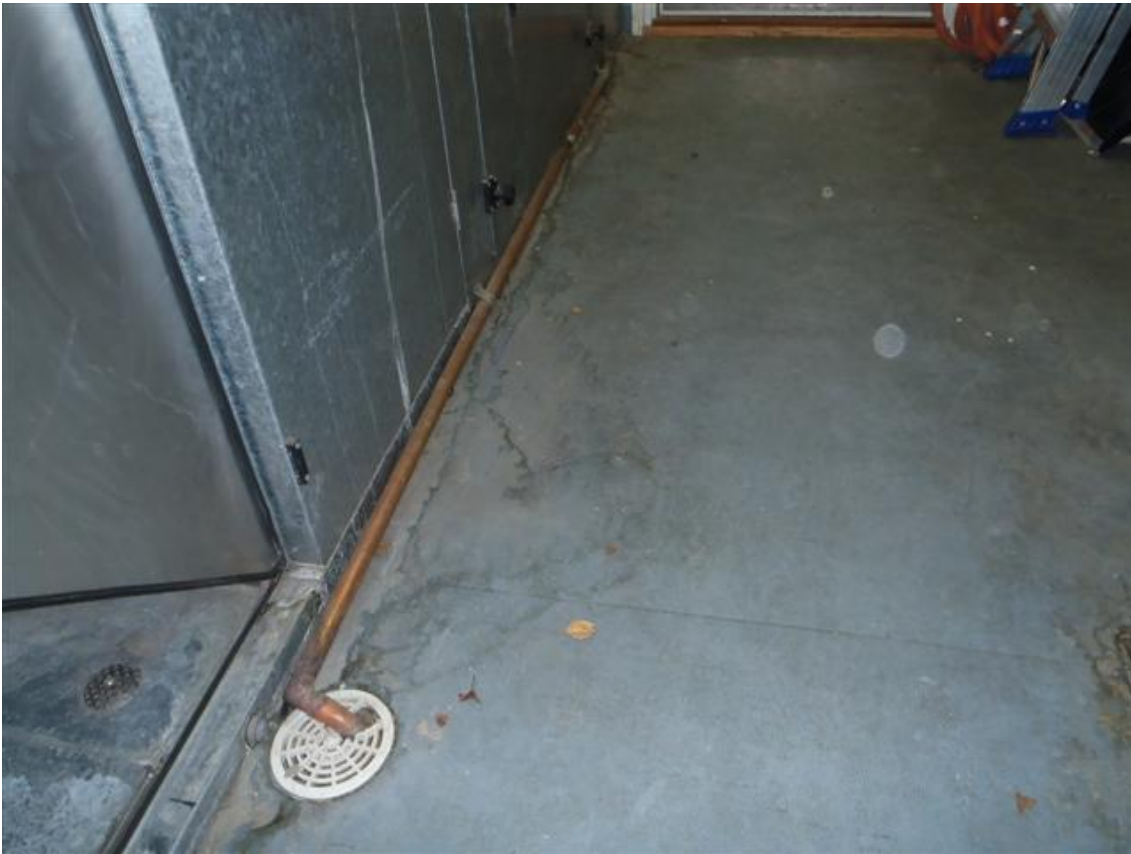
Kuva 3. Tuloilmakammion vedenpoisto yhdistyy suoraan lattiakaivoon
