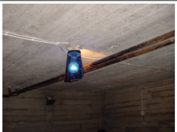
KUVA 36 Kellarikerroksen varastotilan valaisimilta puuttuu kunnolliset kuvut (5.1.3)
