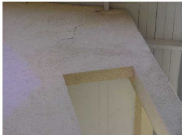
KUVA 10 Julkisivuvaurio rakennuksen Länsipäädyssä(3.2.3.)
