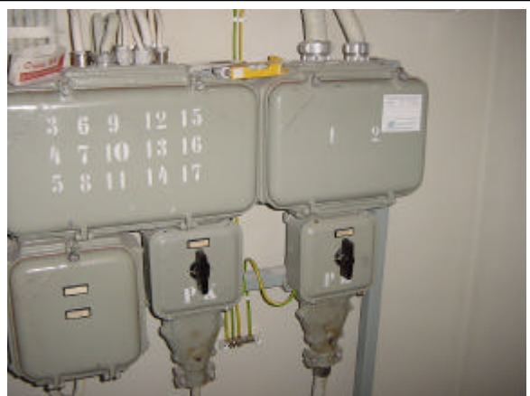
KUVA 30 Kiinteistön vanha pääkeskus (5.1.1)
