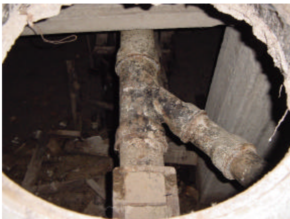
KUVA 27 Valurautainen puhdistusyhde alapohjassa (4.2.3)
