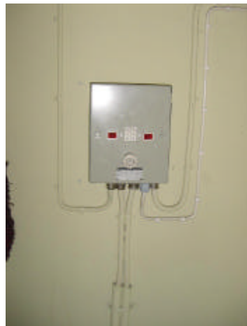
KUVA 34 Nykyisten määräysten vastainen saunan kiukaan ohjauskeskus (5.1.3).
