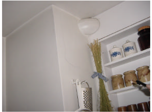
KUVA 20 Murtunut seinäpinta asunnossa (3.3.6.)
