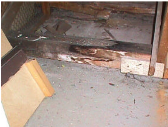
KUVA 15 Lahovaurioituneita vesikaton alusrakenteita, mikrobikasvustoa (3.2.7.)
