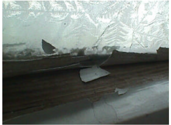
KUVA 14 Saunaosaston ikkunan irronnutta maalipintaa (3.2.5.)
