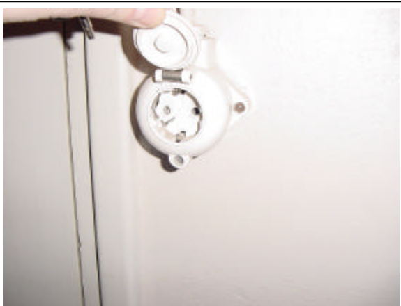
KUVA 35 Rikkinäinen pistorasia kellarin käytävällä (5.1.3).
