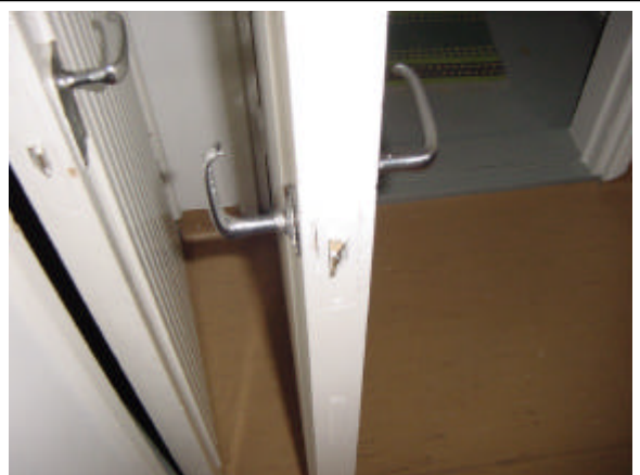
KUVA 18 Saunaosaston oven lukko, jota ei saa murtamatta avattua ulkoa (3.3.5.)
