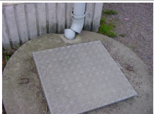
KUVA 4 Paaluveden syöttökaivo, lukko puuttuu, liitos irti (3.1.3.) ja (4.2.1)
