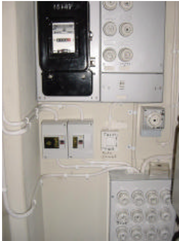
KUVA 31 Jälkeenpäin asennettu, autolämmitystä palveleva keskus (5.1.1)
