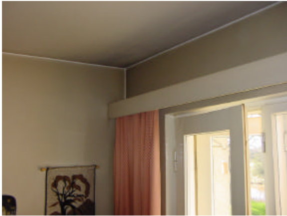
KUVA 19 Pahoin likaantuneita asunnon seinä- ja kattopintoja (3.3.6.)
