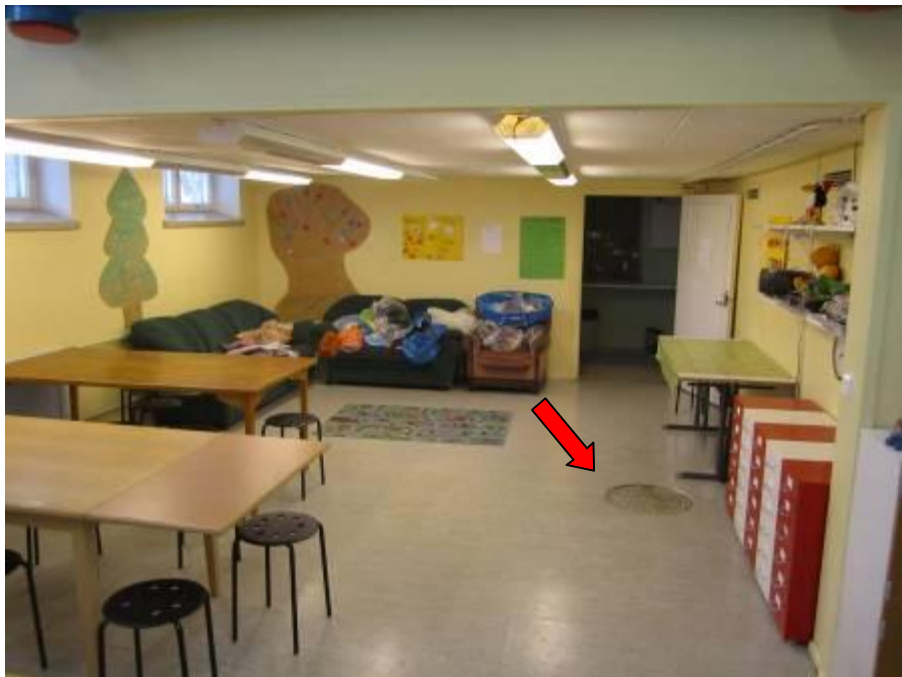
Kuva 3. Tilan 004 lattiassa olevan tarkastusluukun/ -kannen (osoitettu kuvaan punaisella nuolella) reunoilta ja nostoreiän kohdalta todettiin ilmavirtausmerkisävuilla ilmavirtauksia huonetilaan päin.
